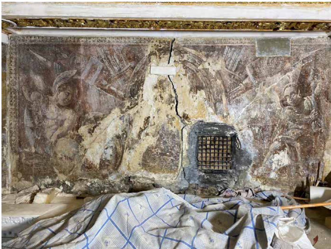
Илл. 06. Золотой зал. Люнет в осях Г-Д"/6. Центральный фрагмент. Вентиляционное отверстие. Съемка 03.09.2021 г. Трушковский В. Э.
