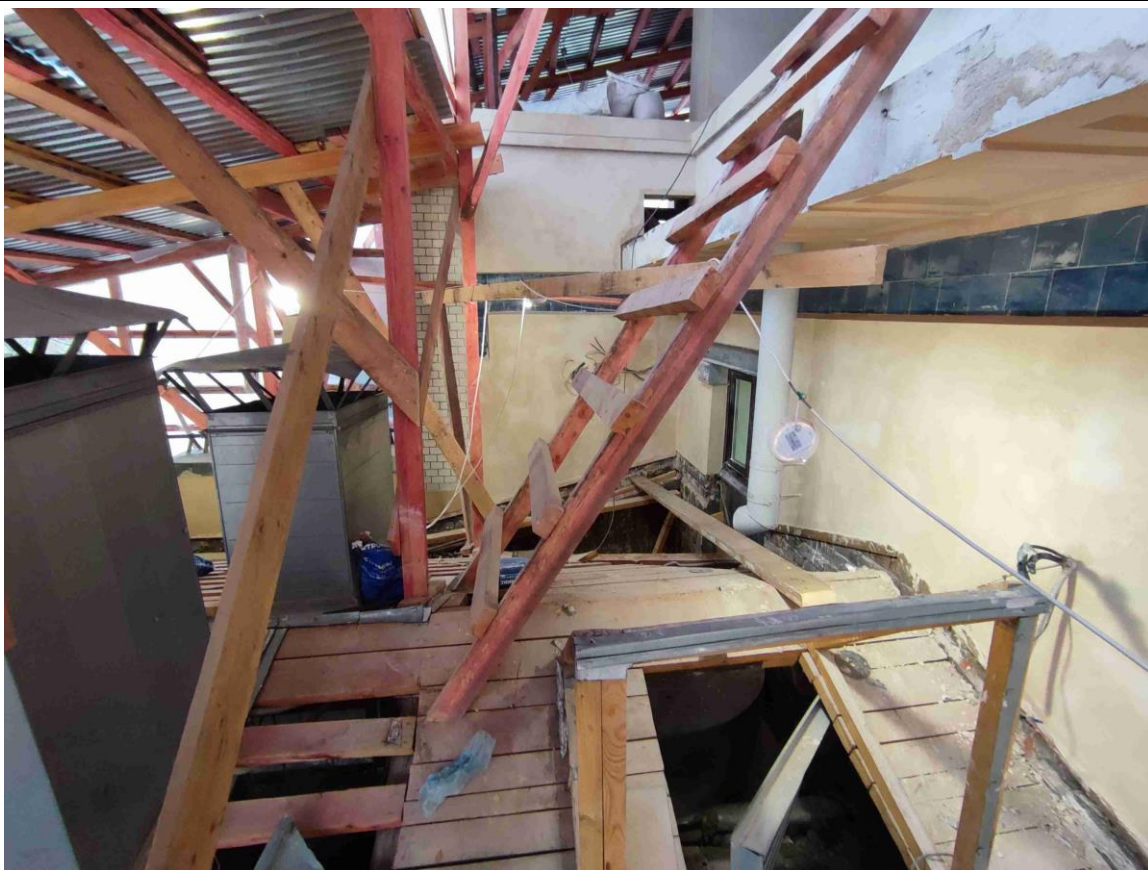
43. Фрагмент южного дворового фасада, находящегося под временной крышей, установленной для ремонта исторической крыши объекта культурного наследия.
