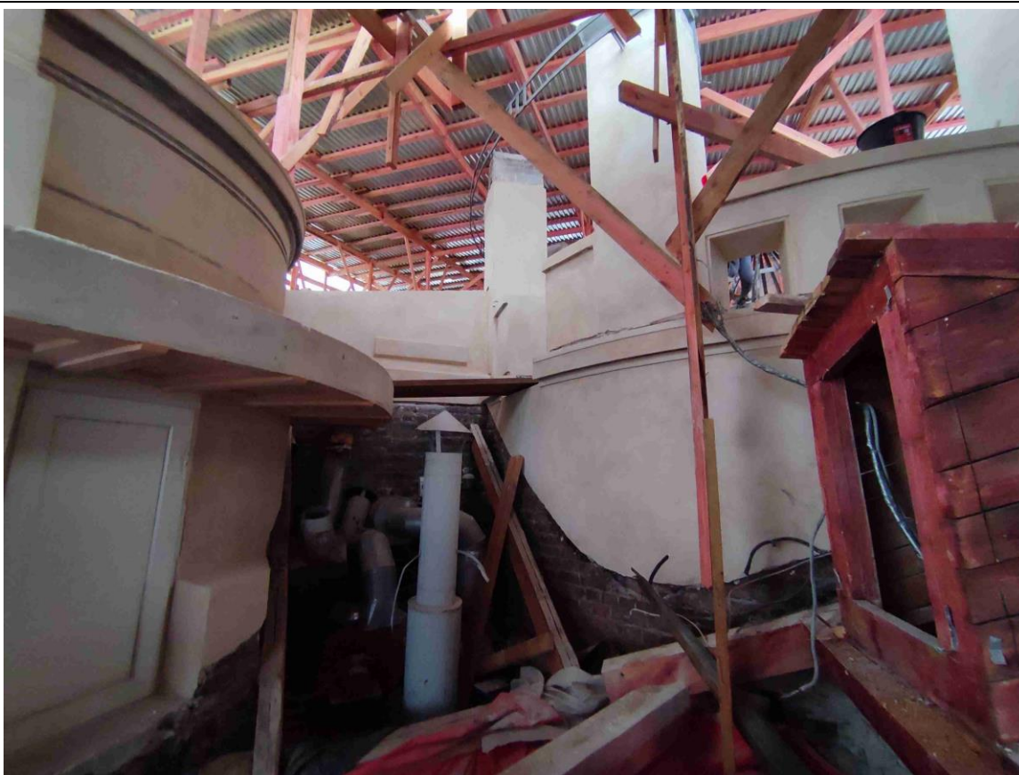
38. Фрагмент лицевого фасада со стороны улицы Рентгена, находящегося под временной крышей, установленной для ремонта исторической крыши объекта культурного наследия.
