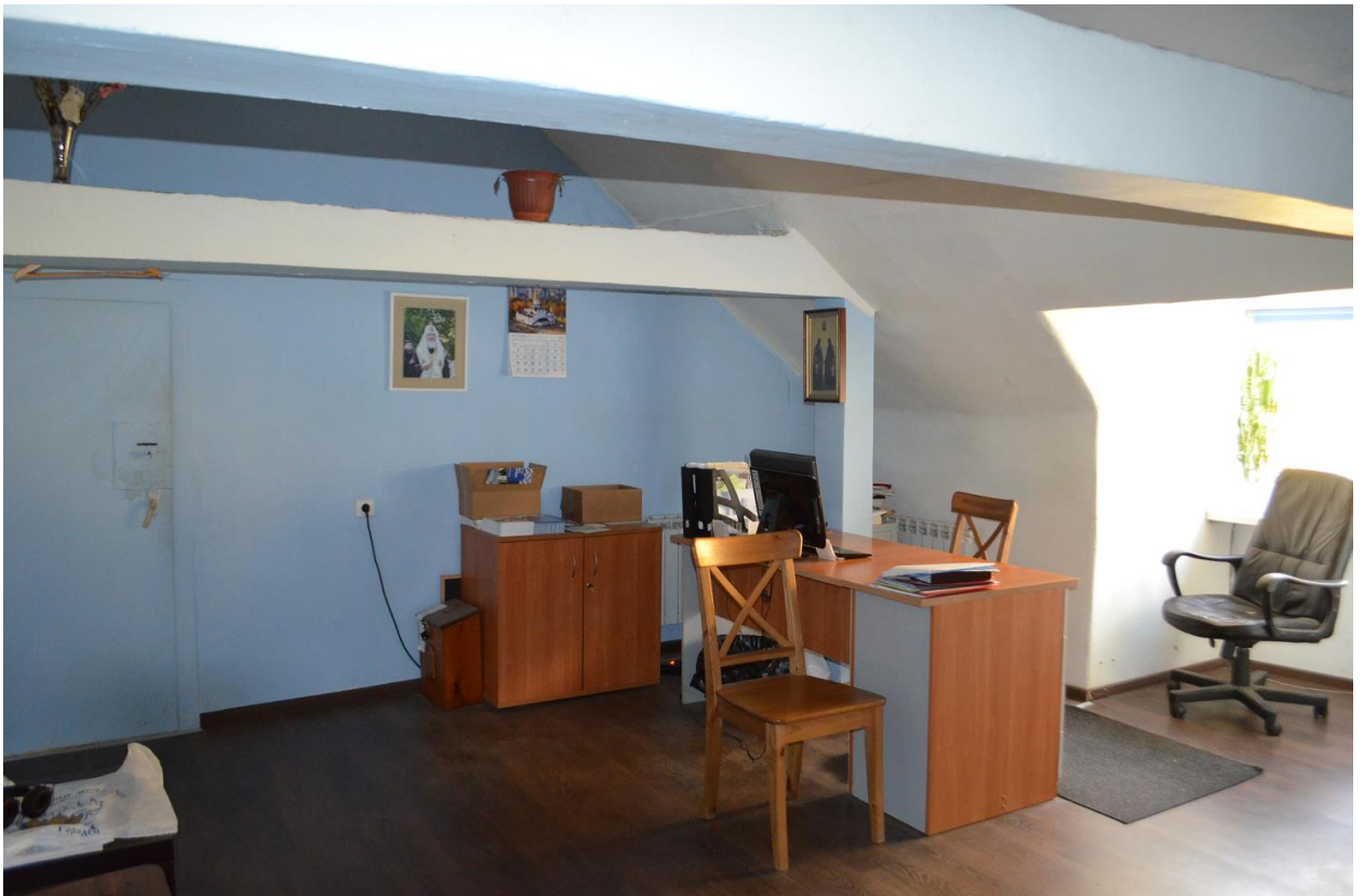
Фото 18. ОКН федерального значения «Корпус просфорный с северными воротами главного двора» (наб. реки Монастырки, дом 1, литера Г). Помещение в осях Б-В/4-5. Съёмка 27.09.2021 г.
