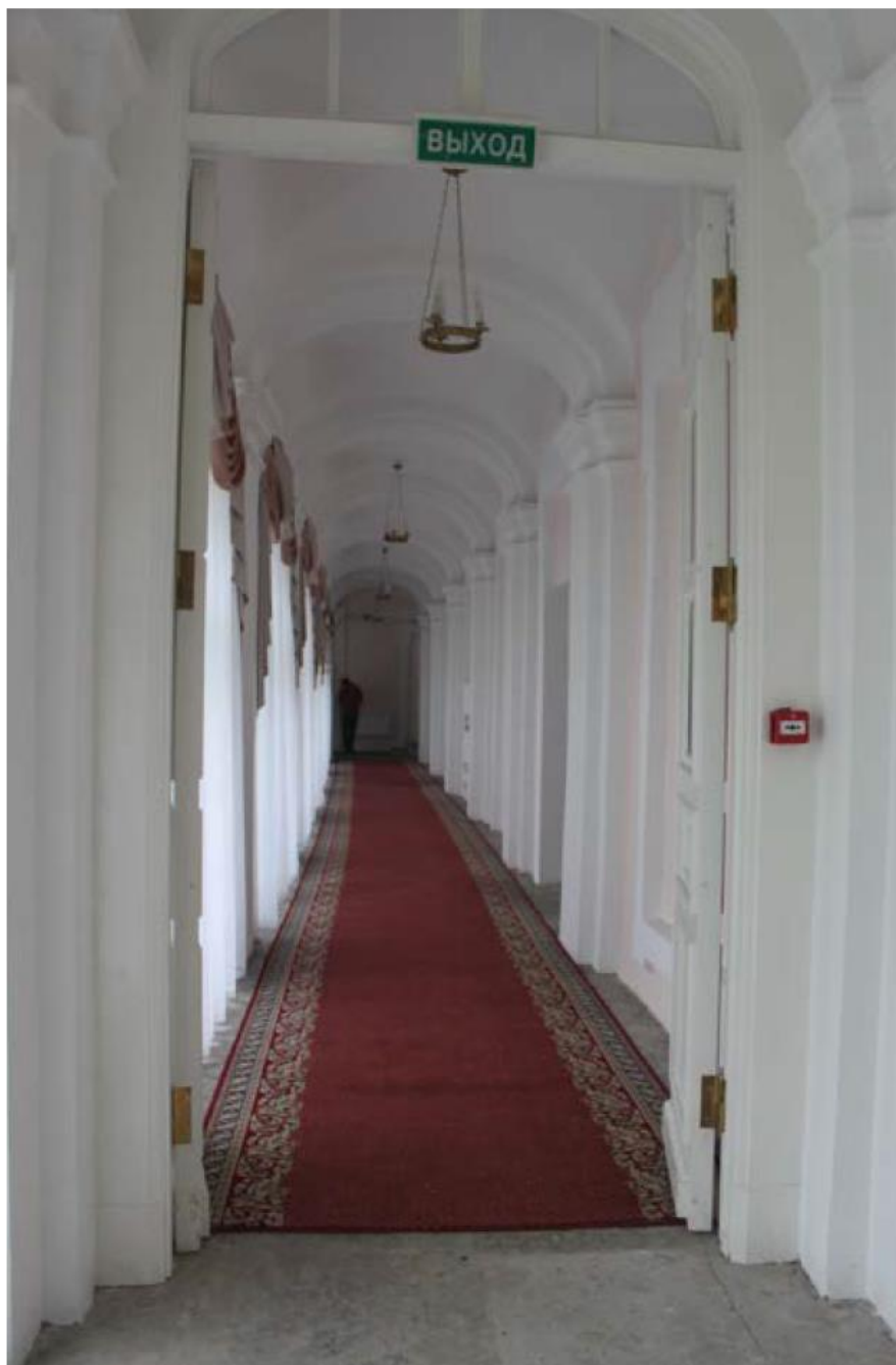
Фото 11. ОКН федерального значения «Корпус просфорный с северными воротами главного двора» (наб. реки Монастырки, дом 1, литера Г). Галерея первого этажа в осях Б-Г/5-6. Съёмка 27.09.2021 г.
