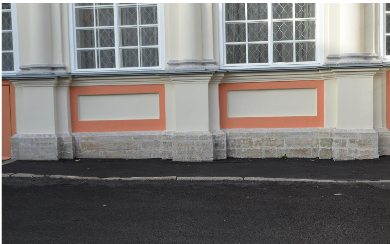
Фото 29. ОКН федерального значения «Корпус просфорный с северными воротами главного двора» (наб. реки Монастырки, дом 1, литера Г). Южный фасад. Фрагмент. Съёмка 27.09.2021 г.
