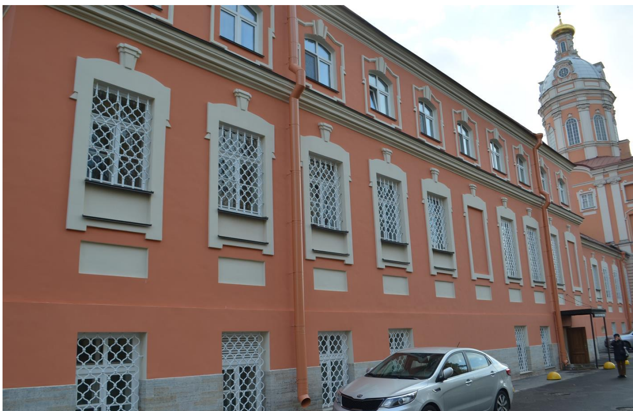
Фото 33. ОКН федерального значения «Корпус просфорный с северными воротами главного двора» (наб. реки Монастырки, дом 1, литера Г). Северный фасад. Фрагмент. Съёмка 27.09.2021 г.
