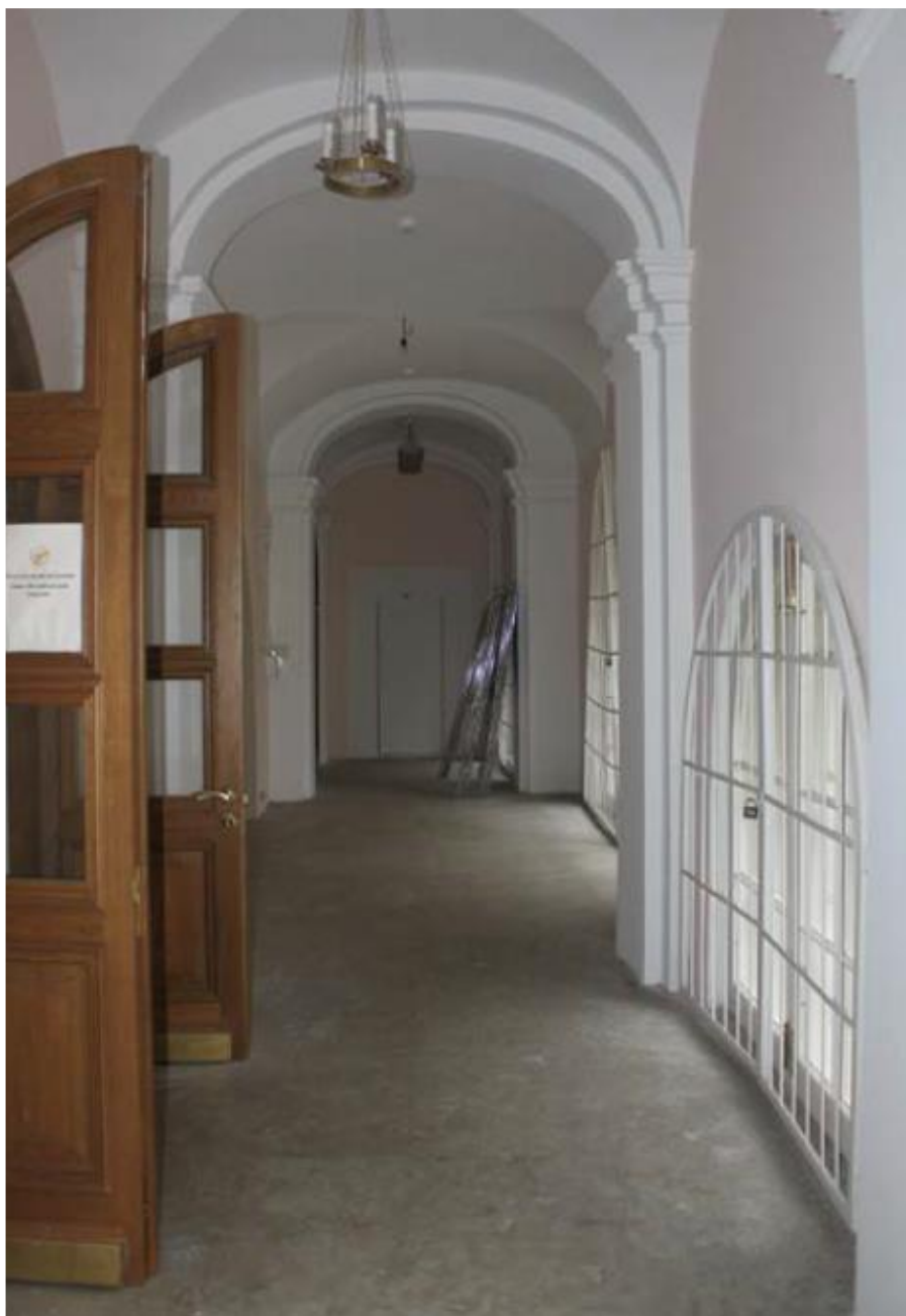
Фото 10. ОКН федерального значения «Корпус просфорный с северными воротами главного двора» (наб. реки Монастырки, дом 1, литера Г). Галерея первого этажа в осях Б-Г/5-6. Съёмка 27.09.2021 г.
