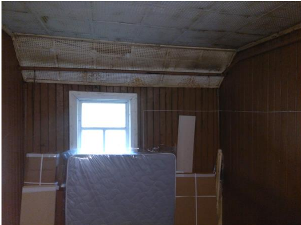
24. Объект культурного наследия регионального значения «Дача А.Н. Францена (О. Бертенсон)» по адресу: г. Санкт-Петербург, г. Зеленогорск, ул. Березовая, д. 19, лит. Д. Фрагмент интерьера.
