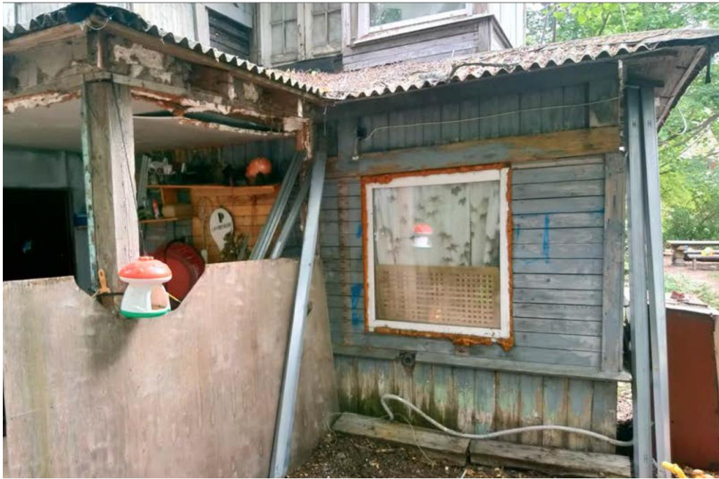
9. Объект культурного наследия регионального значения «Дача А.Н. Францена (О. Бертенсон)» по адресу: г. Санкт-Петербург, г. Зеленогорск, ул. Березовая, д. 19, лит. Д. Западный фасад. Первый этаж. Фрагмент. Поздняя перестройка.
