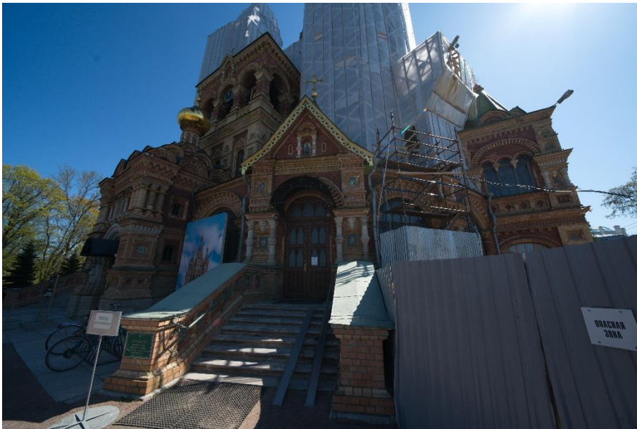
22. «Б. Собор Петра и Павла со зданием б. Церковно-приходской школы», г. Петергоф, Санкт-Петербургский проспект, дом 32, литера А; дом 43 б, литера А (Красный пр., 32, Красный пр., 43). Южный фасад. Фрагмент. Фото 18.09.2021г.
