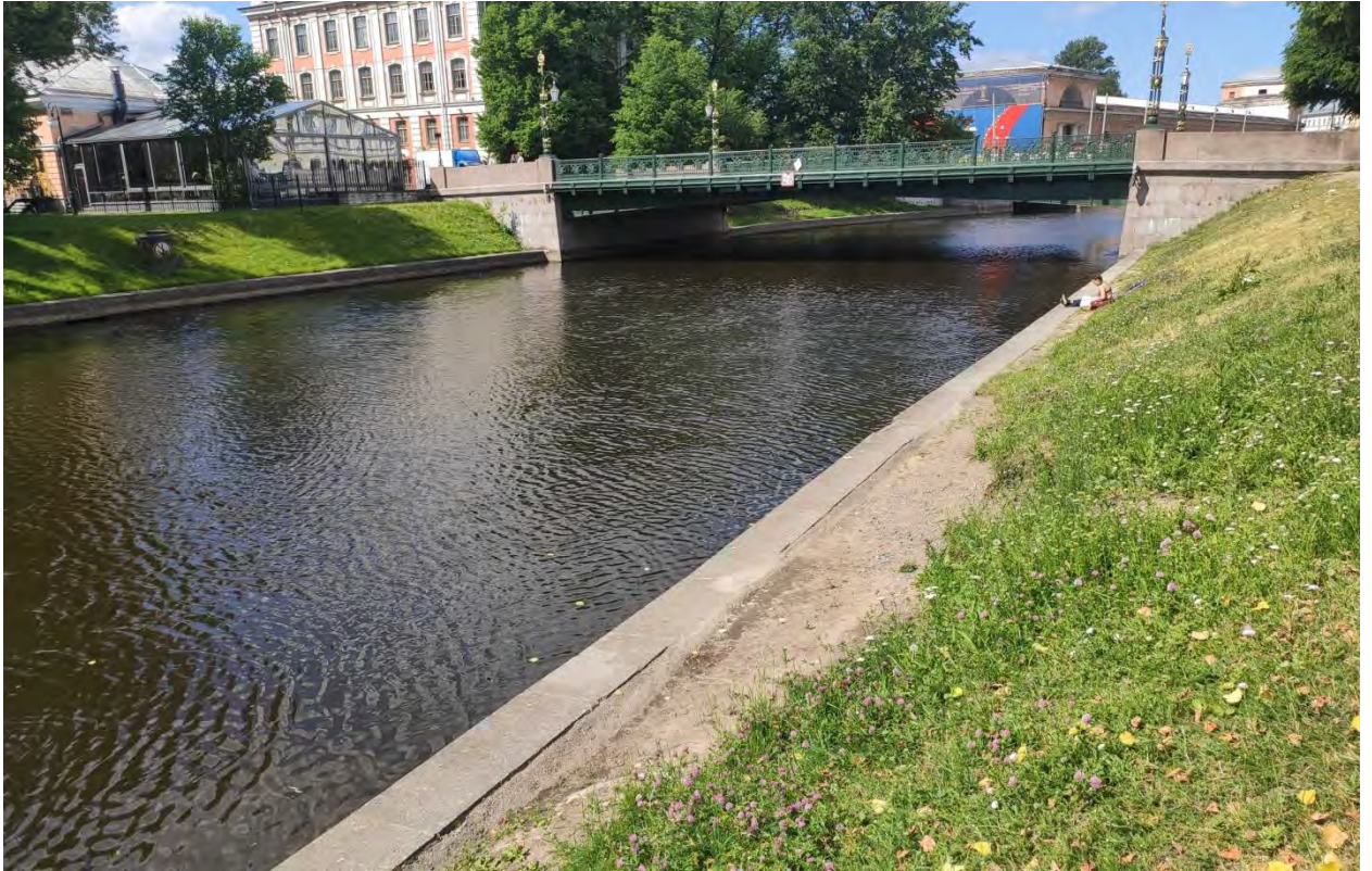
Фото 3. Вид на участок «проседания» подпорной стенки в вертикальном направлении в зоне ранее имеющегося размыва от поврежденных инженерных сетей (в настоящее время отремонтированы). Фото – Давыдова Н.А., 22.06.2020.
