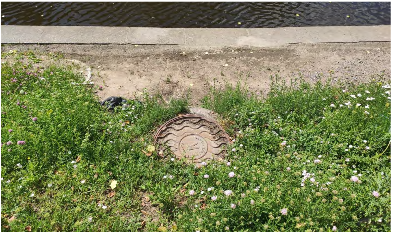
Фото 4. Вид на колодец канализационной сети в откосе в месте размыва откоса и деформации подпорной стенки набережной. Фото – Давыдова Н.А., 22.06.2020.
