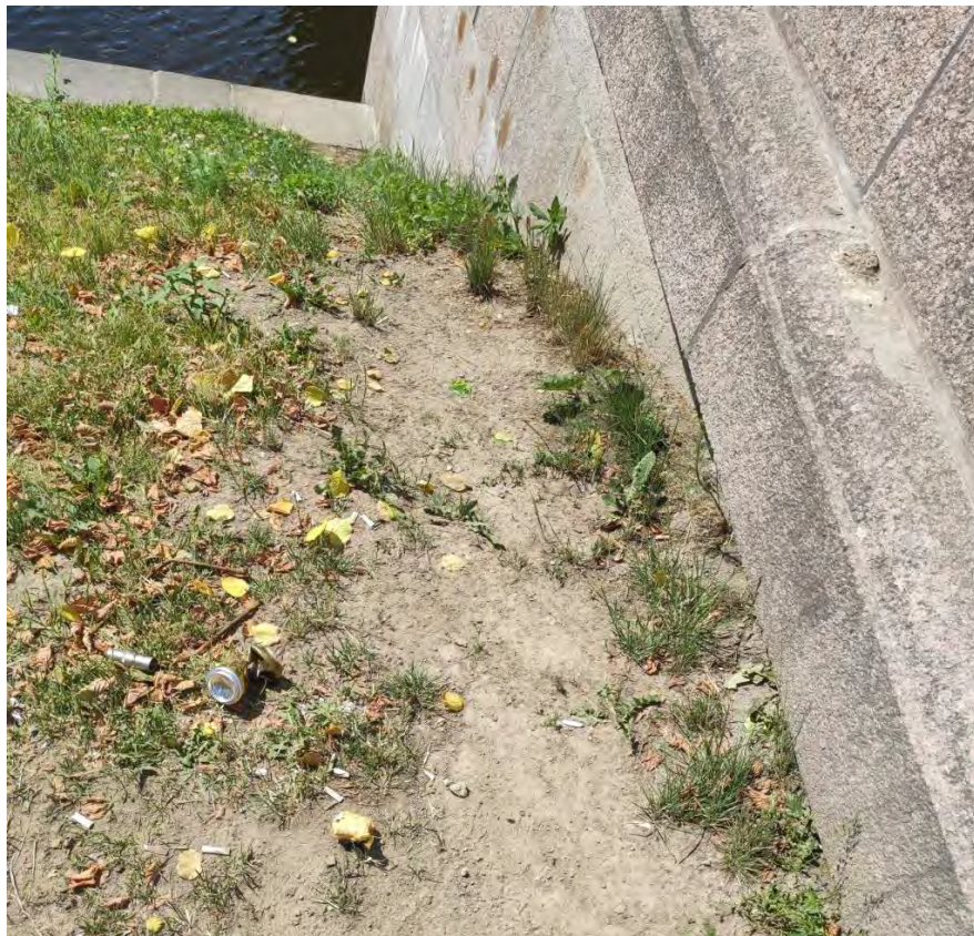
Фото 8. Вид на участок газона непосредственно примыкающего ко 2-му Садовому мосту, вдоль моста устроен стихийный спуск к воде, газон вытоптан. Фото – Давыдова Н.А., 22.06.2020.
