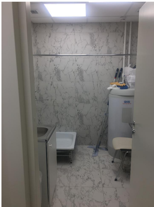
26. Фотофиксация 5-го этажа здания Невский пр., д.82, литера А. Квартира № 50. Подсобное помещение.
