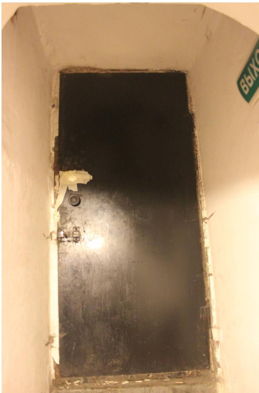
20. Здание по адресу: Санкт-Петербург, Казанская улица, д. 8-10, Лит. А. Интерьеры цокольного этажа.
