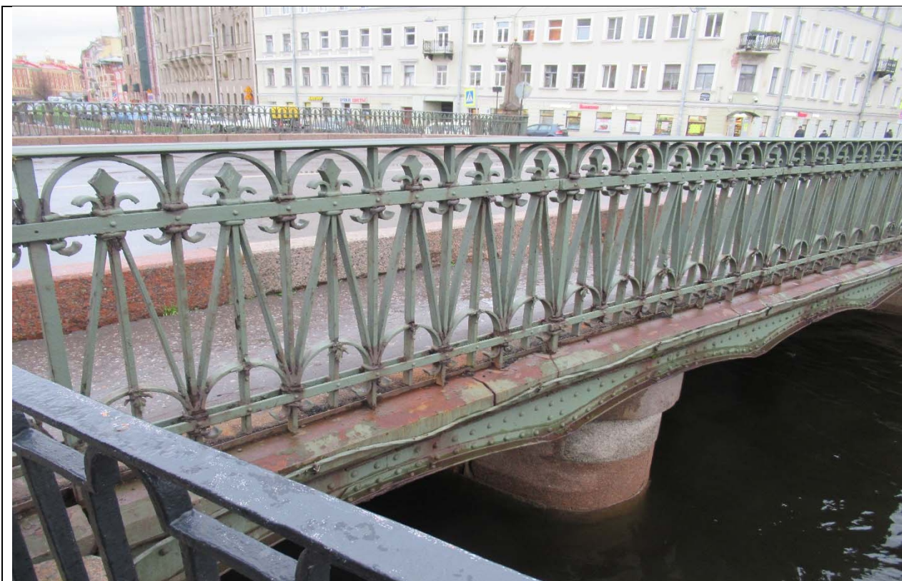
9. ОКН ФЗ «Мост Аларчин», входящий в состав комплекса «Набережные и мосты Екатерининского канала (ныне канала Грибоедова)» по адресу: г. Санкт-Петербург, через канал Грибоедова по Английскому пр. Общий вид на проезжую и пешеходную части моста от просп. Римского -Корсакова. Дата съемки: 16.11.2020 г.
