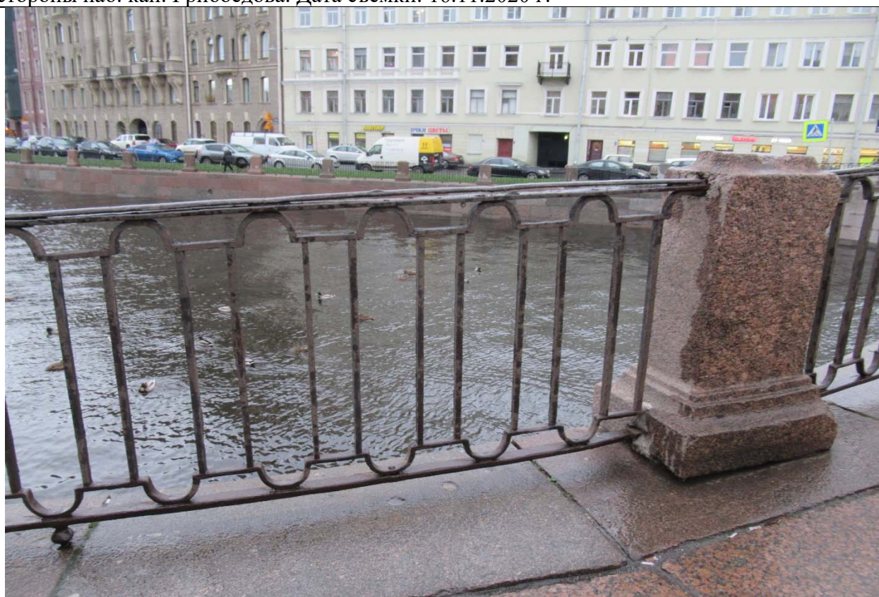
4. ОКН ФЗ «Мост Аларчин», входящий в состав комплекса «Набережные и мосты Екатерининского канала (ныне канала Грибоедова)» по адресу: г. Санкт-Петербург, через канал Грибоедова по Английскому пр. Элементы декора ограждения моста и вид на набережную, расположенную со стороны наб. кан. Грибоедова. Дата съемки: 16.11.2020 г.
