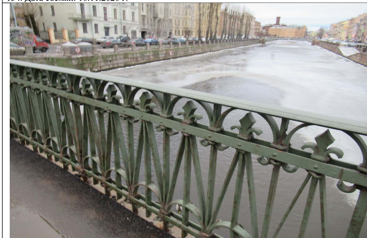
18. ОКН ФЗ «Мост Аларчин», входящий в состав комплекса «Набережные и мосты Екатерининского канала (ныне канала Грибоедова)» по адресу: г. Санкт-Петербург, через канал Грибоедова по Английскому пр. Перильное ограждение. Дата съемки: 16.11.2020 г.
