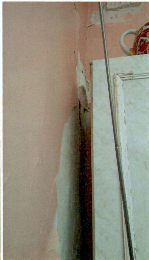
11. Трещины с маяками в квартирах последнего этажа
