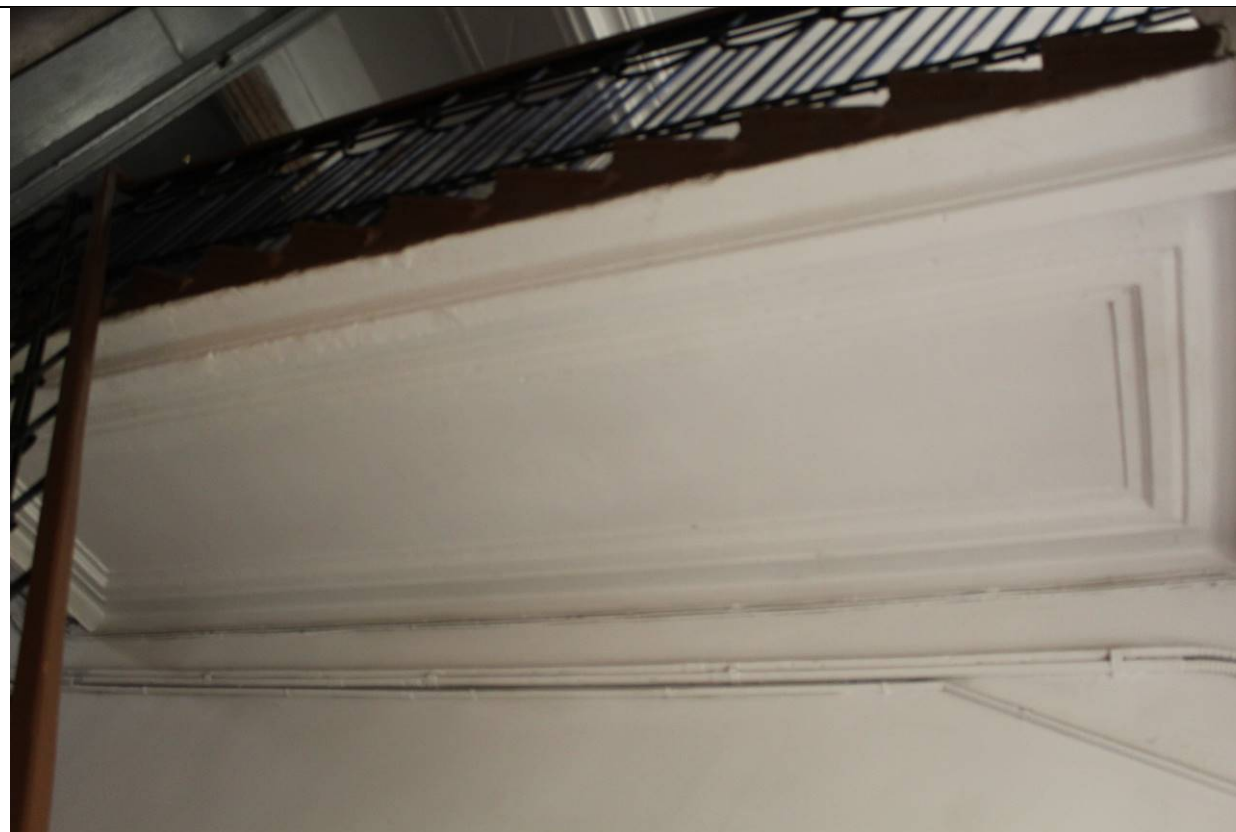
20. Дом В. И. Яковлева и В. Г. Васильева. 15-я линия В.О., дом 34. ЛК-1. Лестничный марш на косоуре. Фрагмент. Фото: эксперт А. А. Кононов, 19.04.2021.
