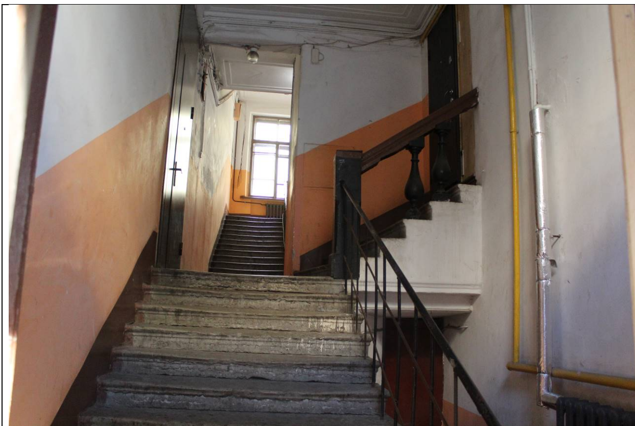
2. Дом В. И. Яковлева и В. Г. Васильева. 15-я линия В.О., дом 34. ЛК-1. Лестничные марши между 1, 2 и 3 этажами. Фото: эксперт А. А. Кононов, 19.04.2021.
