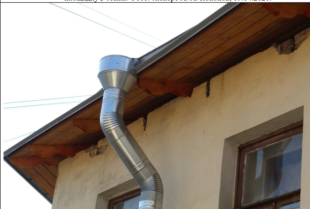
32. Дом В. И. Яковлева и В. Г. Васильева. 15-я линия В.О., дом 34. ЛК-1. Вид из окна межэтажной площадки 5-6 этажей на деревянные кобылки. Фото: эксперт А. А. Кононов, 19.04.2021.
