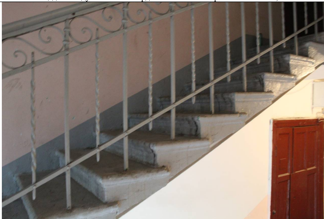
22. Дом В. И. Яковлева и В. Г. Васильева. 15-я линия В.О., дом 34. ЛК-2. Лестничное ограждение и ступени с валиком. Фрагмент марша между 5 этажом и чердаком. Фото: эксперт А. А. Кононов, 19.04.2021.
