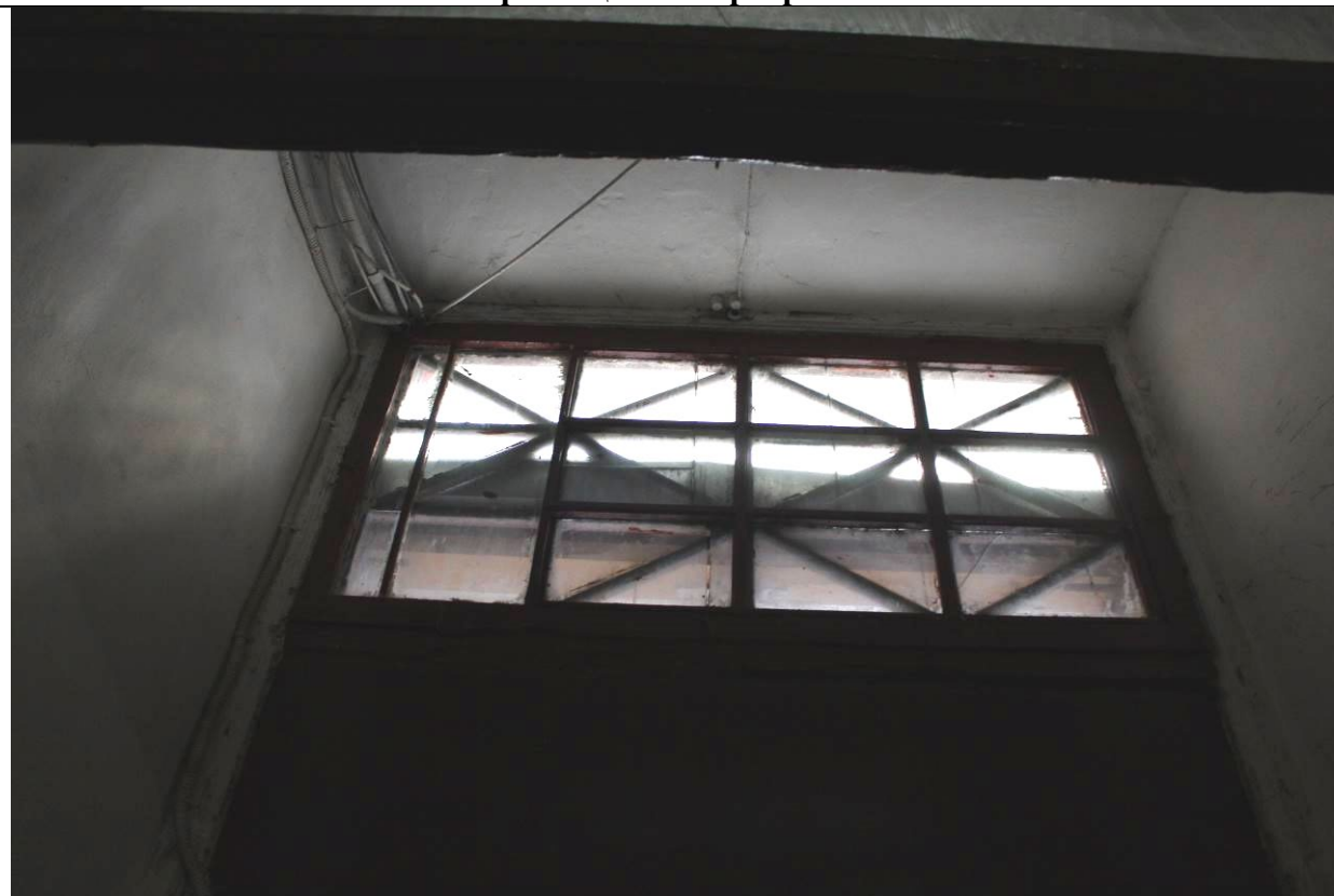
1. Дом В. И. Яковлева и В. Г. Васильева. 15-я линия В.О., дом 34. ЛК-2. Входная группа. Фрагмент. Заполнение дверной фрамуги. Фото: эксперт А. А. Кононов, 19.04.2021.
