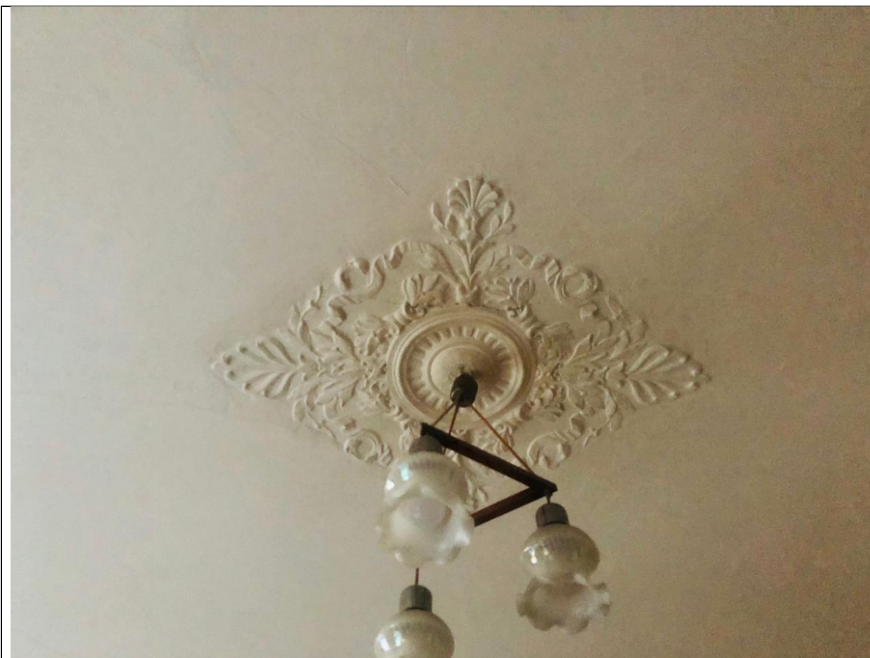
40. Дом В. И. Яковлева и В. Г. Васильева. 15-я линия В.О., дом 34. ЛК-1. Квартира №8, помещение площадью 19,3 кв. м. Розетка в центре плафона. Фото: эксперт А. А. Кононов, 19.04.2021.
