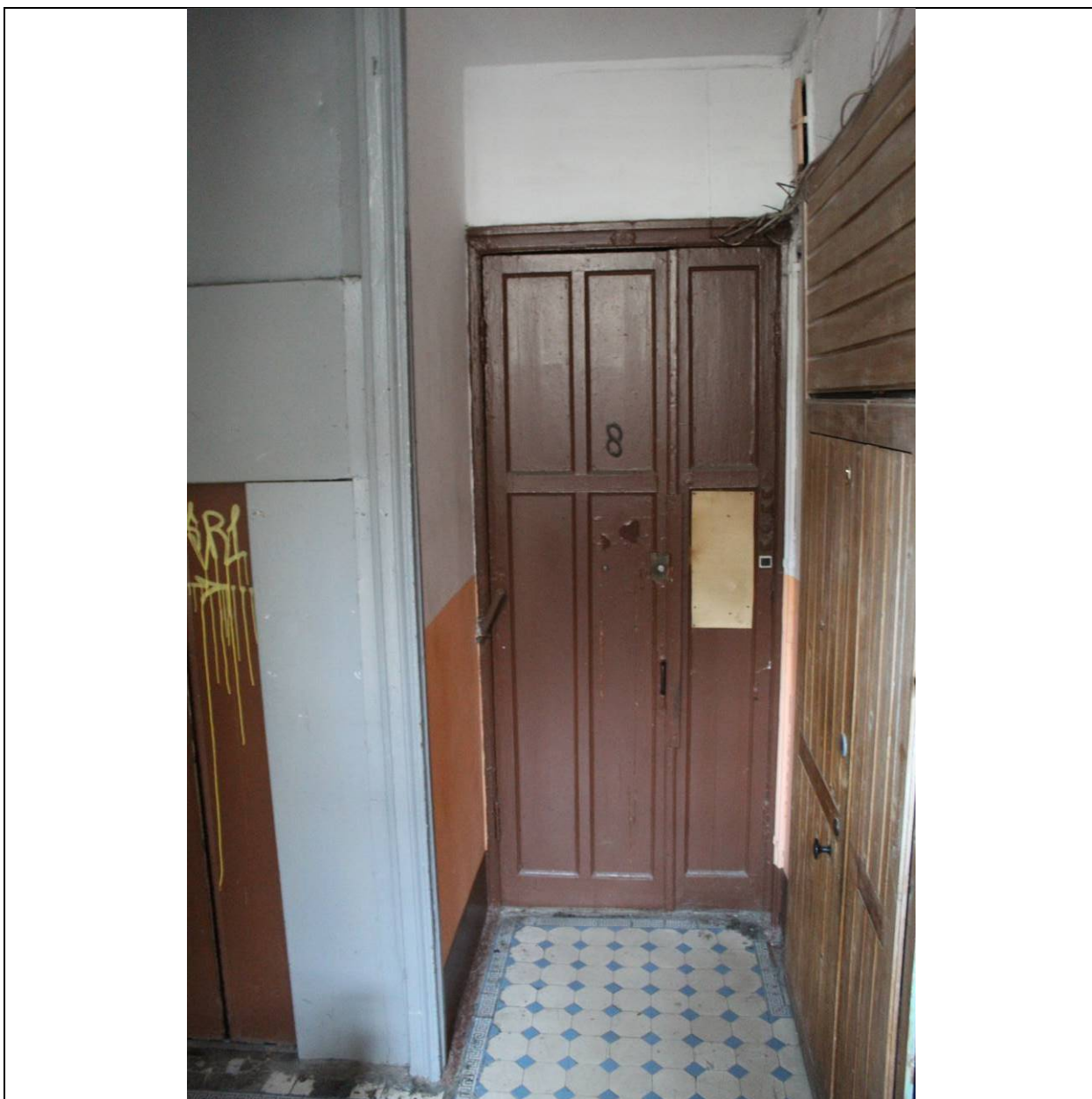
38. Дом В. И. Яковлева и В. Г. Васильева. 15-я линия В.О., дом 34. ЛК-1. Дверное заполнение квартиры на 4 этаже. Фото: эксперт А. А. Кононов, 19.04.2021.
