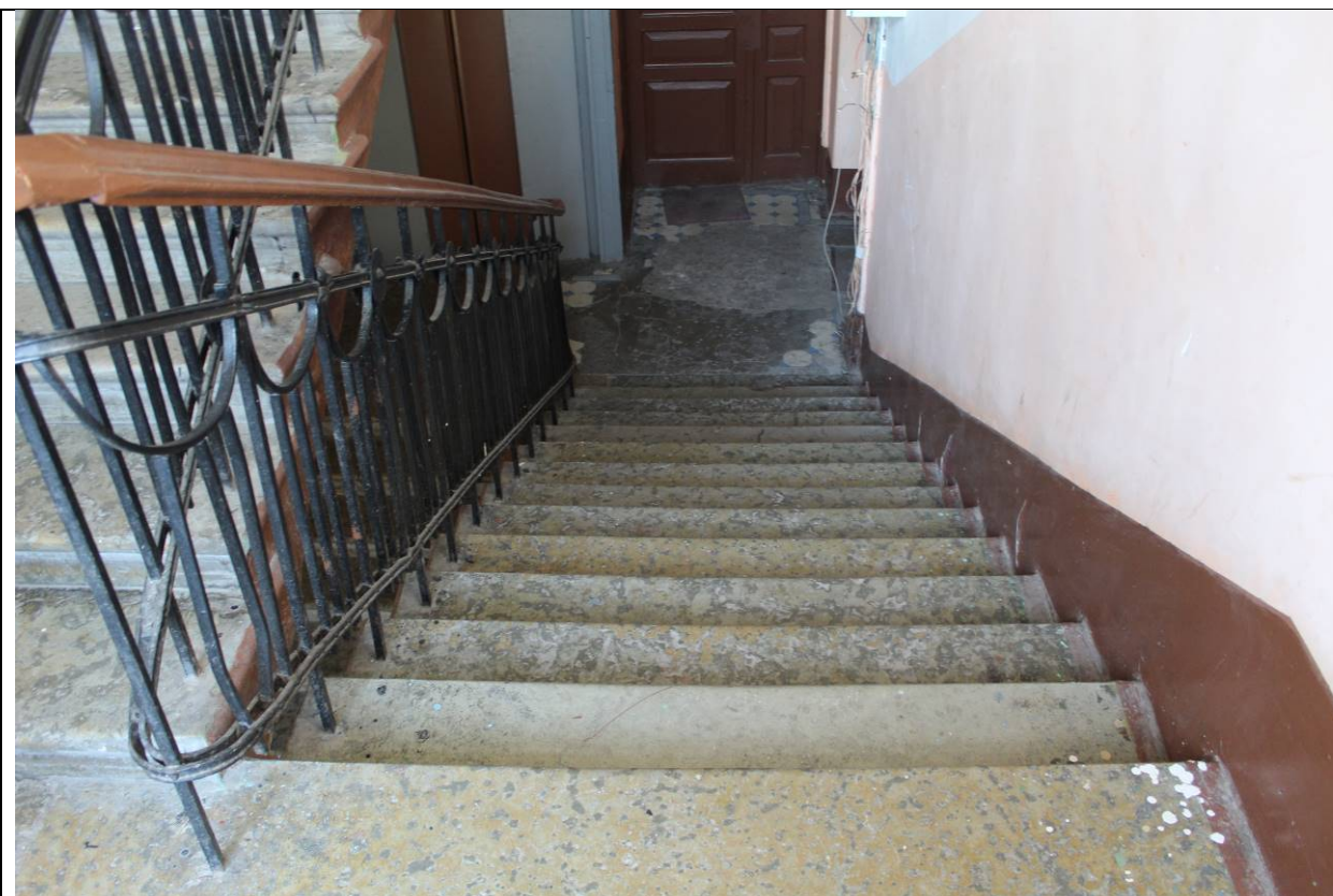
31. Дом В. И. Яковлева и В. Г. Васильева. 15-я линия В.О., дом 34. ЛК-1. Вид на площадку 5 этажа. Фото: эксперт А. А. Кононов, 19.04.2021.
