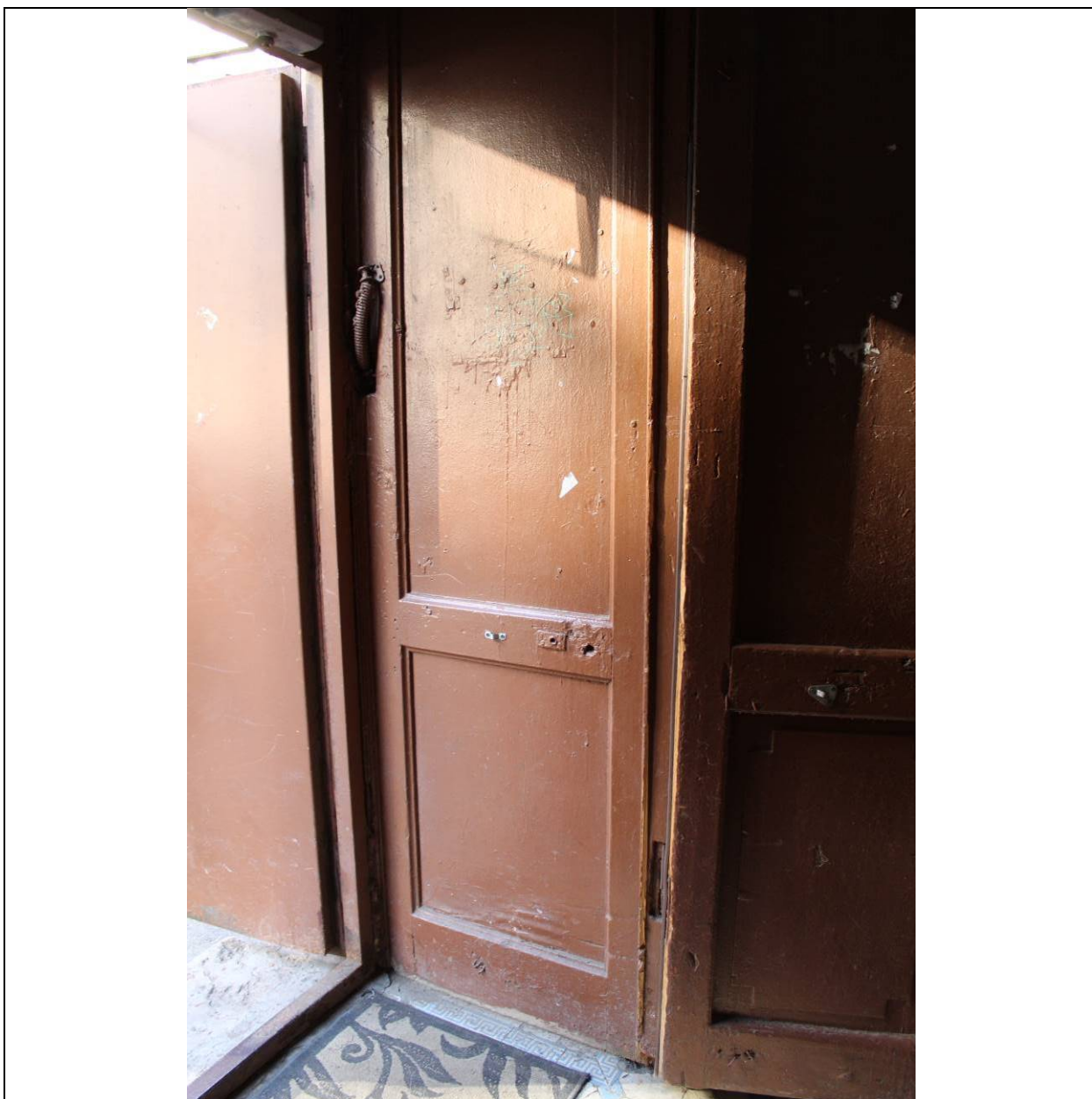
6. Дом В. И. Яковлева и В. Г. Васильева. 15-я линия В.О., дом 34. ЛК-1. Входная группа. Фрагмент. Фото: эксперт А. А. Кононов, 19.04.2021.
