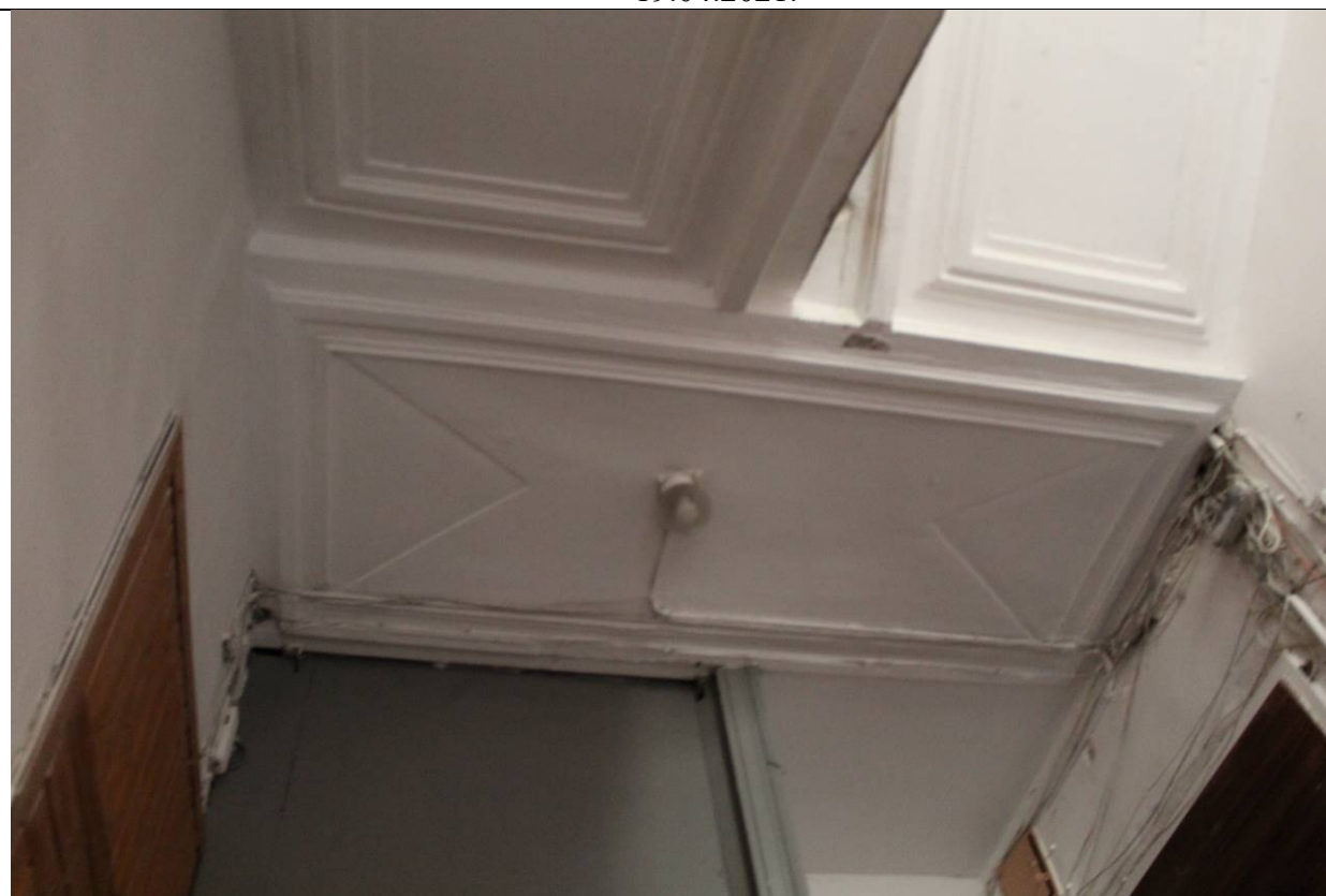
21. Дом В. И. Яковлева и В. Г. Васильева. 15-я линия В.О., дом 34. ЛК-1. Плафон лестничной площадки в уровне 3 этажа. Фото: эксперт А. А. Кононов, 19.04.2021.
