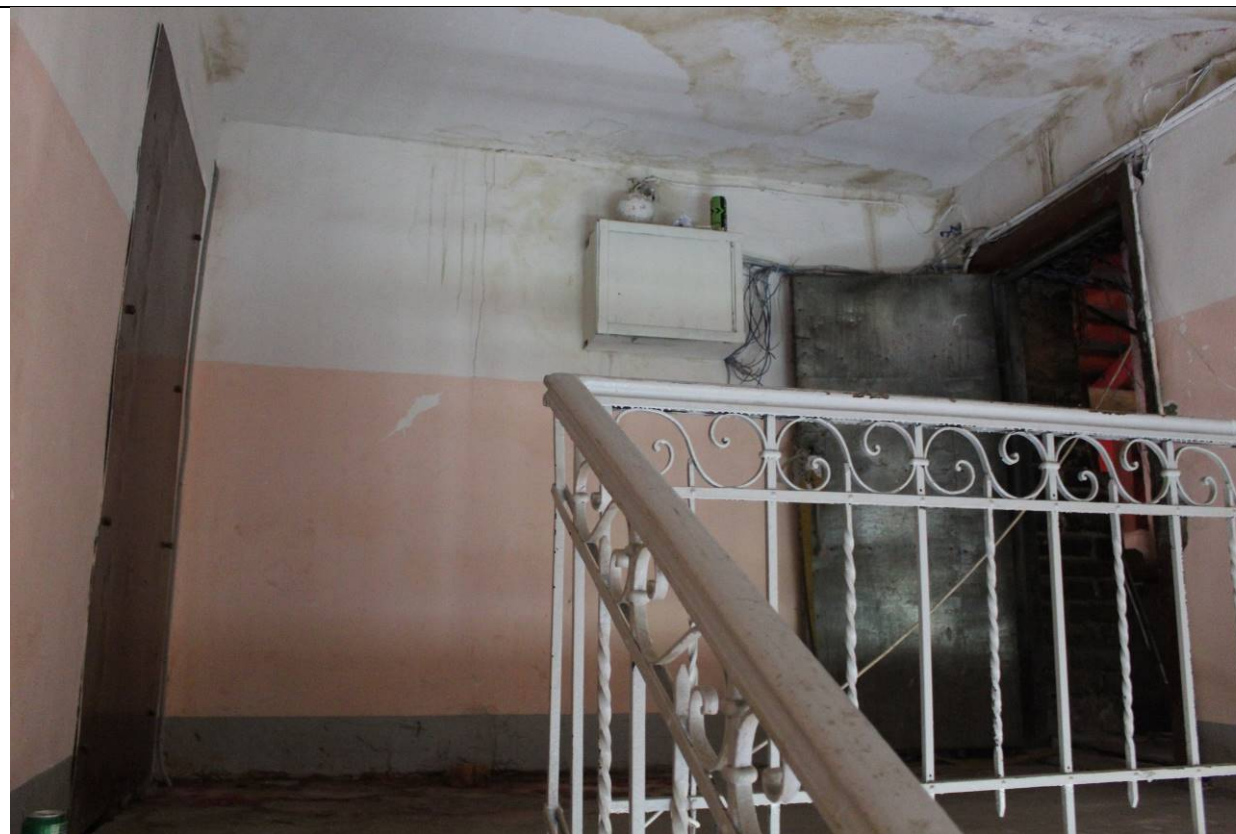
27. Дом В. И. Яковлева и В. Г. Васильева. 15-я линия В.О., дом 34. ЛК-2. Лестничная площадка чердака. Фото: эксперт А. А. Кононов, 19.04.2021.
