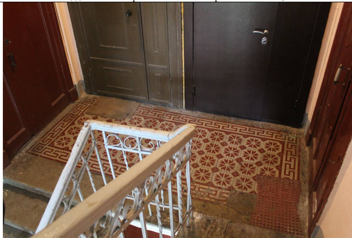
26. Дом В. И. Яковлева и В. Г. Васильева. 15-я линия В.О., дом 34. ЛК-2. Напольное покрытие лестничной площадки 5 этажа. Фото: эксперт А. А. Кононов, 19.04.2021.
