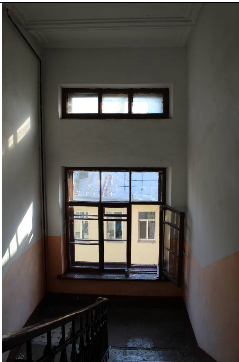
35. Дом В. И. Яковлева и В. Г. Васильева. 15-я линия В.О., дом 34. ЛК-1. Лестничная площадка между 5 и 6 этажом. Фото: эксперт А. А. Кононов, 19.04.2021.
