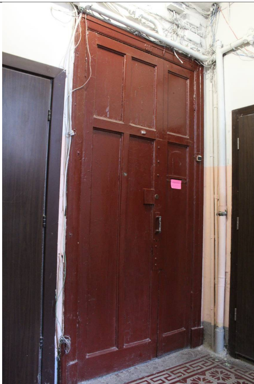
12. Дом В. И. Яковлева и В. Г. Васильева. 15-я линия В.О., дом 34. ЛК-2. Дверное заполнение квартиры на площадке 2 этажа. Фото: эксперт А. А. Кононов, 19.04.2021.
