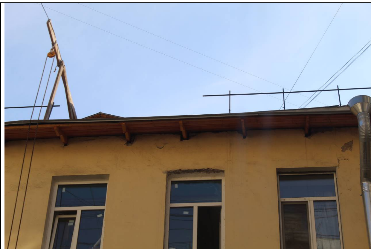
22. Дом В. И. Яковлева и В. Г. Васильева. 15-я линия В.О., дом 34. ЛК-1. Вид из окна межэтажной площадки 3-4 этажа на деревянные кобылки дворового корпуса. Фото: эксперт А. А. Кононов, 19.04.2021.
