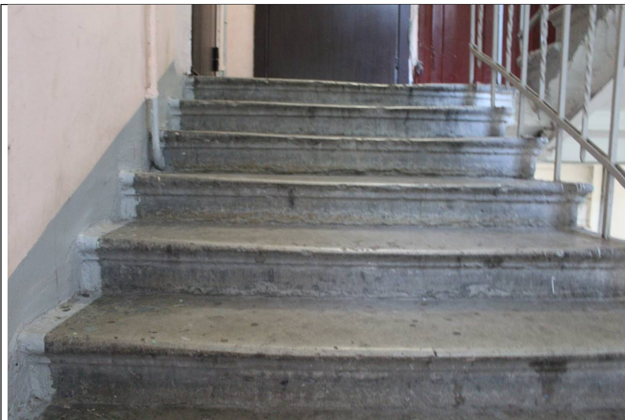
11. Дом В. И. Яковлева и В. Г. Васильева. 15-я линия В.О., дом 34. ЛК-2. Лестничный марш на 2 этажам. Ступени с валиком. Фото: эксперт А. А. Кононов, 19.04.2021.
