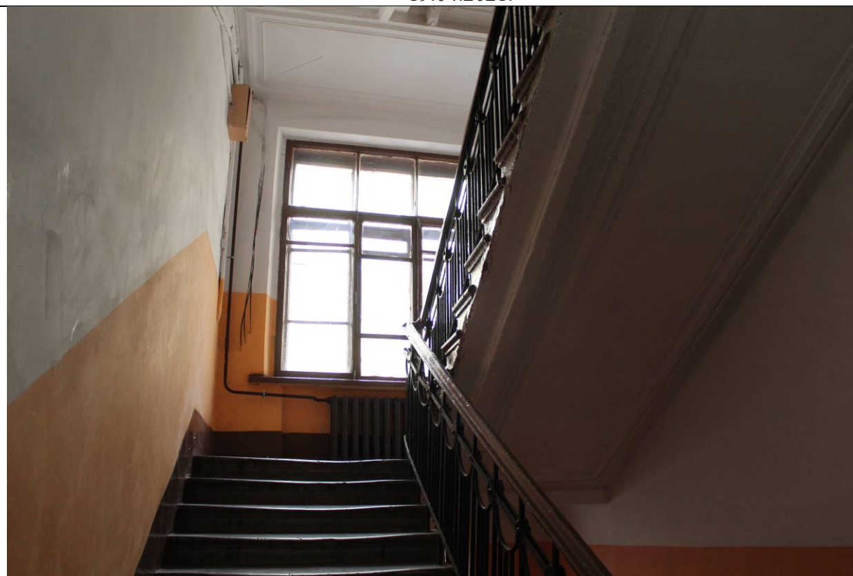
14. Дом В. И. Яковлева и В. Г. Васильева. 15-я линия В.О., дом 34. ЛК-1. Лестничные марши на 3 этаж. Фрагмент. Фото: эксперт А. А. Кононов, 19.04.2021.
