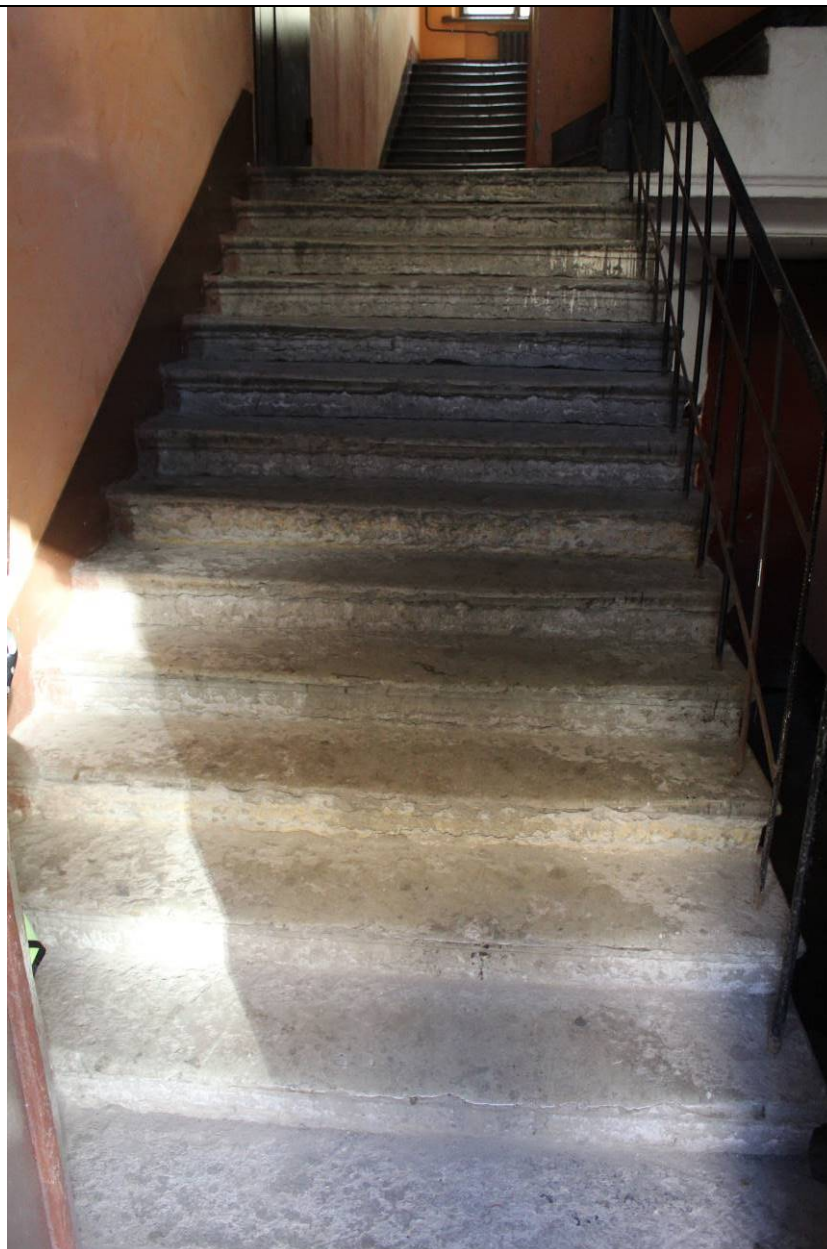
1. Дом В. И. Яковлева и В. Г. Васильева. 15-я линия В.О., дом 34. ЛК-1. Лестничной марш между 1 и 2 этажом. Фото: эксперт А. А. Кононов, 19.04.2021.
