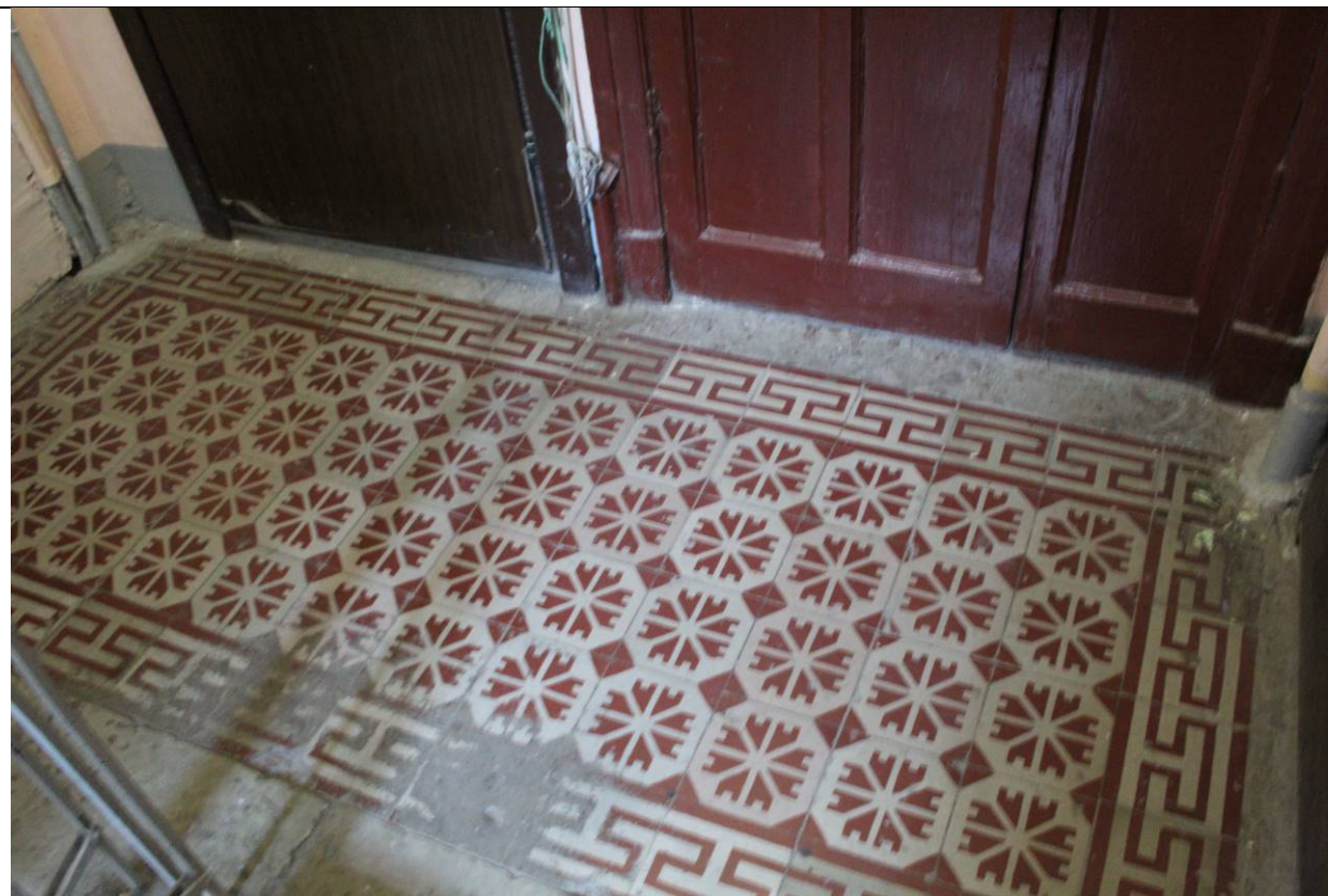
13. Дом В. И. Яковлева и В. Г. Васильева. 15-я линия В.О., дом 34. ЛК-2. Напольное покрытие площадки 2 этажа. Фото: эксперт А. А. Кононов, 19.04.2021.
