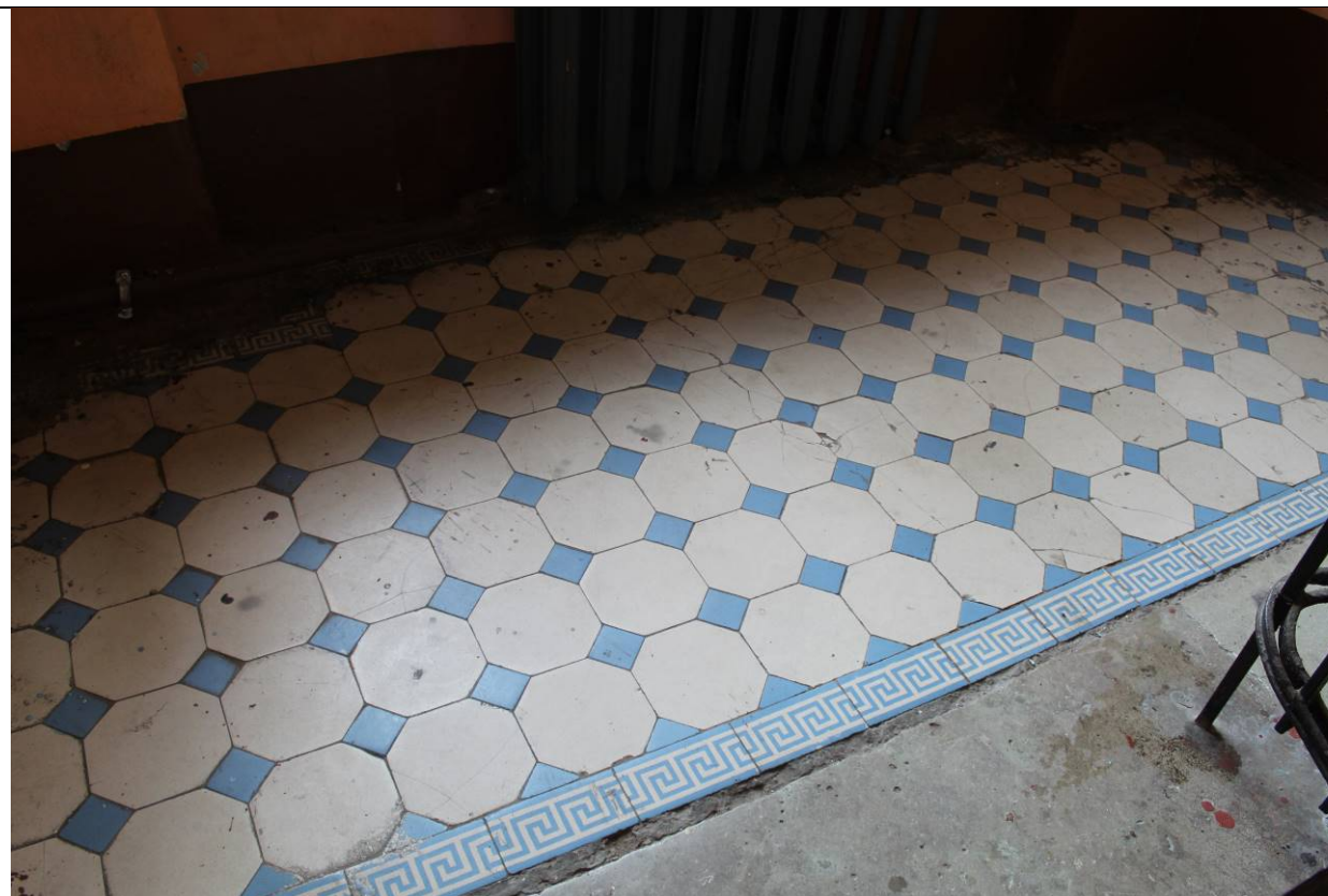
26. Дом В. И. Яковлева и В. Г. Васильева. 15-я линия В.О., дом 34. ЛК-1. Напольное покрытие площадки между 4 и 5 этажами. Фото: эксперт А. А. Кононов, 19.04.2021.
