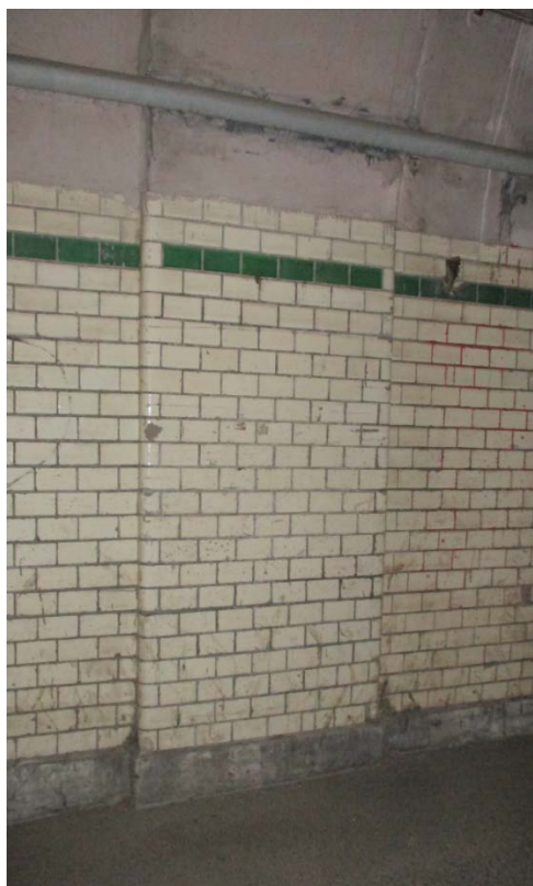
11. Санкт-Петербург, Василеостровский район, 11 линия В.О., дом 20, литера А. Лицевой корпус, воротный проезд. Облицовка кафельной плиткой.01.06.21
