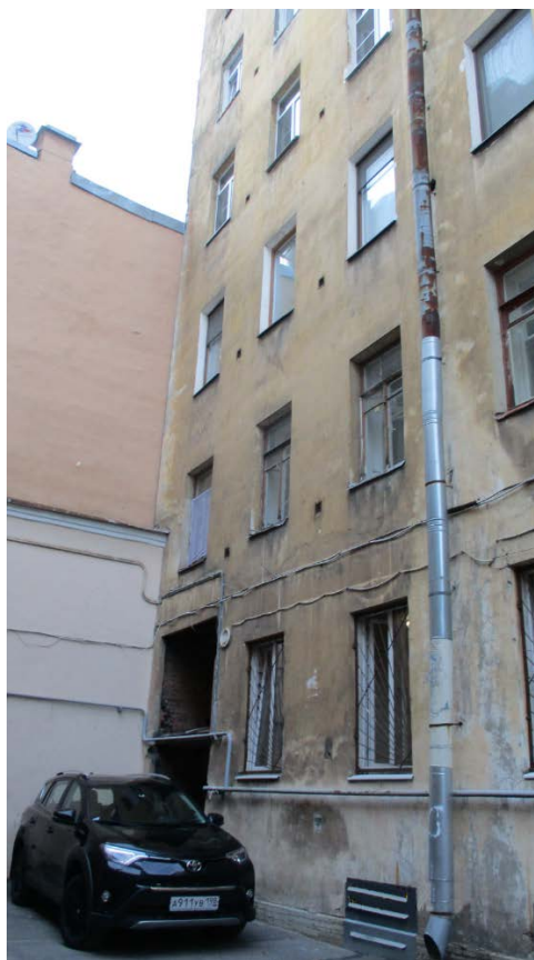
24. Санкт-Петербург, Василеостровский район, 11 линия В.О., дом 20, литера А. Западный флигель. Фрагмент западного фасада. 19.04.21
