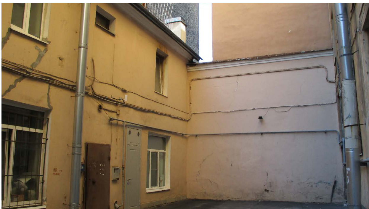
2. Санкт-Петербург, Василеостровский район, 11 линия В.О., дом 20, литера Б. Фрагмент восточного фасада. Фото: 01.06.21
