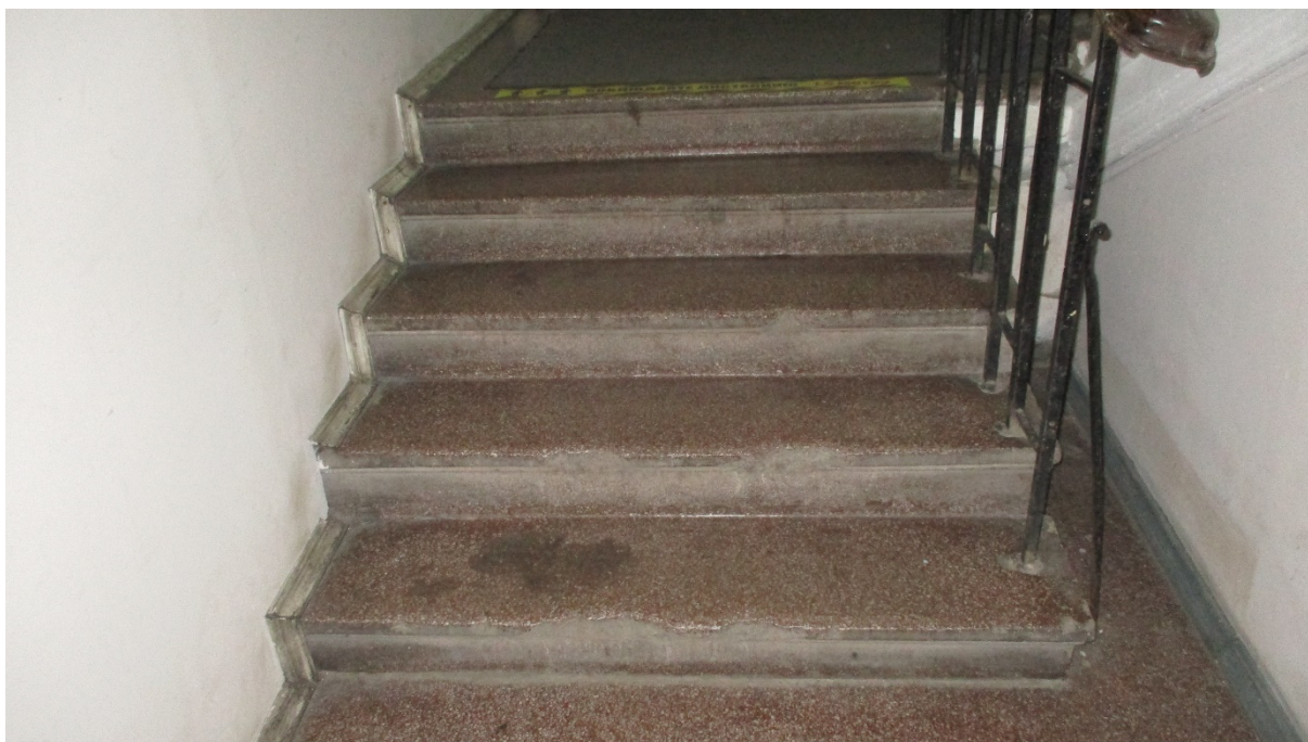
5. г.Санкт-Петербург, Кондратьевский проспект, дом 44, литера А. Интерьер. 1 этаж. Лестница восточного объема (центральная).
