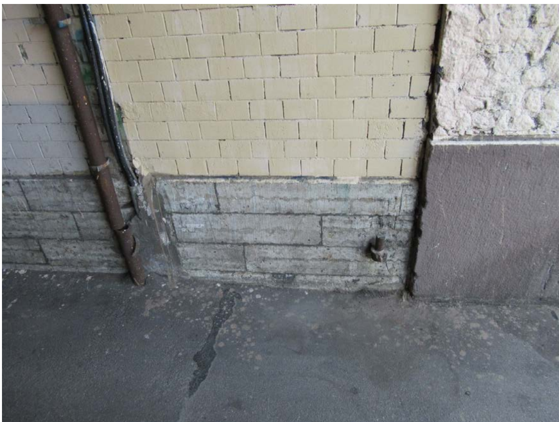
29. 15-я линия В.О., 70. Дом М.М. Кудрявцева. Фрагмент отделки стенки и цоколя проезда лицевого корпуса.
