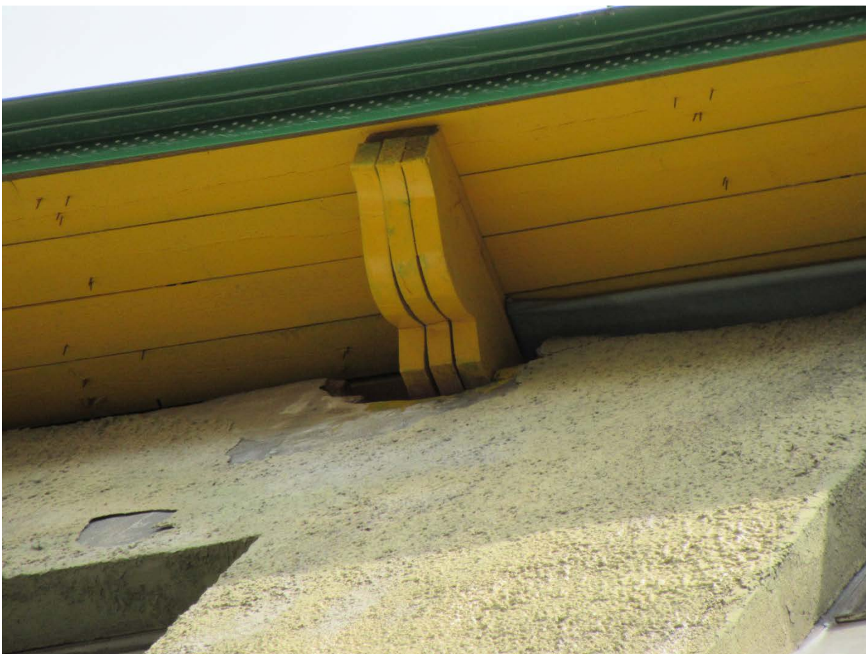
55. 15-я линия В.О., 70. Дом М.М. Кудрявцева. Фрагмент свеса кровли с деревянной подшивкой на кобылках юго-восточного фасада.
