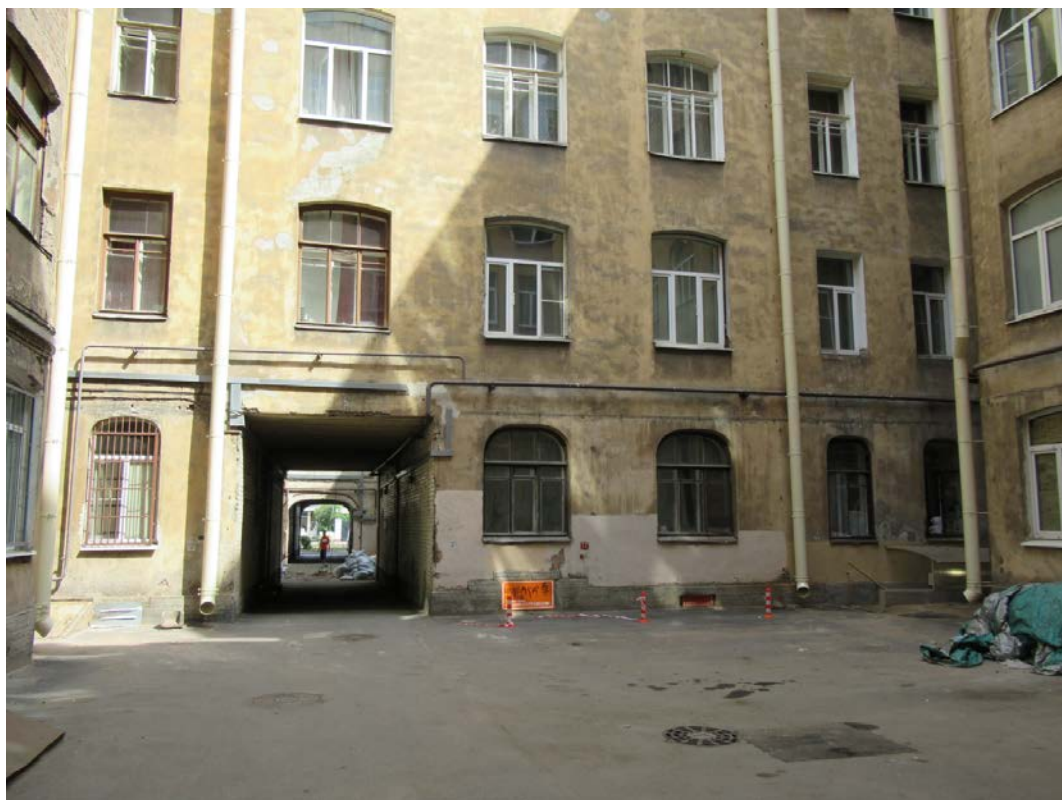
50. 15-я линия В.О., 70. Дом М.М. Кудрявцева. Нижняя часть северо-восточного фасада западного двора.
