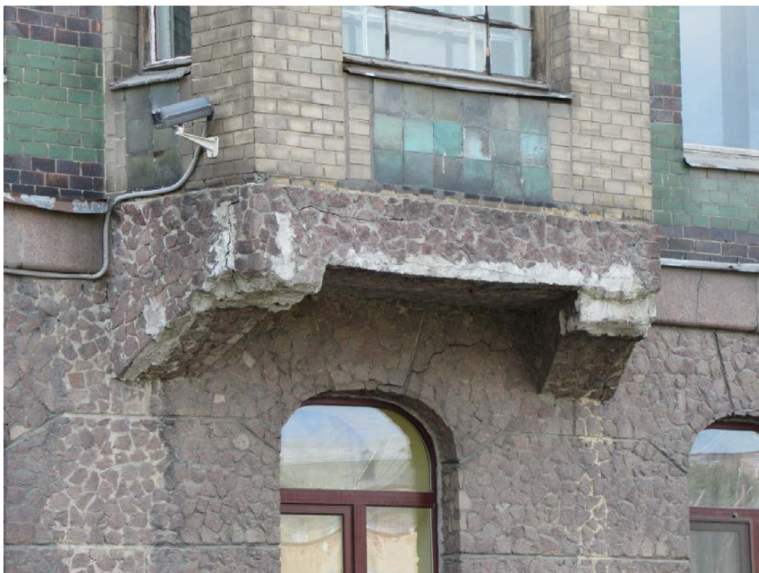
23. 15-я линия В.О., 70. Дом М.М. Кудрявцева. Нижняя часть северного эркера лицевого фасада.
