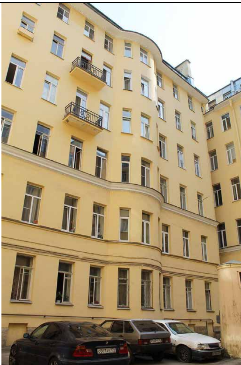
26. Дом В. И. Упатчева. 12 линия, д. 13. Фасад юго-восточного дворового корпуса. Фрагмент. Фото эксперта А. А. Кононова. 19.04.2021.
