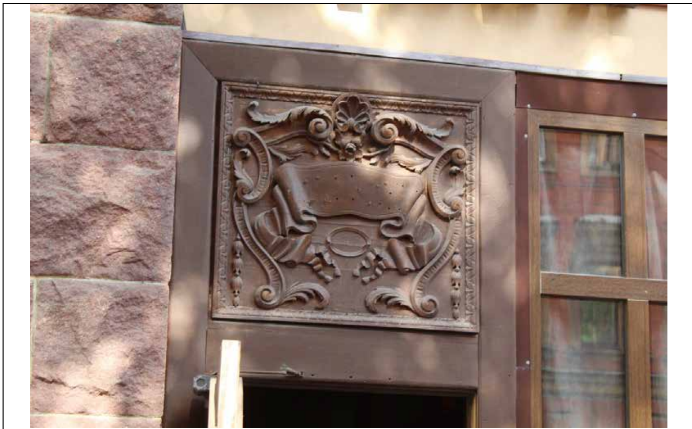
13. Дом В. И. Упатчева. 12 линия, д. 13. Лицевой фасад. Дверное заполнение (южная часть здания) в уровне 1 этажа. Фото эксперта А. А. Кононова. 19.04.2021.
