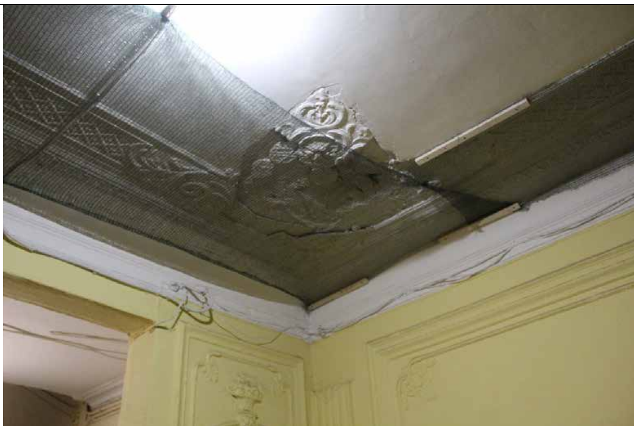
10. Дом В. И. Упатчева. 12 линия, д. 13. Лицевой корпус. Интерьеры. ЛК-2. Вестибюль. Оформление плафона. Фрагмент. Фото эксперта А. А. Кононова. 19.04.2021.
