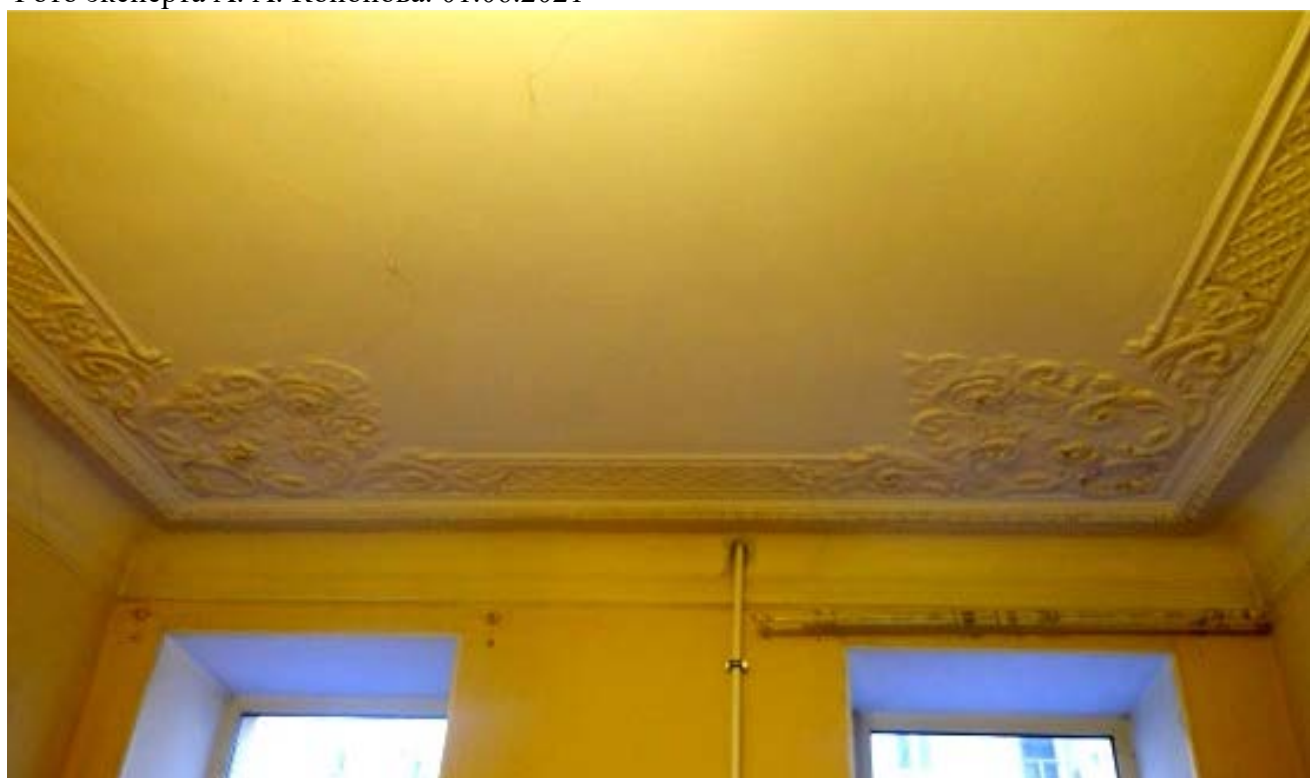
8. Дом В. И. Упатчева. 12 линия, д. 13. Интерьер квартиры № 22 комнаты № 3. Потолочная лепнина. Угловые композиции. Фото эксперта А. А. Кононова. 01.06.2021
