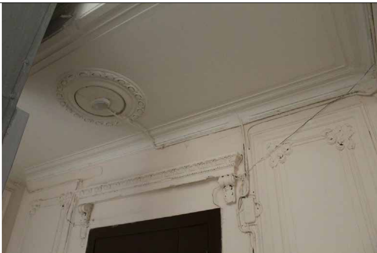
30. Дом В. И. Упатчева. 12 линия, д. 13. Лицевой корпус. Интерьеры. ЛК-1. Оформление стен площадки между 4 и 5 этажами. Фото эксперта А. А. Кононова. 19.04.2021.
