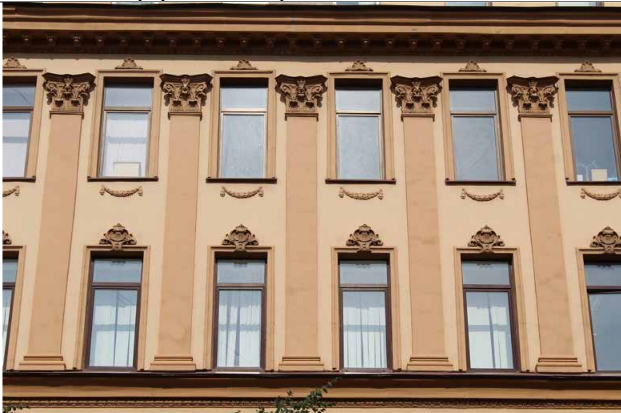
6. Дом В. И. Упатчева. 12 линия, д. 13. Лицевой фасад. Фрагмент плоскости фасада между эркерами. Оформление оконных проемов. Фото эксперта А. А. Кононова. 19.04.2021.
