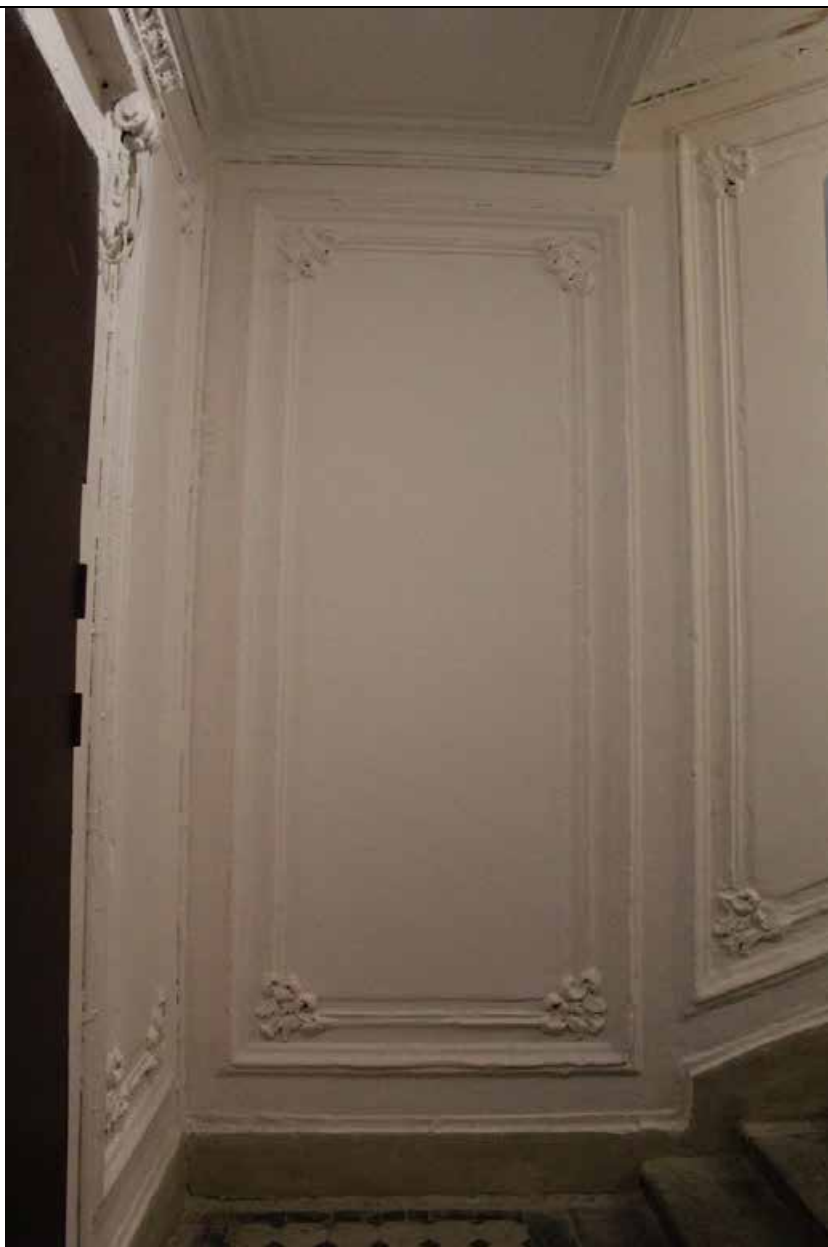
27. Дом В. И. Упатчева. 12 линия, д. 13. Лицевой корпус. Интерьеры. ЛК-1. Оформление стен площадки между 3 и 4 этажами. Фото эксперта А. А. Кононова. 19.04.2021.
