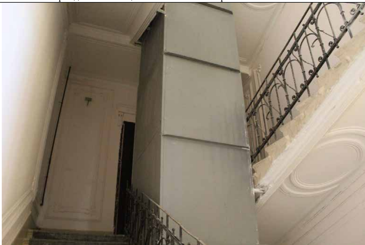
19. Дом В. И. Упатчева. 12 линия, д. 13. Лицевой корпус. Интерьеры. ЛК-1. Лестничные марши между 2 и 3 этажами. Фото эксперта А. А. Кононова. 19.04.2021.
