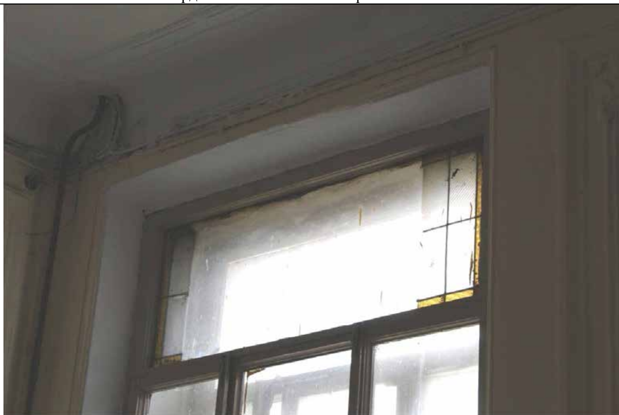
36. Дом В. И. Упатчева. 12 линия, д. 13. Лицевой корпус. Интерьеры. ЛК-2. Оконное заполнение мансардного этажа. Витраж. Фото эксперта А. А. Кононова. 19.04.2021.
