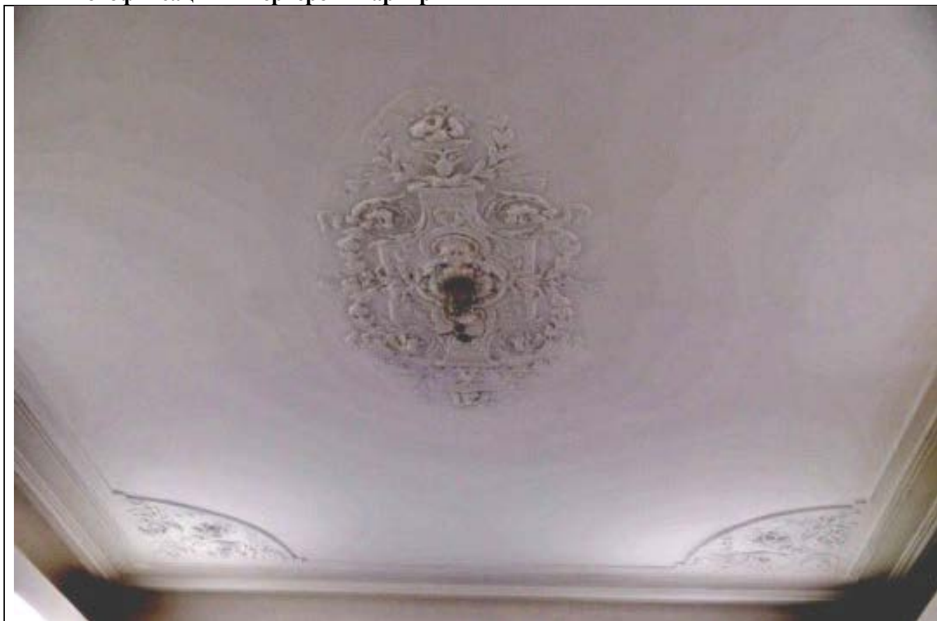
1. Дом В. И. Упатчева. 12 линия, д. 13. Интерьер квартиры № 22 комнаты № 2. Потолочная лепнина. Фото эксперта А. А. Кононова. 01.06.2021
