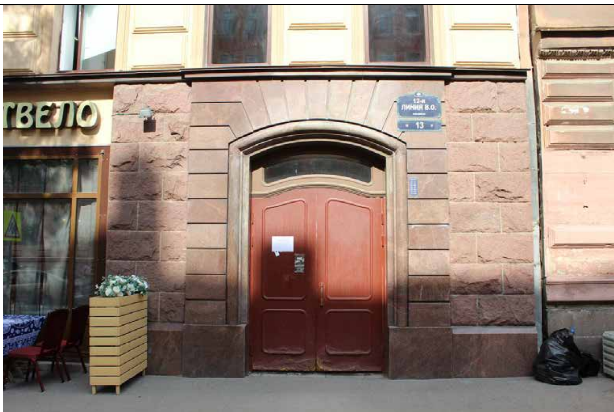
17. Дом В. И. Упатчева. 12 линия, д. 13. Лицевой фасад. Дверное заполнение (в северной части здания) в уровне 1 этажа. Фото эксперта А. А. Кононова. 19.04.2021.
