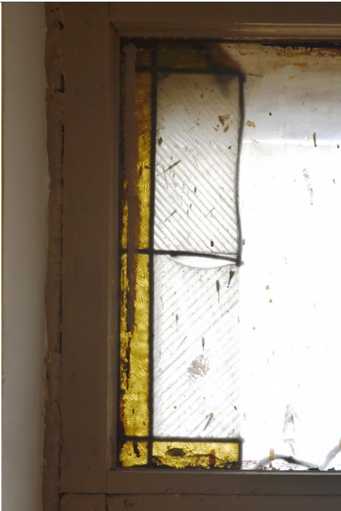
149. Дом В.И. Упатчева. Фрамуга окна 7 этажа. Фрагмент. Источник: Проект «Витражи СПб. Инвентаризация 2019-2020».
