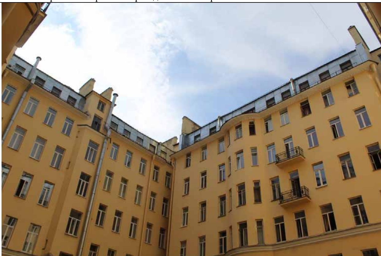
39. Дом В. И. Упатчева. 12 линия, д. 13. Фасад северо-западного и северо-восточного дворового корпуса. Фрагмент. Фото эксперта А. А. Кононова. 19.04.2021.
