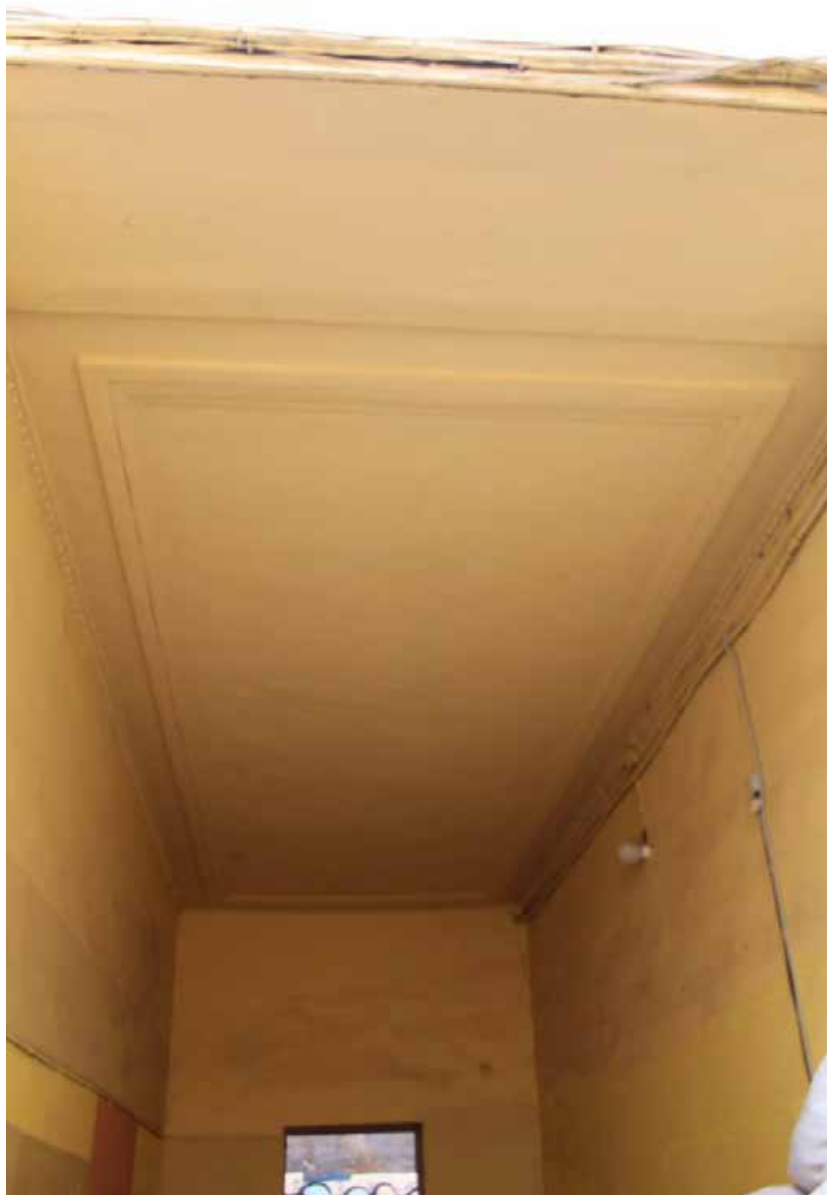
37. Дом В. И. Упатчева. 12 линия, д. 13. Фасад северо-восточного дворового корпуса. Фрагмент. Арочный проезд. Фото эксперта А. А. Кононова. 19.04.2021.
