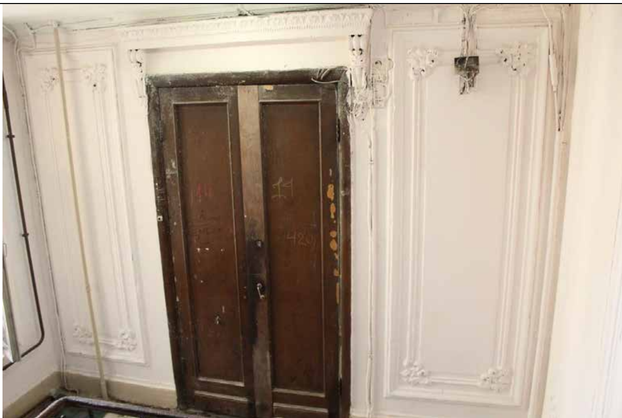
32. Дом В. И. Упатчева. 12 линия, д. 13. Лицевой корпус. Интерьеры. ЛК-1. Площадка в уровне 5 этажа. Фото эксперта А. А. Кононова. 19.04.2021.
