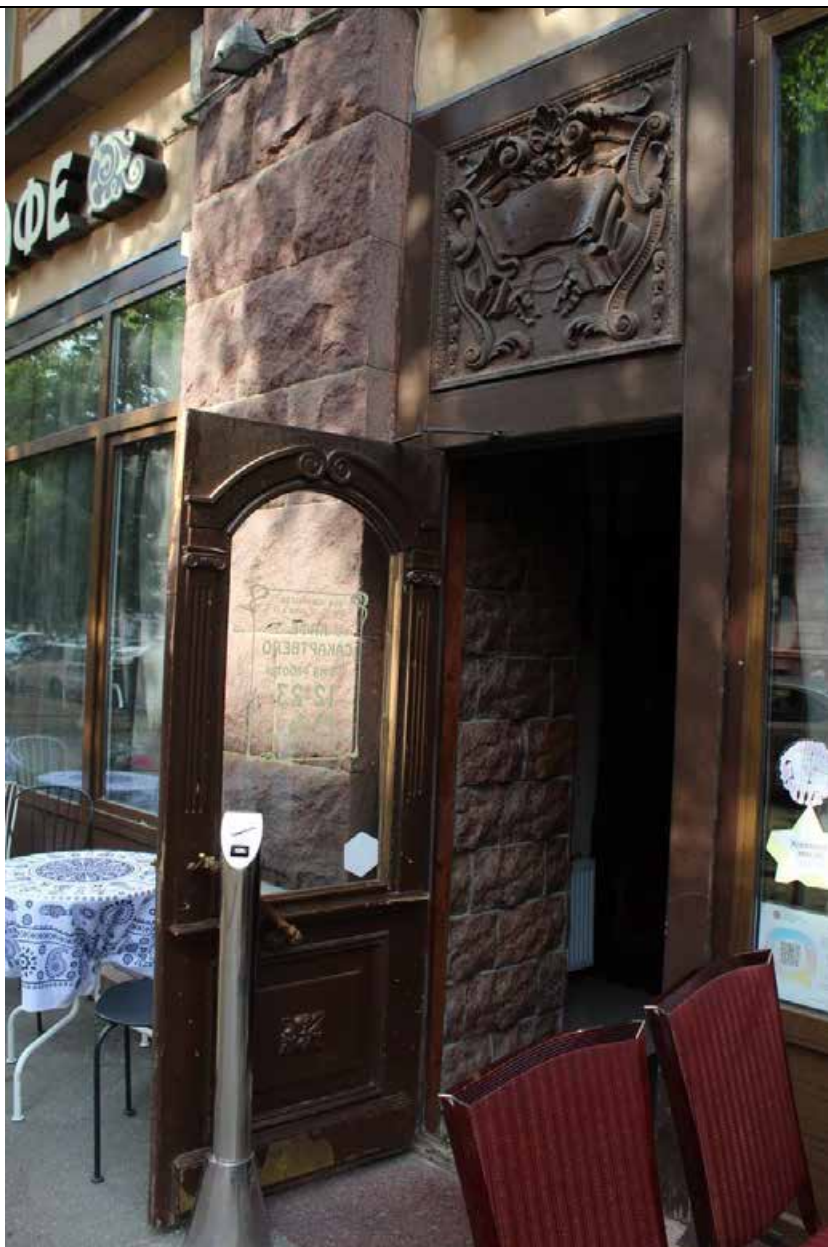
15. Дом В. И. Упатчева. 12 линия, д. 13. Лицевой фасад. Дверное заполнение (южная часть здания) в уровне 1 этажа. Фото эксперта А. А. Кононова. 01.06.2021.
