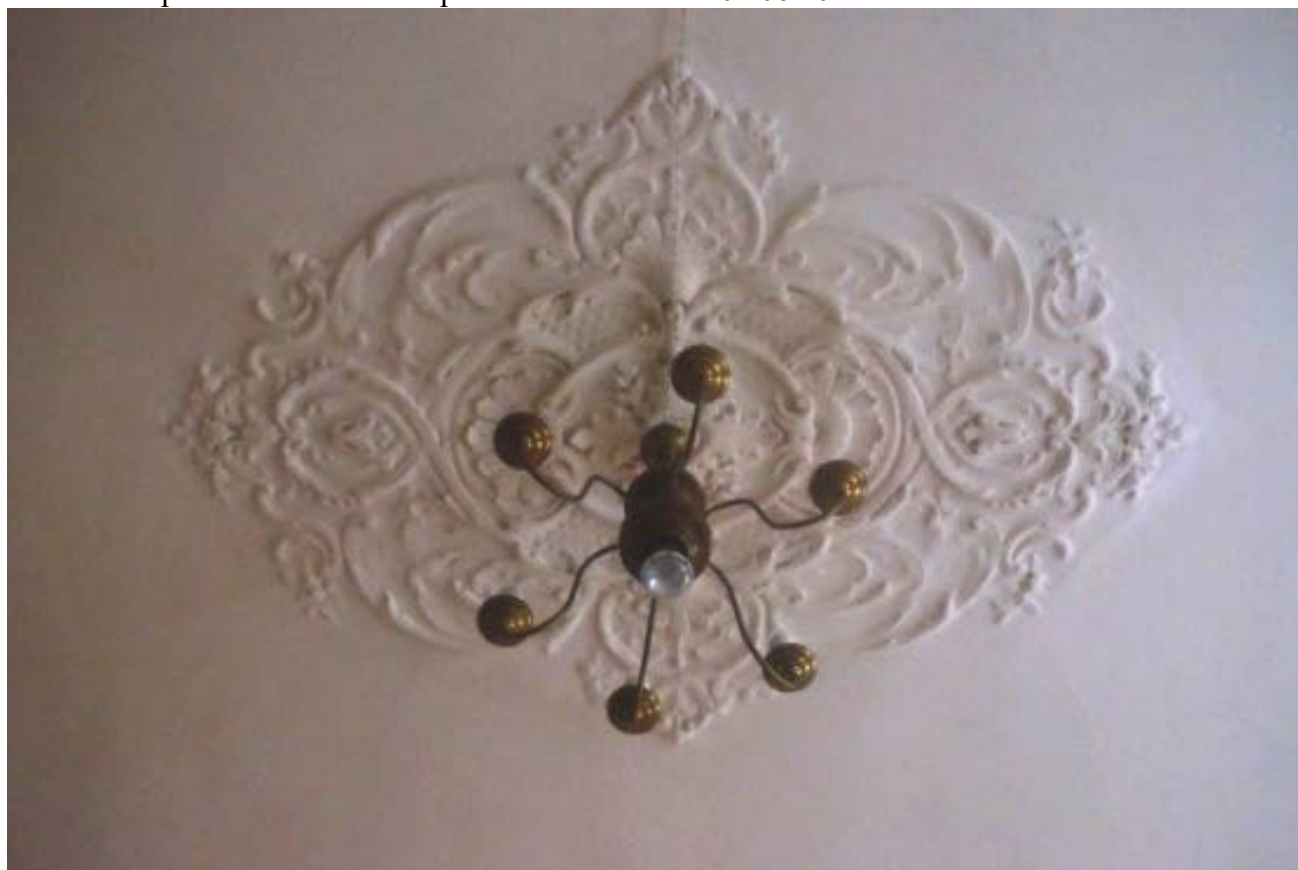
10. Дом В. И. Упатчева. 12 линия, д. 13. Интерьер квартиры № 22 комнаты № 3. Потолочная лепнина. Центральная розетка. Фото эксперта А. А. Кононова. 01.06.2021
