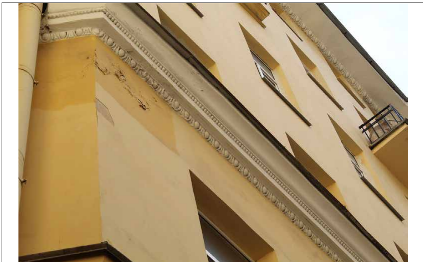
33. Дом В. И. Упатчева. 12 линия, д. 13. Фасад юго-восточного дворового корпуса. Фрагмент. Фото эксперта А. А. Кононова. 19.04.2021.
