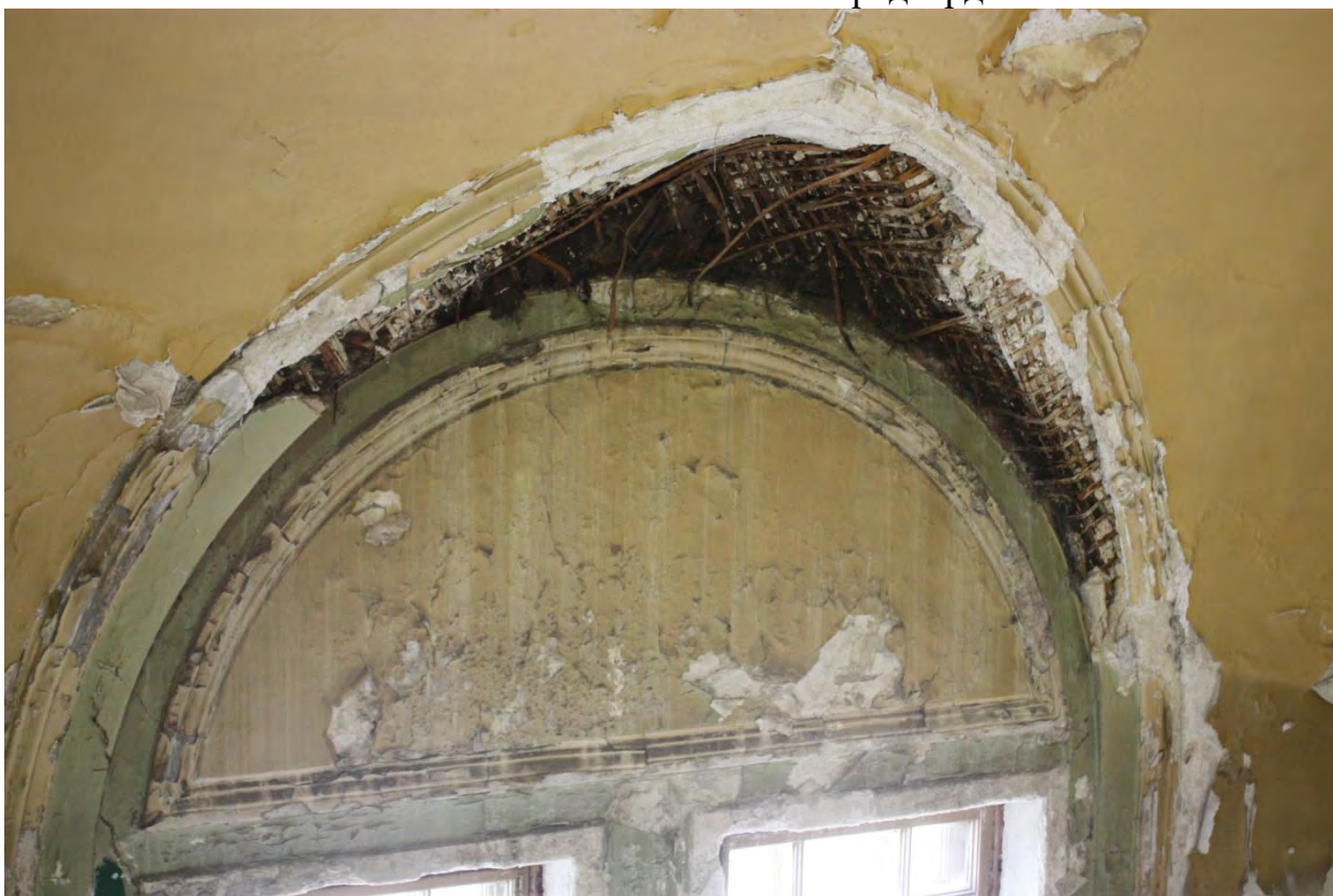
Фото 125. Разрушение деревянной подшивки.
