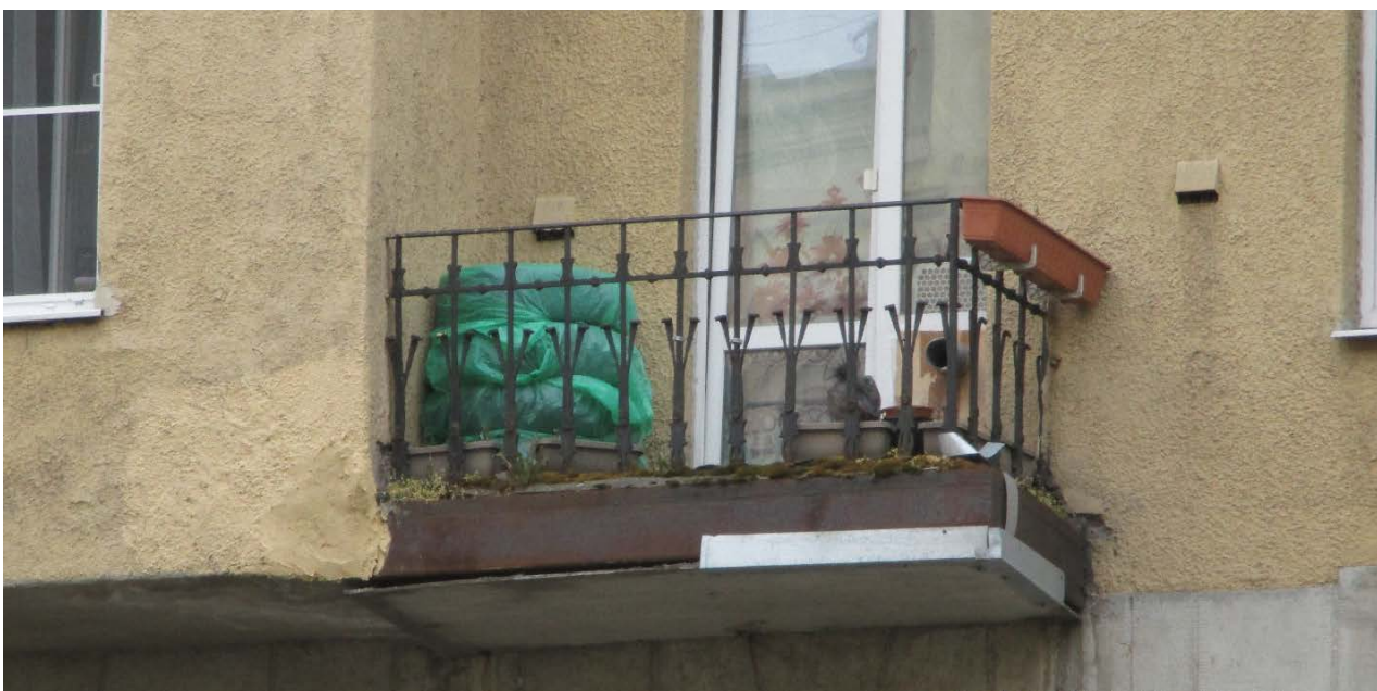
8. Санкт-Петербург. 11 линия, д.48. Фрагмент лицевого фасада. Балкон в уровне 3 этажа.
