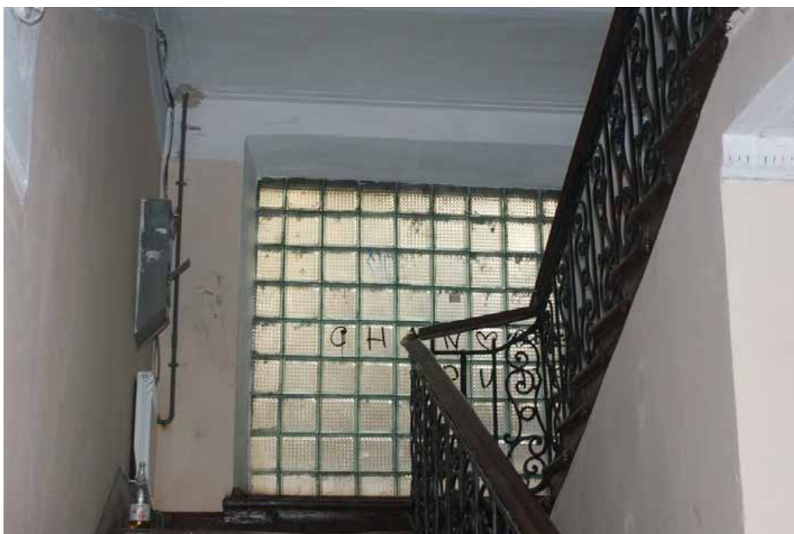
Фото 47. Лестница № 2. Площадка м/у 1-м и 2-м этажом. Съемка 19.04.2021 г. Кириков Б. М.
