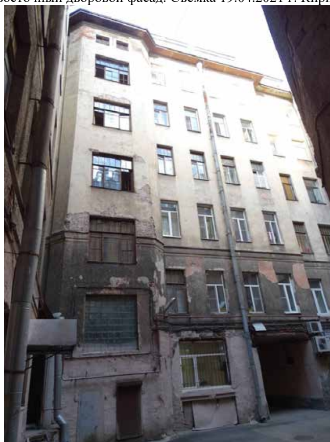
Фото 36. Здание по адресу: г. Санкт-Петербург, 11-я линия В. О., 34/47, литера А. Восточный дворовой фасад. Съемка 19.04.2021 г. Кириков Б. М.
