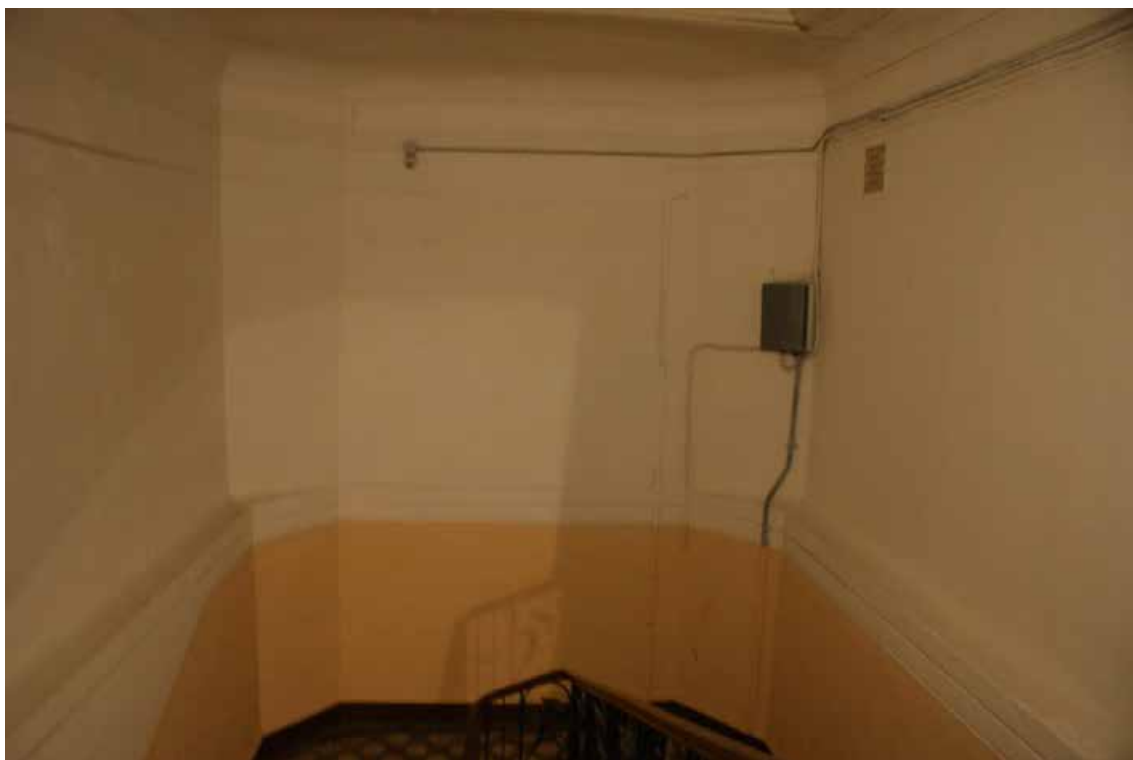
Фото 33. Лестница № 1. Площадка м/у 6-м и чердачным этажом. Съемка 19.04.2021 г. Кириков Б. М.
