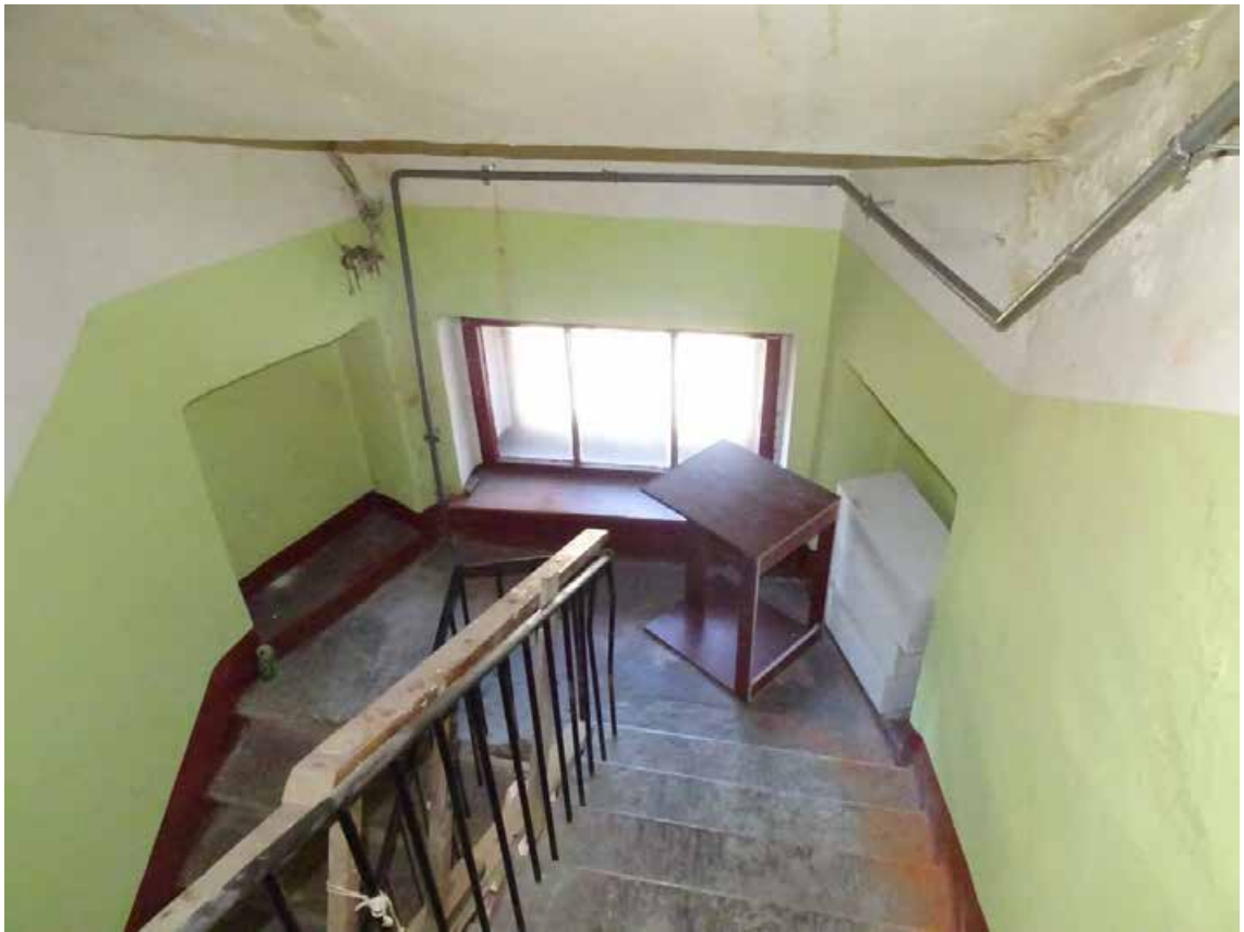
Фото 145. Лестница № 4. Площадка м/у 6-м и чердачным этажом. Съемка 19.04.2021 г. Кириков Б. М.
