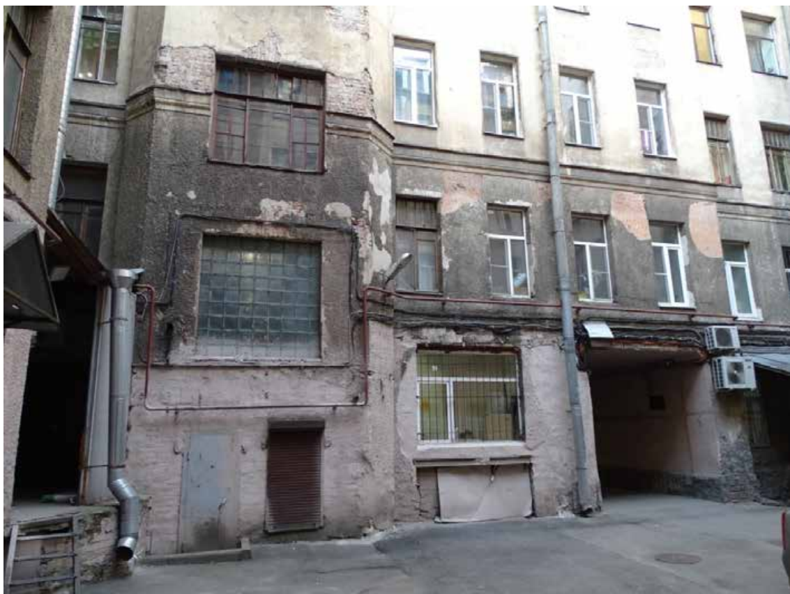
Фото 37. Здание по адресу: г. Санкт-Петербург, 11-я линия В. О., 34/47, литера А. Фрагмент восточного дворового фасада. Съемка 19.04.2021 г. Кириков Б. М.
