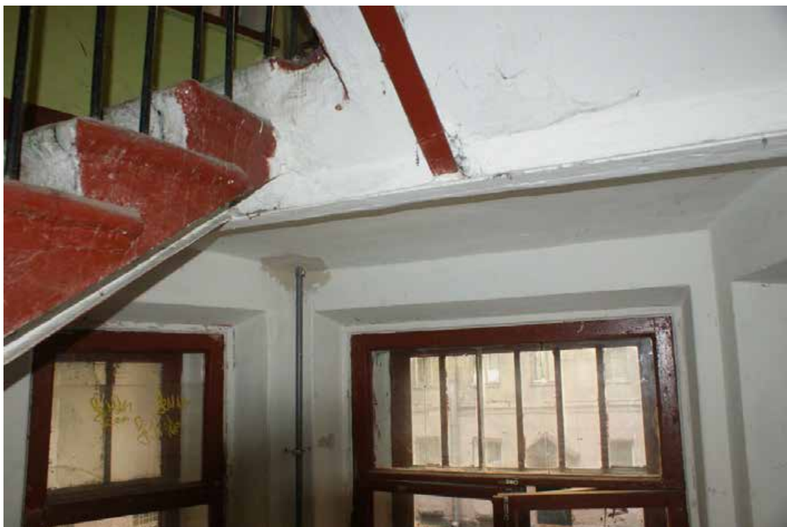
Фото 125. Лестница № 4. Площадка м/у 1-м и 2-м этажом. Съемка 19.04.2021 г. Кириков Б. М.
