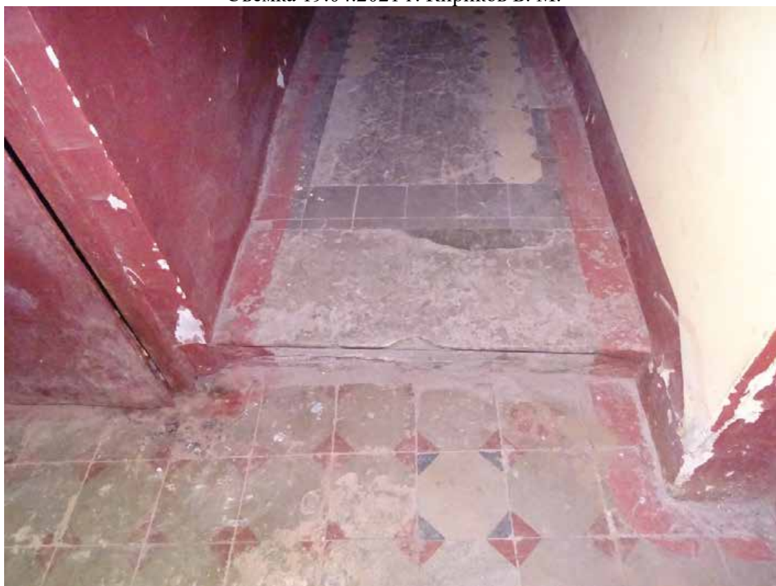
Фото 74. Лестница № 3. 1-й этаж. Покрытие пола. Ступень. Съемка 19.04.2021 г. Кириков Б. М.
