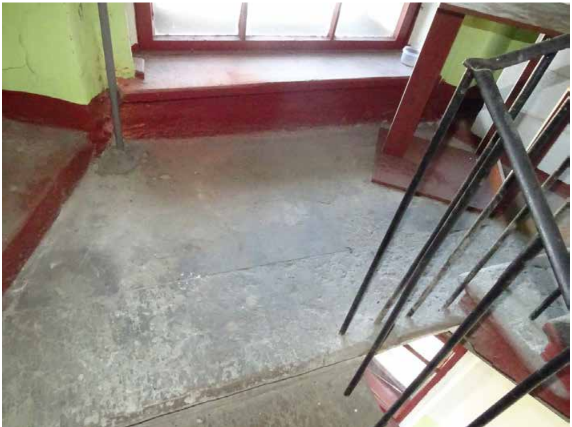
Фото 146. Лестница № 4. Площадка м/у 6-м и чердачным этажом. Съемка 19.04.2021 г. Кириков Б. М.
