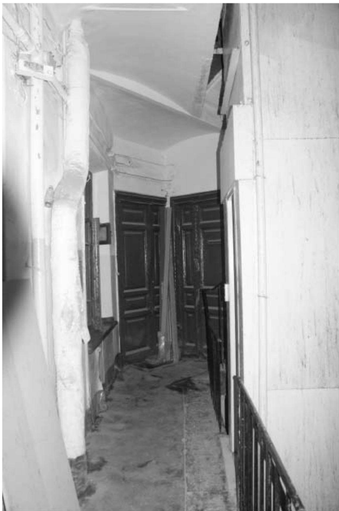
Фото 158. Лестница № 8. Площадка 2-го этажа. Съёмка 19.04.2021 г. Трушковский В.Э.
