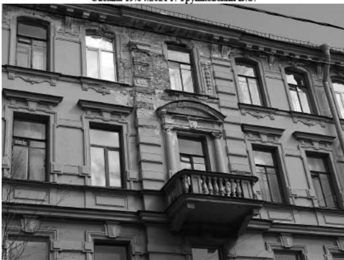
Фото 12. Здание по адресу: г. Санкт-Петербург, Тучков пер., 11/5, литера А. Фрагмент лицевого фасада со стороны Тучкова пер. Балкон. 4-й, 5-й этаж. Съемка 19.04.2021 г. Трушковский В.Э.
