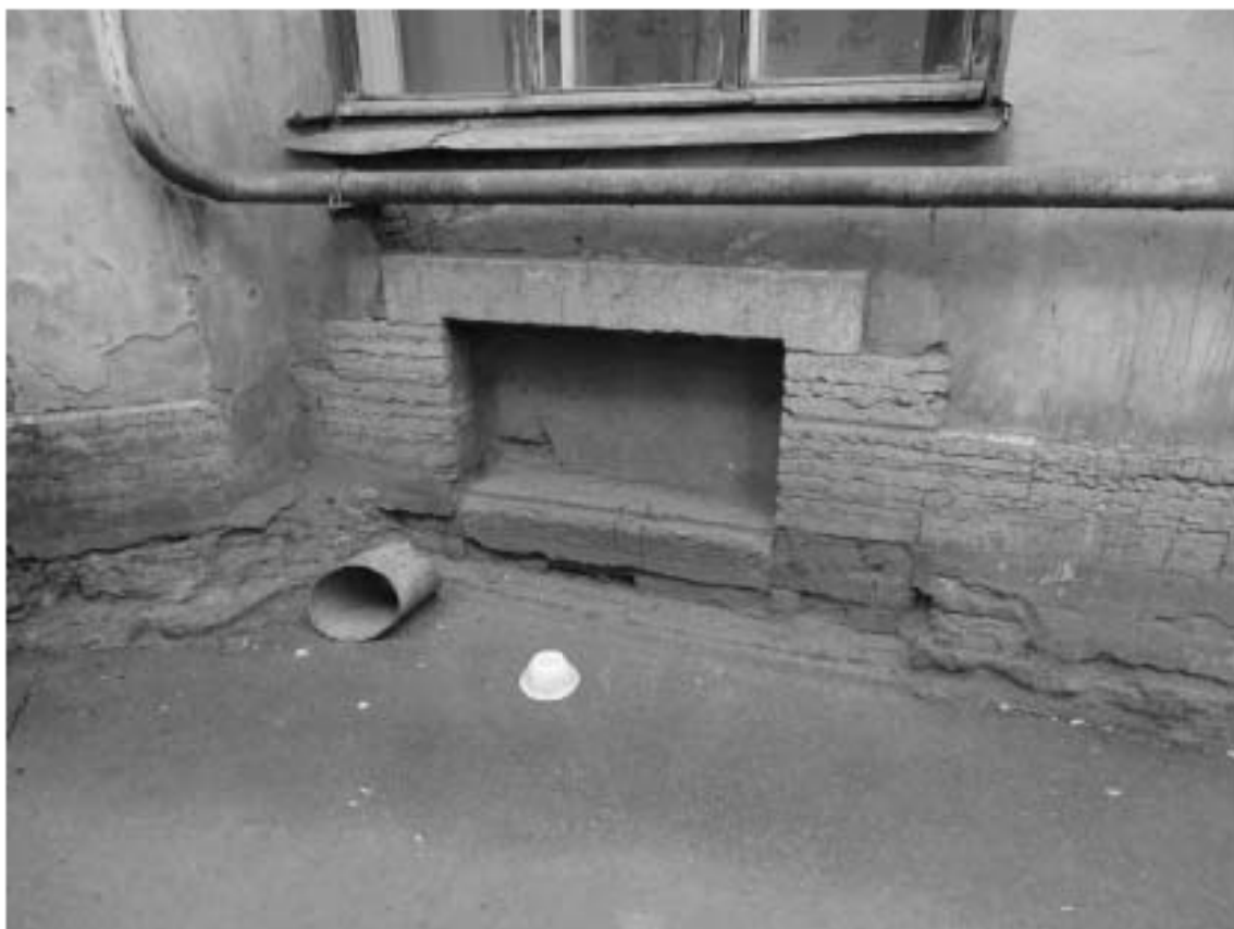
Фото 28. Здание по адресу: г. Санкт-Петербург, Тучков пер., 11/5, литера А. Дворовой фасад. Цоколь из известняка. Съемка 19.04.2021 г. Трушковский В.Э
