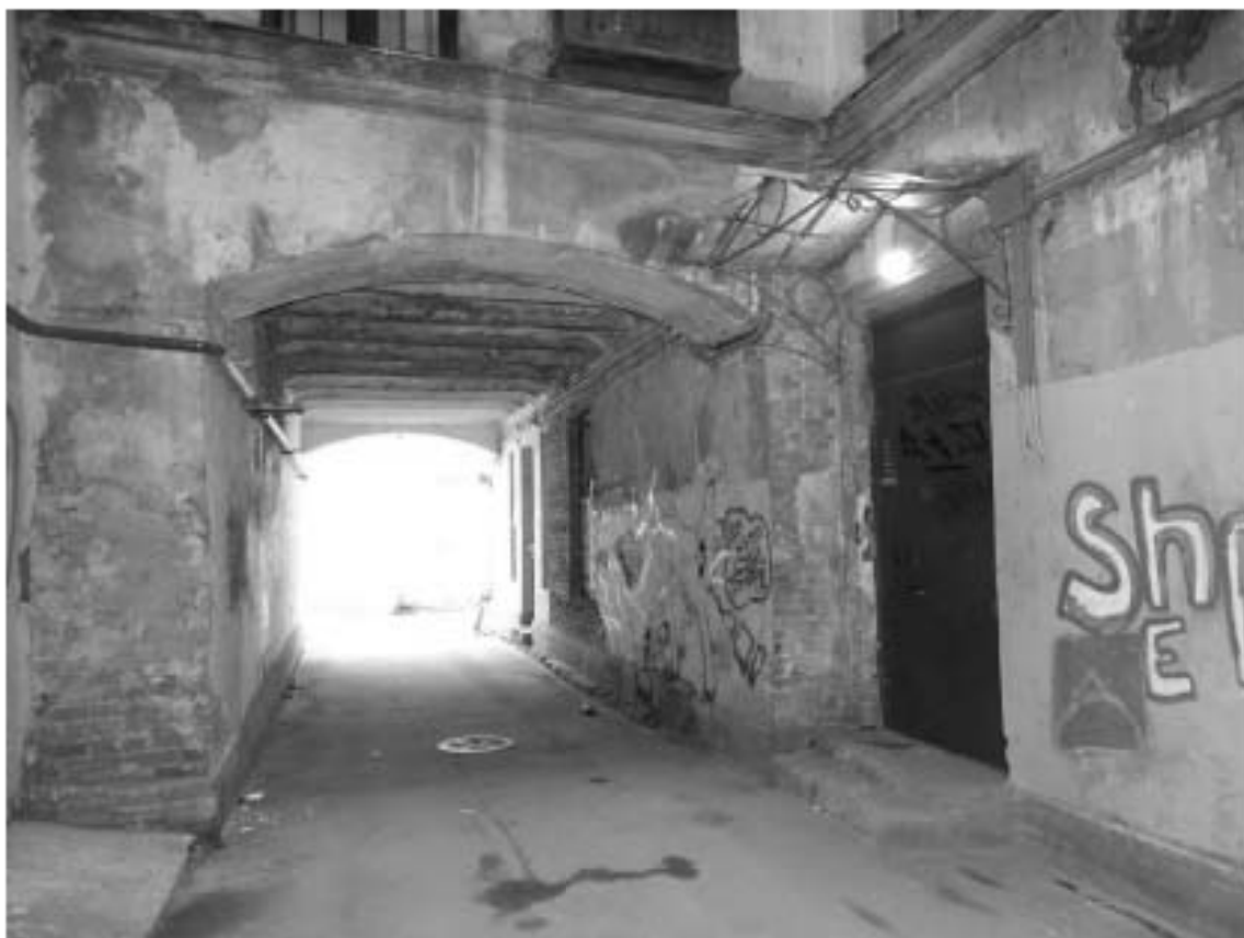
Фото 34. Здание по адресу: г. Санкт-Петербург, Тучков пер., 11/5, литера А. Воротный проезд в северо-восточный двор. Съемка 19.04.2021 г. Трушковский В.Э.
