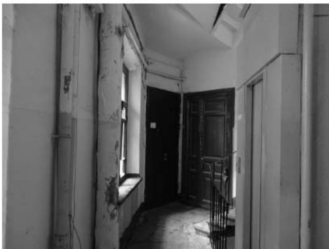
Фото 172. Лестница № 8. Площадка 4-го этажа. Съёмка 19.04.2021 г. Трушковский В.Э.
