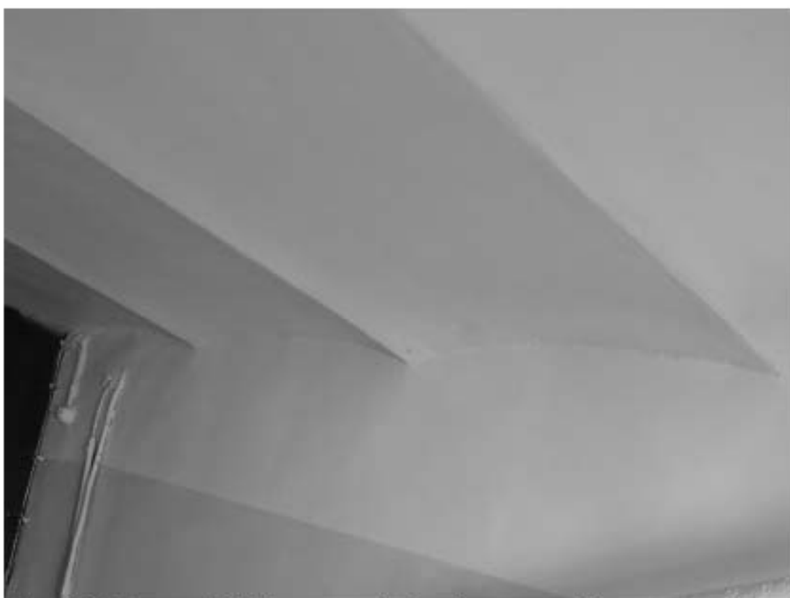
Фото 103. Лестница № 5. Площадка м/у 4-м и 5-м этажом. Оформление потолка. Съемка 19.04.2021 г. Трушковский В.Э.
