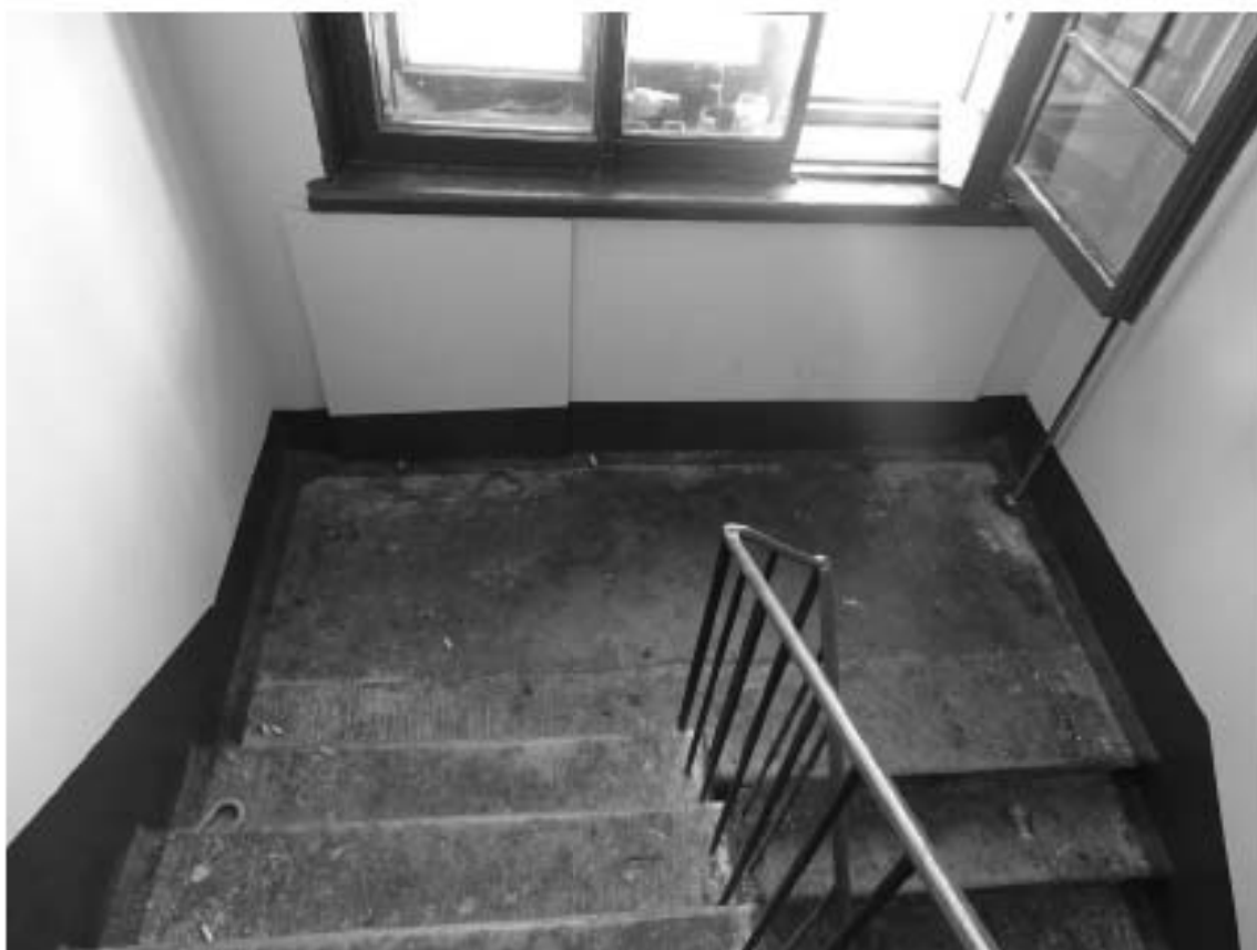
Фото 98. Лестница № 5. Площадка м/у 3-м и 4-м этажом. Покрытие пола. Съемка 19.04.2021 г. Трушковский В.Э.
