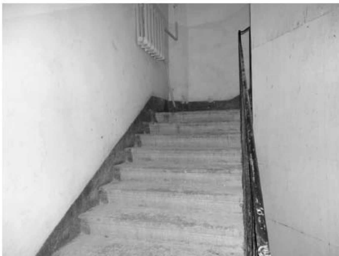
Фото 163. Лестница № 8. Лестничный марш м/у 2-м и 3-м этажом. Съемка 19.04.2021 г. Трушковский В.Э.
