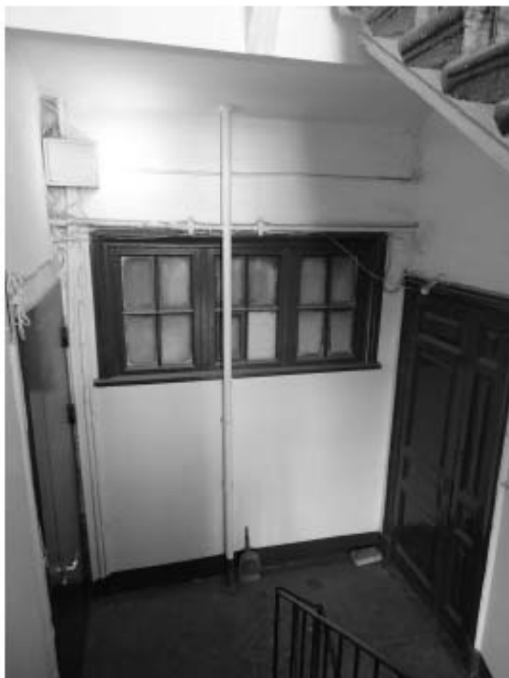
Фото 111. Лестница № 6. Площадка 2-го этажа. Съёмка 19.04.2021 г. Трушковский В.Э.
