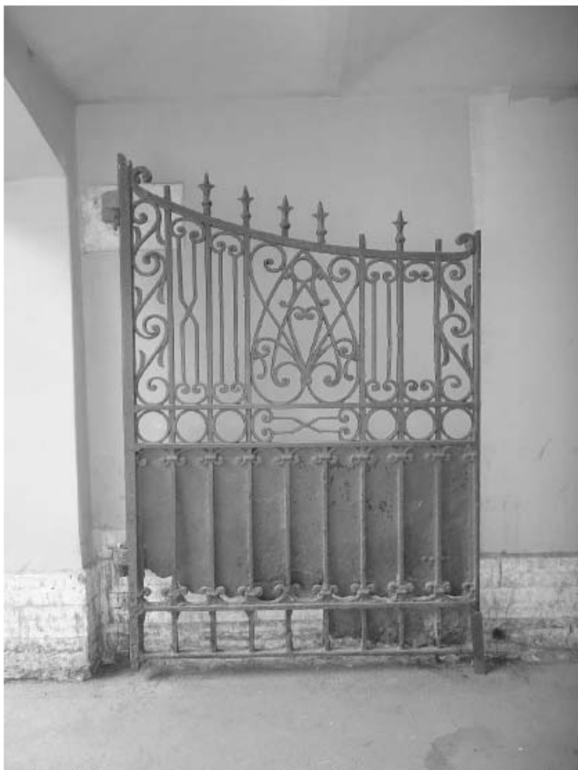
Фото 64. Здание по адресу: г. Санкт-Петербург, Тучков пер., 11/5, литера А. Воротное заполнение. Съемка 19.04.2021 г. Трушковский В.Э.
