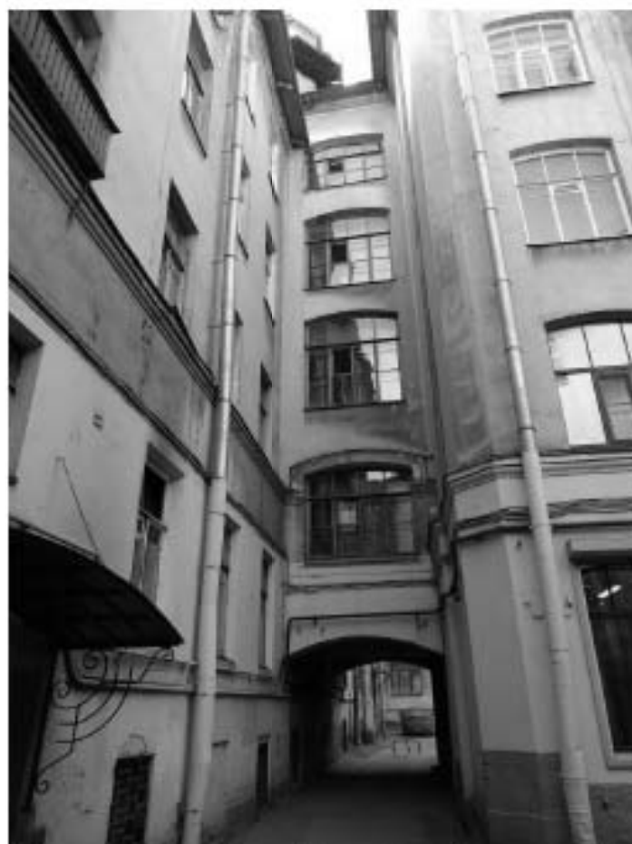
Фото 45. Здание по адресу: г. Санкт-Петербург, Тучков пер., 11/5, литера А. Фрагмент северо-восточного дворового фасада. Съемка 19.04.2021 г. Трушковский В.Э.
