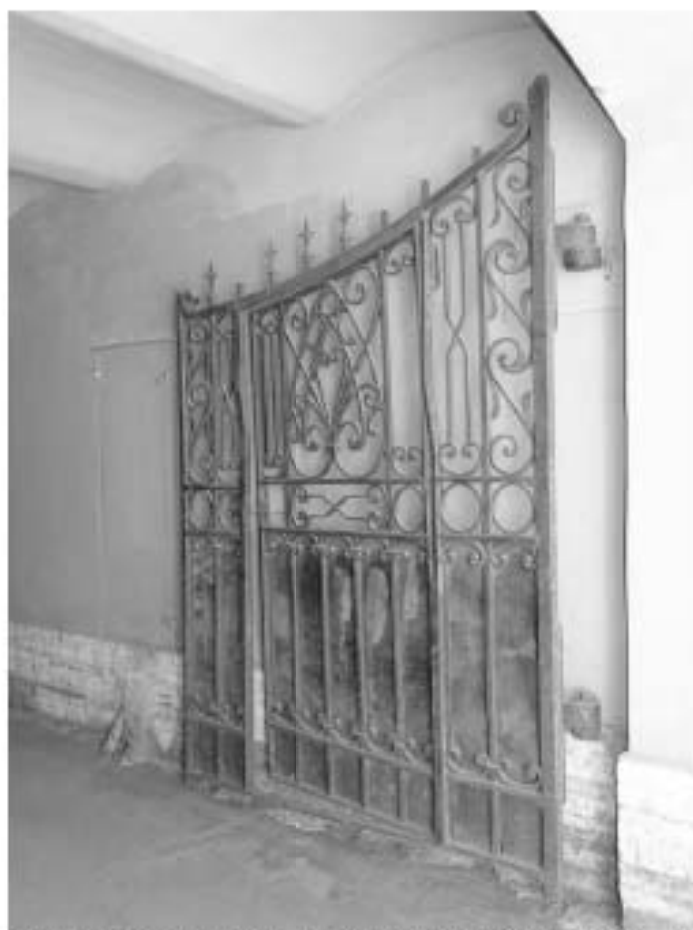
Фото 22. Здание по адресу: г. Санкт-Петербург, Тучков пер., 11/5, литера А. Воротное заполнение. Съемка 19.04.2021 г. Трушковский В.Э.
