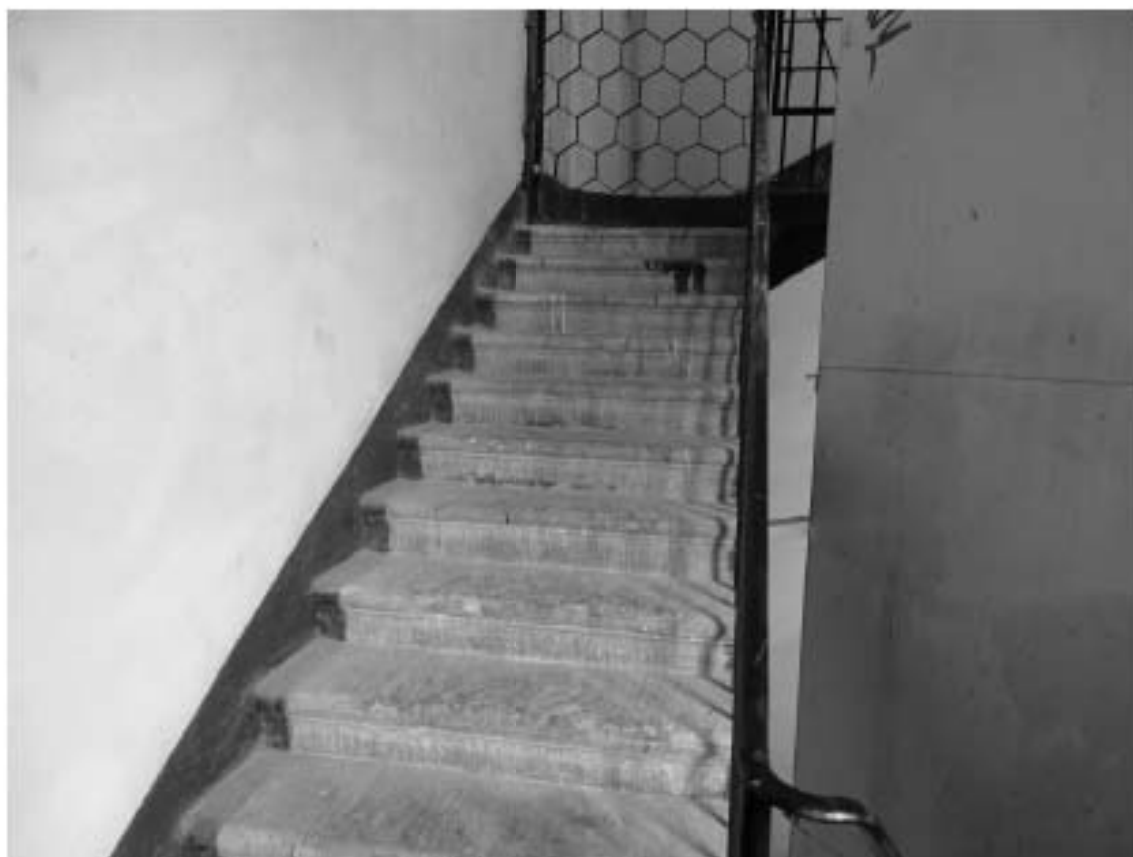
Фото 182. Лестница № 8. Лестничный марш м/у 5-м и 6-м этажом. Съемка 19.04.2021 г. Трушковский В.Э.
