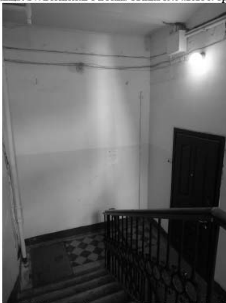
Фото 127. Лестница № 7. Площадка 1-го этажа. Съёмка 19.04.2021 г. Трушковский В.Э.
