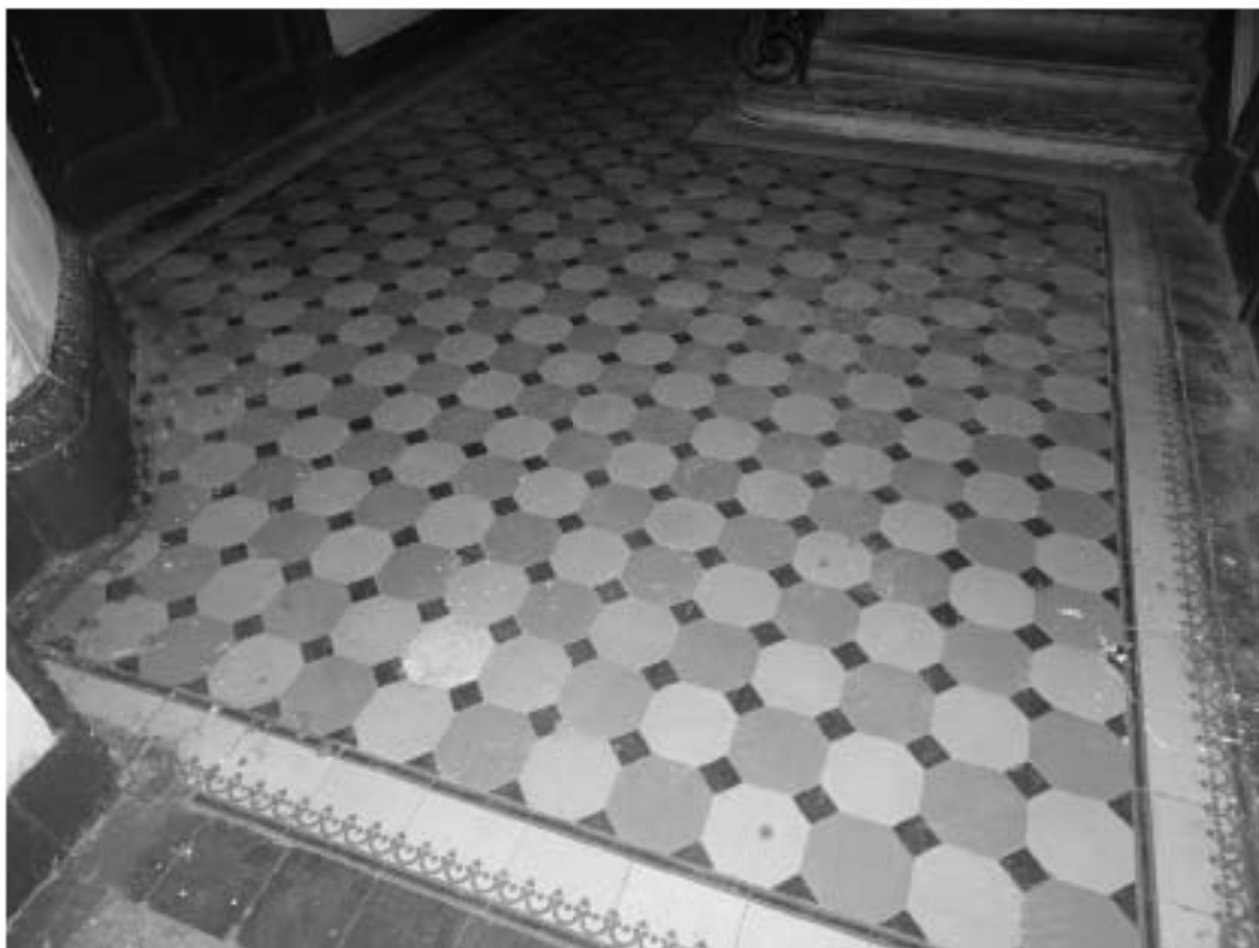
Фото 63. Лестница № 3. 1-й этаж. Вестибюль. Покрытие пола. Съемка 19.04.2021 г. Трушковский В.Э.
