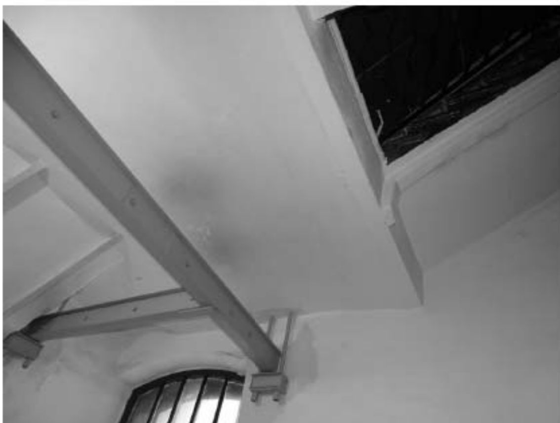
Фото 169. Лестница № 5. Площадка м/у 4-м и 5-м этажом. Своды. Съемка 19.04.2021 г. Штиглиц М. С.
