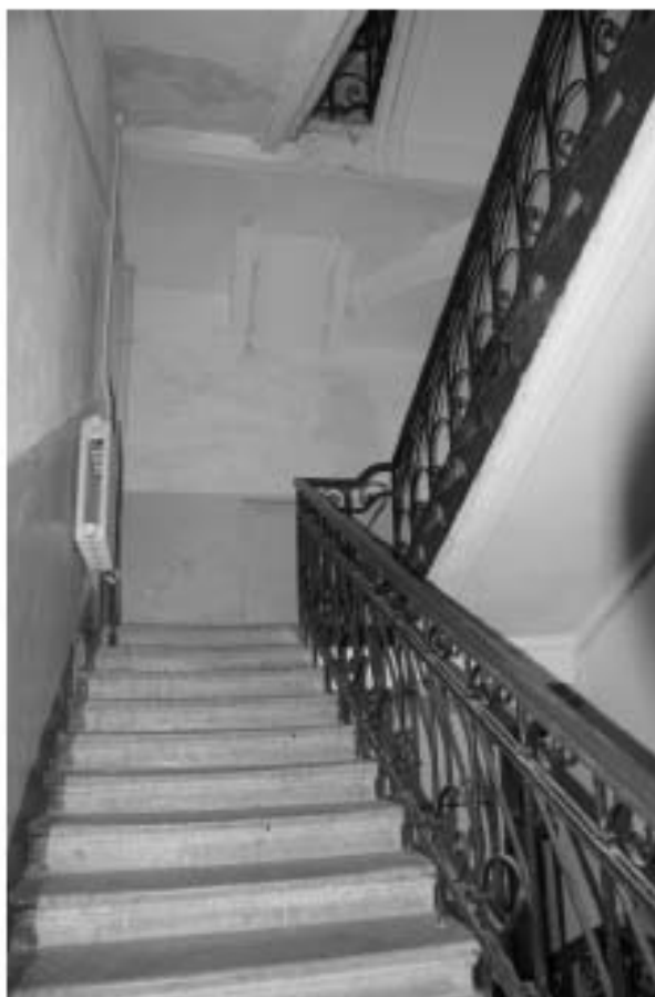
Фото 151. Лестница № 5. Вид на площадку м/у 2-м и 3-м этажом. Съемка 19.04.2021 г. Штиглиц М. С.
