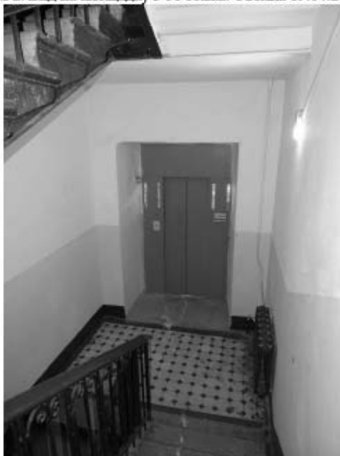
Фото 62. Лестница № 2. Вид на площадку м/у 3-м и 4-м этажом. Съемка 19.04.2021 г. Штиглиц М. С.
