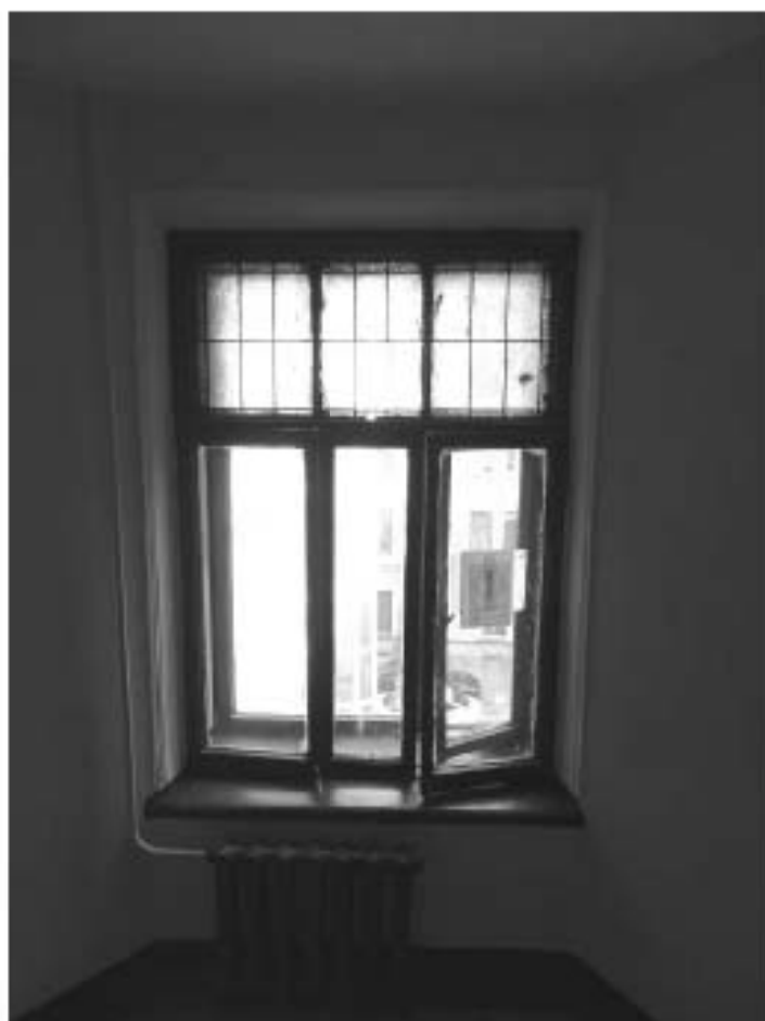
Фото 29. Лестница № 1. Площадка между 3-м и 4-м этажом. Оконный проем. Съемка 19.04.2021 г. Штиглиц М. С.
