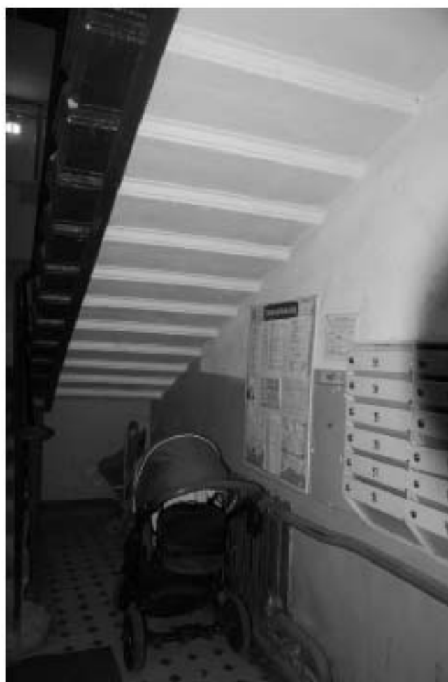
Фото 81. Лестница № 3. Вестибюль 1-го этажа. Пространство под лестницей. Съемка 19.04.2021 г. Штиглиц М. С.
