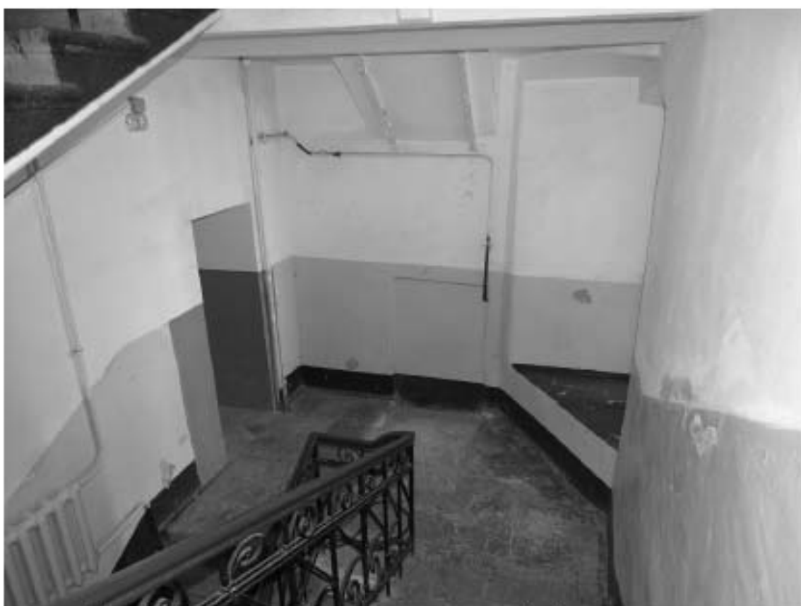
Фото 160. Лестница № 5. Вид на площадку м/у 3-м и 4-м этажом. Съемка 19.04.2021 г. Штиглиц М. С.
