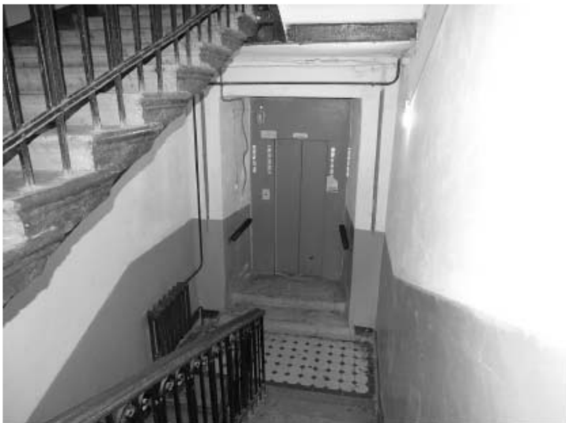
Фото 84. Лестница № 3. Вид на площадку м/у 1-м и 2-м этажом. Съемка 19.04.2021 г. Штиглиц М. С.
