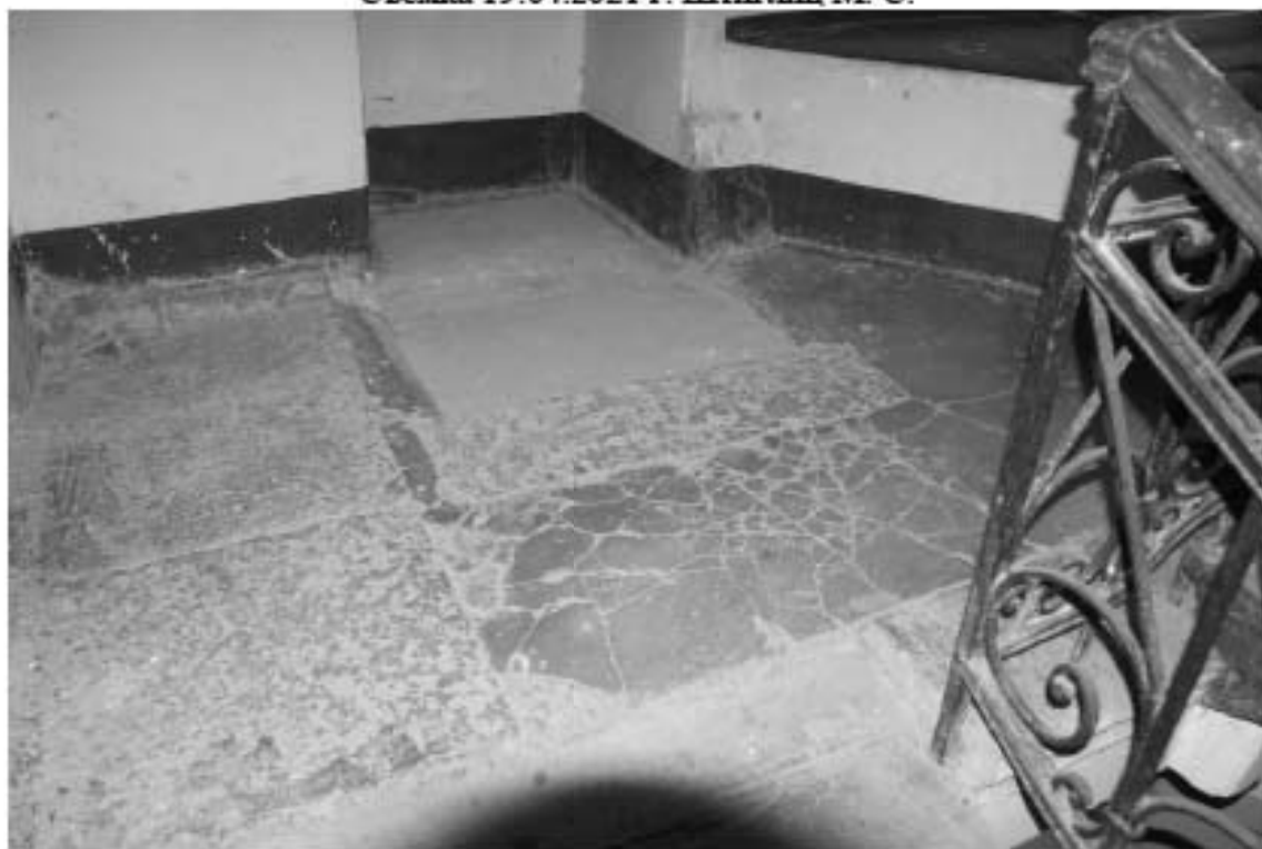
Фото 146. Лестница № 5. Площадка м/у 1-м и 2-м этажом. Покрытие пола. Съемка 19.04.2021 г. Штиглиц М. С.
