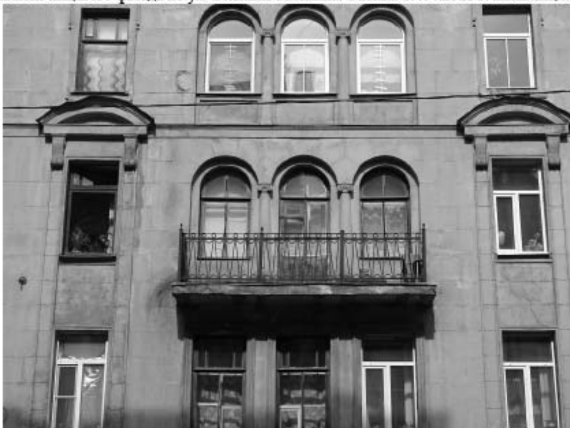
Фото 8. Здание по адресу: г. Санкт-Петербург, Большая Зеленина ул., дом 29, литера А. Фрагмент лицевого фасада по ул. Большая Зеленина. Балкон. Съемка 19.04.2021 г. Штиглиц М. С.
