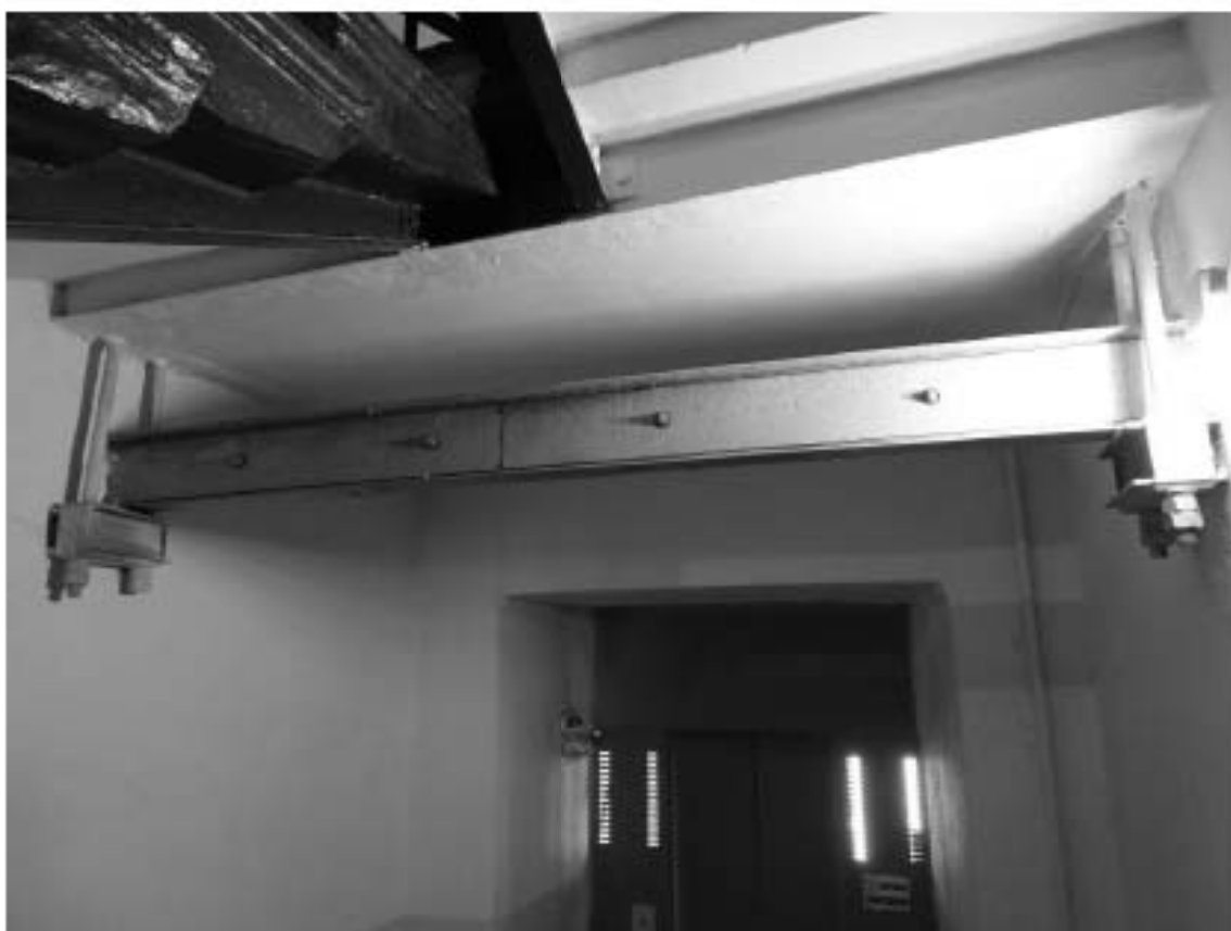
Фото 65. Лестница № 2. Площадка м/у 4-м и 5-м этажом. Съемка 19.04.2021 г. Штиглиц М. С.
