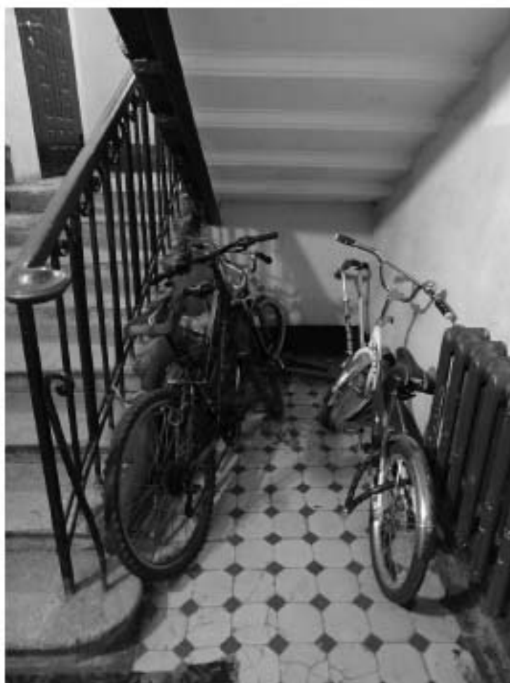
Фото 49. Лестница № 2. Вестибюль. 1-й этаж. Пространство под лестницей. Съемка 19.04.2021 г. Штиглиц М. С.
