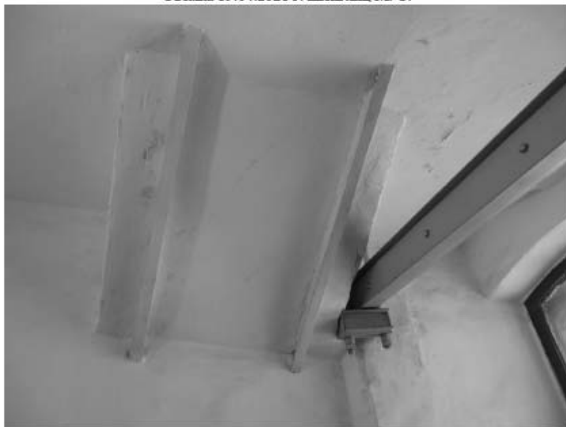
Фото 168. Лестница № 5. Площадка м/у 4-м и 5-м этажом. Своды. Съемка 19.04.2021 г. Штиглиц М. С.
