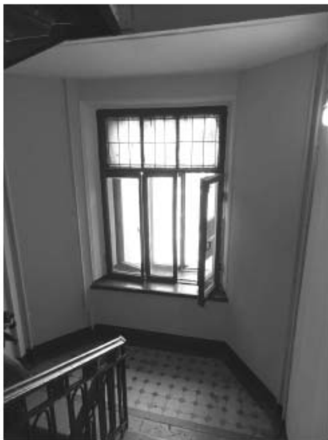
Фото 31. Лестница № 1. Вид на площадку м/у 4-м и 5-м этажом. Съемка 19.04.2021 г. Штиглиц М. С.
