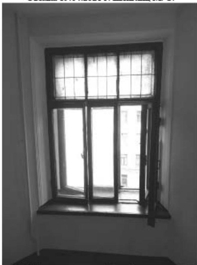
Фото 32. Лестница № 1. Площадка между 4-м и 5-м этажом. Оконное заполнение. Съемка 19.04.2021 г. Штиглиц М. С.
