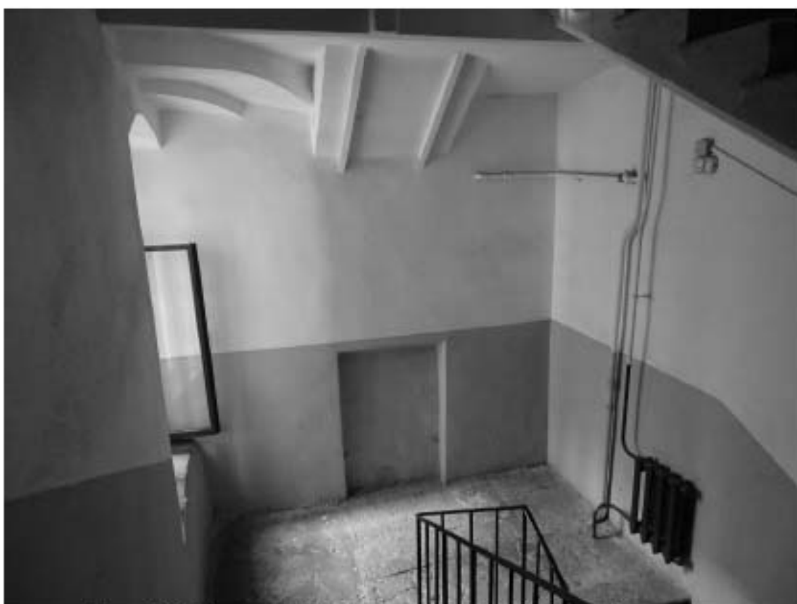
Фото 116. Лестница № 4. Вид на площадку м/у 2-м и 3-м этажом. Съемка 19.04.2021 г. Штиглиц М. С.
