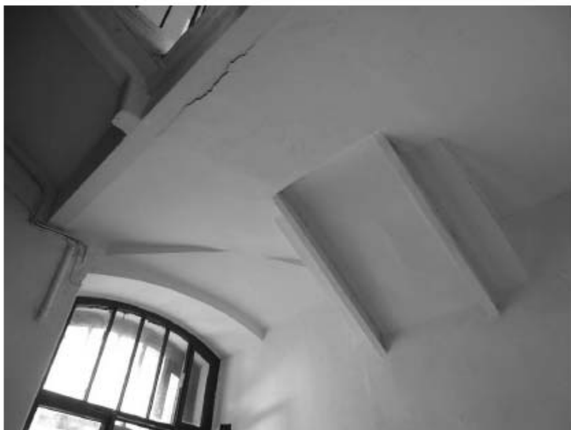
Фото 111. Лестница № 4. Площадка м/у 1-м и 2-м этажом. Своды. Съемка 19.04.2021 г. Штиглиц М. С.
