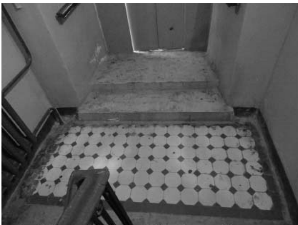
Фото 85. Лестница № 3. Площадка м/у 1-м и 2-м этажом. Покрытие пола. Съемка 19.04.2021 г. Штиглиц М. С.
