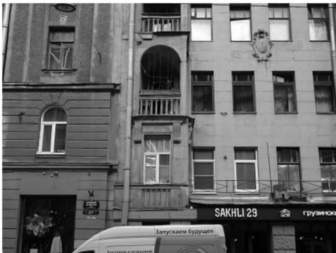
Фото 13. Здание по адресу: г. Санкт-Петербург, Большая Зеленина ул., дом 29, литера А. Фрагмент лицевого фасада по ул. Большая Зеленина. Съемка 19.04.2021 г. Штиглиц М. С.
