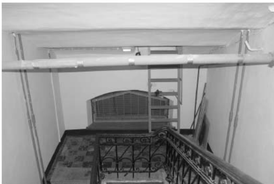
Фото 110. Лестница № 8. Площадка между 5-м и 6-м этажом. Съемка 19.04.2021 г. Штиглиц М. С.
