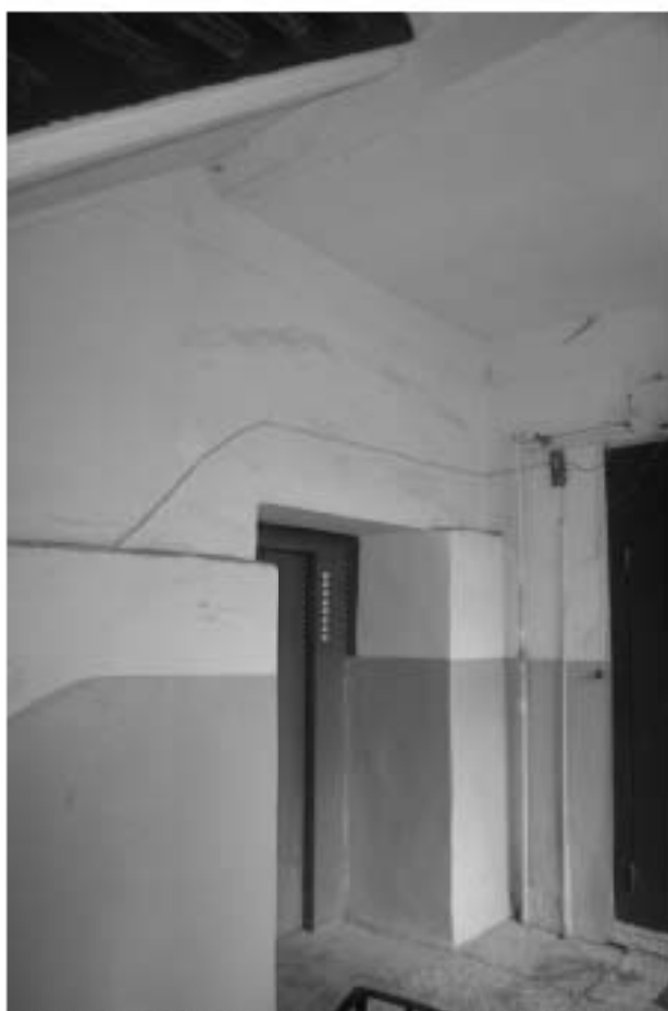
Фото 72. Лестница № 7. 6-й этаж. Съёмка 19.04.2021 г. Штиглиц М. С.
