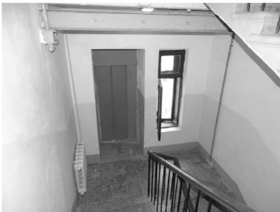
Фото 20. Лестница № 6. Площадка между 3-м и 4-м этажом. Съемка 19.04.2021 г. Штиглиц М. С.
