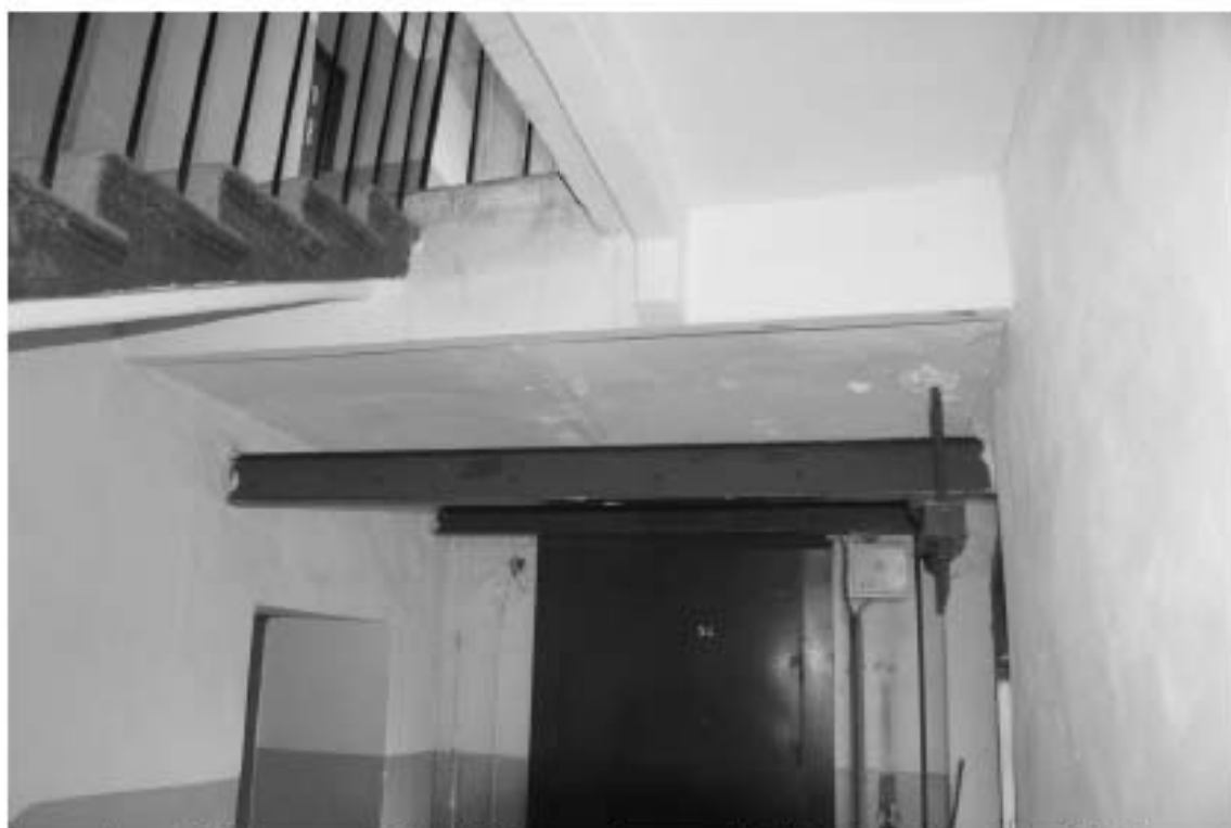
Фото 66. Лестница № 7. 5-й этаж. Съёмка 19.04.2021 г. Штиглиц М. С.
