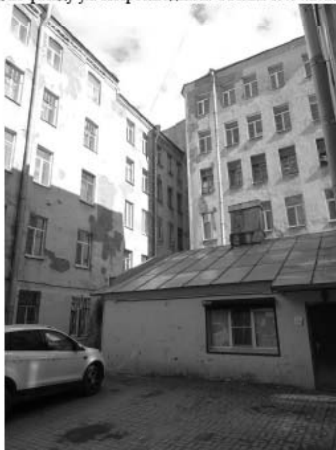
Фото 18. Здание по адресу: г. Санкт-Петербург, Большая Зеленина ул., дом 29, литера Б. Дворовой фасад. Съемка 19.04.2021 г. Штиглиц М. С.
