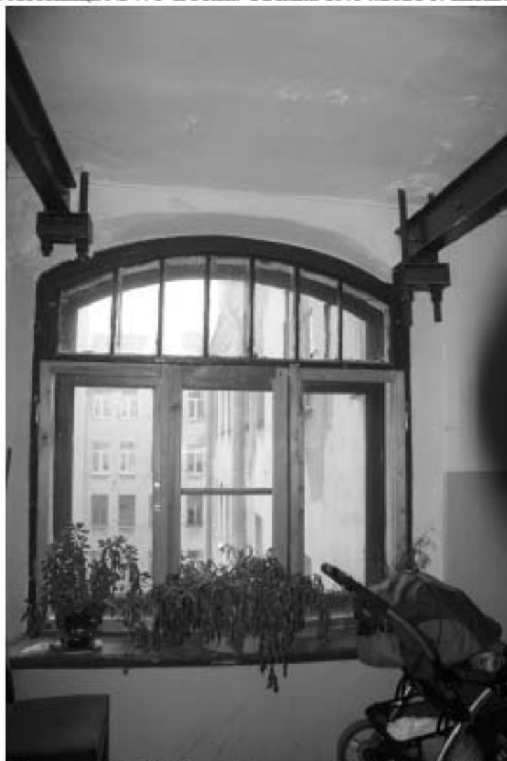
Фото 67. Лестница № 7. 5-й этаж. Съёмка 19.04.2021 г. Штиглиц М. С.
