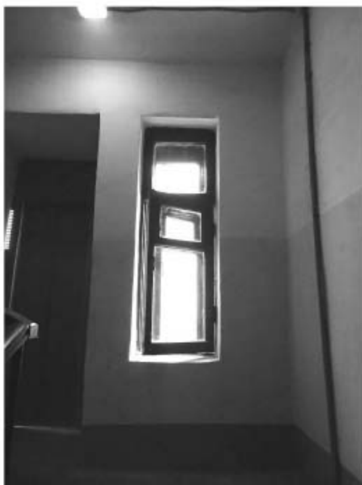
Фото 23. Лестница № 6. Площадка между 4-м и 5-м этажом. Съемка 19.04.2021 г. Штиглиц М. С.
