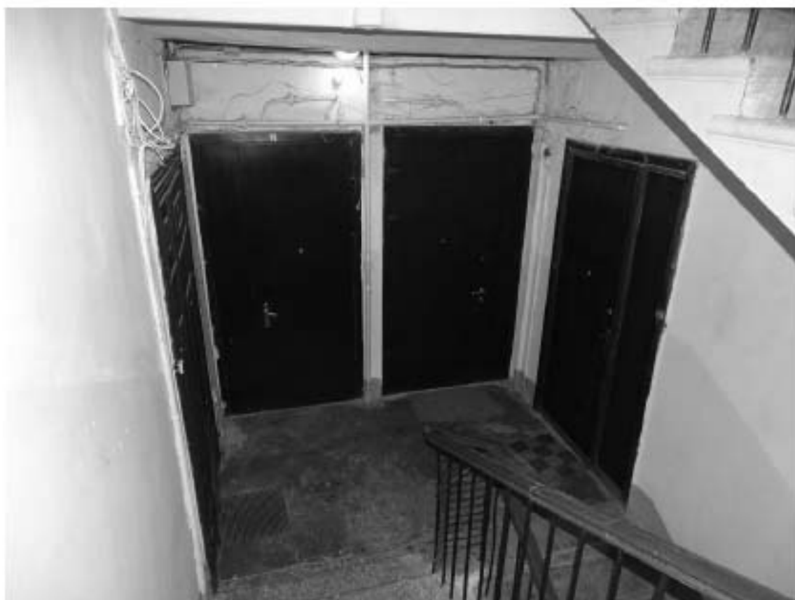
Фото 21. Лестница № 6. 4-й этаж. Съёмка 19.04.2021 г. Штиглиц М. С.
