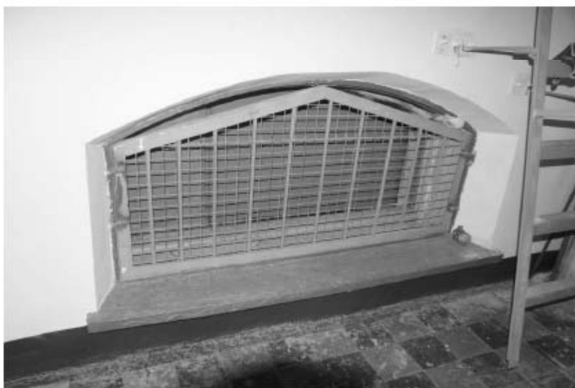
Фото 111. Лестница № 8. Площадка между 5-м и 6-м этажом. Съемка 19.04.2021 г. Штиглиц М. С.
