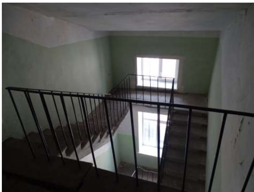
Фото 91. Выявленный объект культурного наследия «Дом Ш. З. Иофа», расположенный по адресу Санкт-Петербург, ул. Белинского, д. 13, Литейный пр., д. 47. Вид лестницы № 3 (со стороны двора). Съемка 26.04.2021. Егорова Т. Г.
