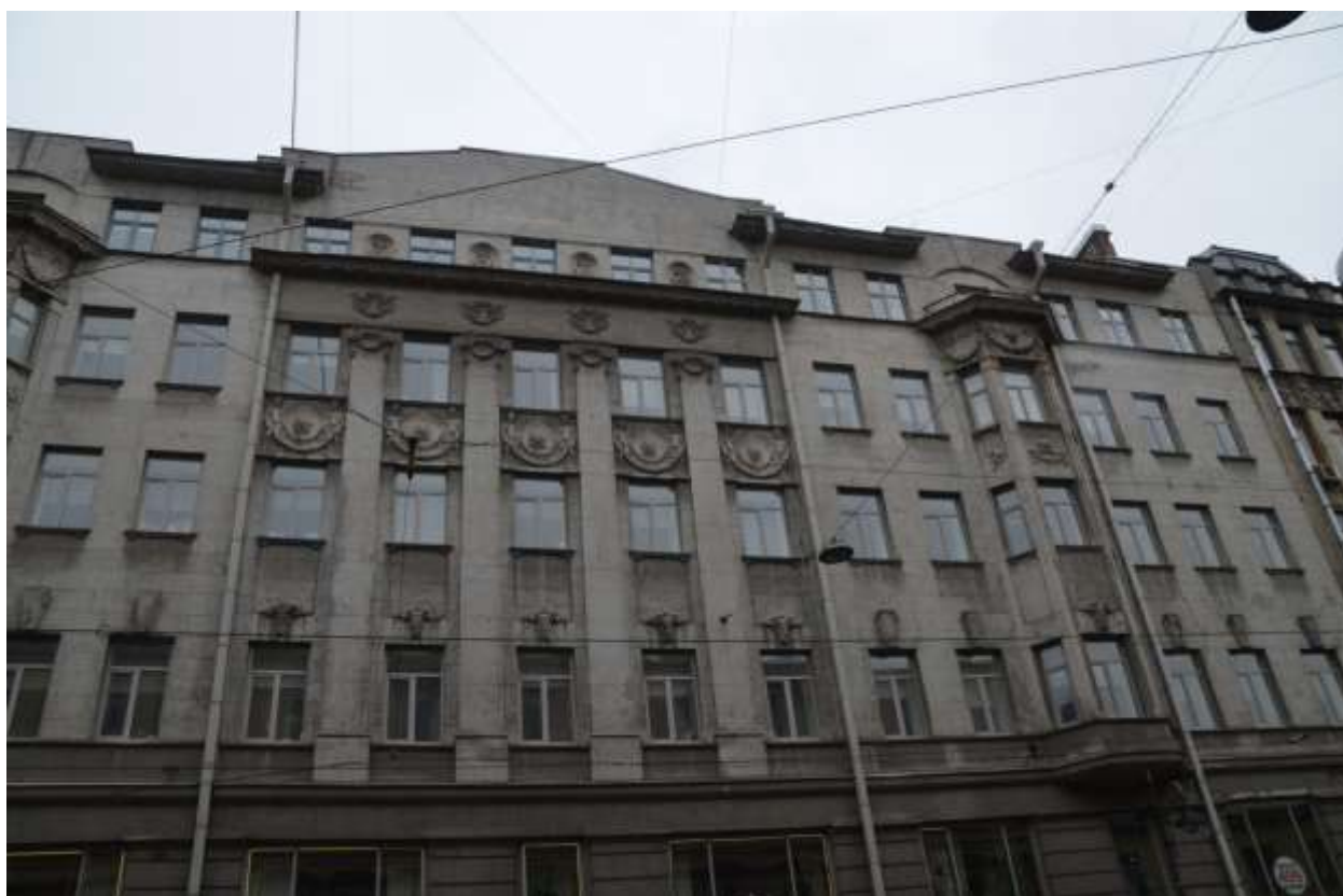
Фото 05. Выявленный объект культурного наследия «Дом Ш. З. Иофа», расположенный по адресу Санкт-Петербург, ул. Белинского, д. 13, Литейный пр., д. 47. Вид северного фасада. Фрагмент. Съемка 26.04.2021. Егорова Т. Г.
