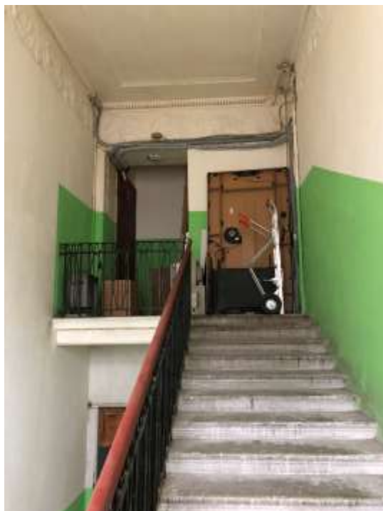
Фото 24. Выявленный объект культурного наследия «Дом Ш. З. Иофа», расположенный по адресу Санкт-Петербург, ул. Белинского, д. 13, Литейный пр., д. 47. Вид черной лестницы. Съемка 26.04.2021. Егорова Т. Г.
