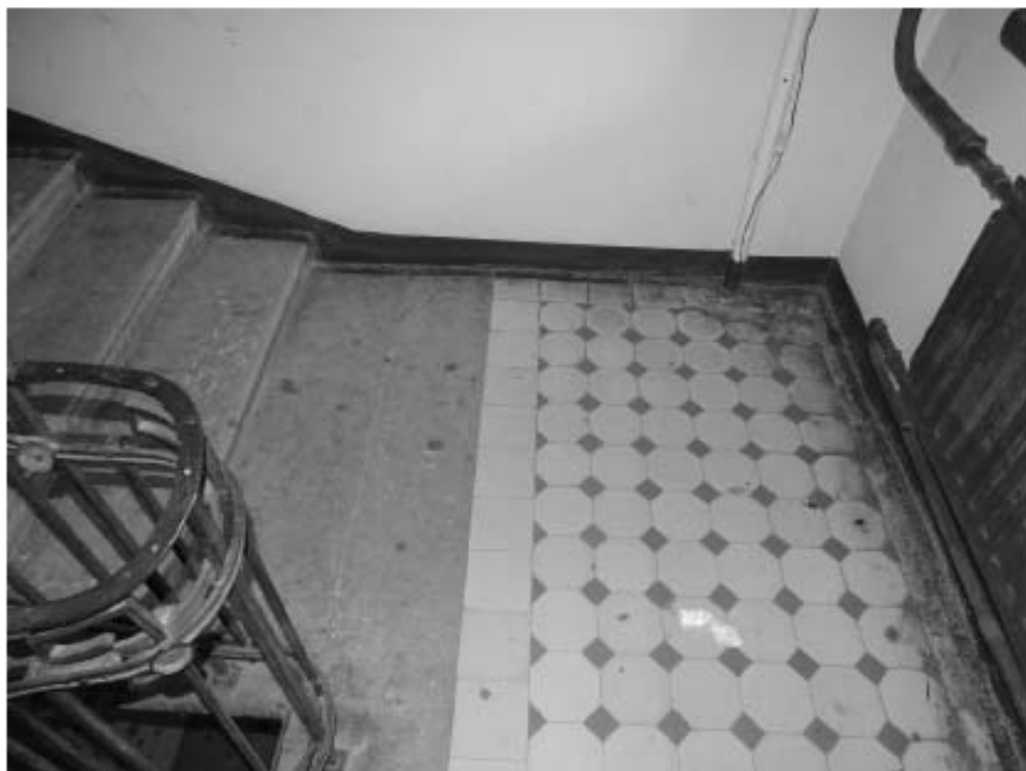
Фото 52. Лестница № 3: Площадка между 1-м и 2-м этажом. Съемка 26.04.2021 г. Михайловская Г. В.
