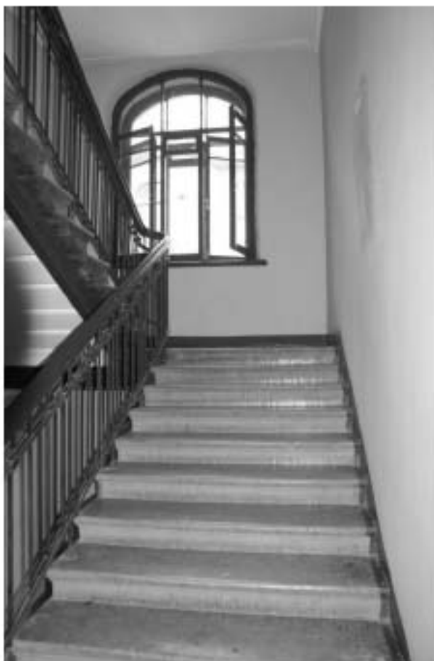
Фото 63. Лестница № 3: Площадка между 3-м и 4-м этажом. Съемка 26.04.2021 г. Михайловская Г. В.
