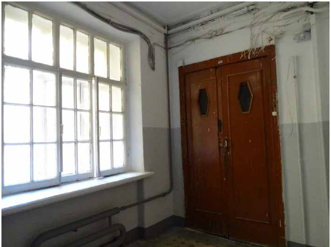
Фото 447. ЛК-6. Площадка между 1-м и 2-м этажом. Съемка 19.04.2021 г. Трушковский В.Э.
