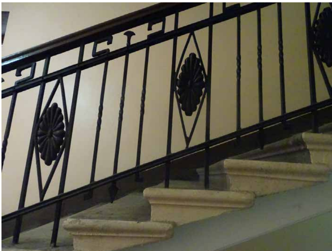
Фото 364. ЛК-3. Площадка между 3-м и 4-м этажом. Лестничное ограждение. Съемка 19.04.2021 г. Трушковский В.Э.
