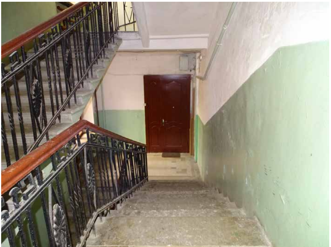
Фото 285. ЛК-1. Площадка между 1-м и 2-м этажом. Съемка 19.04.2021 г. Трушковский В.Э.
