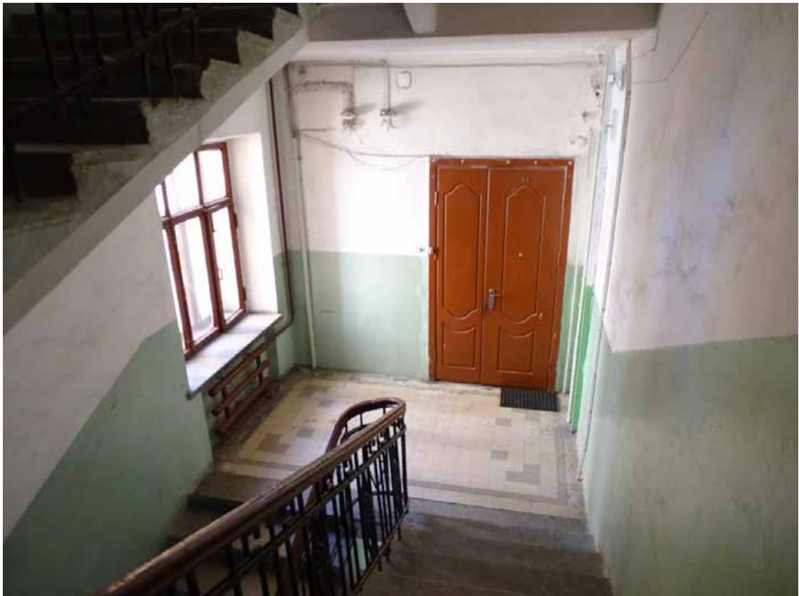
Фото 293. ЛК-1. Площадка между 2-м и 3-м этажом. Съемка 19.04.2021 г. Трушковский В.Э.
