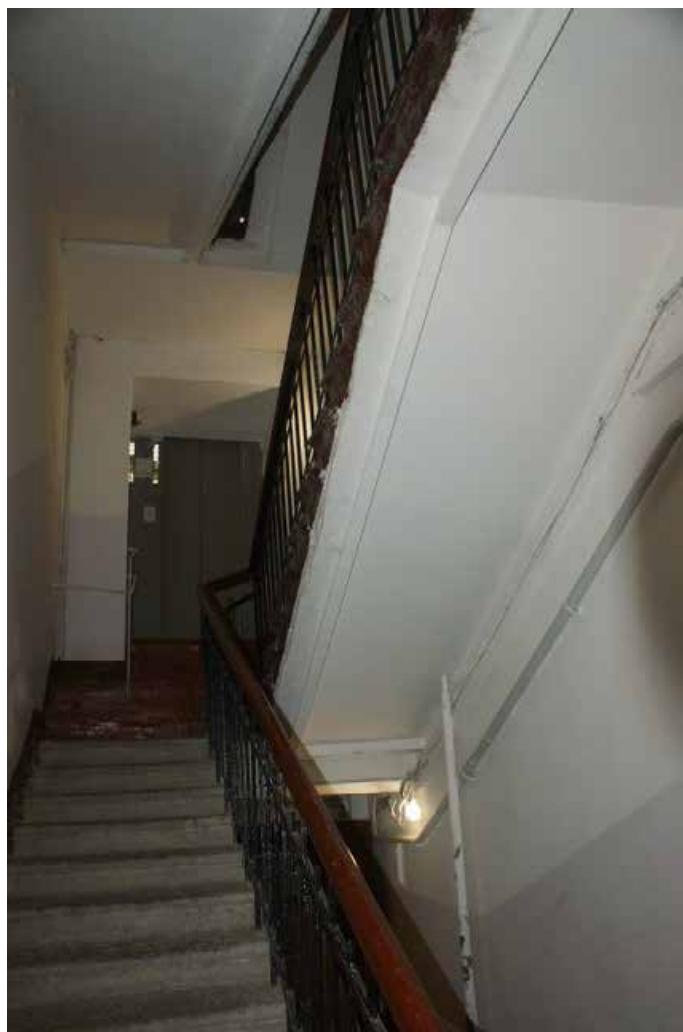
Фото 315. ЛК-2. Площадка между 1-м и 2-м этажом. Съемка 19.04.2021 г. Трушковский В.Э.
