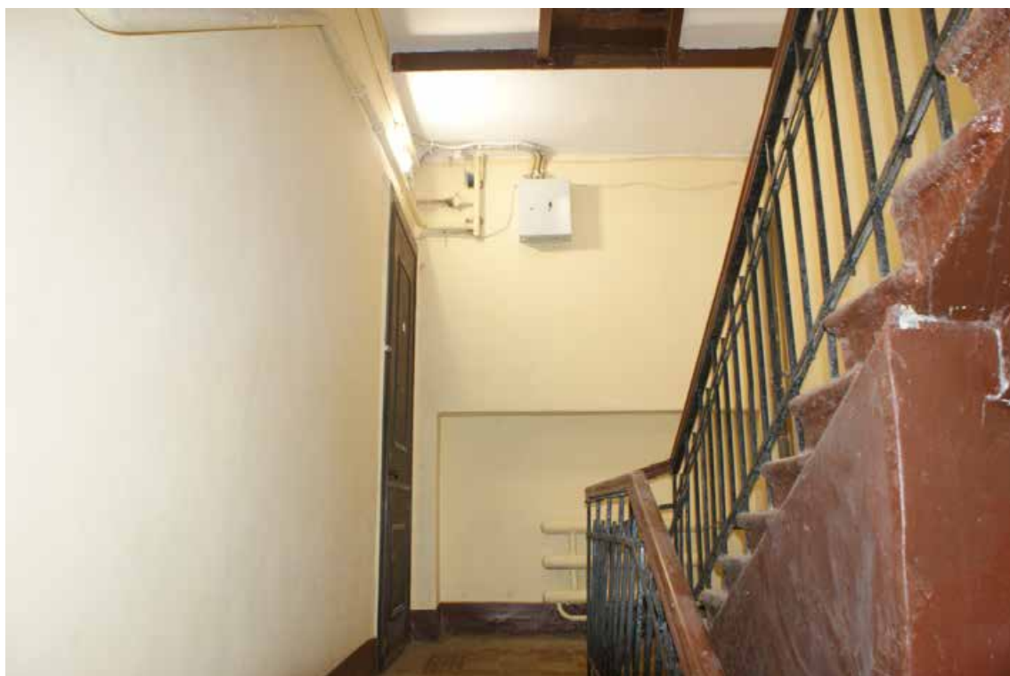
Фото 517. ЛК-9. Площадка между 1-м и 2-м этажом. Съемка 19.04.2021 г. Трушковский В.Э.
