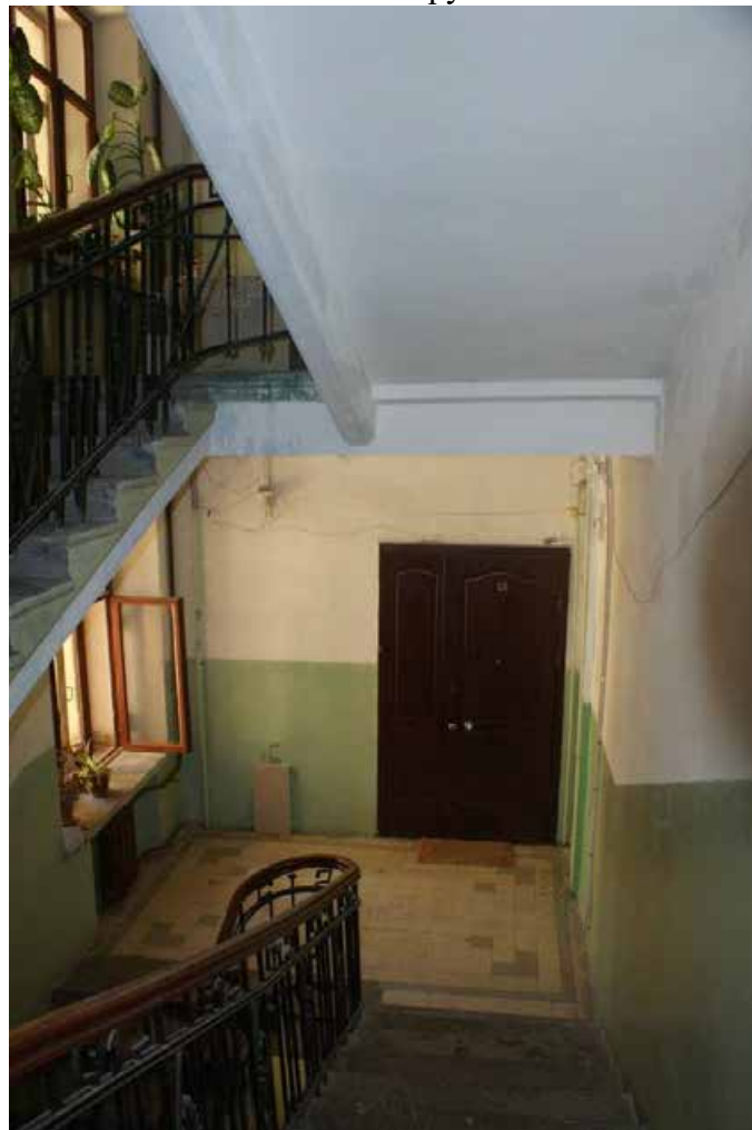
Фото 301. ЛК-1. Площадка между 4-м и 5-м этажом. Съемка 19.04.2021 г. Трушковский В.Э.
