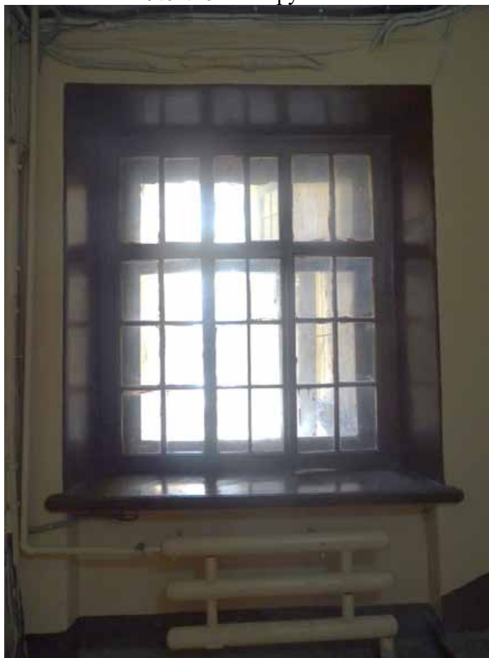
Фото 355. ЛК-3. Площадка между 1-м и 2-м этажом. Съемка 19.04.2021 г. Трушковский В.Э.
