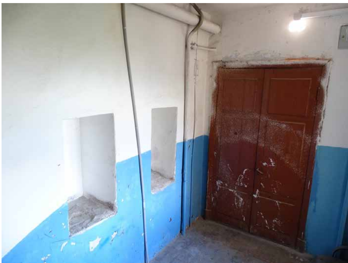
Фото 421. ЛК-5. Площадка между 5-м и 6-м этажом. Съемка 19.04.2021 г. Трушковский В.Э.
