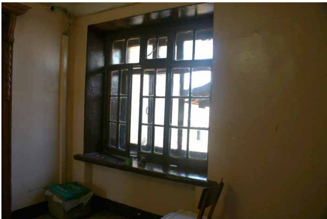
Фото 385. ЛК-3. Площадка 6-го этажа. Оконный проем. Съемка 19.04.2021 г. Трушковский В.Э.
