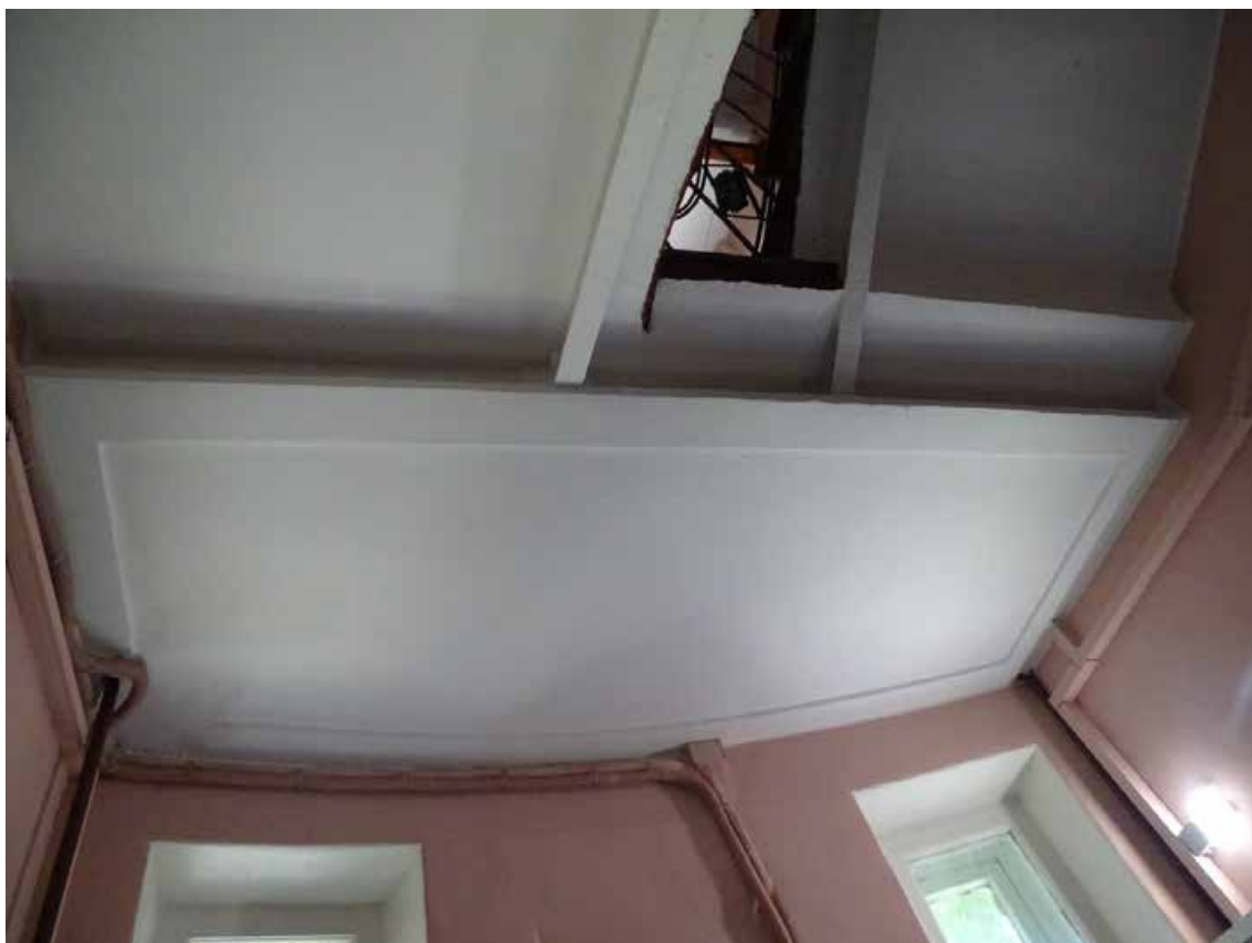
Фото 494. ЛК-8. Площадка между 1-м и 2-м этажом. Съемка 19.04.2021 г. Трушковский В.Э.
