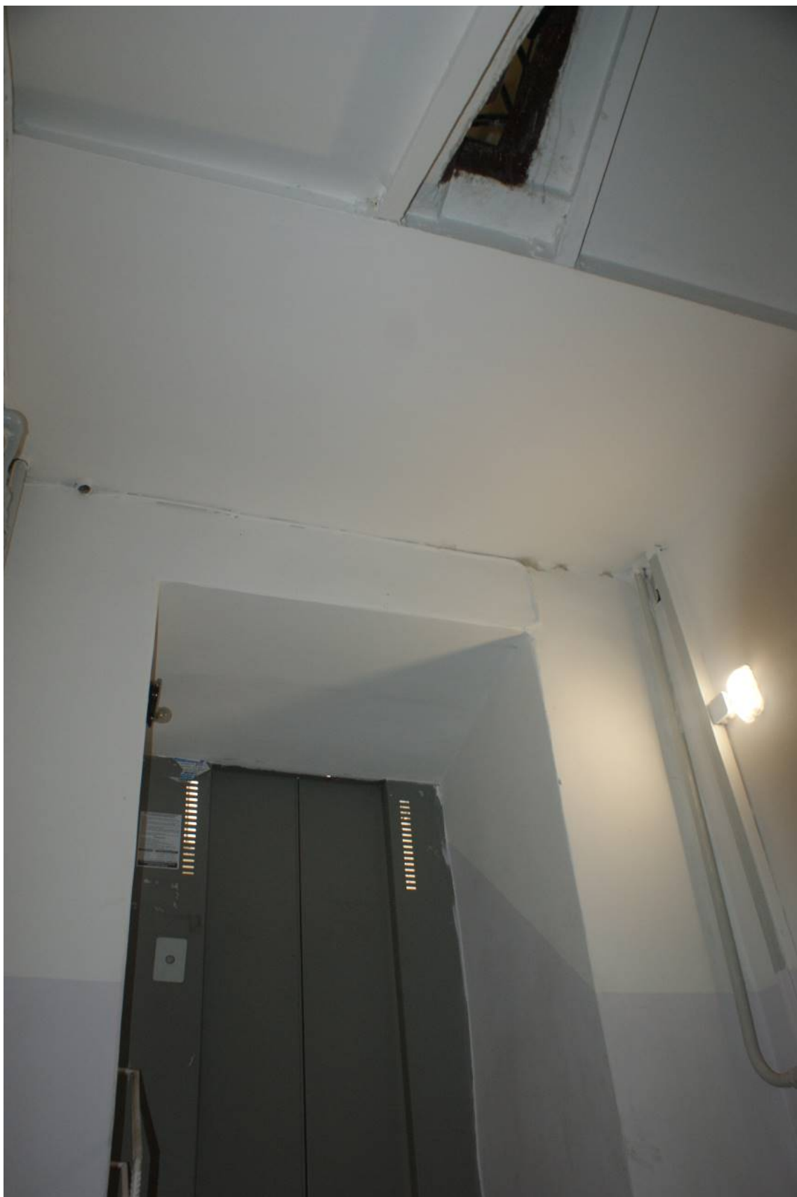
Фото 317. ЛК-2. Площадка между 1-м и 2-м этажом. Съемка 19.04.2021 г. Трушковский В.Э.
