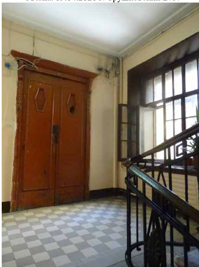
Фото 365. ЛК-3. Площадка между 3-м и 4-м этажом. Съемка 19.04.2021 г. Трушковский В.Э.
