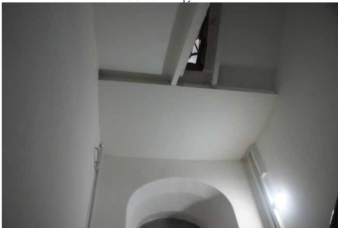
Фото 321. ЛК-2. Площадка между 2-м и 3-м этажом. Съемка 19.04.2021 г. Трушковский В.Э.
