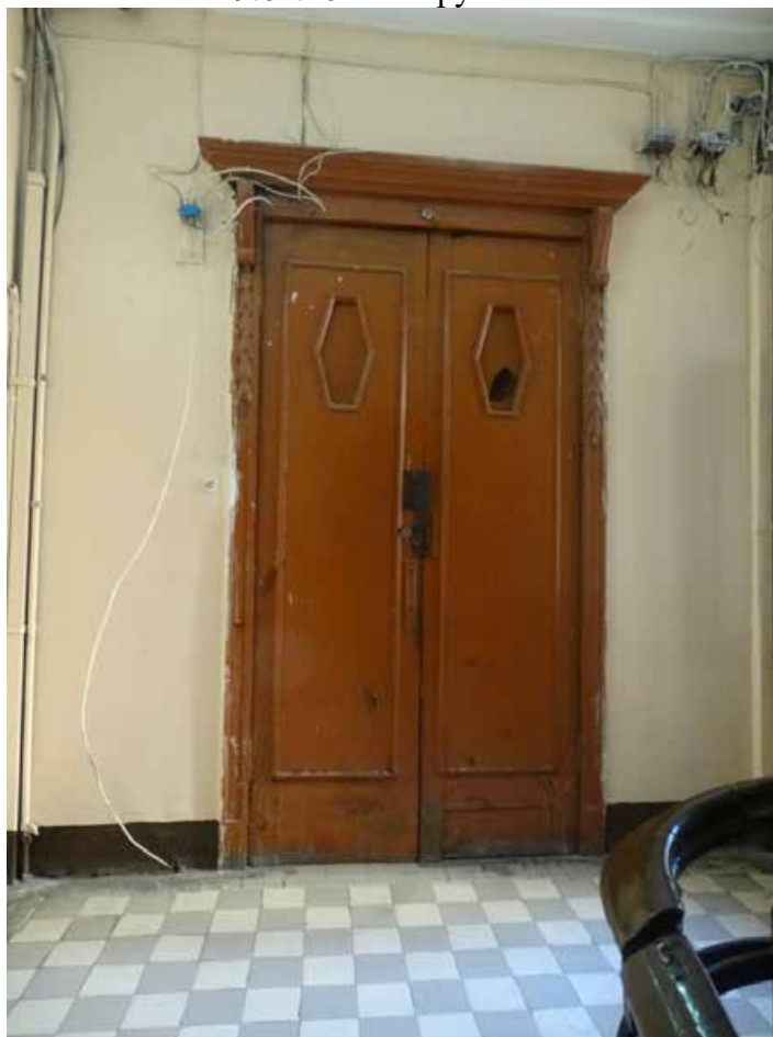
Фото 367. ЛК-3. Площадка между 3-м и 4-м этажом. Съемка 19.04.2021 г. Трушковский В.Э.
