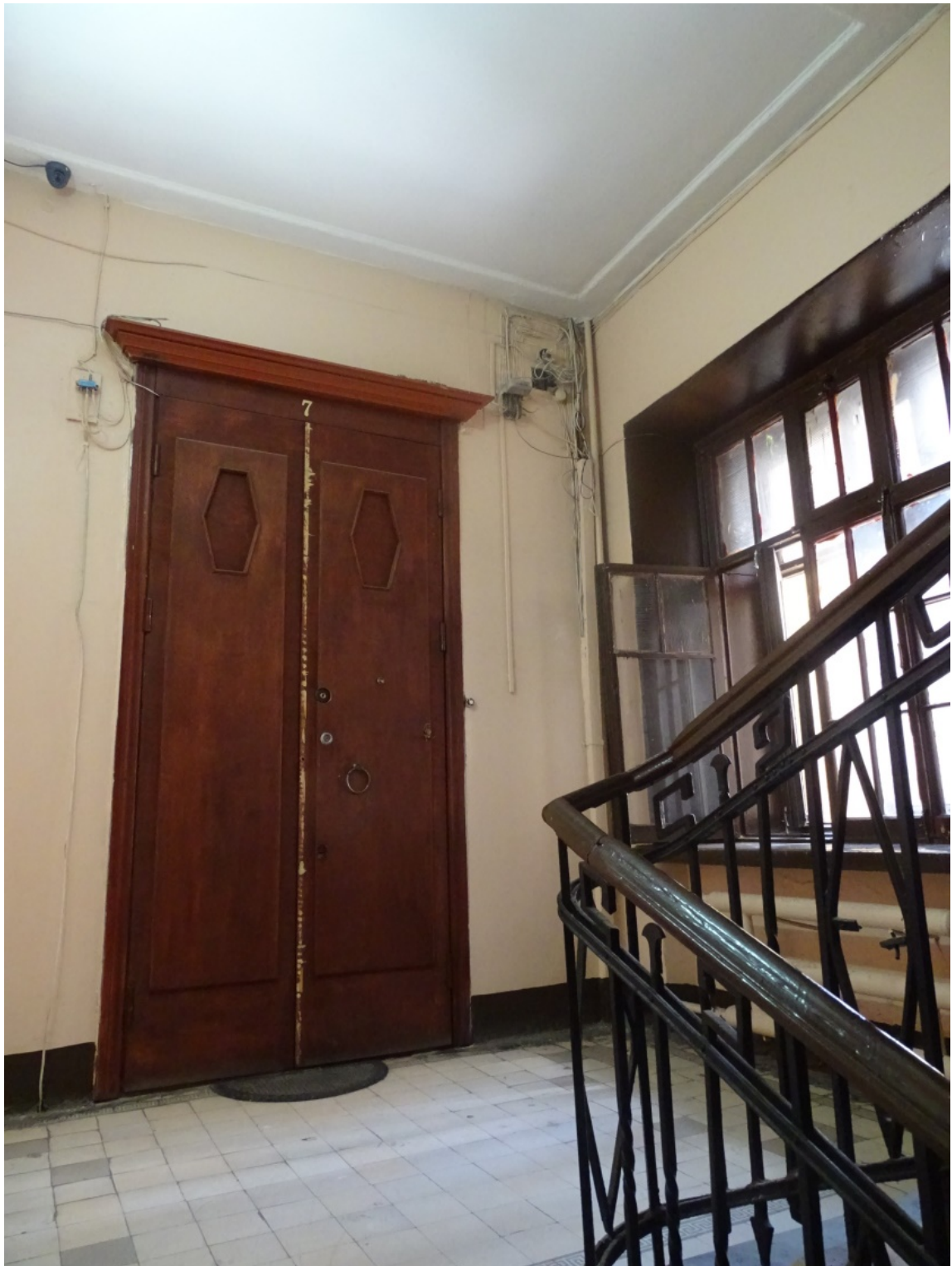
Фото 358. ЛК-3. Площадка между 2-м и 3-м этажом. Съемка 19.04.2021 г. Трушковский В.Э.
