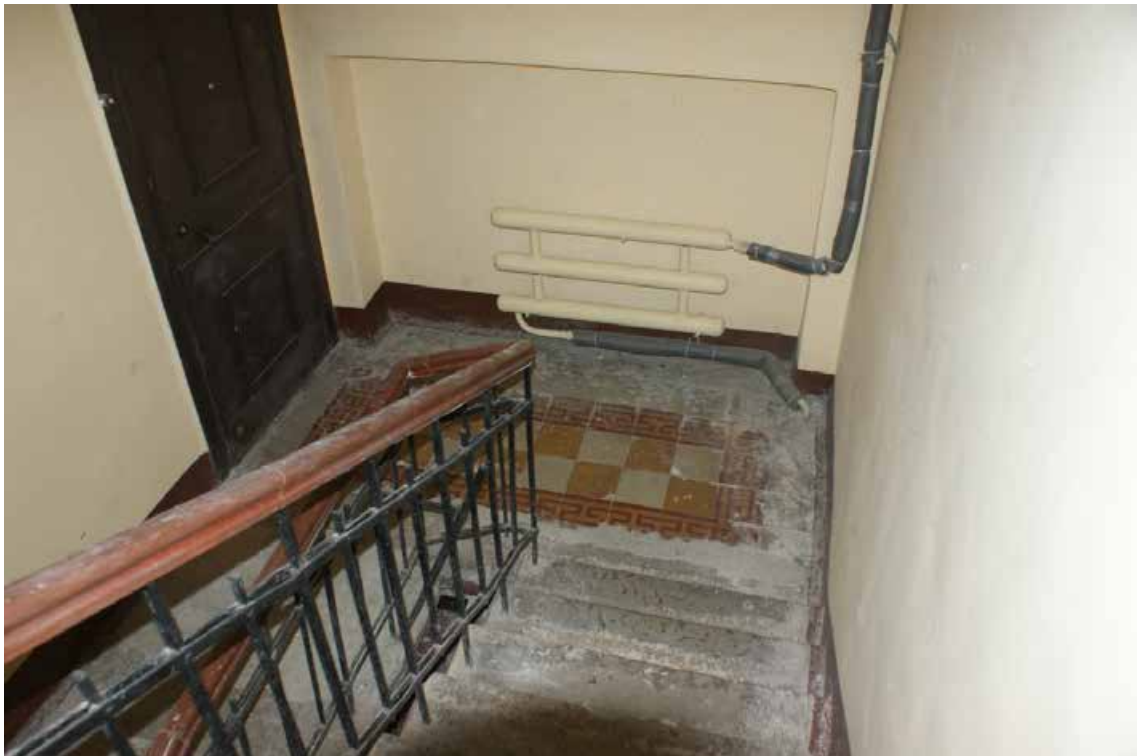
Фото 518. ЛК-9. Площадка между 1-м и 2-м этажом. Съемка 19.04.2021 г. Трушковский В.Э.
