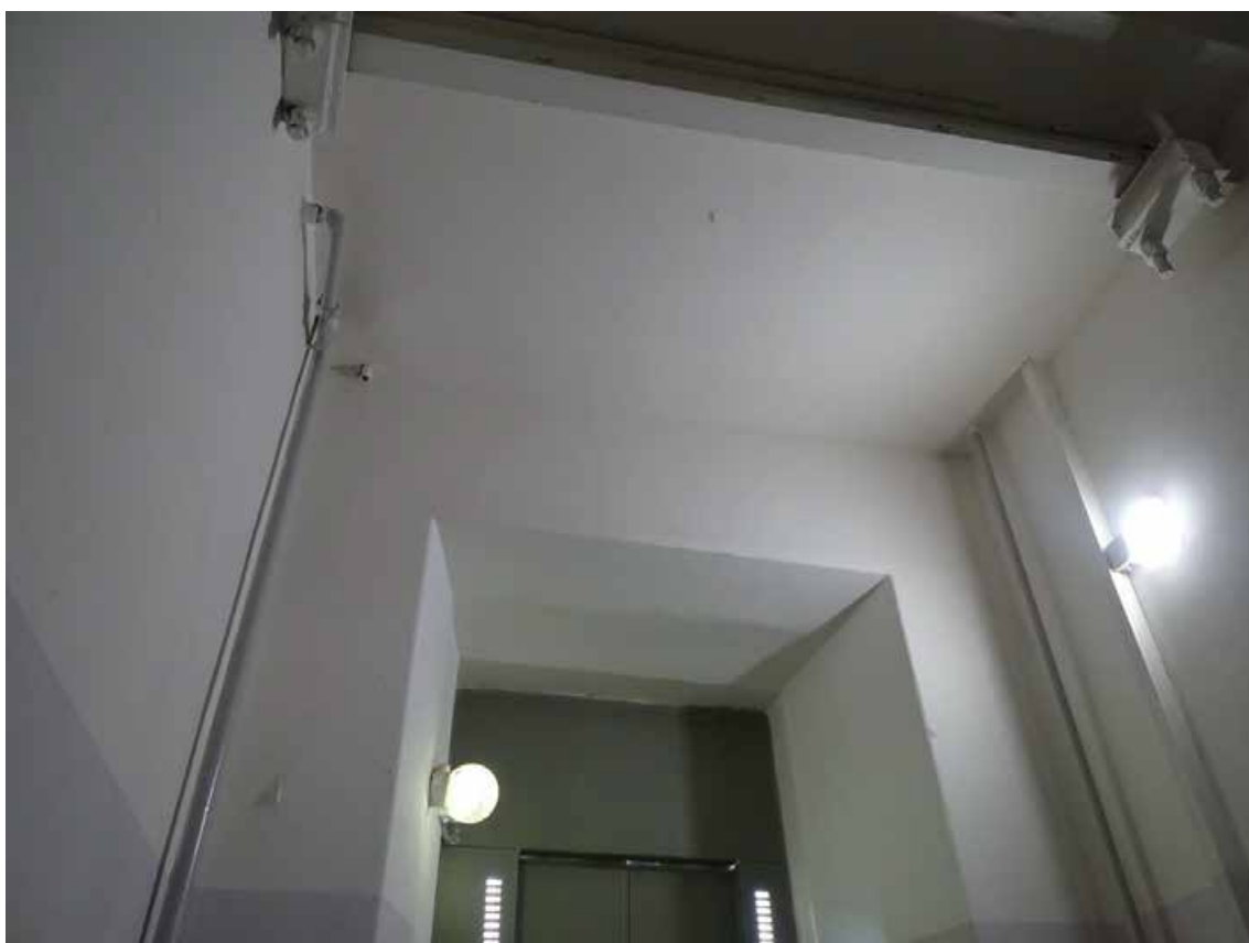
Фото 327. ЛК-2. Площадка между 3-м и 4-м этажом. Съемка 19.04.2021 г. Трушковский В.Э.
