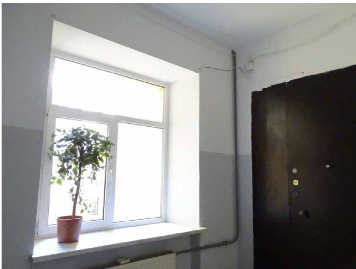
Фото 459. ЛК-6. Площадка между 3-м и 4-м этажом. Съемка 19.04.2021 г. Трушковский В.Э.
