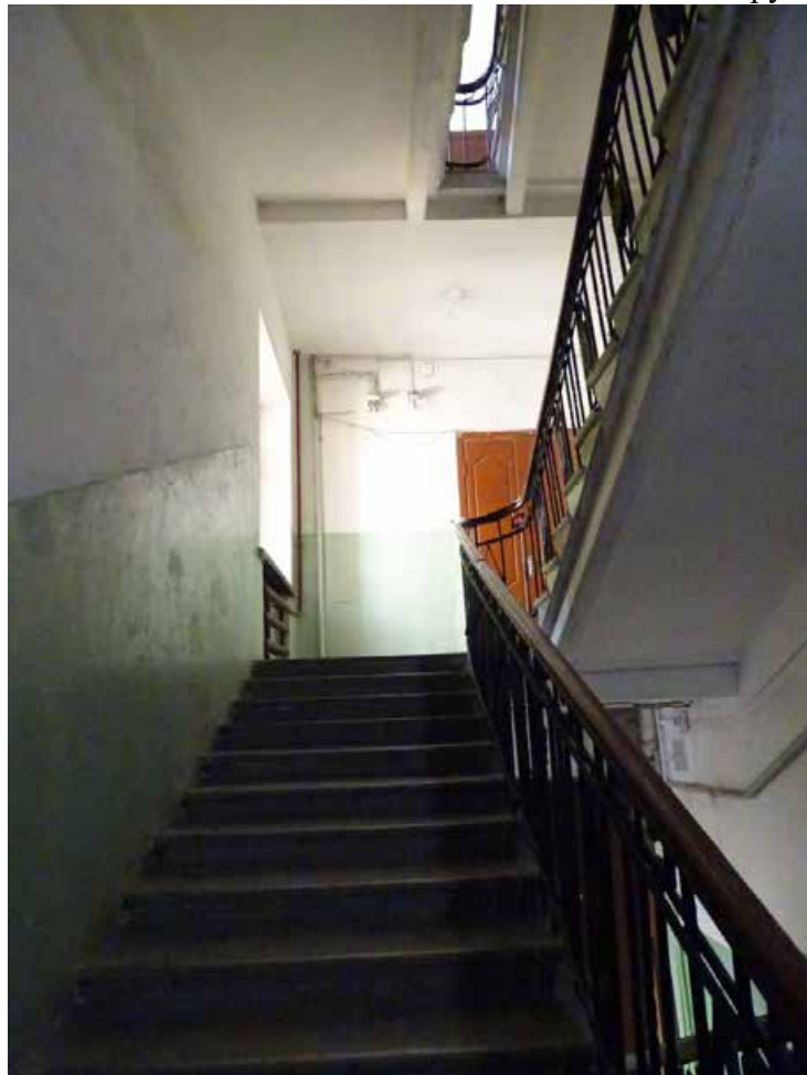
Фото 291. ЛК-1. Площадка между 2-м и 3-м этажом. Съемка 19.04.2021 г. Трушковский В.Э.
