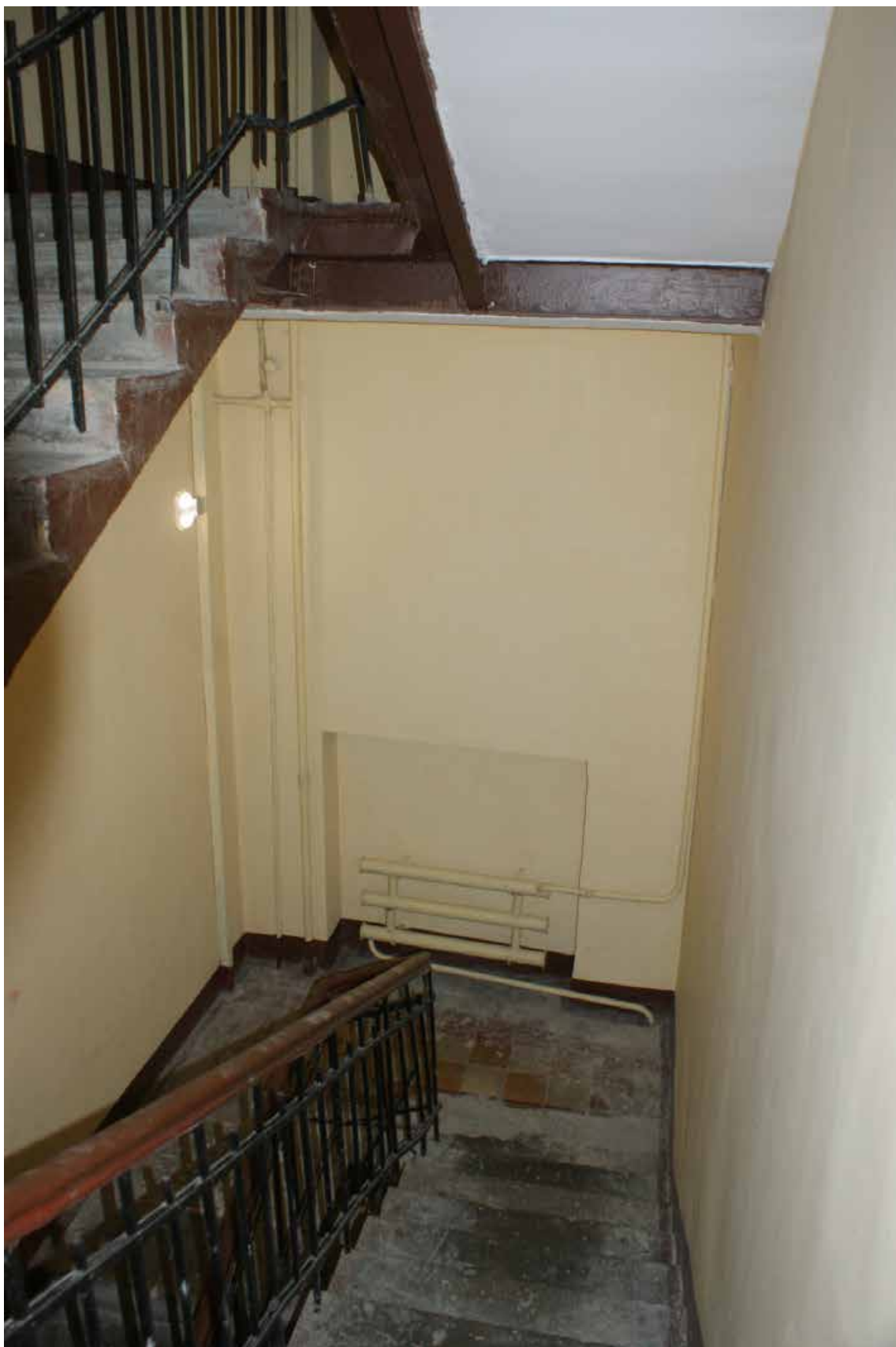
Фото 526. ЛК-9. Вид на площадку между 3-м и 4-м этажом. Съемка 19.04.2021 г. Трушковский В.Э.
