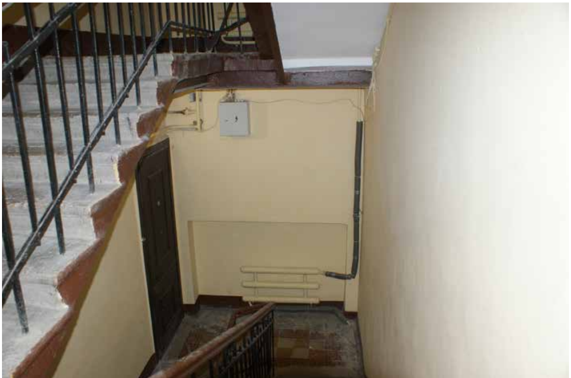
Фото 519. ЛК-9. Площадка между 1-м и 2-м этажом. Съемка 19.04.2021 г. Трушковский В.Э.
