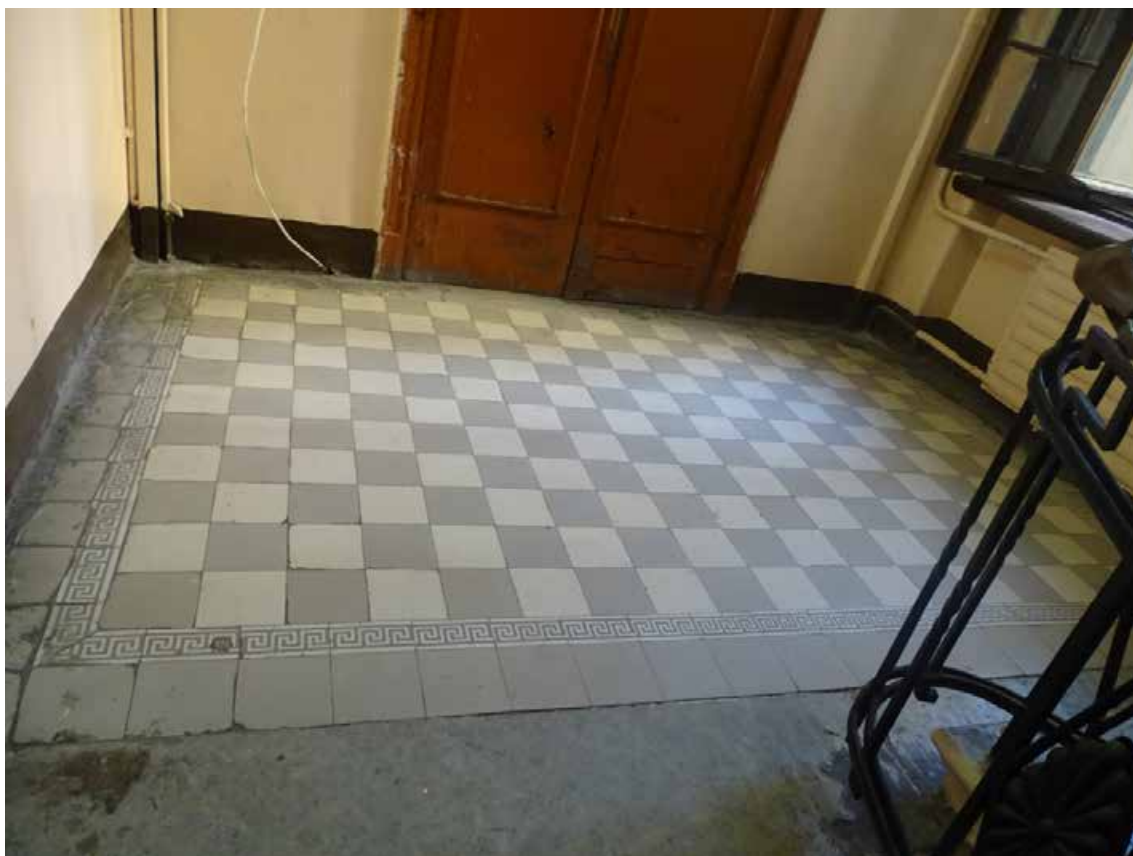
Фото 366. ЛК-3. Площадка между 3-м и 4-м этажом. Съемка 19.04.2021 г. Трушковский В.Э.
