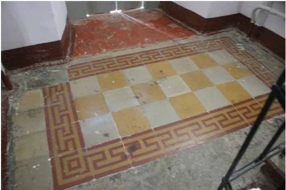
Фото 322. ЛК-2. Площадка между 2-м и 3-м этажом. Съемка 19.04.2021 г. Трушковский В.Э.
