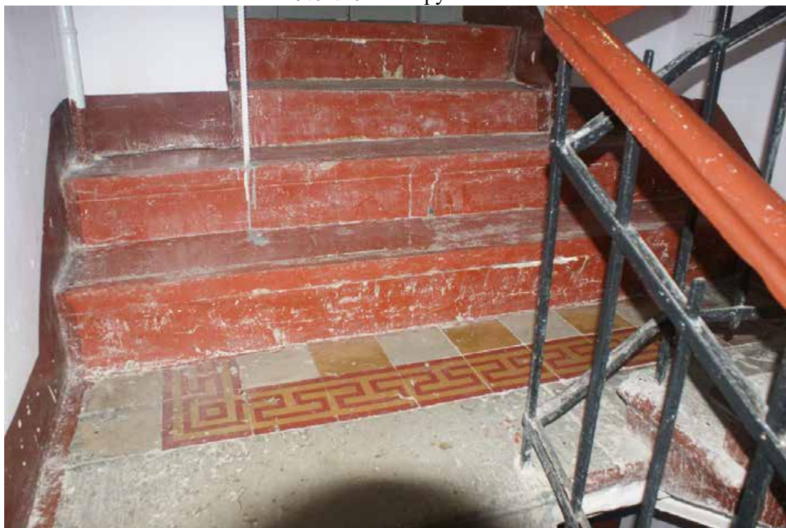
Фото 316. ЛК-2. Площадка между 1-м и 2-м этажом. Съемка 19.04.2021 г. Трушковский В.Э.
