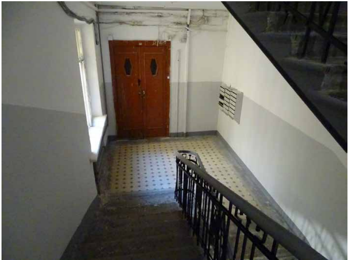
Фото 446. ЛК-6. Площадка между 1-м и 2-м этажом. Съемка 19.04.2021 г. Трушковский В.Э.
