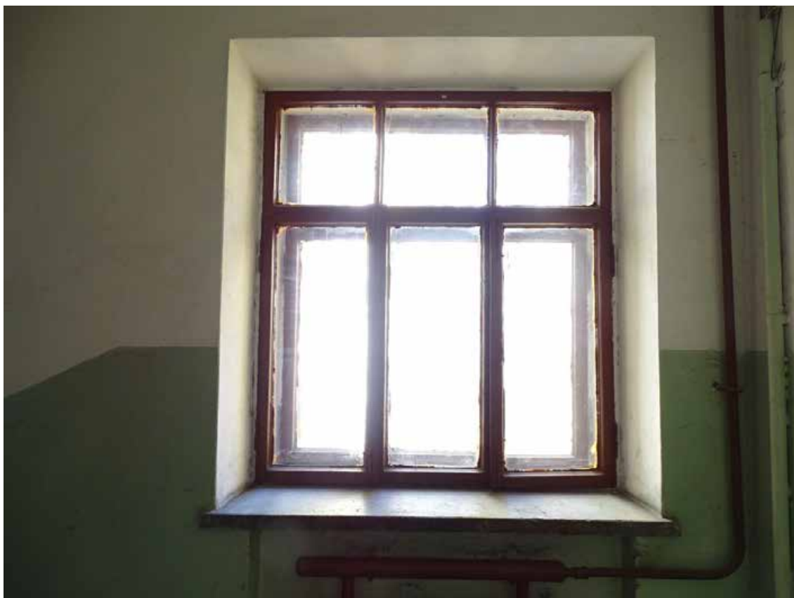
Фото 294. ЛК-1. Площадка между 2-м и 3-м этажом. Оформление окна. Съемка 19.04.2021 г. Трушковский В.Э.
