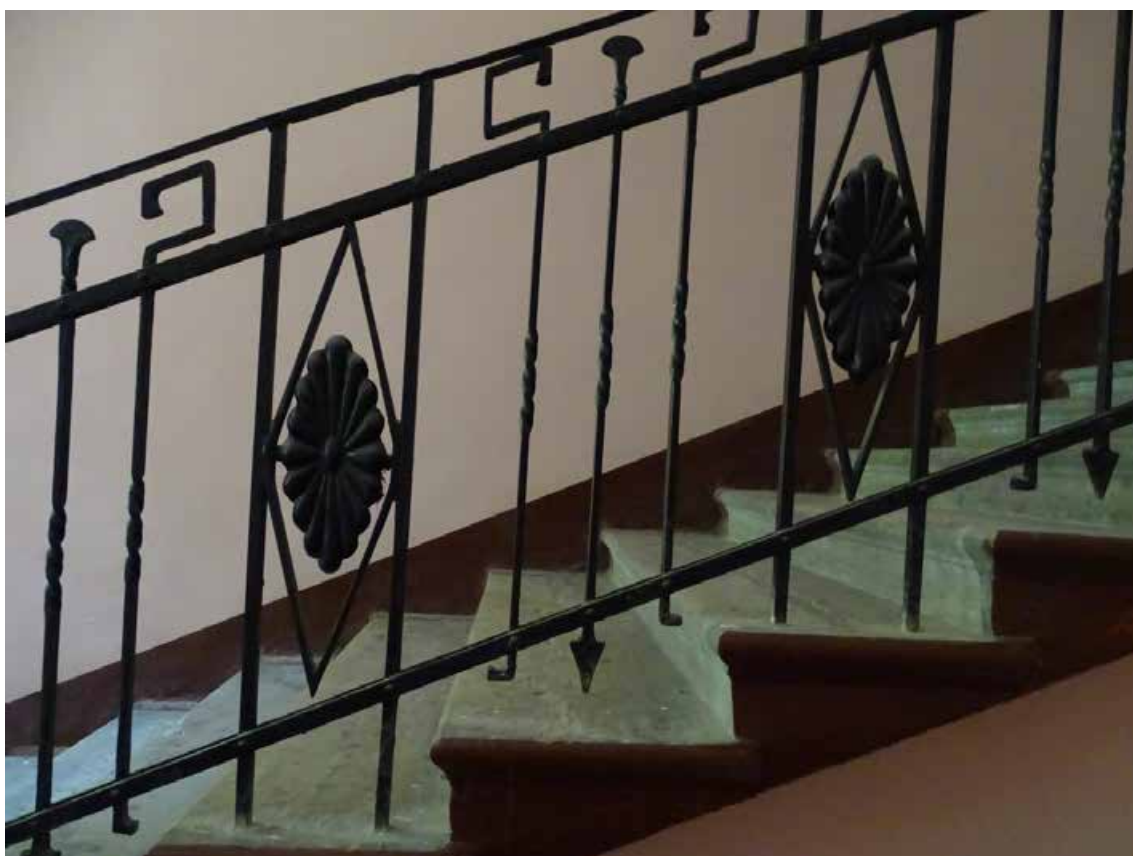
Фото 491. ЛК-8. Площадка между 1-м и 2-м этажом. Лестничное ограждение. Съемка 19.04.2021 г. Трушковский В.Э.
