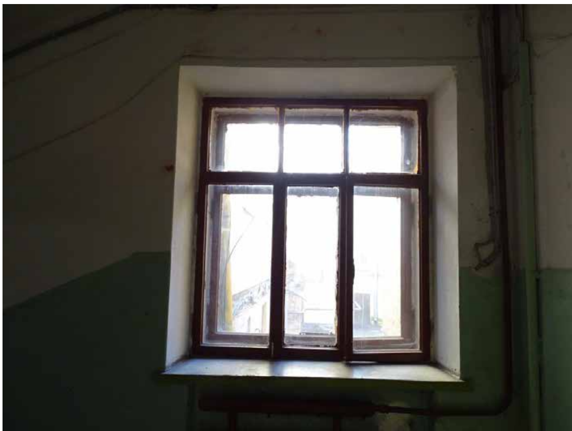
Фото 286. ЛК-1. Площадка между 1-м и 2-м этажом. Съемка 19.04.2021 г. Трушковский В.Э.
