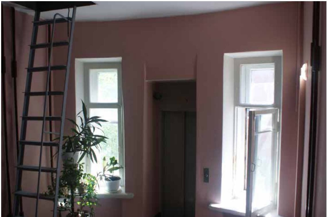
Фото 510. ЛК-8. Площадка между 5-м и 6-м этажом. Съемка 19.04.2021 г. Трушковский В.Э.
