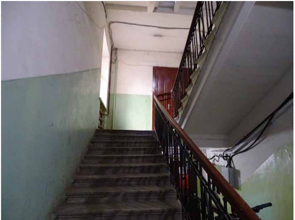
Фото 284. ЛК-1. Площадка между 1-м и 2-м этажом. Съемка 19.04.2021 г. Трушковский В.Э.
