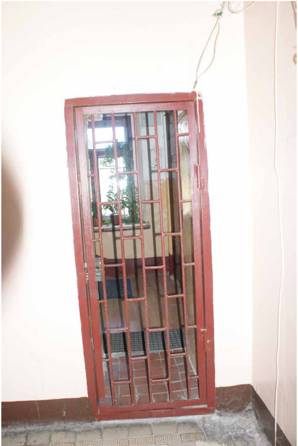
Фото 387. ЛК-3. 6 этаж. Проем, выходящий на соседнюю лестничную клетку. Съемка 19.04.2021 г. Трушковский В.Э.
