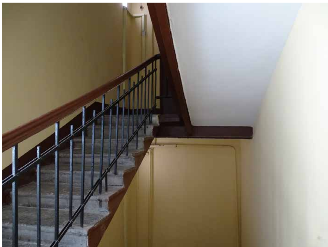
Фото 538. ЛК-9. Площадка между 6-м и 7-м этажом. Съемка 19.04.2021 г. Трушковский В.Э.
