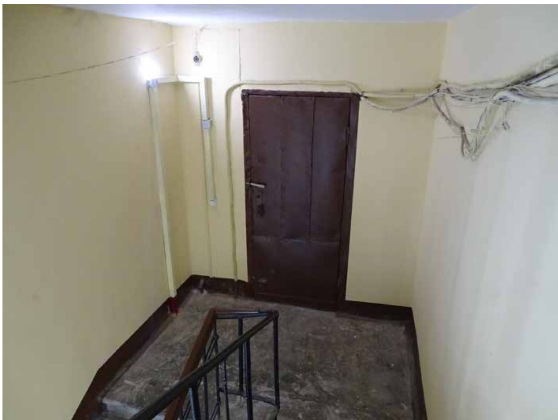
Фото 541. ЛК-9. Технический этаж. Съемка 19.04.2021 г. Трушковский В.Э.
