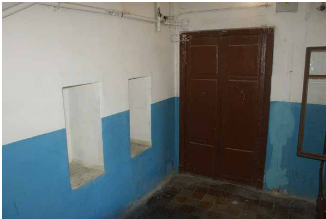
Фото 396. ЛК-5. Площадка между 1-м и 2-м этажом. Съемка 19.04.2021 г. Трушковский В.Э.
