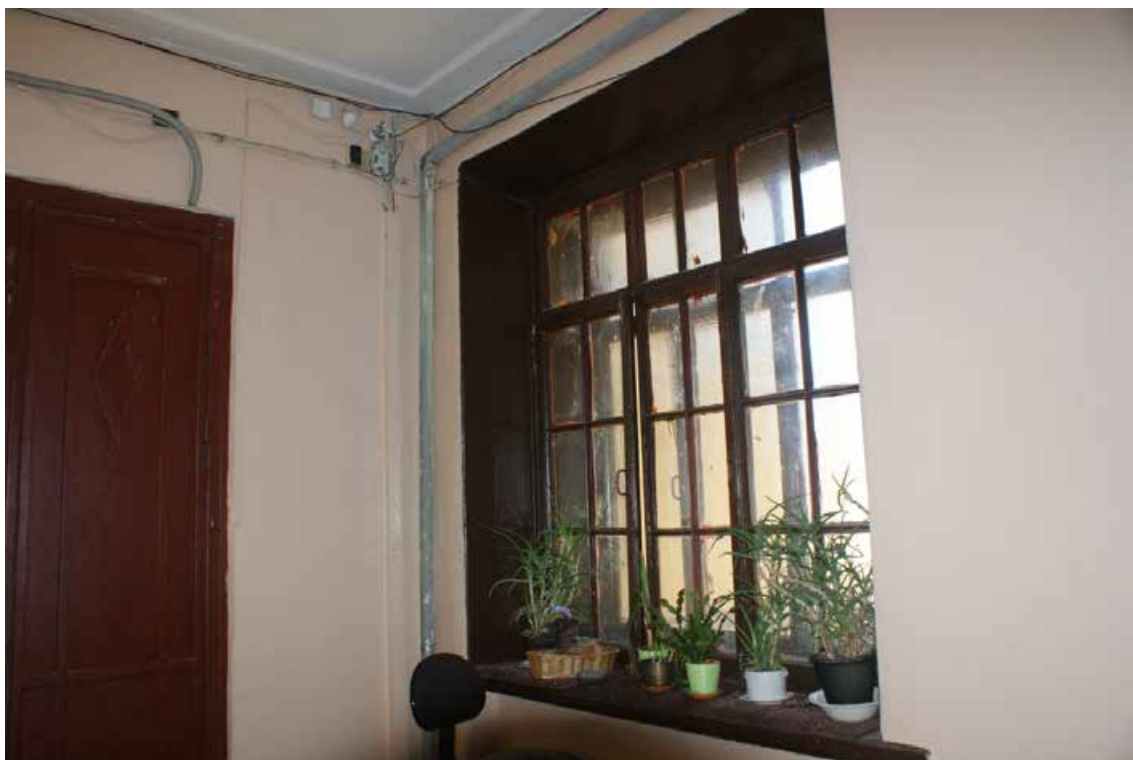
Фото 376. ЛК-3. Площадка между 4-м и 5-м этажом. Съемка 19.04.2021 г. Трушковский В.Э.
