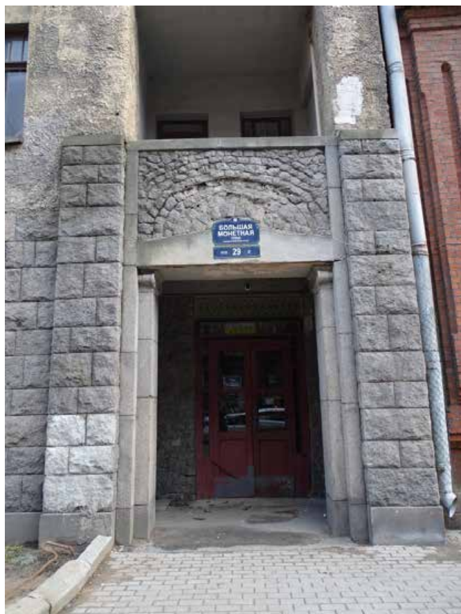
Фото 7. Здание по адресу: г. Санкт-Петербург, Большая Монетная ул., дом 29, литера А. Фрагмент фасада по Большой Монетной ул. Исторический дверной проем. Съемка 19.04.2021 г. Трушковский В.Э.
