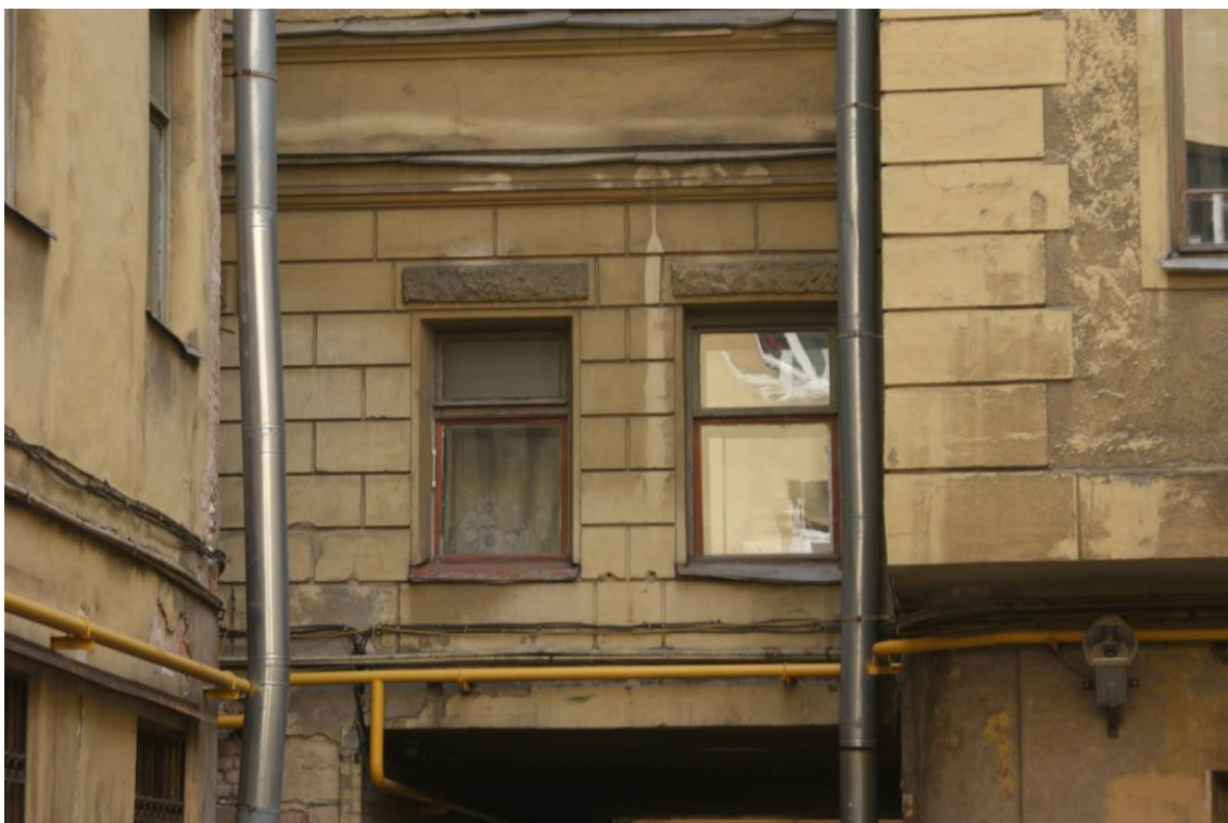
Фото 69. Здание по адресу: г. Санкт-Петербург, Кирочная ул., 22. Фрагмент южного фасада северного внутреннего двора. 2-й этаж. Съемка 26.04.2021 г. Трушковский В.Э.
