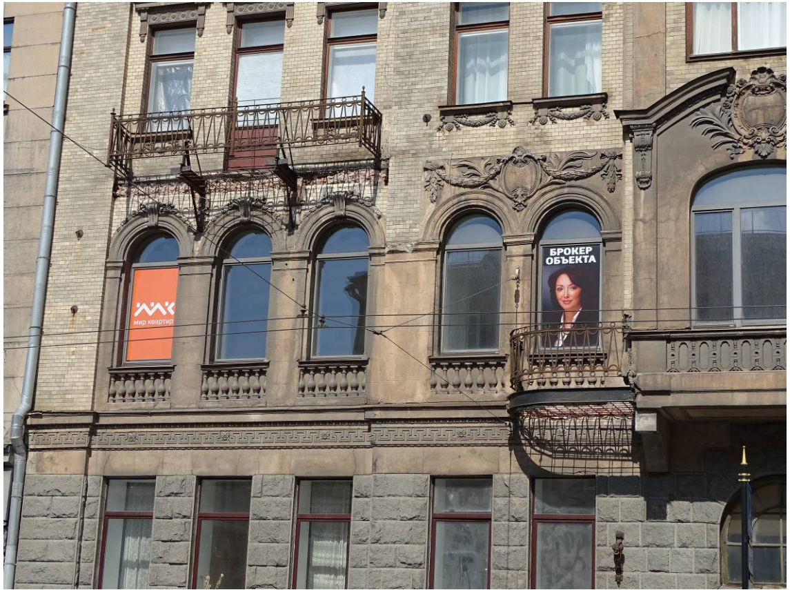
Фото 40. Здание по адресу: г. Санкт-Петербург, Кирочная ул., 22. Фрагмент лицевого фасада. 2-й этаж. Провисающие гирлянды над оконными перемычками.
