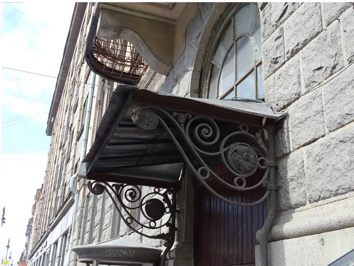
Фото 51. Здание по адресу: г. Санкт-Петербург, Кирочная ул., 22. Фрагмент лицевого фасада. Козырек. Съемка 26.04.2021 г. Трушковский В.Э.
