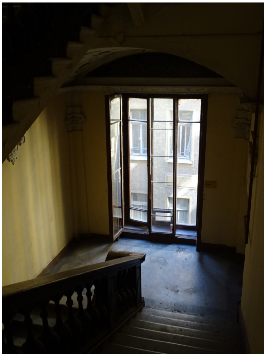
Фото 205. Лестница № 1: Площадка между 3-м и 4-м этажом. Съемка 26.04.2021 г. Трушковский В.Э.
