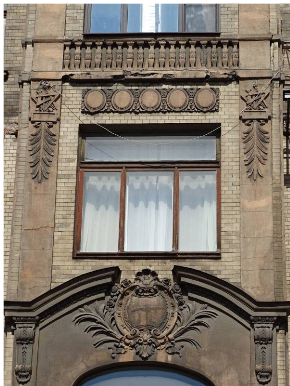
Фото 43. Здание по адресу: г. Санкт-Петербург, Кирочная ул., 22. Фрагмент лицевого фасада. Эркер. Оформление оконного проема в уровне 3-го этажа. Съемка 26.04.2021 г. Трушковский В.Э.
