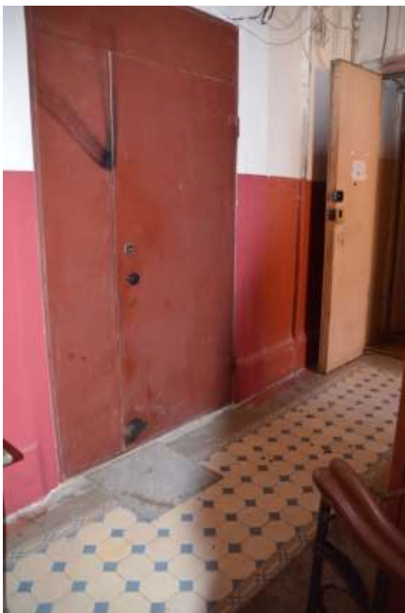
Фото 55. Выявленный объект культурного наследия «П. М. Станового», расположенный по адресу Санкт-Петербург, 8-я Советская улица, д. 48, литера А. Вид лестницы. Съемка 26.04.2021.Егорова Т. Г.
