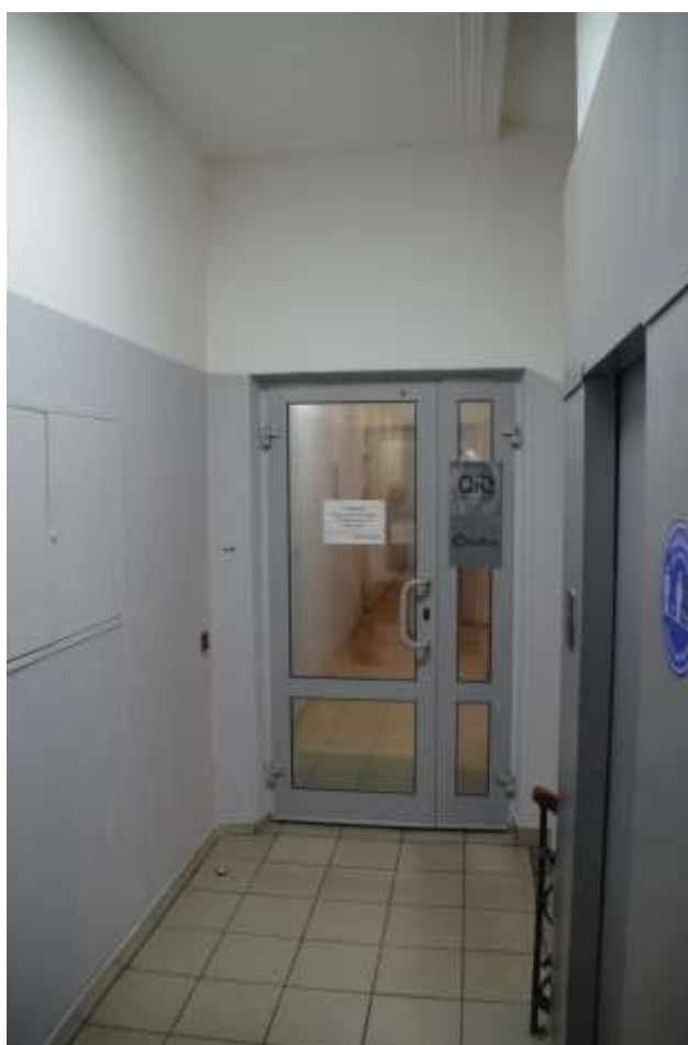
Фото 21. Выявленный объект культурного наследия «Дом П. М. Станового», расположенный по адресу Санкт-Петербург, 8-я Советская улица, д. 48, литера А. Вид площадки 2-го этажа лестницы по Мытнинской ул. Съемка 26.04.2021.Егорова Т. Г.
