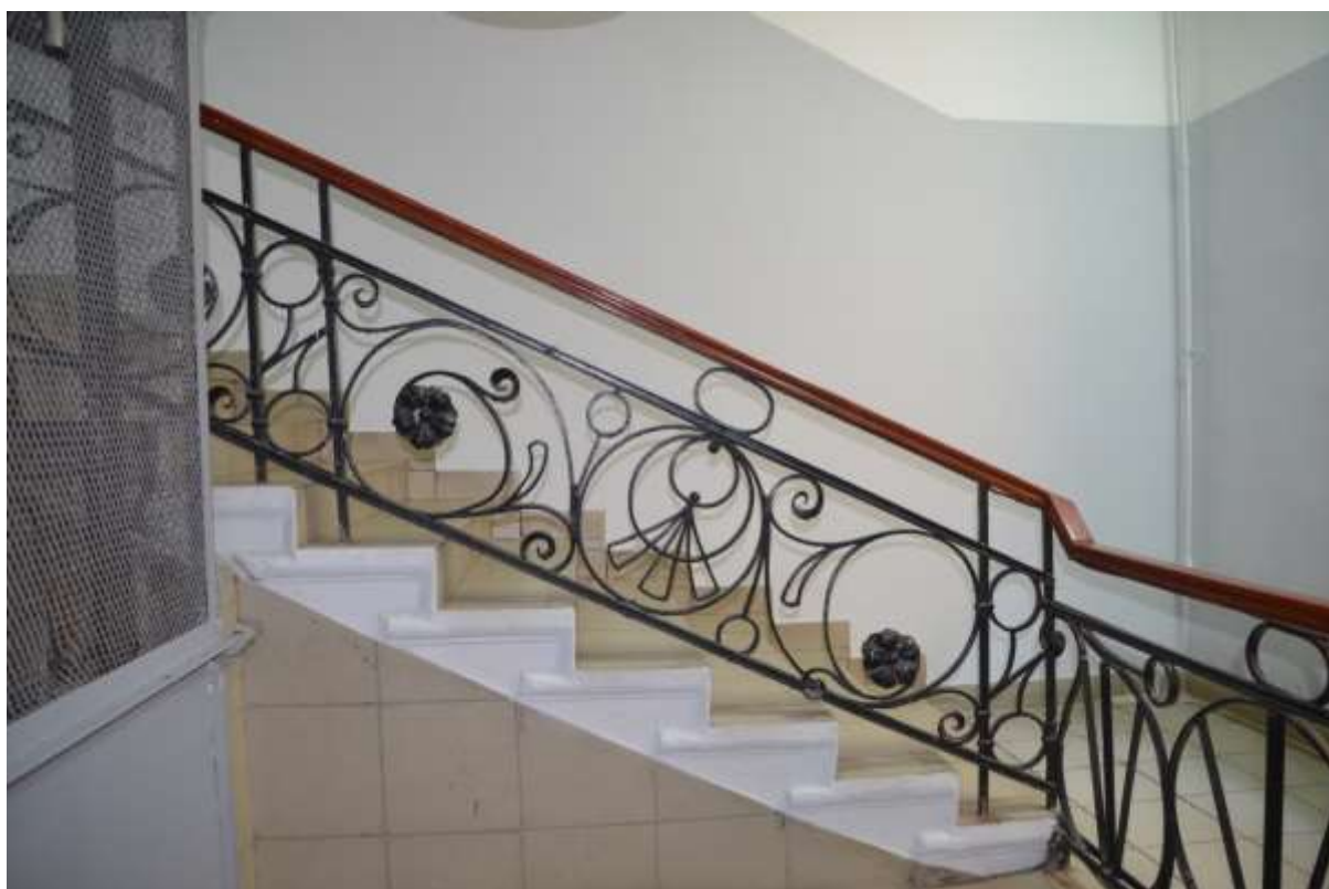
Фото 48. Выявленный объект культурного наследия «Дом П. М. Станового», расположенный по адресу Санкт-Петербург, 8-я Советская улица, д. 48, литера А. Вид ограждения лестницы (по Мытнинской ул.). Съемка 26.04.2021.Егорова Т. Г.
