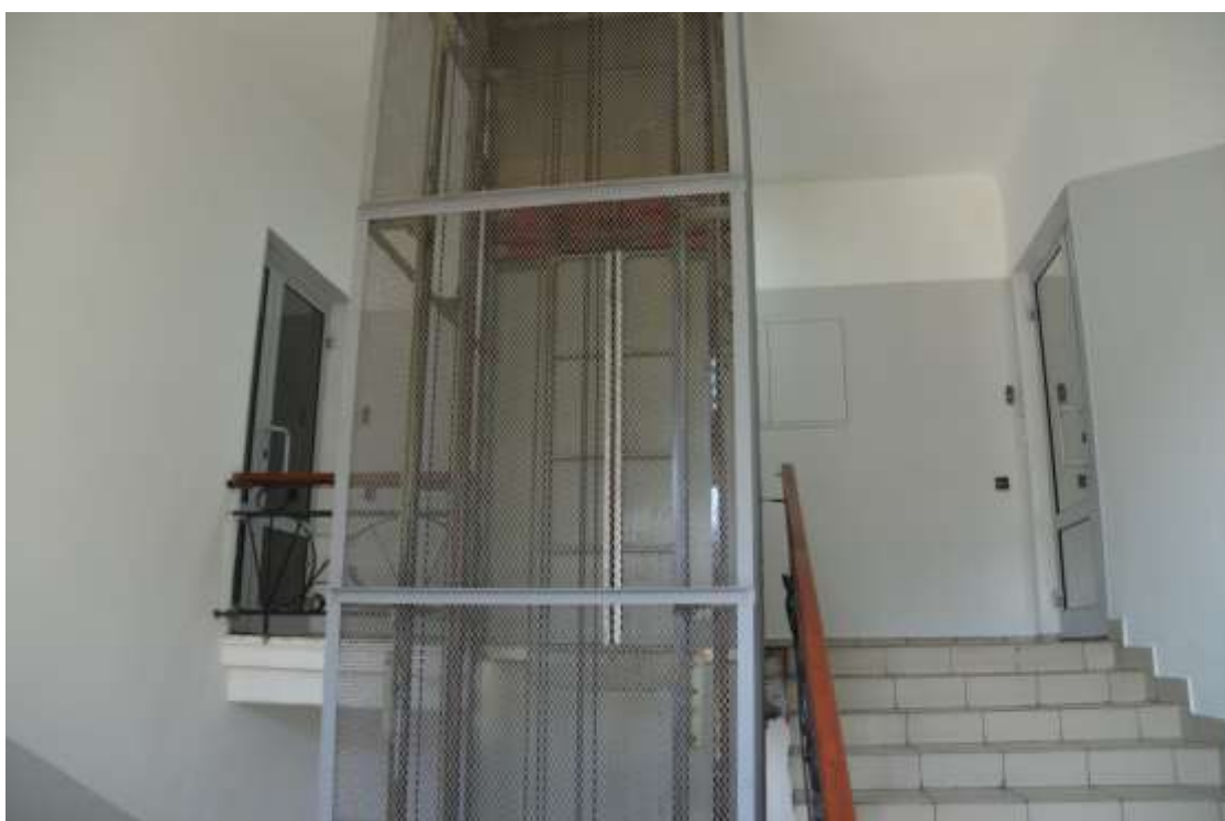
Фото 43. Выявленный объект культурного наследия «Дом П. М. Станового», расположенный по адресу Санкт-Петербург, 8-я Советская улица, д. 48, литера А. Вид площадки 6-го этажа. Съемка 26.04.2021. Егорова Т. Г.
