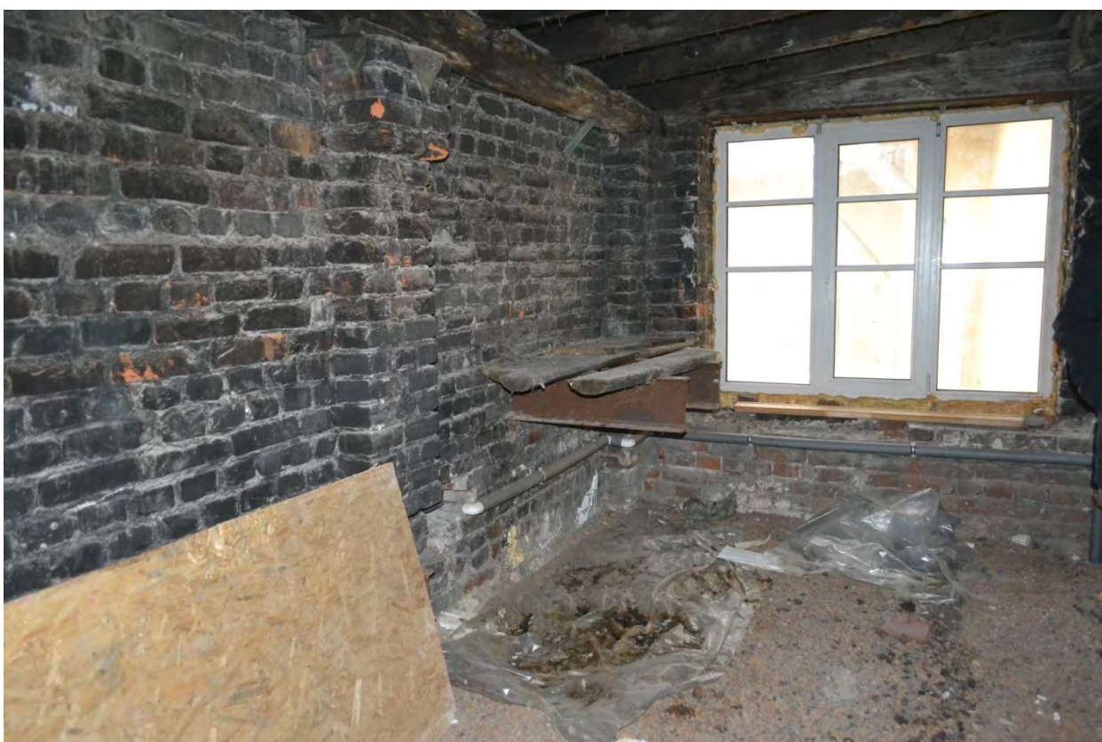
Фото 40. Чердачное пространство Общежития №1. Секция №2. Вид на место протечки кровли.
