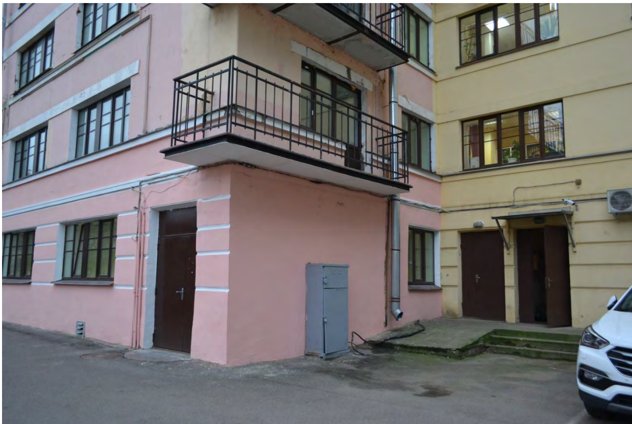
Фото 25. Входные группы со стороны дворового фасада Общежития №1 («Жилой корпус»). Секции №2 и №3. Вид с северо-востока.
