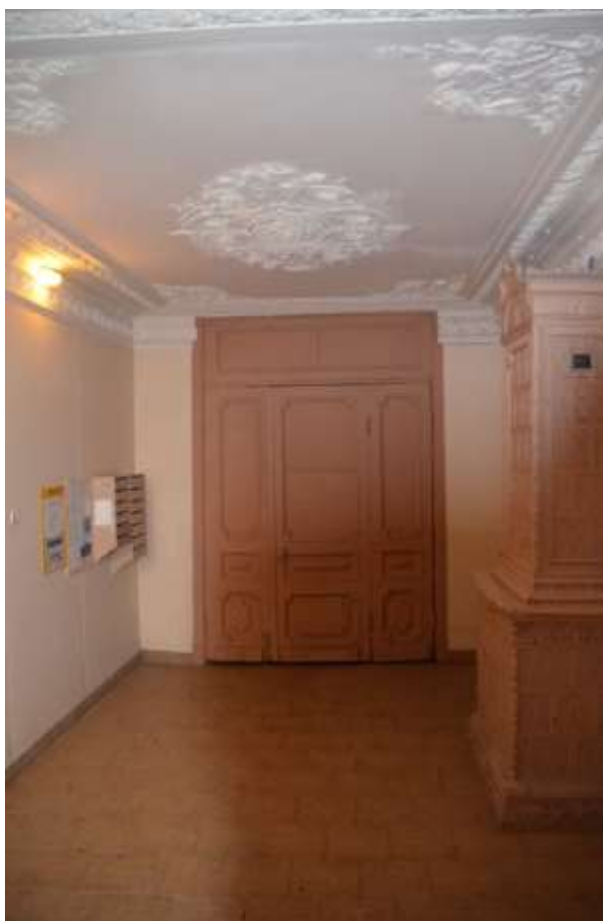
Фото 07. Выявленный объект культурного наследия «Дом И. С. Мальцева», расположенный по адресу Санкт-Петербург, Басков пер., 41/29, литера А (Басков пер., 41, ул. Радищева, 29). Вестибюль парадной лестницы по Баскову переулку. Съемка 26.04.2021. Егорова Т. Г.
