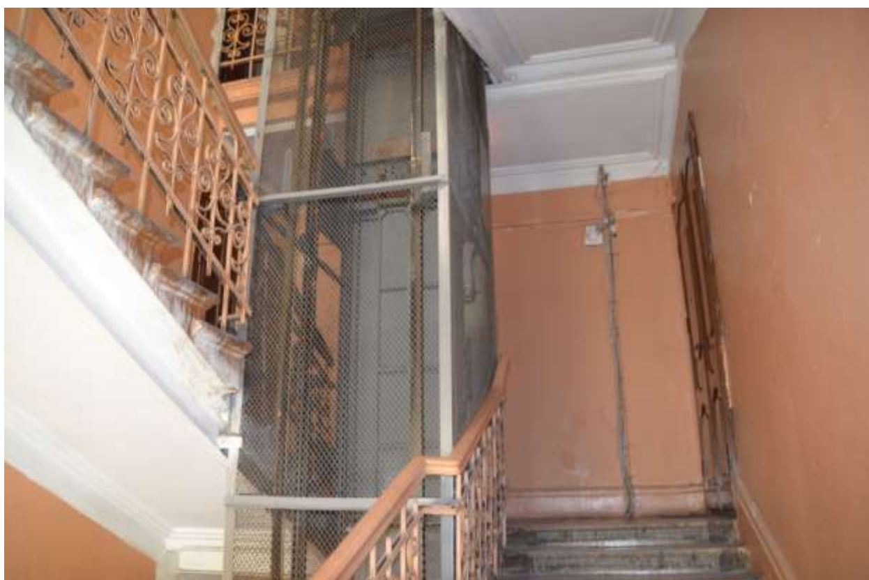
Фото 34. Выявленный объект культурного наследия «Дом И. С. Мальцева», расположенный по адресу Санкт-Петербург, Басков пер., 41/29, литера А (Басков пер., 41, ул. Радищева, 29). Вид парадной лестницы по ул. Радищева. Съемка 26.04.2021. Егорова Т. Г.
