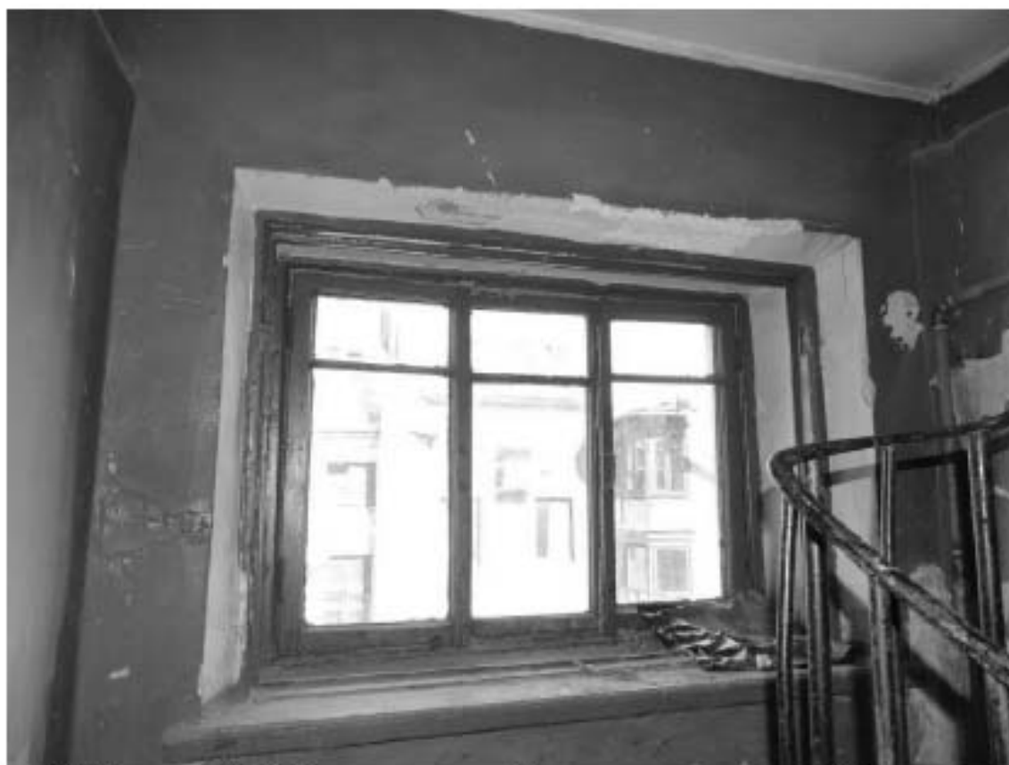
Фото 142. Лестница № 12: Площадка между 7-м и чердачным этажом. Оформление окна. Съемка 19.04.2021 г. Михайловская Г. В.
