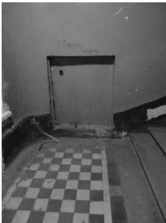
Фото 275. Лестница № 5: Площадка между 1-м и 2-м этажом. Ниша в стене. Съемка 19.04.2021 г. Михайловская Г. В.
