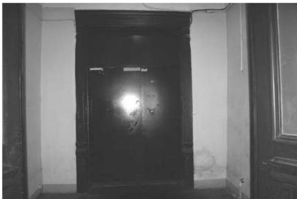
Фото 229. Лестница № 4: 1-й этаж. Входной тамбур. Заполнение дверного проема. Съемка 19.04.2021 г. Михайловская Г. В.
