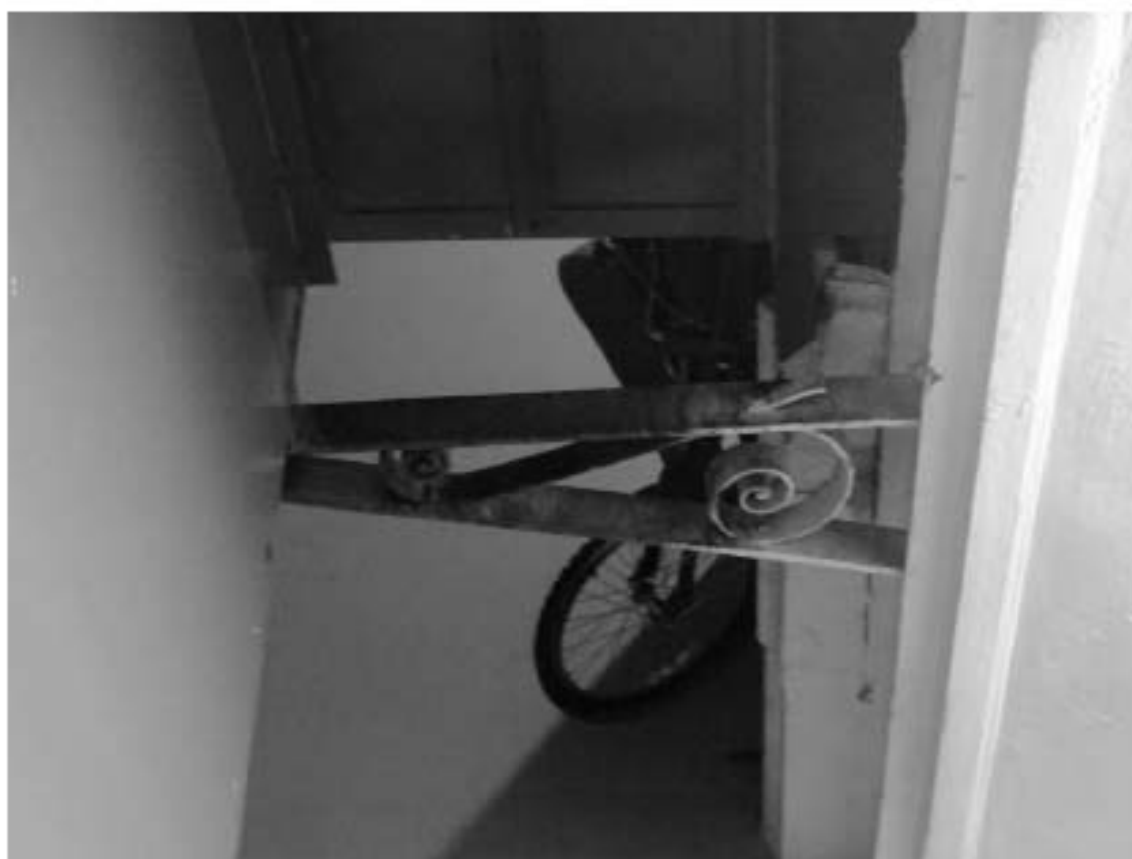
Фото 255. Лестница № 4: 6-й этаж. Кронштейн. Съемка 19.04.2021 г. Михайловская Г. В.
