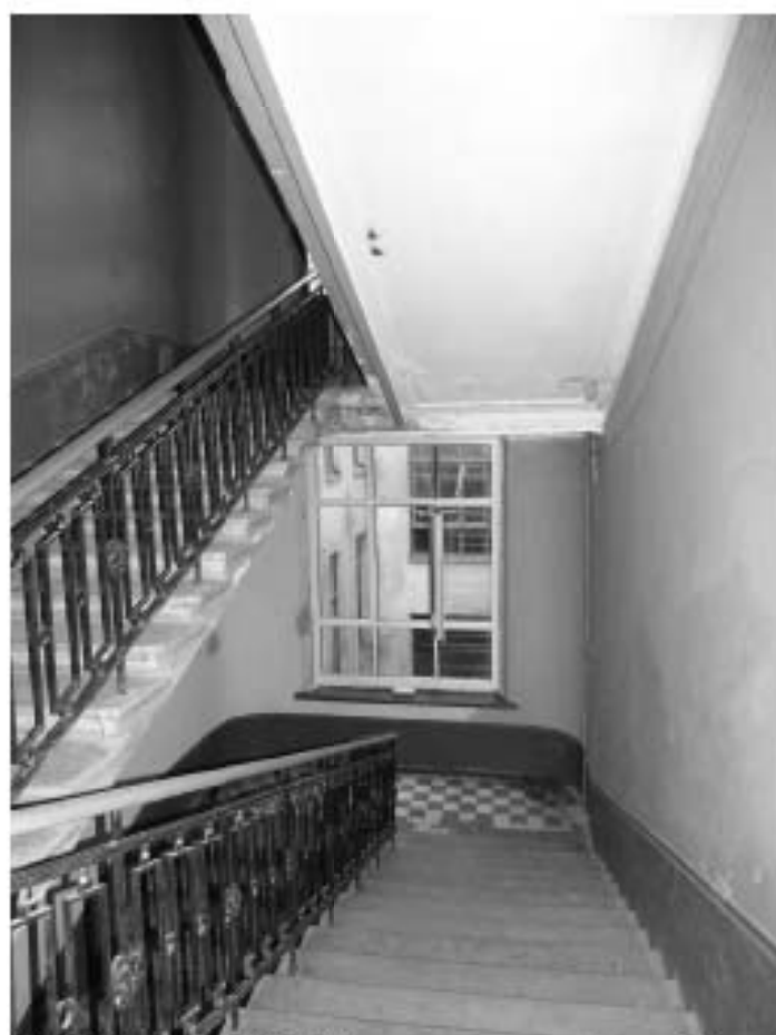
Фото 220. Лестница № 3: Площадка между 5-м и 6-м этажом. Съемка 19.04.2021 г. Михайловская Г. В.
