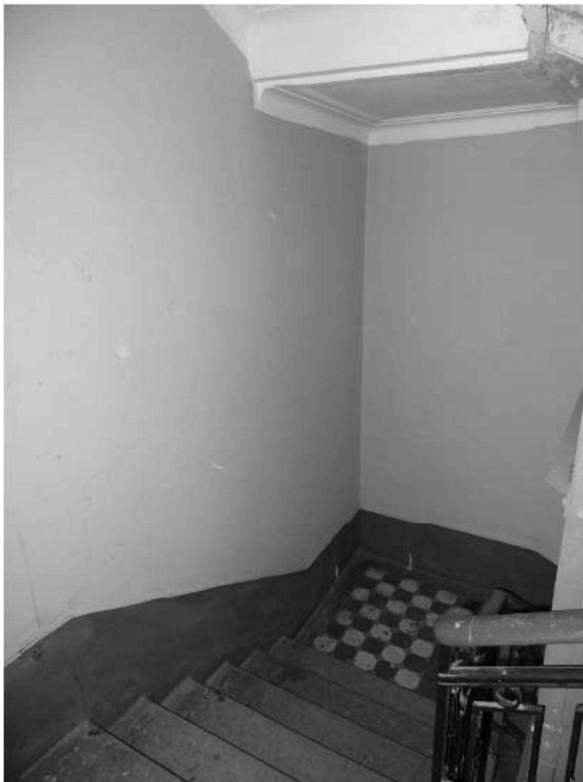
Фото 251. Лестница № 4: Лестничная площадка между 5-м и 6-м этажом. Съемка 19.04.2021 г. Михайловская Г. В.
