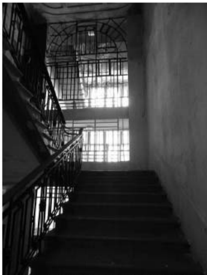
Фото 38. Лестница № 1: Вид с площадки между 6-м и 7-м этажом. Съемка 19.04.2021 г. Михайловская Г. В.
