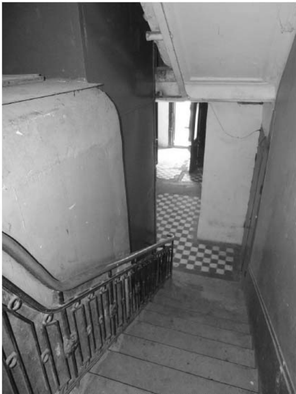
Фото 306. Лестница № 6: Лестничный марш на площадку между 1-м и 2-м этажом. Съемка 19.04.2021 г. Михайловская Г. В.
