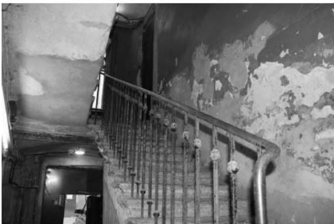
Фото 147. Лестница № 13: 1-й этаж. Лестничный марш на площадку между 1-м и 2-м этажом. Съемка 19.04.2021 г. Михайловская Г. В.
