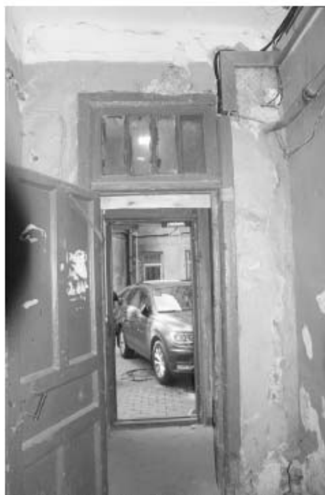
Фото 336. Лестница № 7: 1-й этаж. Вестибюль. Заполнение дверного проема. Съемка 19.04.2021 г. Михайловская Г. В.
