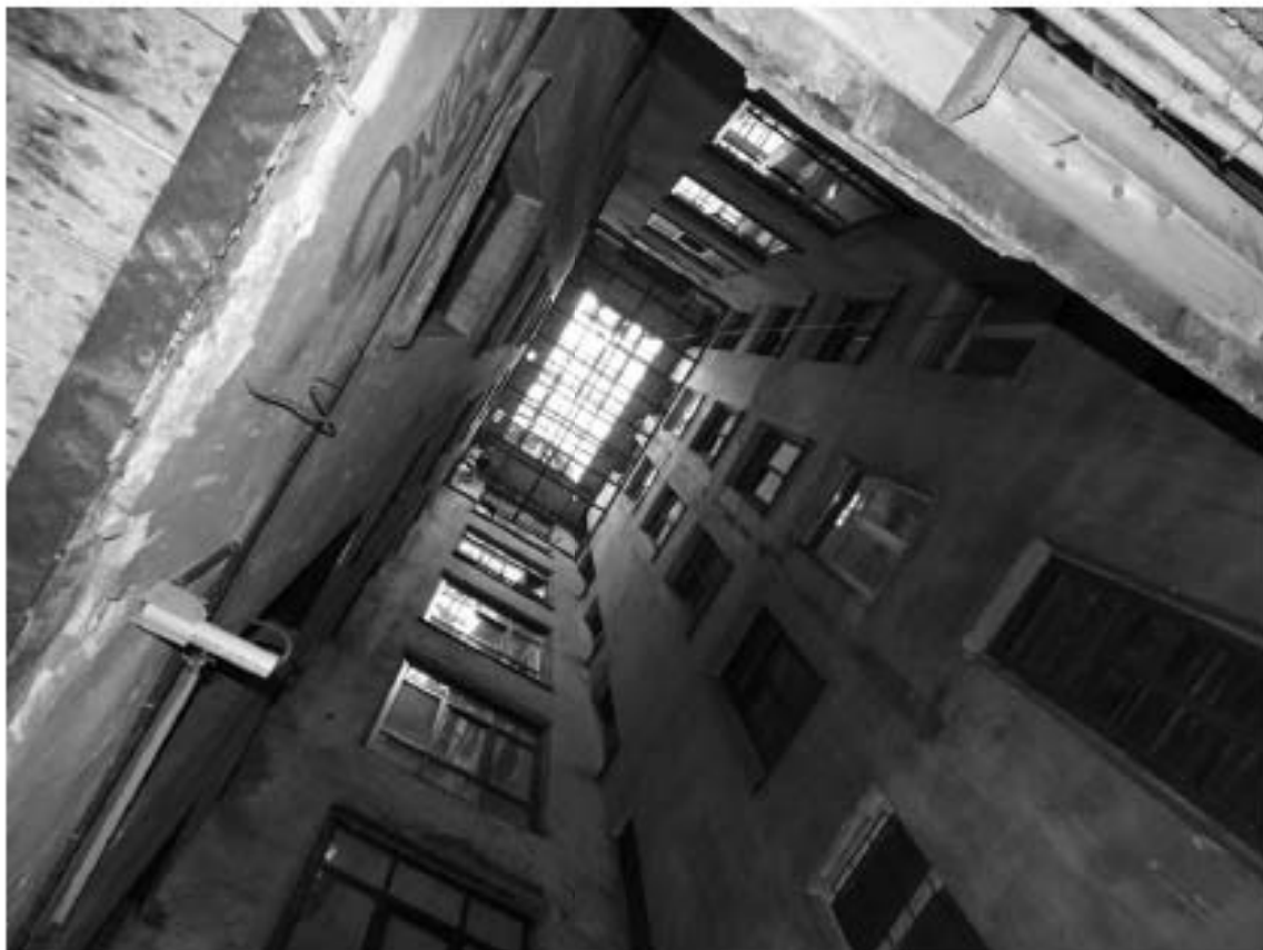
Фото 32. Здание по адресу: г. Санкт-Петербург, Большой проспект П.С., дом 74, литера А. Проезд между западным и восточным двором. Световой колодец. Съемка 19.04.2021 г. Михайловская Г. В.
