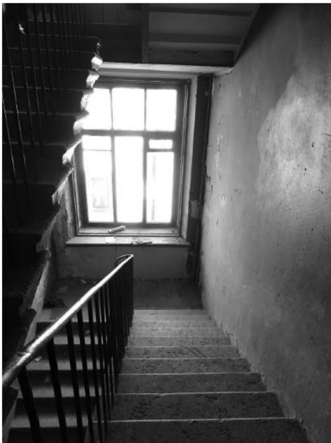
Фото 139. Лестница № 12: Площадка между 6-м и 7-м этажом. Съемка 19.04.2021 г. Михайловская Г. В.
