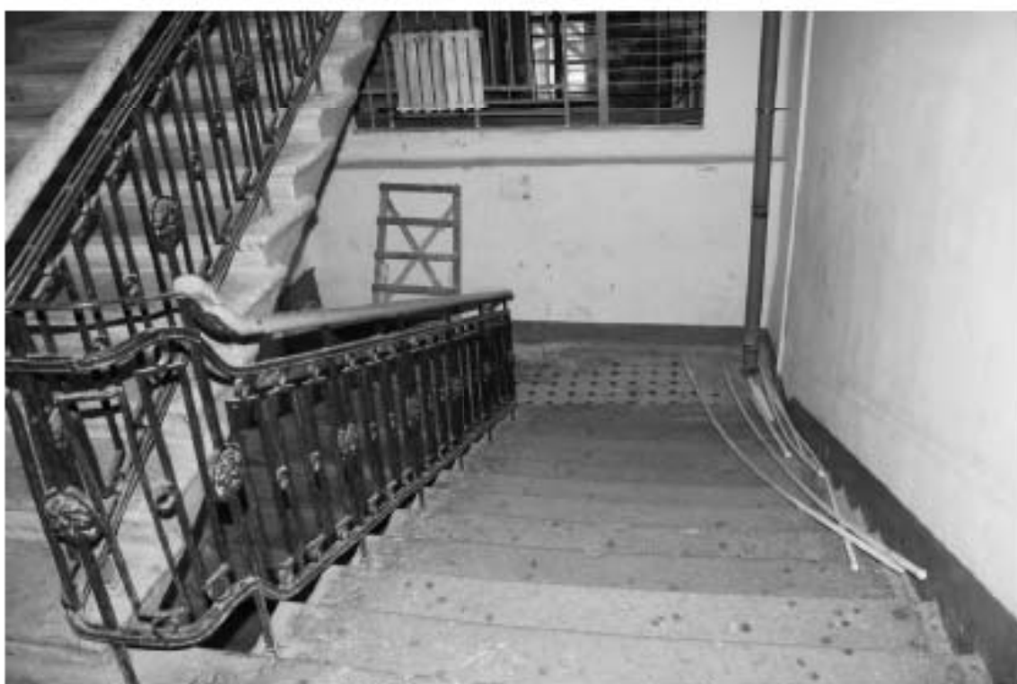
Фото 47. Лестница № 2: Вид на площадку между 1-м и 2-м этажом. Съемка 19.04.2021 г. Михайловская Г. В.
