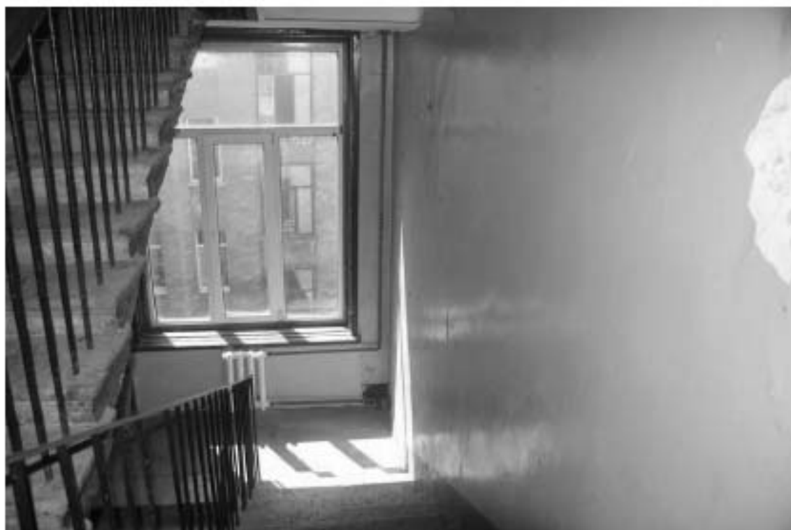
Фото 372. Лестница № 8: Площадка между 4-м и 5-м этажом. Съемка 19.04.2021 г. Михайловская Г. В.
