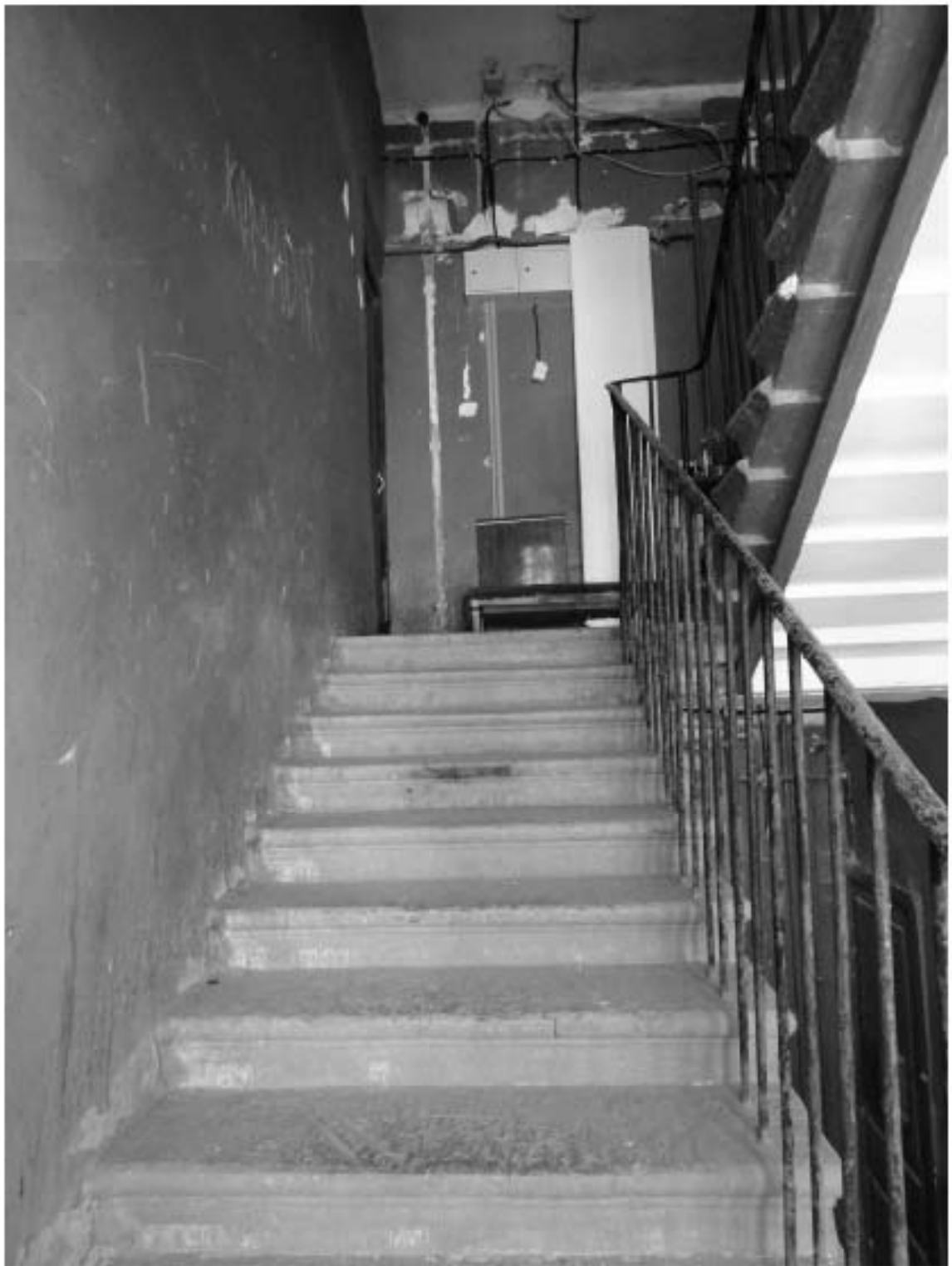
Фото 140. Лестница № 12: Лестничный марш на площадку 7-го этажа. Съемка 19.04.2021 г. Михайловская Г. В.
