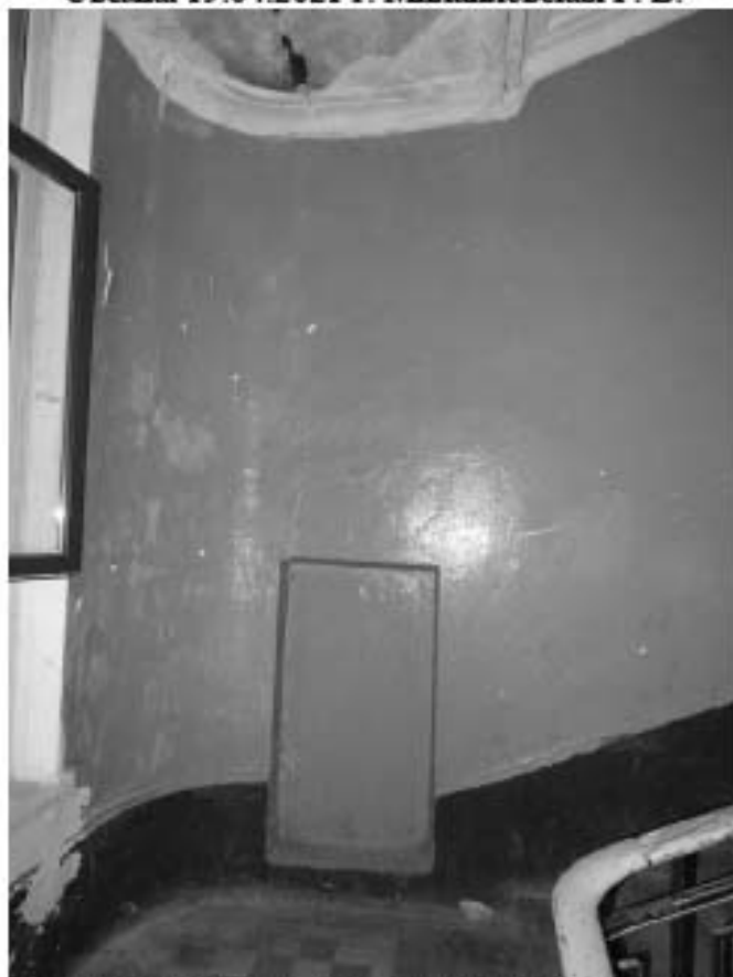
Фото 282. Лестница № 5: Площадка между 2-м и 3-м этажом. Ниша в стене. Съемка 19.04.2021 г. Михайловская Г. В.
