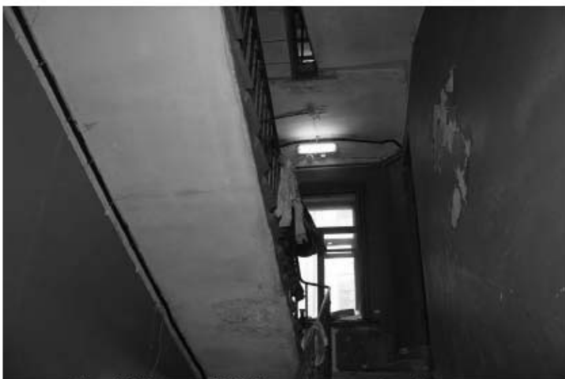
Фото 155. Лестница № 13: Площадка между 2-м и 3-м этажом. Съемка 19.04.2021 г. Михайловская Г. В.
