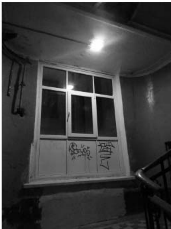
Фото 272. Лестница № 5: Площадка между 1-м и 2-м этажом. Съемка 19.04.2021 г. Михайловская Г. В.
