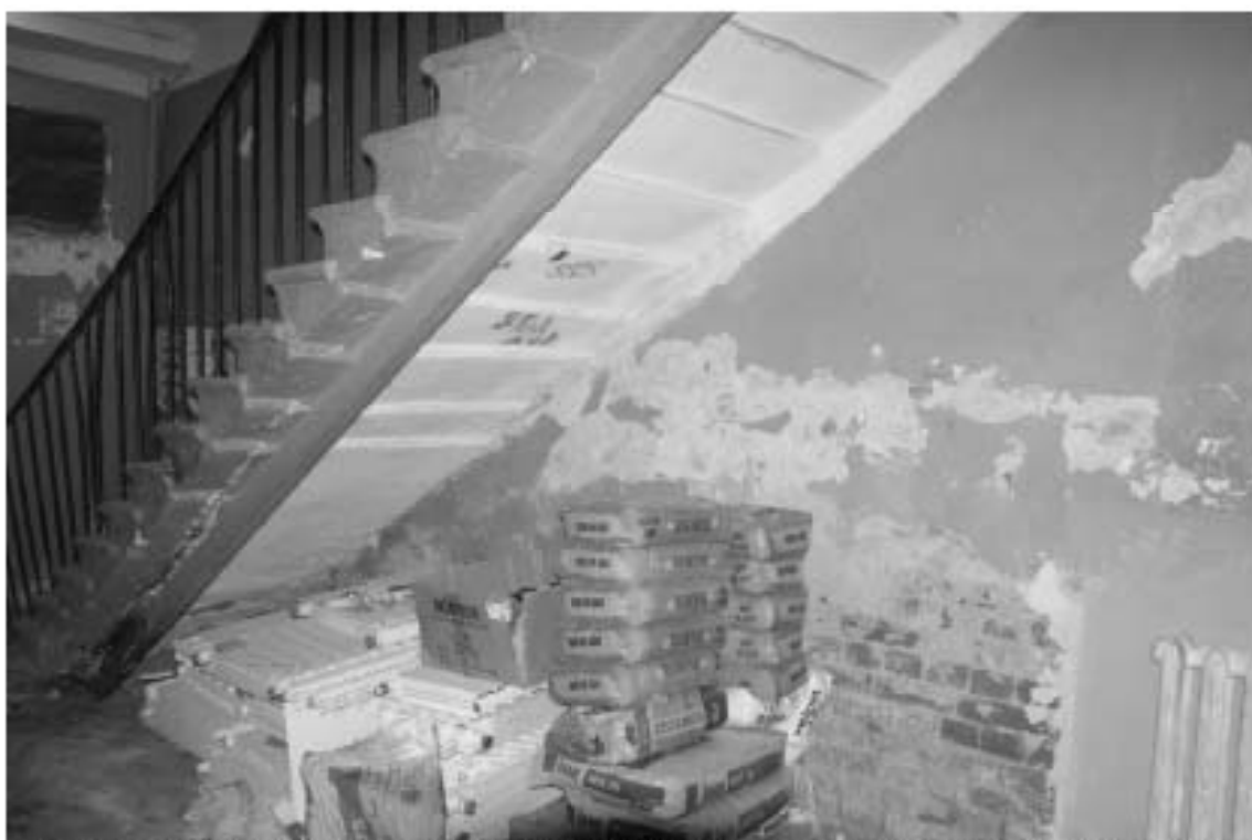
Фото 338. Лестница № 7: 1-й этаж. Вестибюль. Пространство под лестницей. Съемка 19.04.2021 г. Михайловская Г. В.
