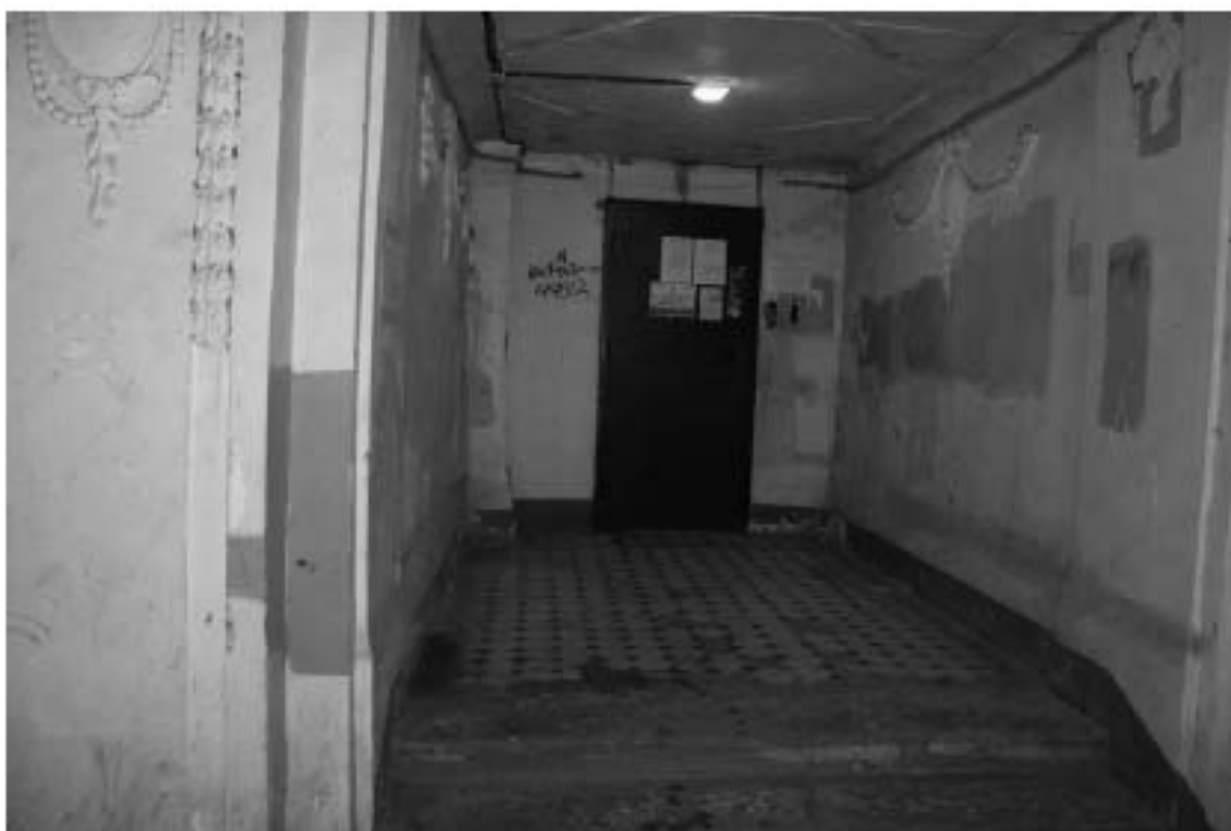
Фото 262. 1-й этаж. Вестибюль по Большому проспекту. Вид на дверь 1-й лестницы. Съемка 19.04.2021 г. Михайловская Г. В.
