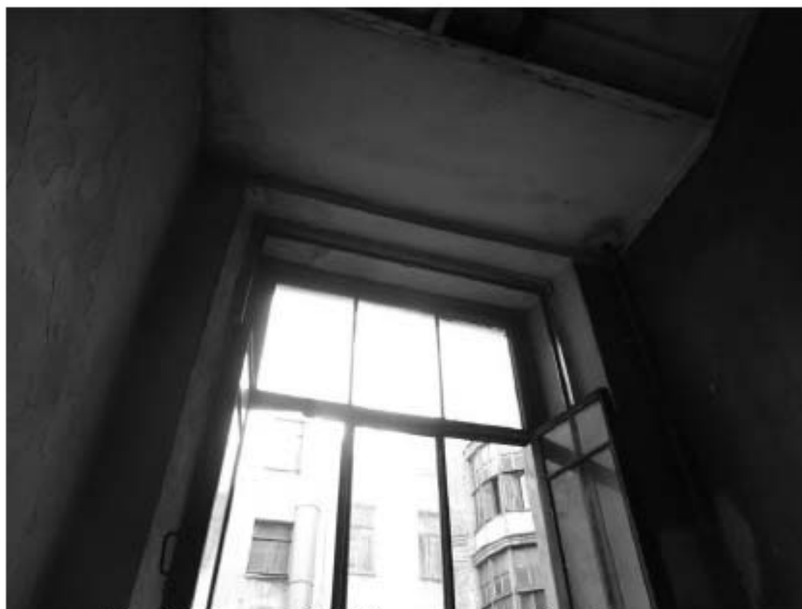
Фото 128. Лестница № 12: Площадка между 2-м и 3-м этажом. Съемка 19.04.2021 г. Михайловская Г. В.
