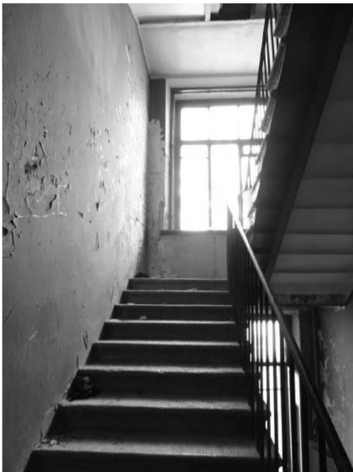
Фото 138. Лестница № 12: Площадка между 6-м и 7-м этажом. Съемка 19.04.2021 г. Михайловская Г. В.
