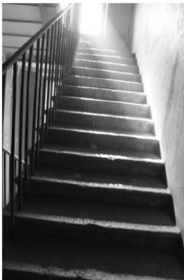
Фото 171. Лестница № 13: Лестничный марш на площадку между 7-м и чердачным этажом. Съемка 19.04.2021 г. Михайловская Г. В.
