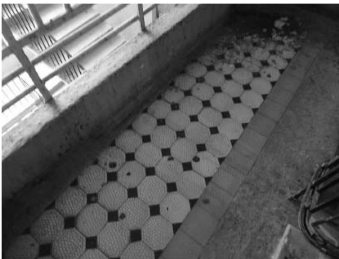
Фото 35. Лестница № 1: Площадка между 5-м и 6-м этажом. Покрытие пола. Съемка 19.04.2021 г. Михайловская Г. В.
