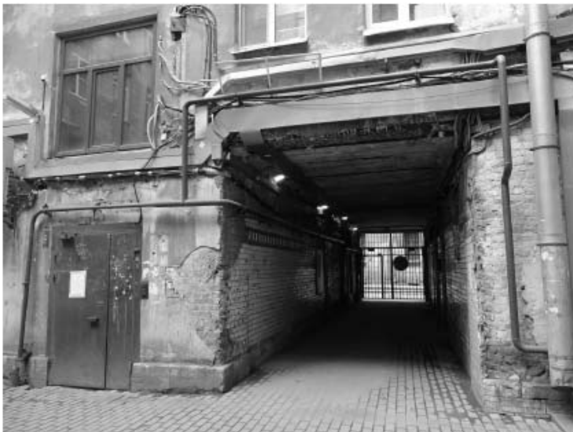
Фото 26. Здание по адресу: г. Санкт-Петербург, Большой проспект П.С., дом 74, литера А. Въездная арка с Бармалеевой ул. Съемка 19.04.2021 г. Михайловская Г. В.
