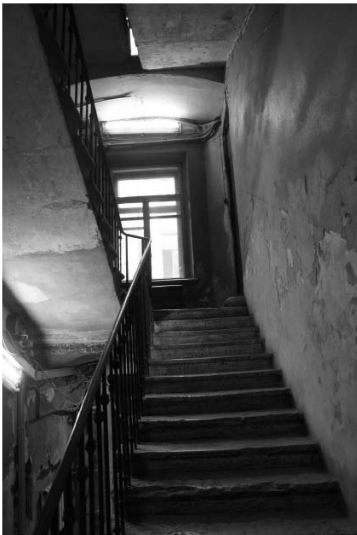
Фото 150. Лестница № 13: Площадка между 1-м и 2-м этажом. Съемка 19.04.2021 г. Михайловская Г. В.
