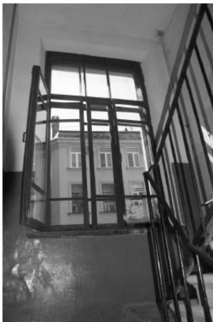
Фото 122. 5ЛК. Площадка между 3-м и 4-м этажом. Съемка 19.04.2021 г. Михайловская Г. В.
