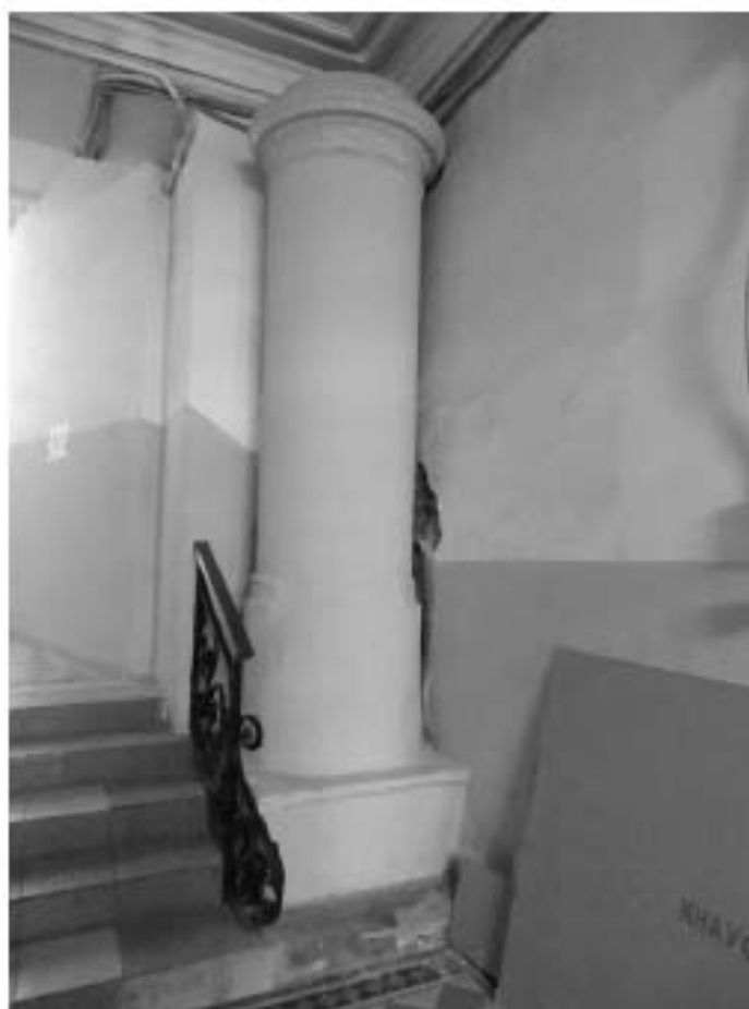
Фото 7. 2ЛК. 1-й этаж. Вестибюль. Печь. Съемка 19.04.2021 г. Михайловская Г. В.
