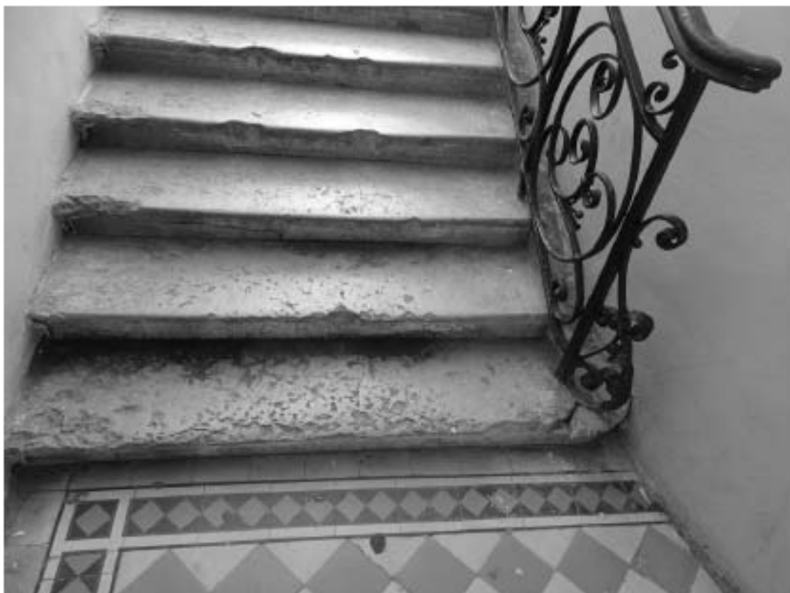
Фото 13. 2ЛК. 1-й этаж. Вестибюль. Ступени лестничного марша. Съемка 19.04.2021 г. Михайловская Г. В.
