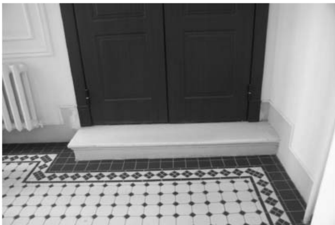
Фото 38. 4ЛК. 1-й этаж. Ступень ко входу квартиры. Съемка 19.04.2021 г. Михайловская Г. В.
