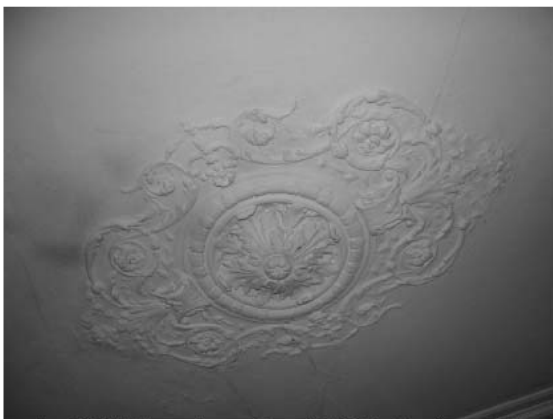
Фото 84. 1ЛК. 5-й этаж. Розетка. Съемка 19.04.2021 г. Михайловская Г. В.
