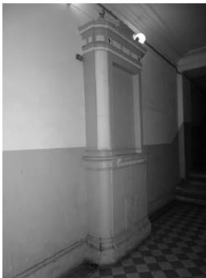
Фото 66. 1ЛК. 1-й этаж. Вестибюль. Печь. Съемка 19.04.2021 г. Михайловская Г. В.
