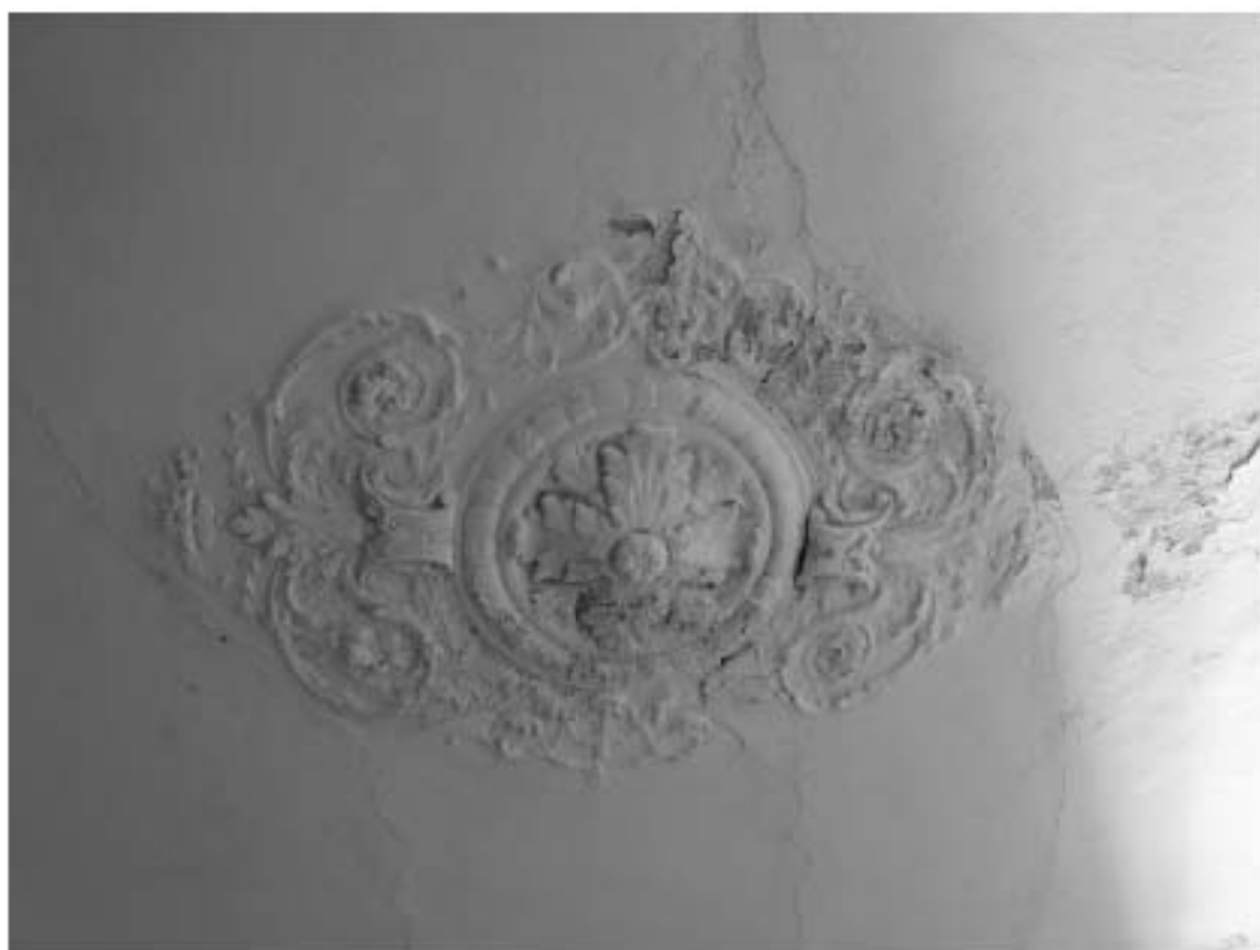
Фото 62. 4ЛК. 5-й этаж. Розетка. Съемка 19.04.2021 г. Михайловская Г. В.
