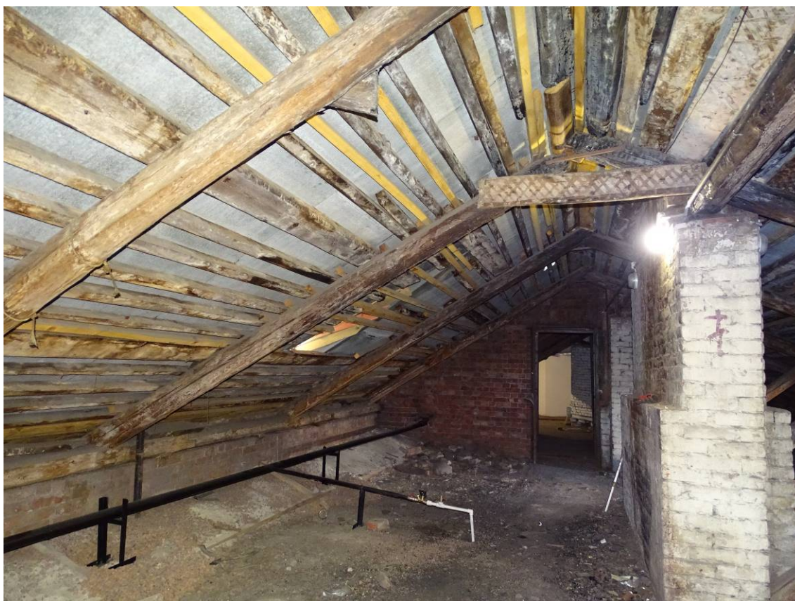
Фото 35. Лестница № 1. Чердачный этаж. Съемка 19.04.2021 г. Трушковский В.Э.
