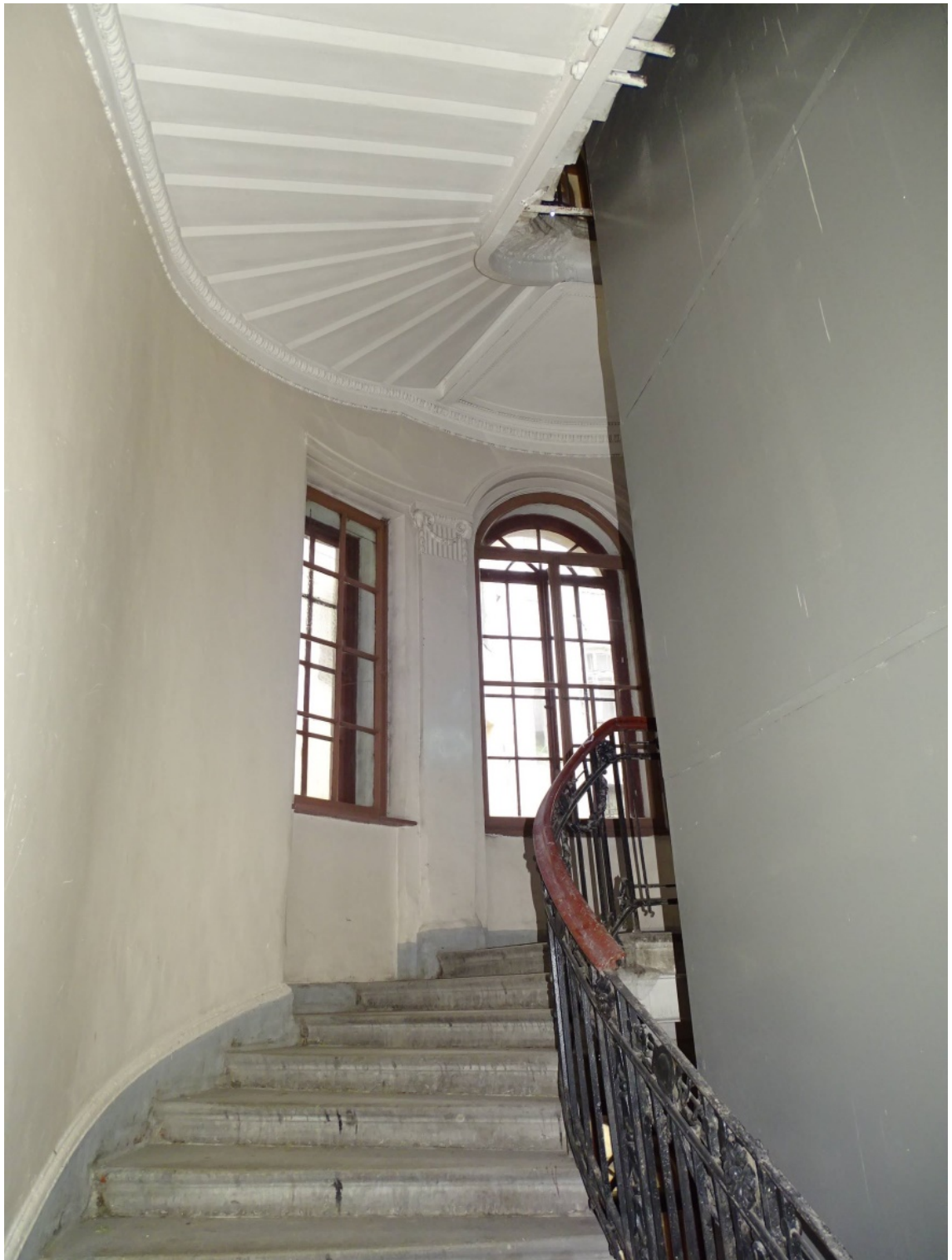
Фото 15. Лестница № 1. Площадка между 2-м и 3-м этажом. Съемка 19.04.2021 г. Штиглиц М. С.
