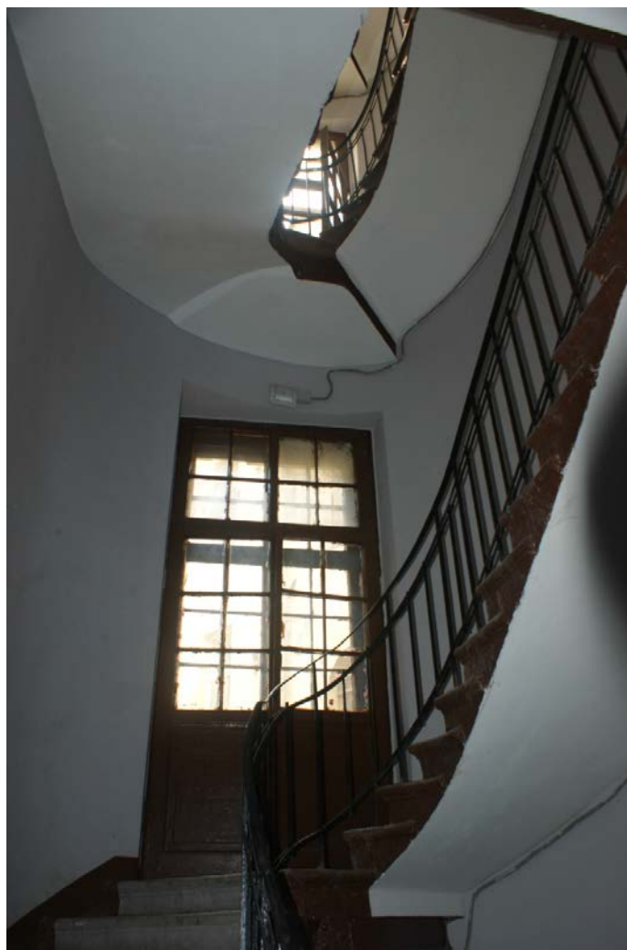
Фото 112. Лестница № 4. Площадка между 3-м и 4-м этажом. Съемка 19.04.2021 г. Штиглиц М. С.
