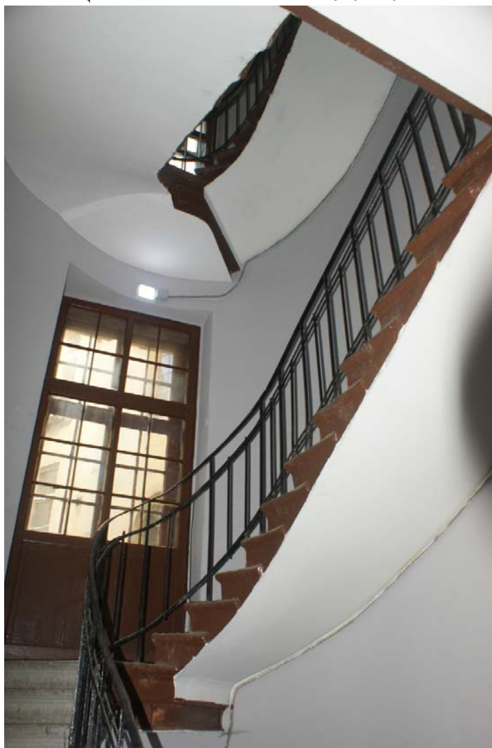
Фото 107. Лестница № 4. Площадка между 2-м и 3-м этажом. Съемка 19.04.2021 г. Штиглиц М. С.
