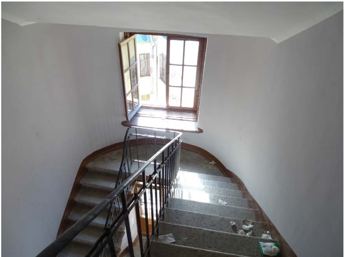
Фото 132. Лестница № 4. Площадка между 6-м и чердачным этажом. Съёмка 19.04.2021 г. Штиглиц М. С.
