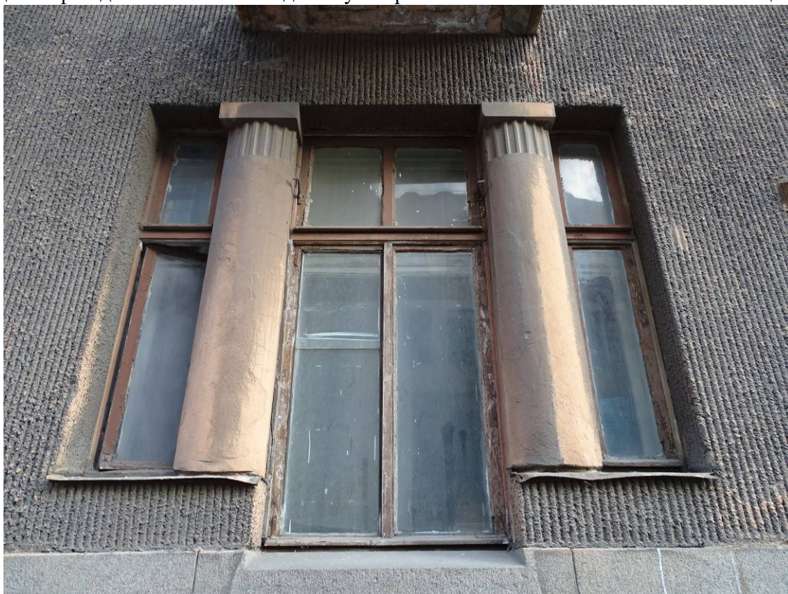
Фото 18. Здание по адресу: г. Санкт-Петербург, Большая Посадская, дом 1/10, литера А. Лицевой фасад по Большой Посадской ул. Оконное заполнение. Съемка 19.04.2021 г. Штиглиц М. С.
