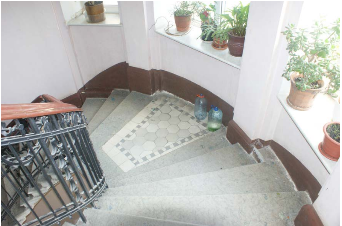
Фото 68. Лестница № 2. Площадка между 5-м и 6-м этажом. Съемка 19.04.2021 г. Штиглиц М. С.
