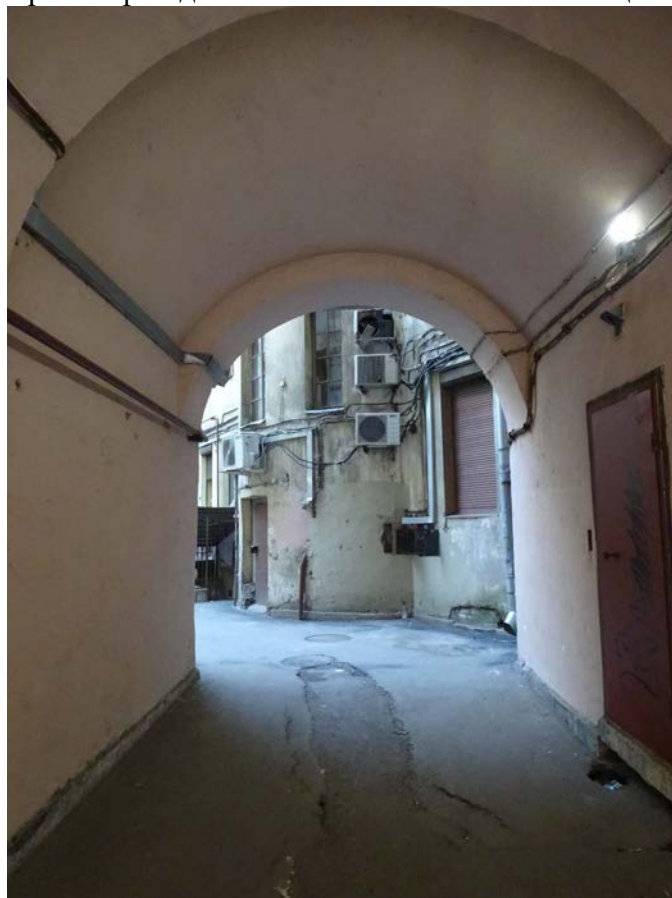
Фото 25. Здание по адресу: г. Санкт-Петербург, Большая Посадская, дом 1/10, литера А. Въездная арка с Большой Посадской ул. Съемка 19.04.2021 г. Штиглиц М. С.
