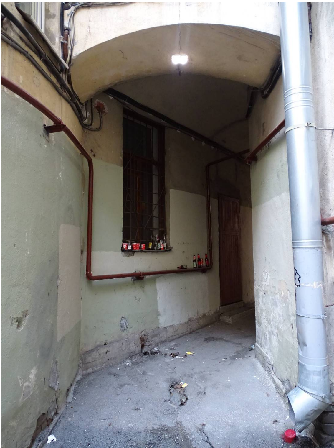
Фото 32. Здание по адресу: г. Санкт-Петербург, Большая Посадская, дом 1/10, литера А. Внутренний двор. Проход между дворовыми корпусами. Съемка 19.04.2021 г. Штиглиц М. С.
