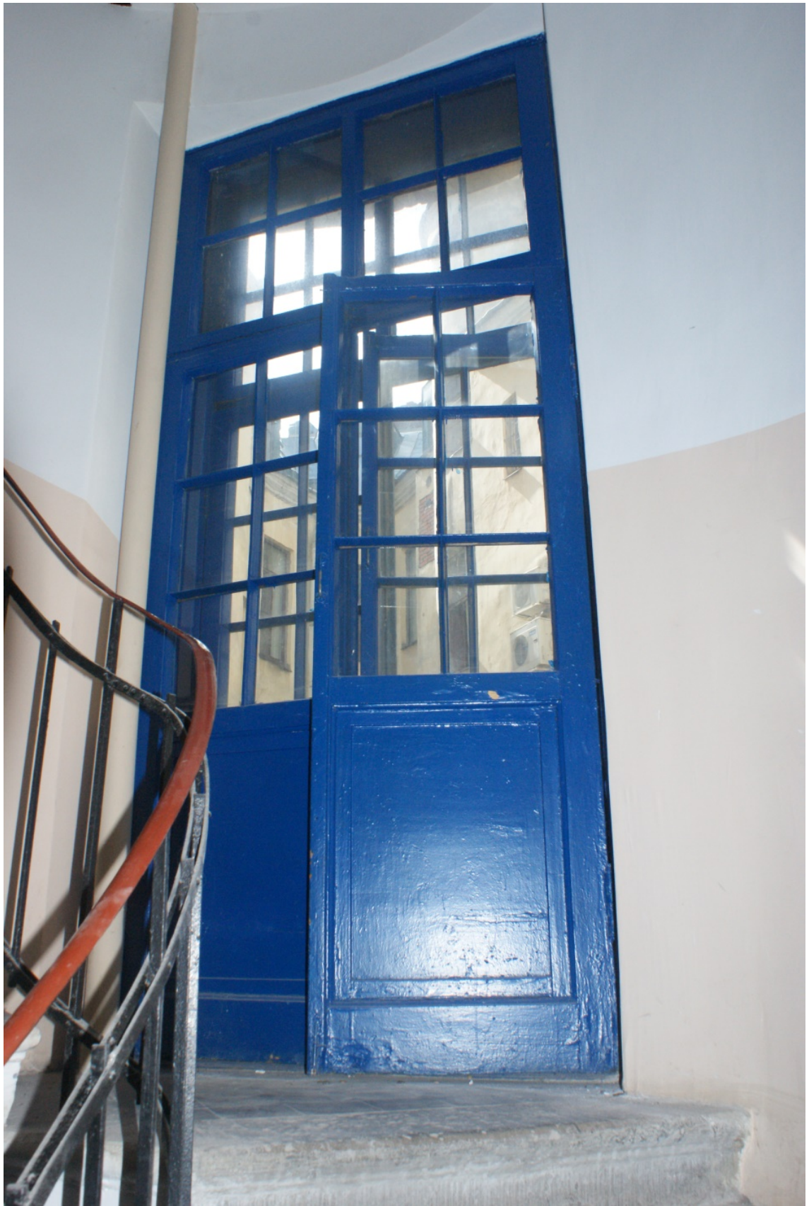
Фото 87. Лестница № 3. Площадка между 3-м и 4-м этажом. Съемка 19.04.2021 г. Штиглиц М. С.
