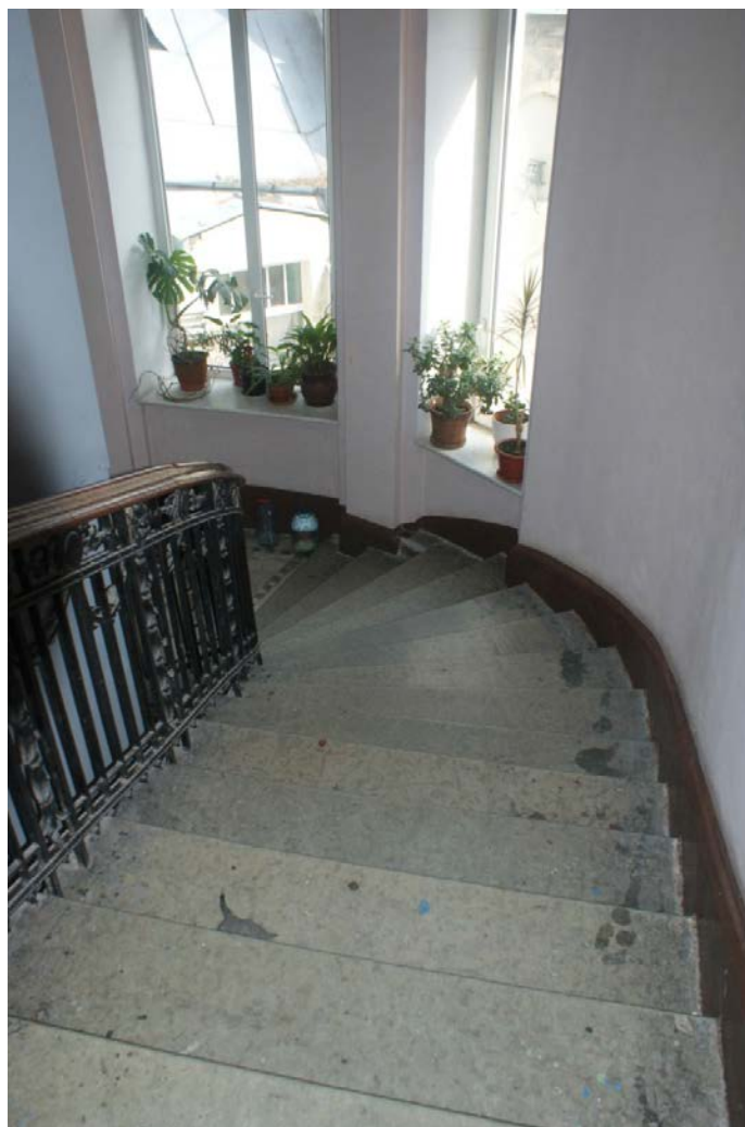
Фото 66. Лестница № 2. Площадка между 5-м и 6-м этажом. Съемка 19.04.2021 г. Штиглиц М. С.
