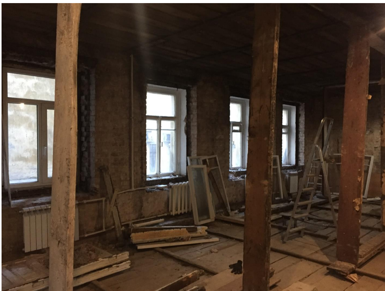
Фото 10. Общий вид существующего состояния помещений квартиры № 78 и оконных заполнений юго-восточного дворового фасада.
