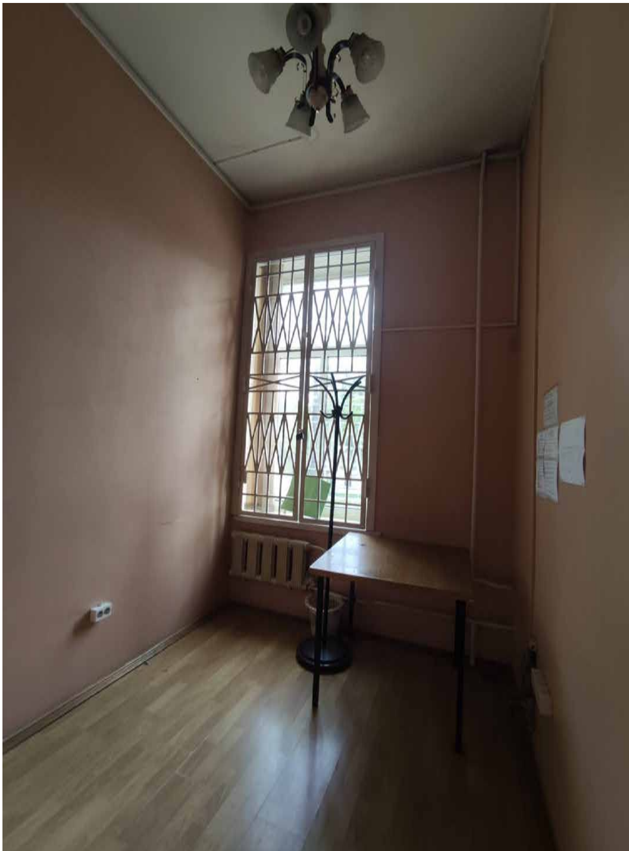
Фото 32. Объект культурного наследия регионального значения «Дом командира Уланского полка», расположенный по адресу: Санкт-Петербург, город Петергоф, Санкт-Петербургский проспект, дом 13/7. Общий вид пом. № 2-Н(9).
