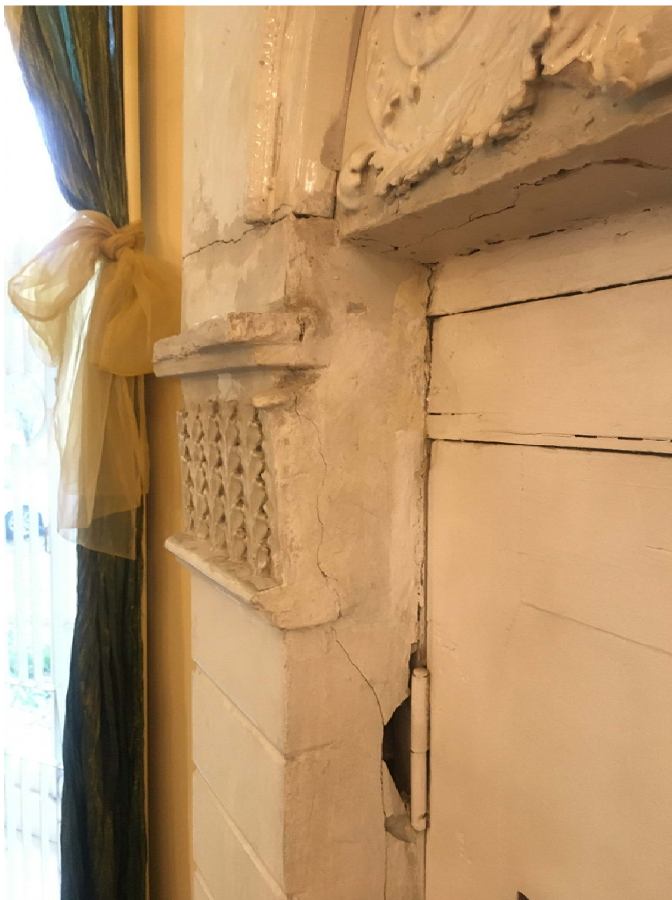
Фото №22. Помещение №1-Н (20), печь 4 (маркировка согласно проекту). Состояние элементов декора.
