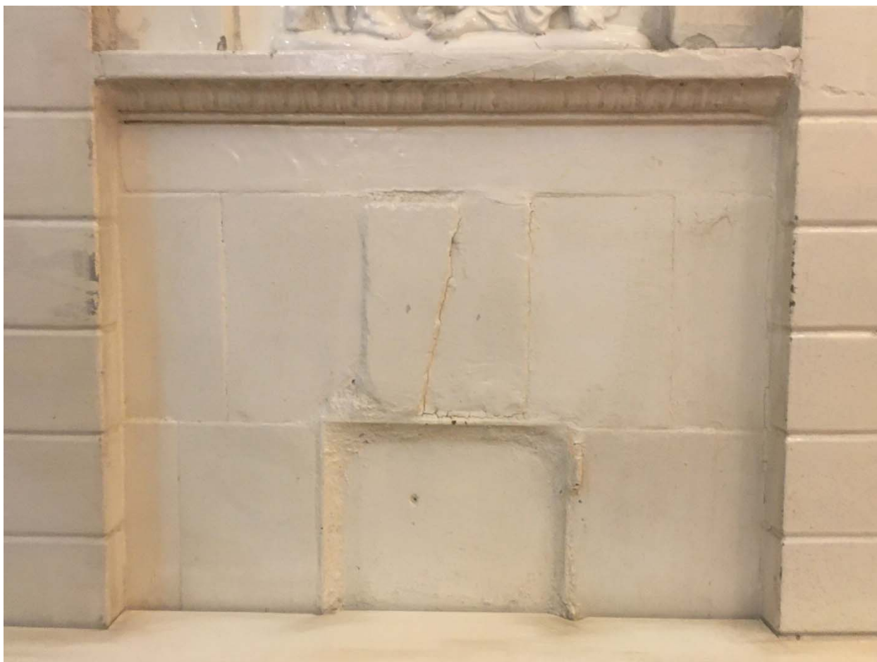
Фото №7. Помещение №1-Н (20), печь 1 (маркировка согласно проекту), топочная часть.
