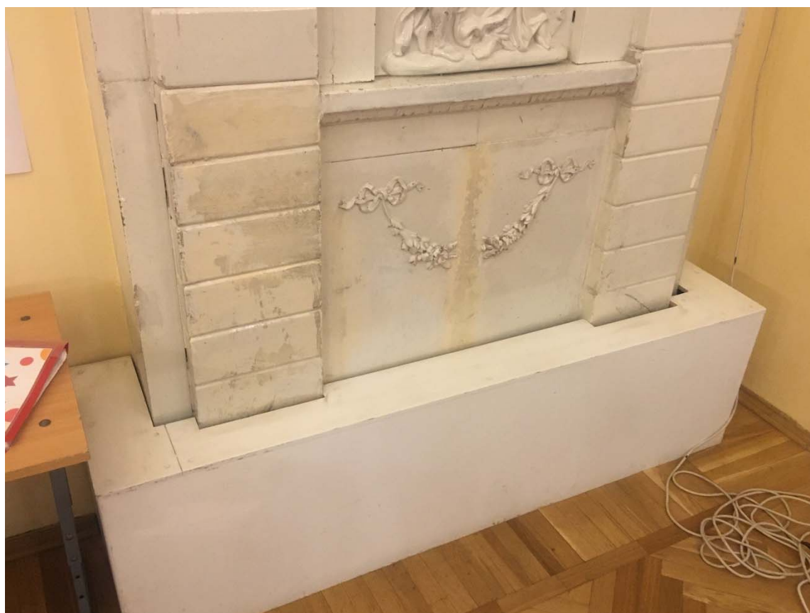
Фото №10. Помещение №1-Н (20), печь 2 (маркировка согласно проекту), топочная часть (поздние вставки), основание.
