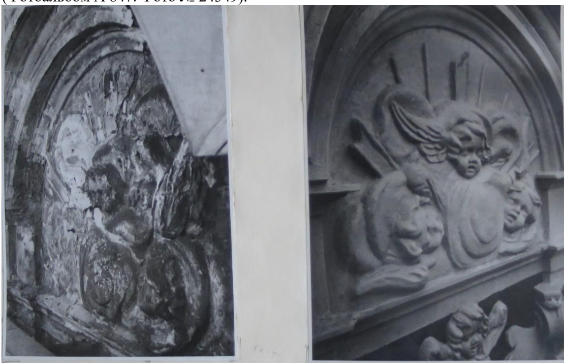
40. Неизвестный автор. Здание усыпальницы Суворова. Барельеф фронтона фасада до реставрации и Барельеф фронтона фасада после реставрации Фотография. 1950 г. Архив КГИОП. П-155. (Фотоальбом А 847. Фото № б/н).
