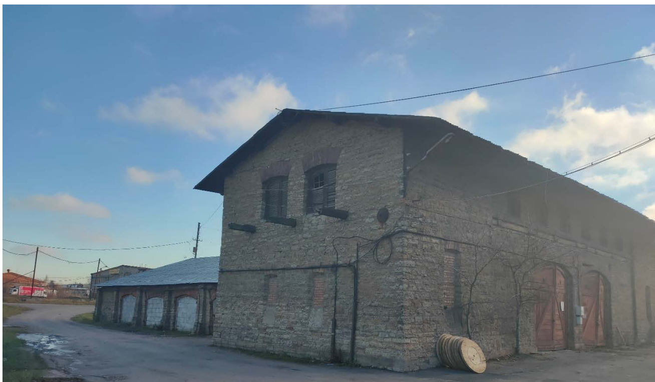
12. Северные фасады объекта культурного наследия регионального значения «Бутовая кладовая», расположенный по адресу: г. Санкт-Петербург, Октябрьская наб., д. 54, литеры О, П. 01.11.2021
