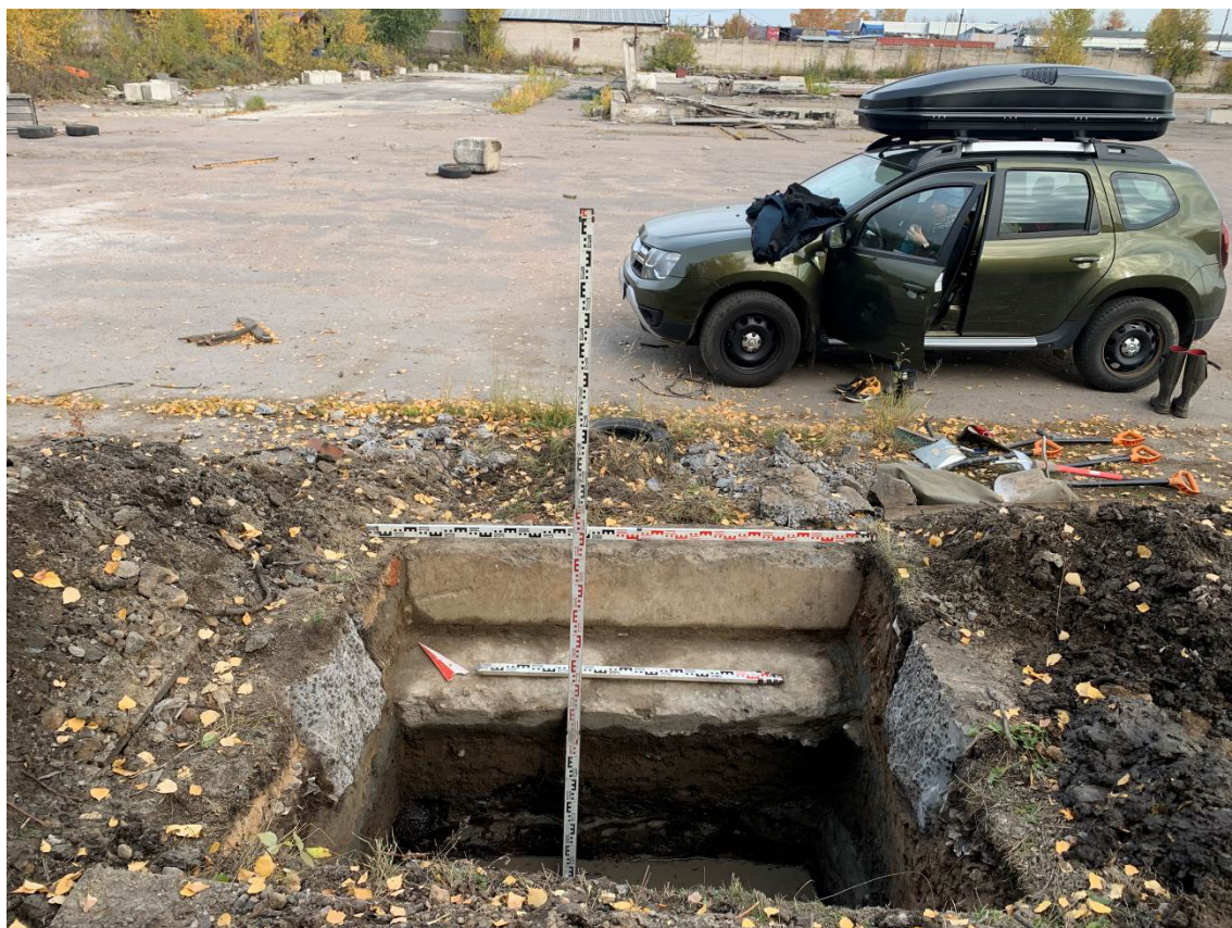
Рис. 45. Санкт-Петербург, Выборгский район, 5-й Верхний пер., д. 1, лит. В. Общий вид Шурфа 1. Финальная зачистка. Вид с ЮЗ.
