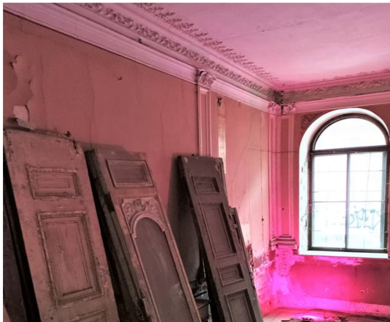
27. Объекта культурного наследия регионального значения «Дом С. С. Нарышкина», по адресу: Санкт-Петербург, Литейный проспект, дом 62, литера А (Литейный пр., 62. Вестибюль. Детали и фрагменты стен вестибюля. Пилястры. Заполнение антресолята. Фрагмент антаблемента. Дата съемки: 12 октября 2021 г.
