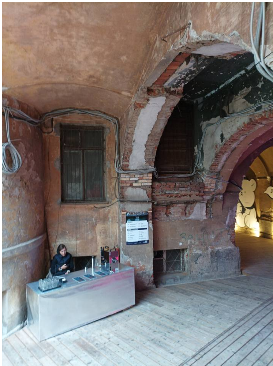
6. Объекта культурного наследия регионального значения «Дом С. С. Нарышкина», по адресу: Санкт-Петербург, Литейный проспект, дом 62, литера А (Литейный пр., 62) Фрагмент восточного фасада Дата съемки: 12 октября 2021 г.
