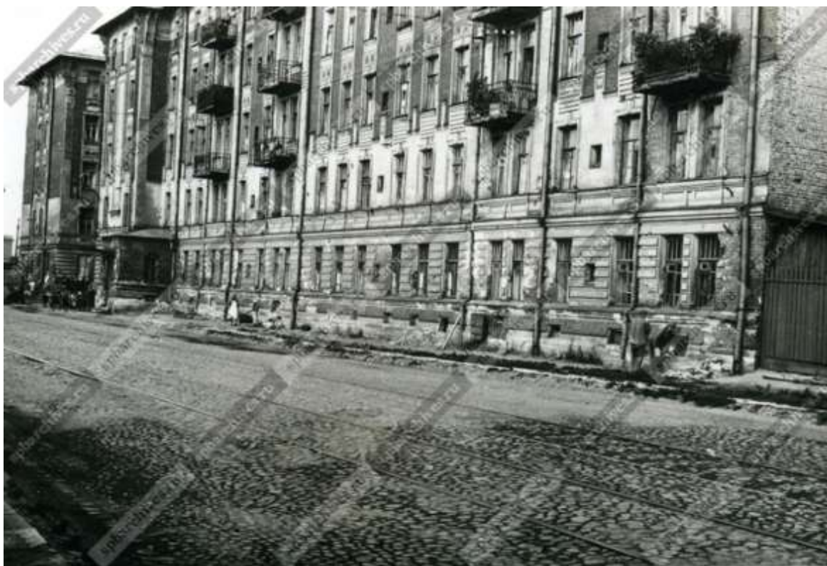
109. Фрагменты фасадов 2-ух разрушающихся домов Жилого комплекса "Гаванский рабочий городок" (Гаванская ул., 47; Малый пр., 69, 71), гражд.инж. Н.В.Дмитриев при участии В.А.Федорова, 1904-1906. 1955-1960 гг. ЦГАКФФД СПб Бр 67528
