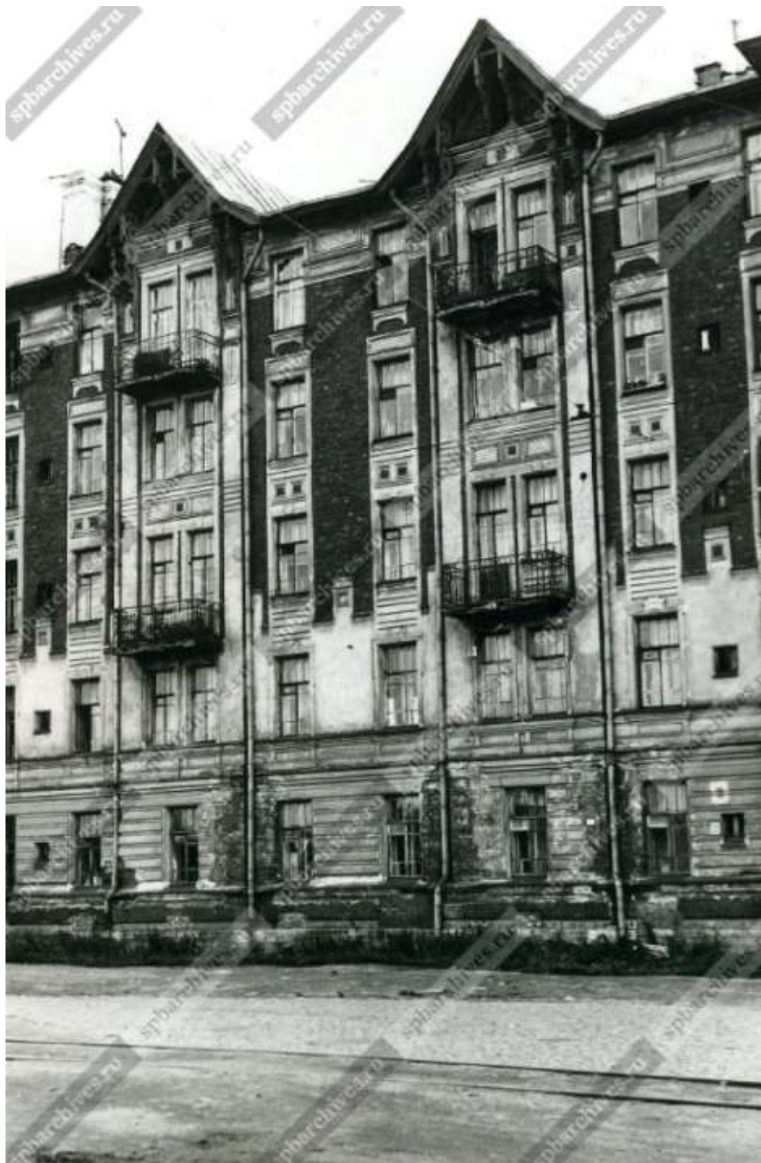
108. Фрагмент фасада одного из разрушающихся жилых домов Жилого комплекса "Гаванский рабочий городок" (Гаванская ул., 47; Малый пр., 69, 71), гражд.инж.Н.В.Дмитриев при участии В.А.Федорова. 1955-1960 гг. ЦГАКФФД СПб Бр 67527
