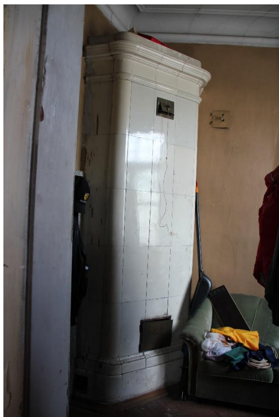
Фото 22. Вид на печь в пом. 1-Н (15).
