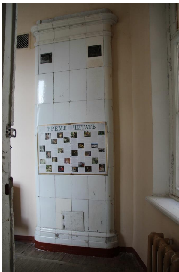
Фото 46. Вид на печь в пом. 1-Н (125).
