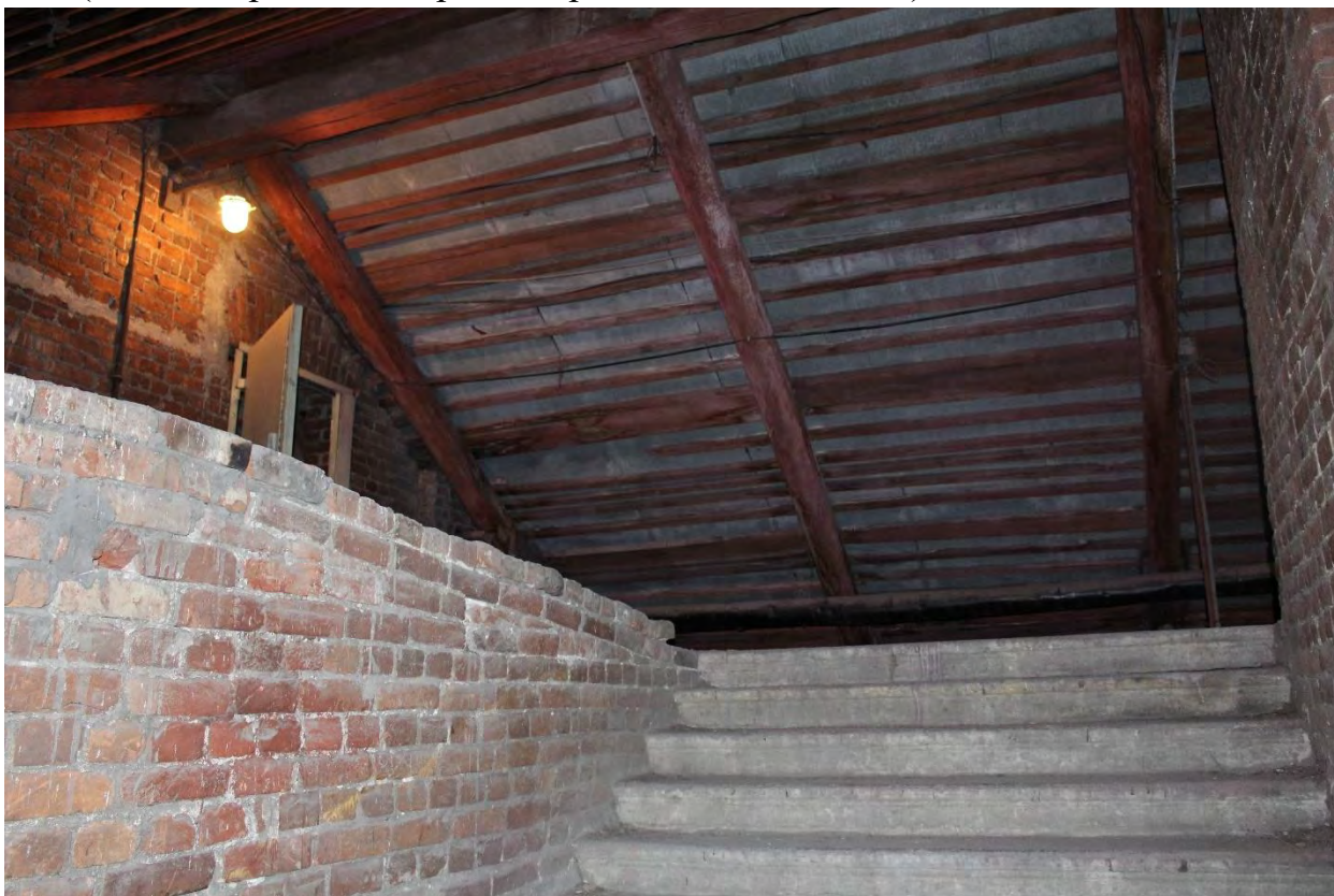
Фото 85. Чердачные помещения лицевого корпуса выявленного объекта культурного наследия «Манеж и конюшни лейб-гвардии Гренадерского полка (здание тира лейб-гвардии Стрелкового батальона)». Фото 22.05.2023 г.
