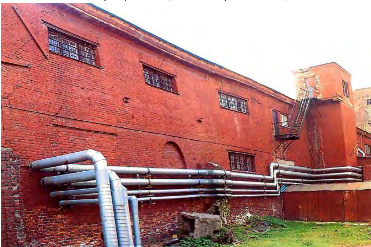
Илл. 47. Вид на северный фасад дворового корпуса (Загородный пр., д. 35, корп. 3, литера Н). 2008 г. (источник: архив КГИОП).
