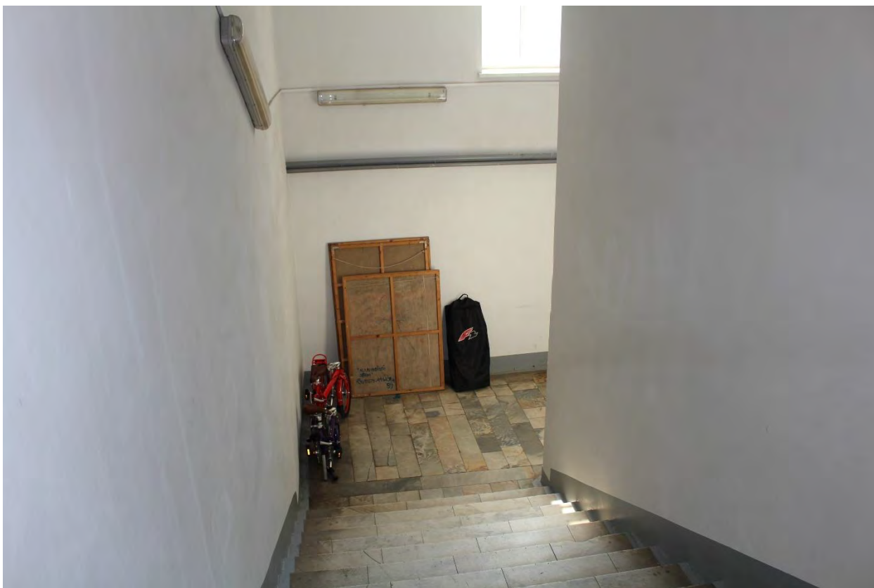
Фото 72. Юго-западная лестничная клетка лицевого корпуса выявленного объекта культурного наследия «Манеж и конюшни лейб-гвардии Гренадерского полка (здание тира лейб-гвардии Стрелкового батальона)». Фото 22.05.2023 г.
