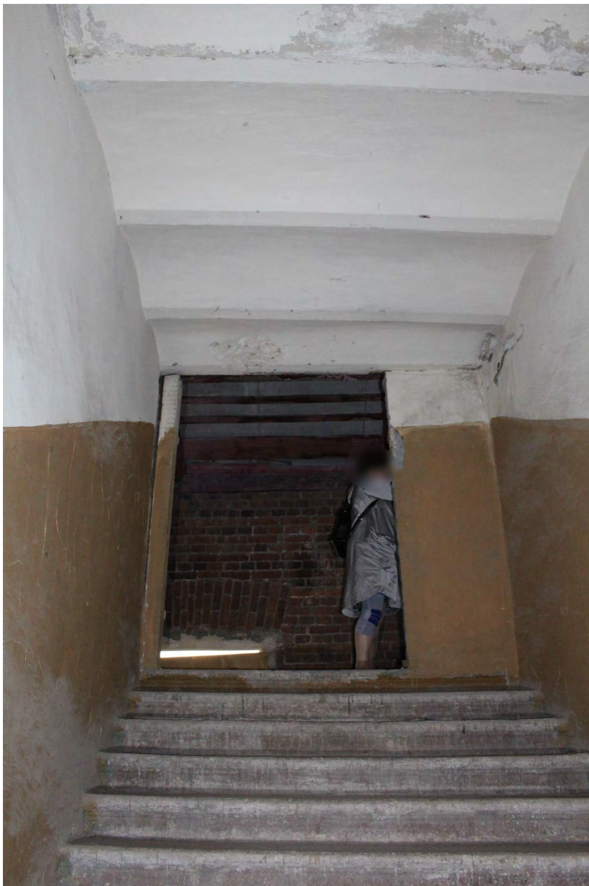
Фото 83. Выход в чердачные помещения лицевого корпуса выявленного объекта культурного наследия «Манеж и конюшни лейб-гвардии Гренадерского полка (здание тира лейб-гвардии Стрелкового батальона)». Фото 22.05.2023 г.
