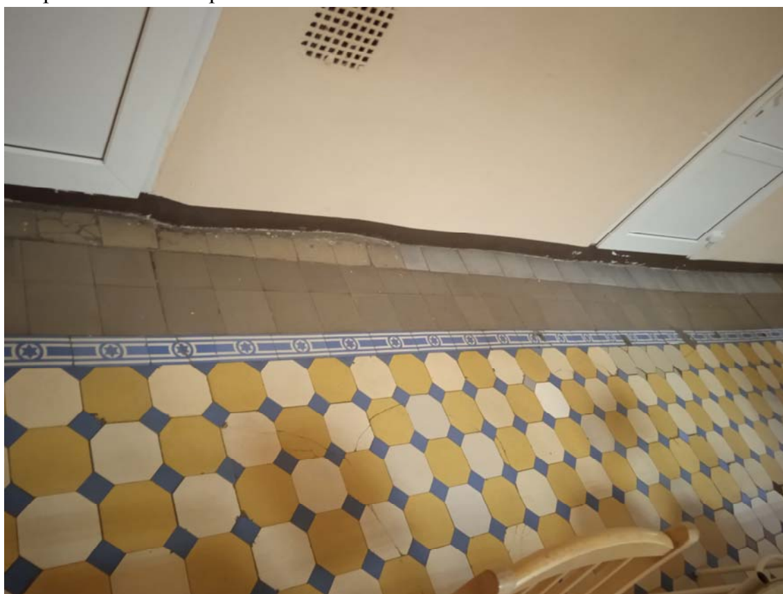
15. Помещение № 17 первого этажа. Северо-западная стена помещения в зоне прогиба балки. Фрагмент.
