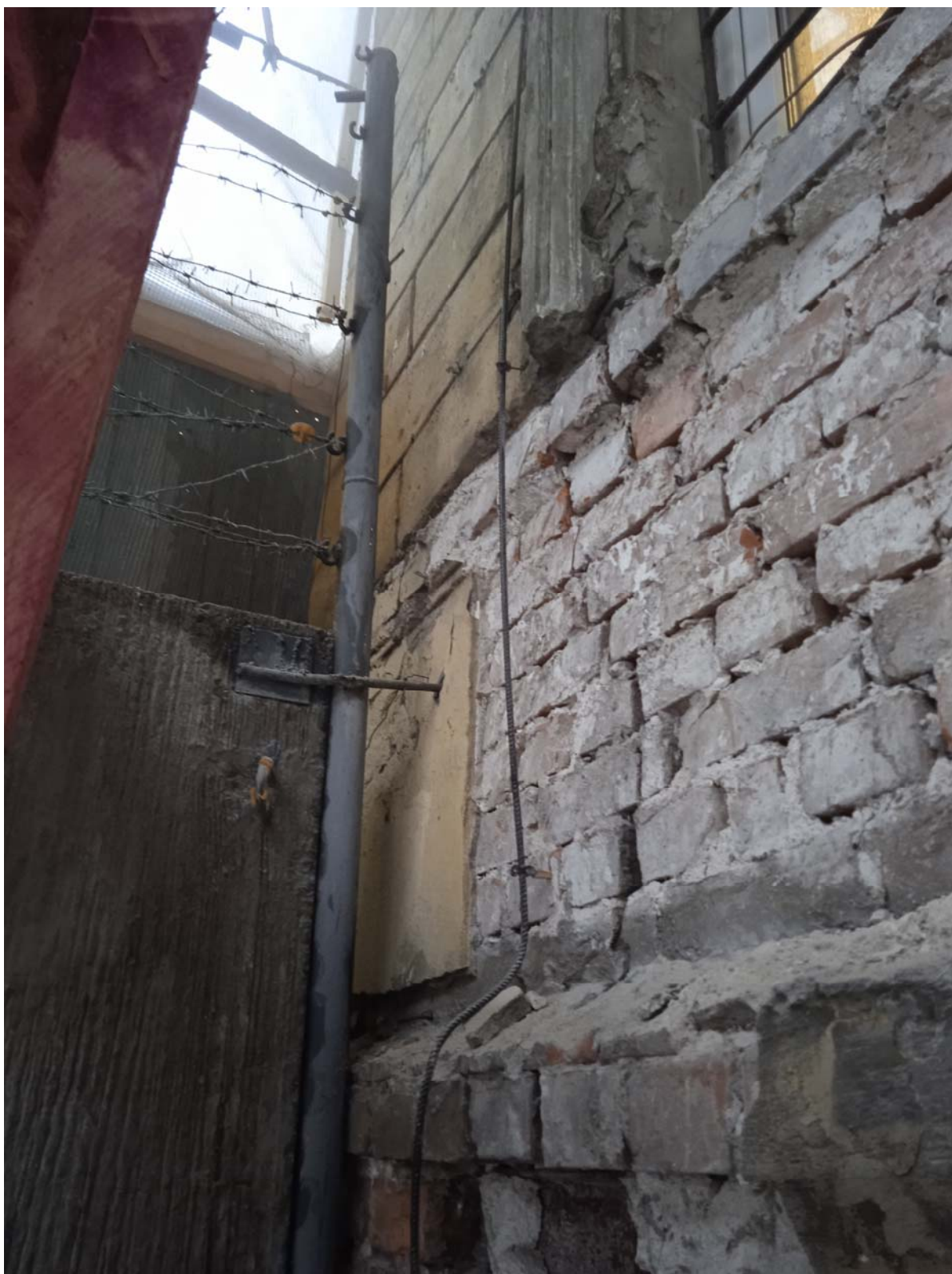
5. Юго-западный фасад здания между осями 25-24/Д в уровне цокольного этажа. Деструкция кирпичной кладки, утраты шовного раствора. Вертикальная сквозная трещина в кладке.
