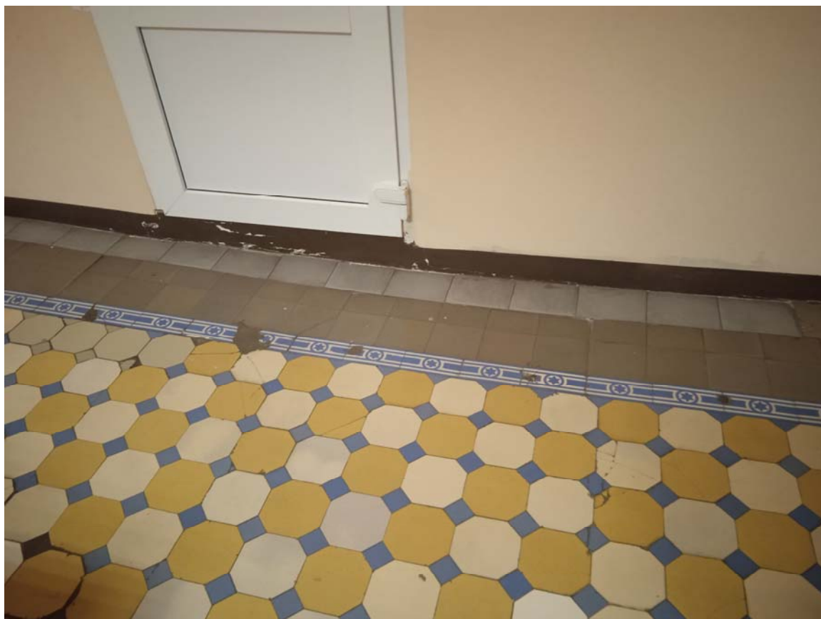
14. Помещение № 17 первого этажа. Северо-западная стена помещения в зоне прогиба балки. Фрагмент.
