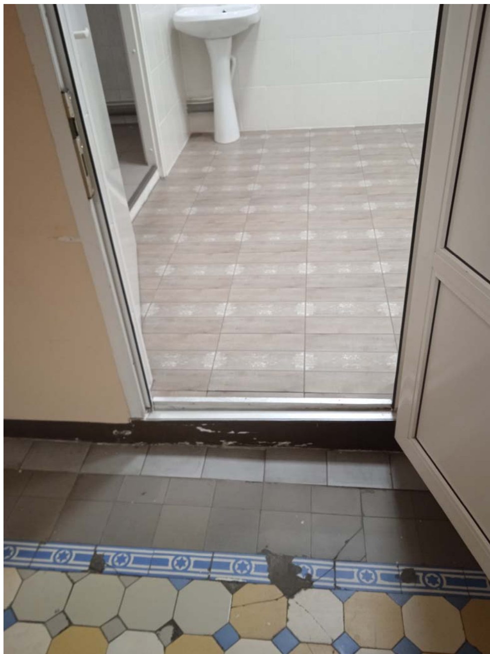
17. Вход из помещения № 17 первого этажа (приемный покой) в помещение № 11 первого этажа (кабинет).
