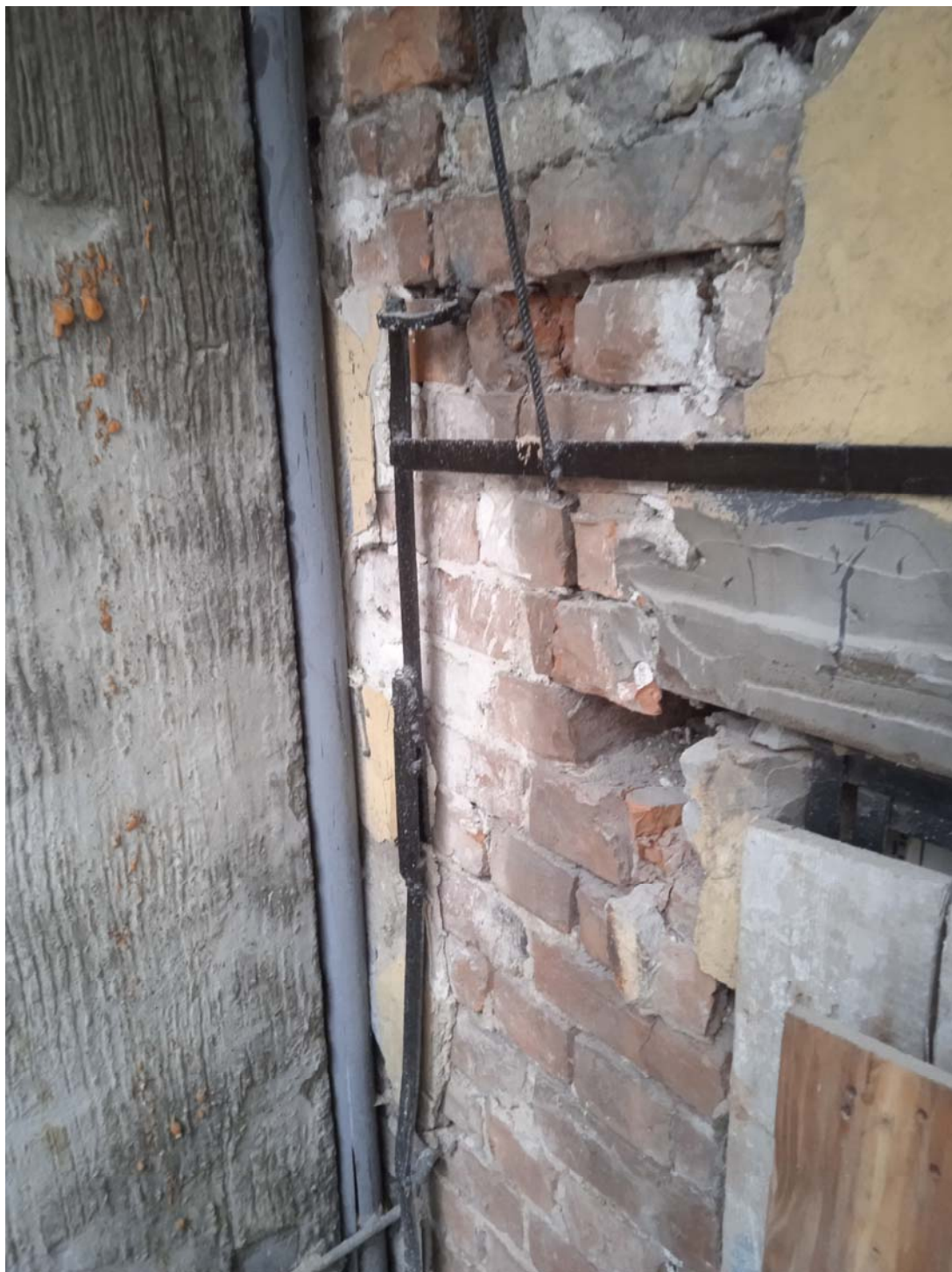
6. Юго-западный фасад здания между осями 25-24/Д в уровне цокольного этажа. Деструкция кирпичной кладки, утраты шовного раствора. Вертикальная сквозная трещина в кладке.
