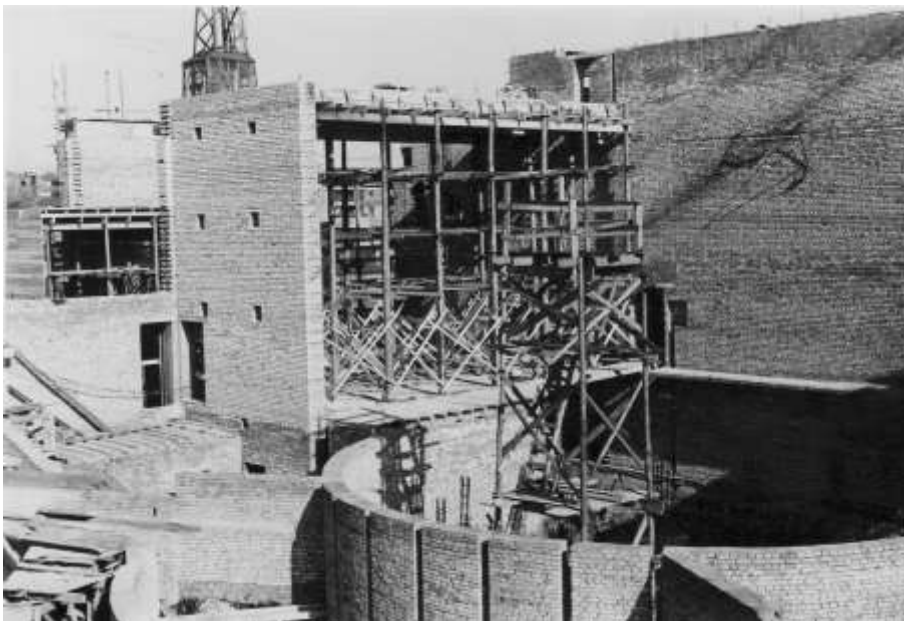
43. ЦГАКФФД СПб. Бр 71438. Вид на строящуюся коробку сцены театра юных зрителей. 1958 г.
