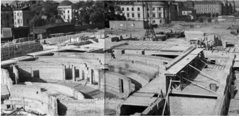
32. ЦГАКФФД. СПб. Бр 71429. Общий вид строительной площадки здания театра юных зрителей. (Панорама из 2-х снимков). 1957 г.
