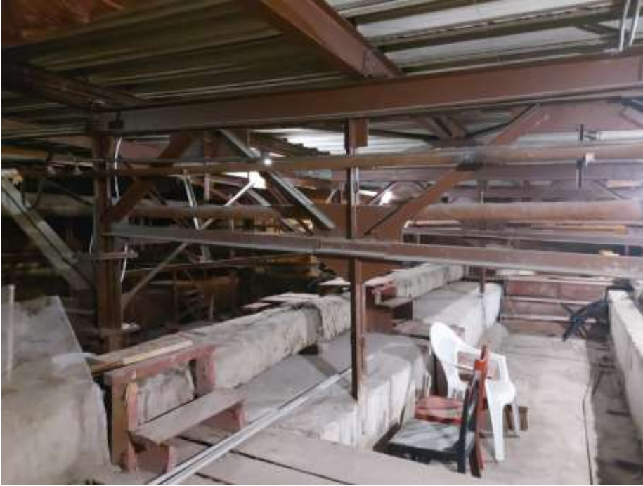
50. Чердачные помещения выявленного объекта культурного наследия «Театр юных зрителей (ТЮЗ) имени А.А. Брянцева». 2023 г.
