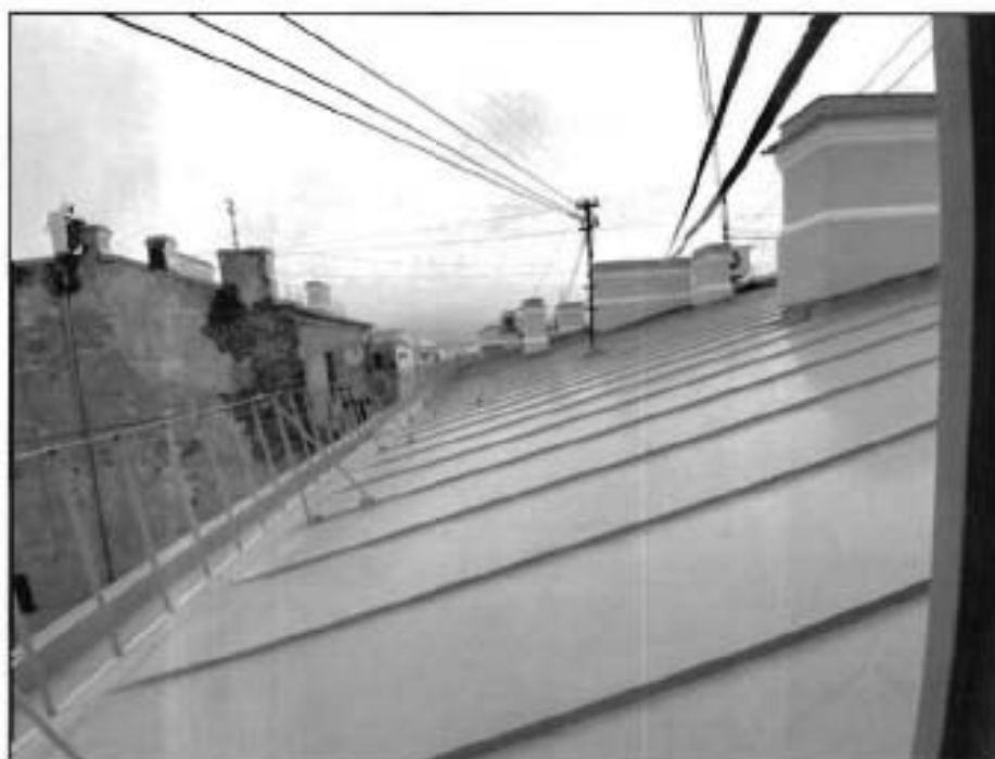
23. Металлическая кровля лицевого корпуса (со стороны пл. Ломоносова и ул. Зодчего Росси). Фото от 16.11.2021 г.
