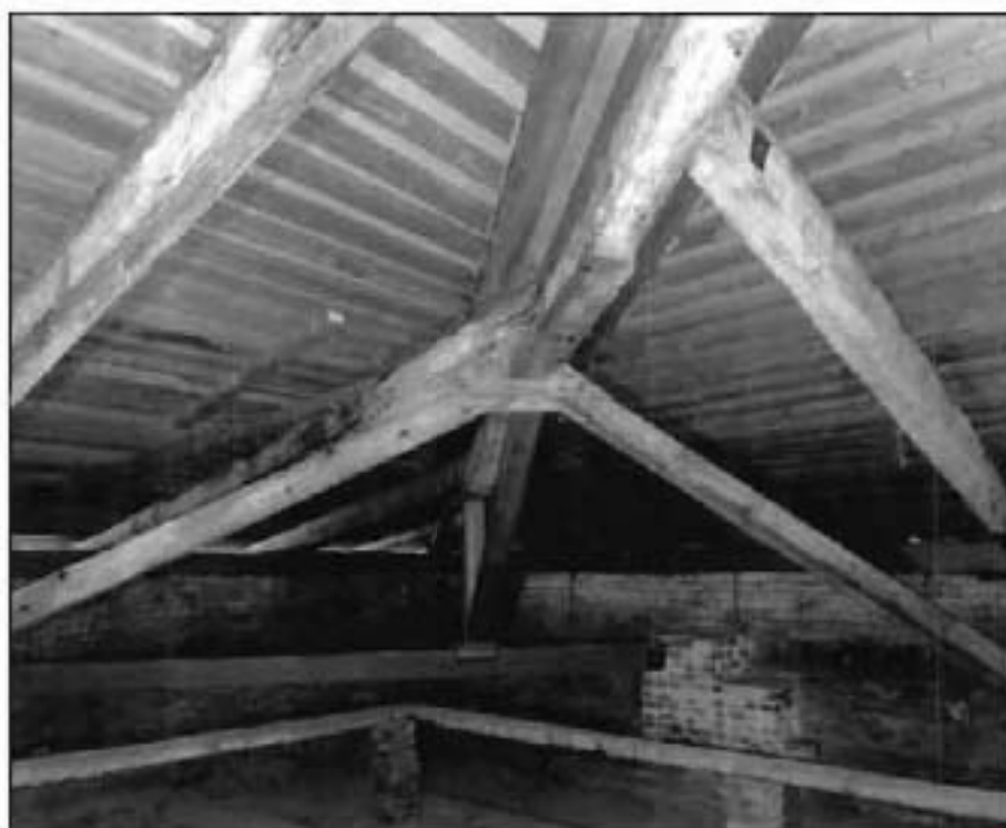
21. Стропильная система лицевого корпуса (со стороны пл. Ломоносова и ул. Зодчего Росси). Фото от 16.11.2021 г.
