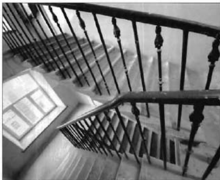
37. Двухмаршевые служебные лестницы (IIJK). Сколы ступеней, истертости в ходовых местах, утраты металлических стоек ограждений. Фото от 16.11.2021 г.
