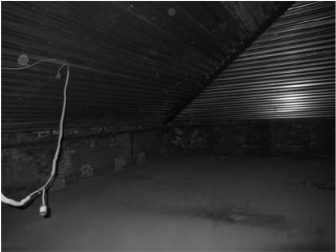
26. Технический этаж здания Проходной.
