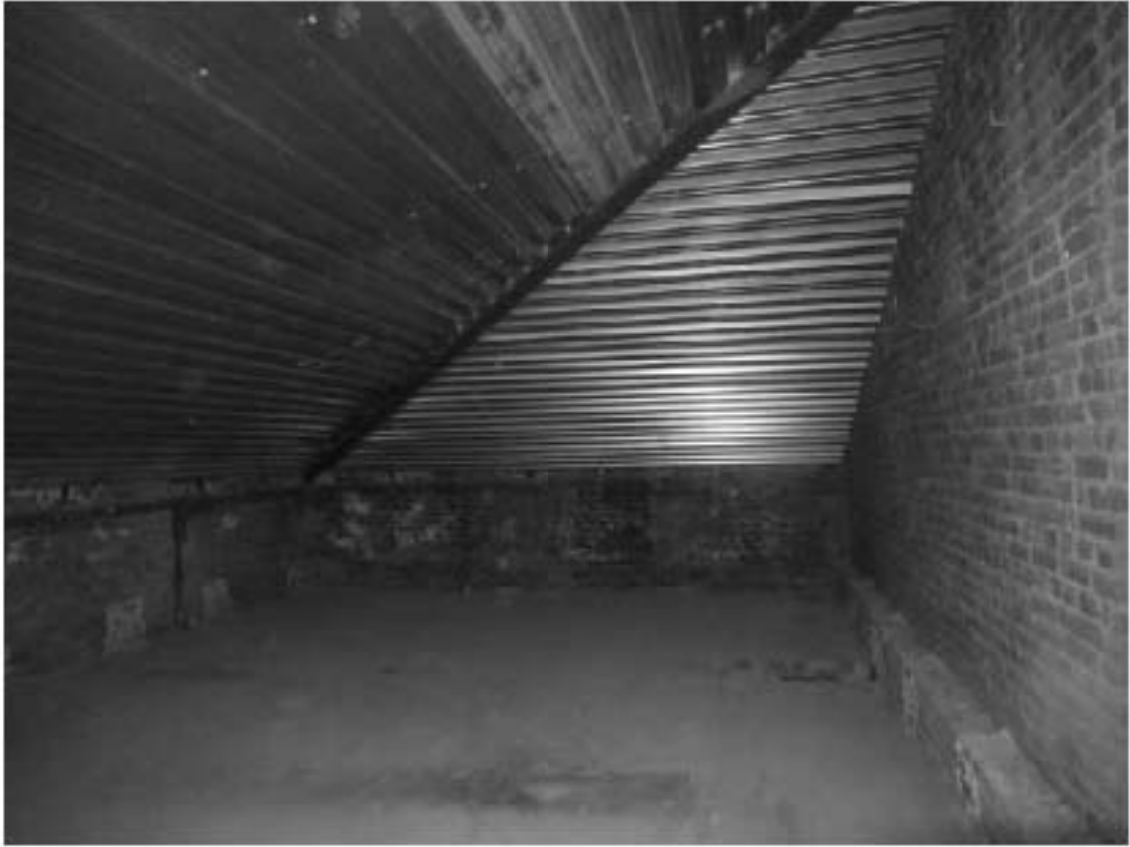
25. Технический этаж здания Проходной.
