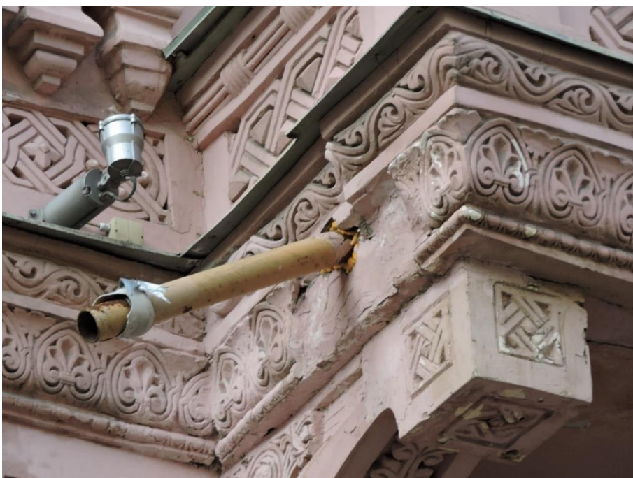
14. Объект культурного наследия регионального значения «Собственный дом архитектора Н.П. Басина», г. Санкт-Петербург, Крылова пер., 7/5, лит. А. Восточный фасад. Фрагмент. Фото 28.08.2023г.
