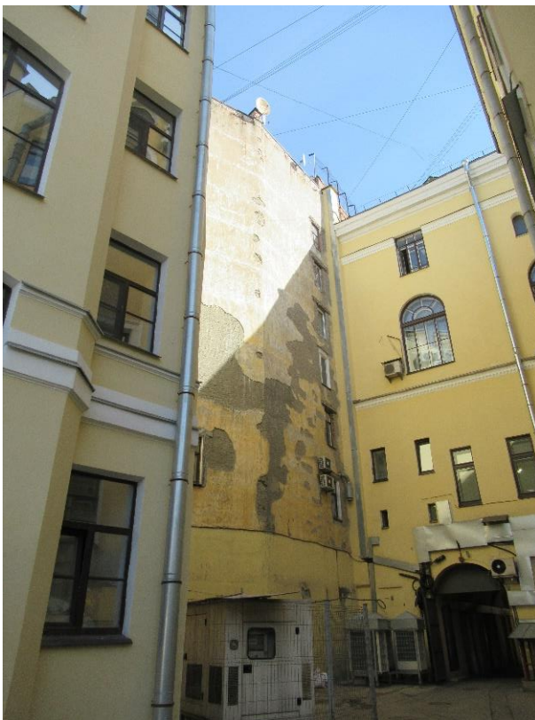
4. Объект культурного наследия регионального значения «Собственный дом архитектора Н.П. Басина», г. Санкт-Петербург, Крылова пер., 7/5, лит. А. Дворовый фасад. Общий вид. Фото 28.08.2023г.
