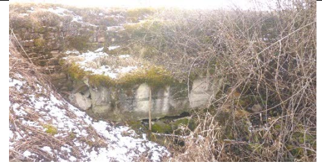
фрагменты кирпичной кладки
