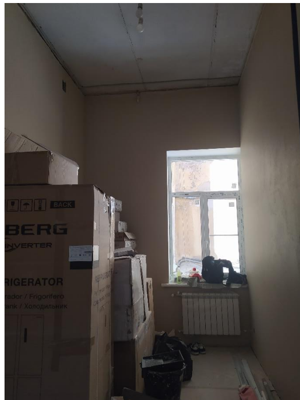
Фото 17. Вид на второе кухонное окно кв. № 33 слева от входа на кухню.
