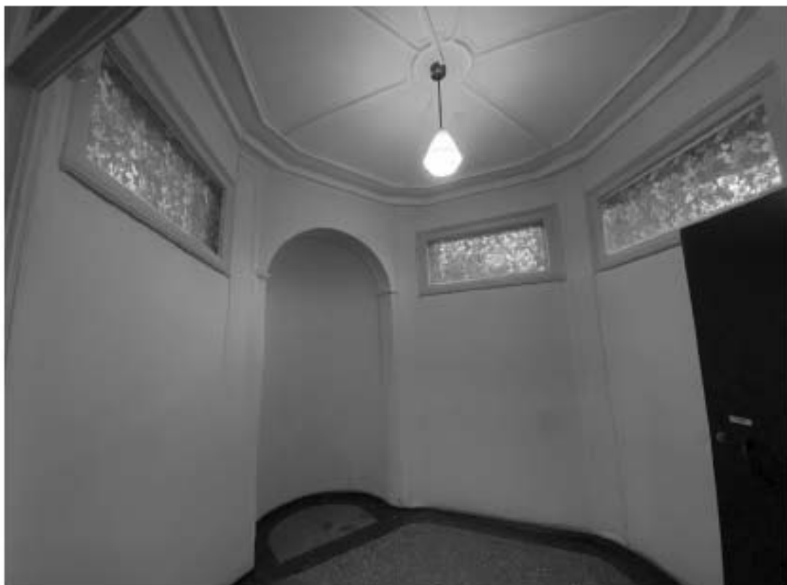
18. Объект культурного наследия регионального значения «Дом А. Гейрота с беседкой, садом и оградой», расположенный по адресу: Санкт-Петербург, город Петергоф, улица Бородачёва, дом 12, литера А. Общий вид пом. 1-Н (1) в уровне 1-го этажа.
