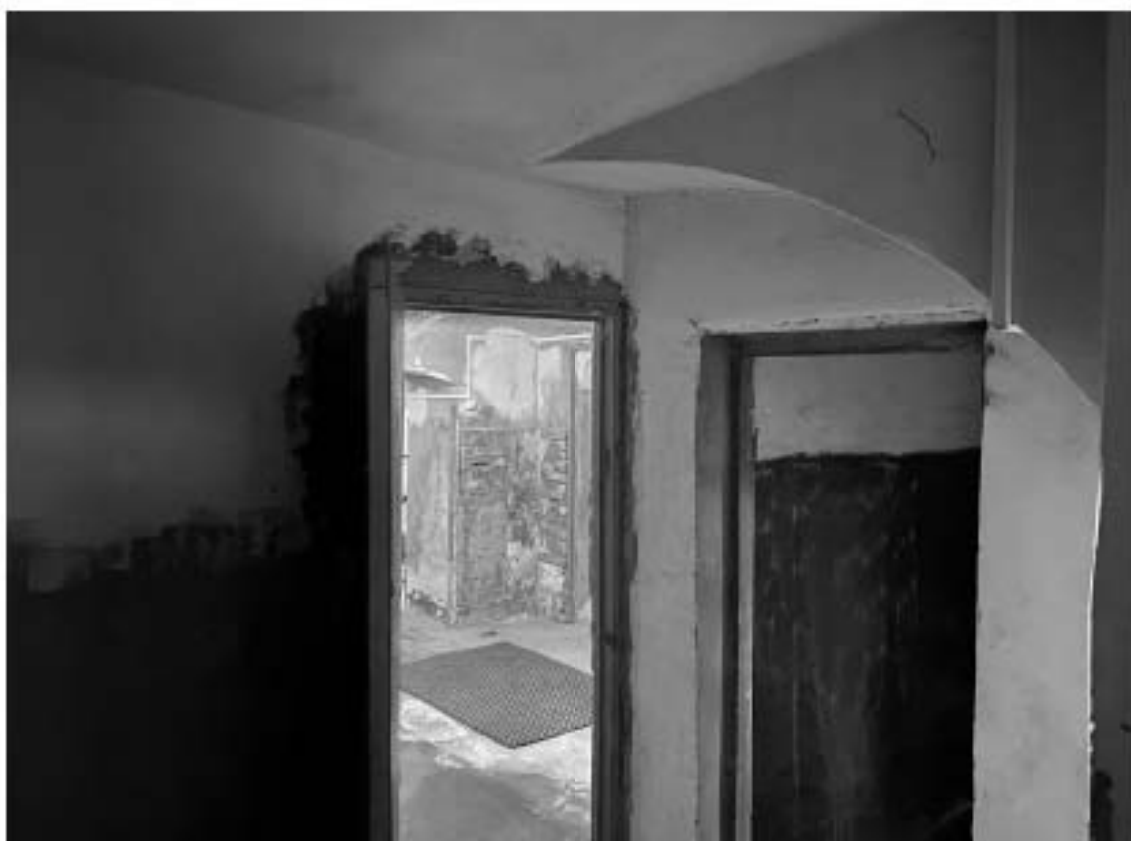
6. Объект культурного наследия регионального значения «Дом А. Гейрота с беседкой, садом и оградой», расположенный по адресу: Санкт-Петербург, город Петергоф, улица Бородачёва, дом 12, литера А. Фрагмент пом. 1-Н (37) в уровне подвала.
