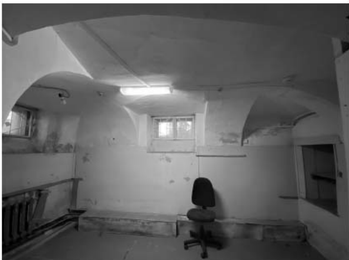
14. Объект культурного наследия регионального значения «Дом А. Гейрота с беседкой, садом и оградой», расположенный по адресу: Санкт-Петербург, город Петергоф, улица Бородачёва, дом 12, литера А. Общий вид пом. 1-Н (45) в уровне подвала.
