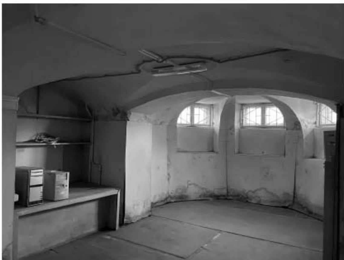
15. Объект культурного наследия регионального значения «Дом А. Гейрота с беседкой, садом и оградой», расположенный по адресу: Санкт-Петербург, город Петергоф, улица Бородачёва, дом 12, литера А. Общий вид пом. 1-Н (43) в уровне подвала.
