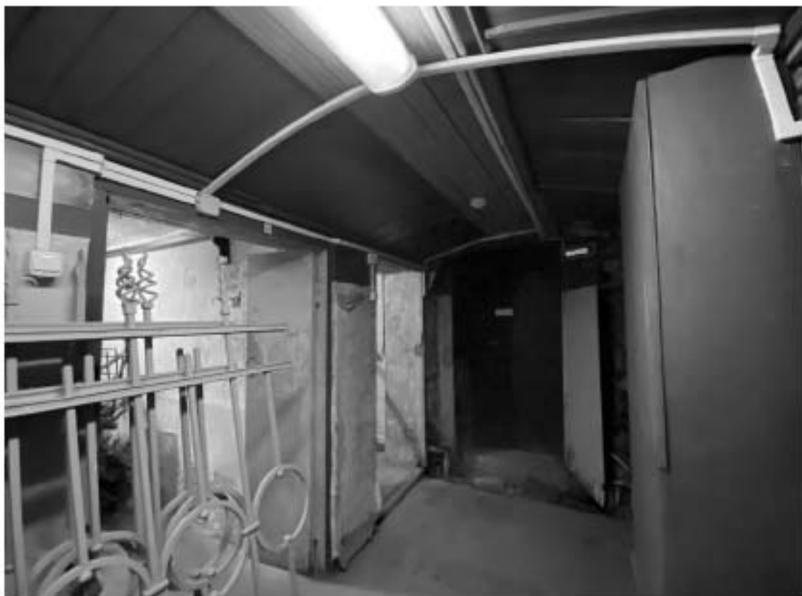
10. Объект культурного наследия регионального значения «Дом А. Гейрота с беседкой, садом и оградой», расположенный по адресу: Санкт-Петербург, город Петергоф, улица Бородачёва, дом 12, литера А. Фрагмент пом. 1-Н (47) в уровне подвала.
